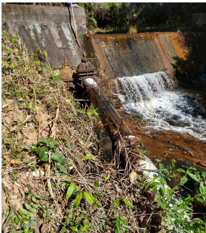
Figura 3 – Área no entorno da Captação sem identificação e delimitação
