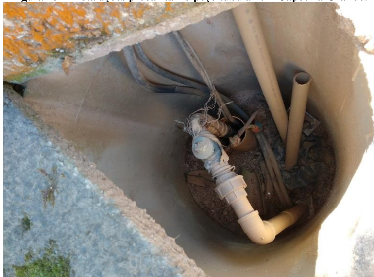
Figura 13 – Instalações precárias no poço tubular em Capoeira Grande.
