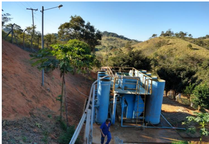
Figura 19 – Estruturas da ETA de Manejo
