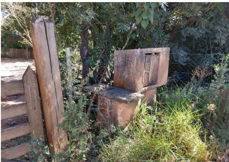
Figura 12 – Captação poço tubular no distrito de Capoeira Grande identificação nem cercamento.
