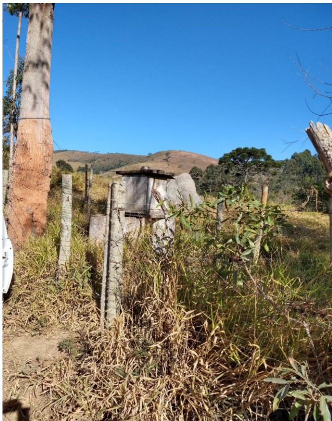
Figura 11 – Local onde é realizada captação em poço tubular sem identificação e com cercamento precário.
