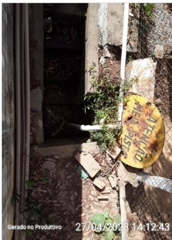
Válvula de saída - Bairro Morada Nova
