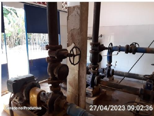
Área interna da EEAB
