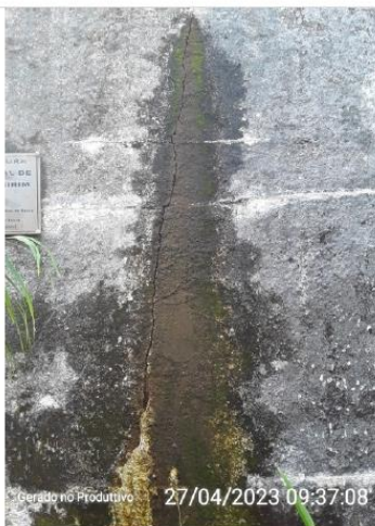
Trincas de infiltração
