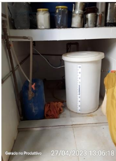
Tanque de preparo do flúor
