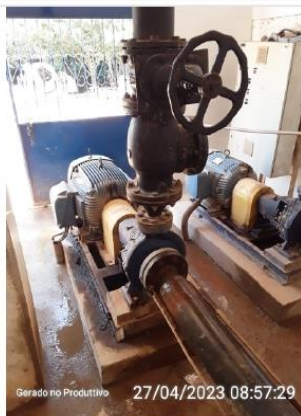
Registro com vazamento.
