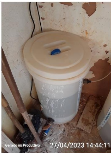
Flúor dosado por bomba dosadora
