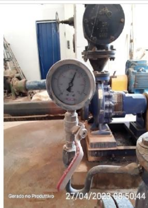
Manômetro na bomba de 75 cv
