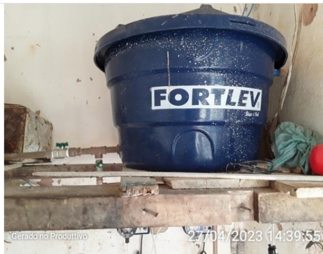
Reservatório de produto químico
