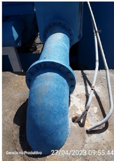
Tubulação de entrada de flúor (tubo fino)
