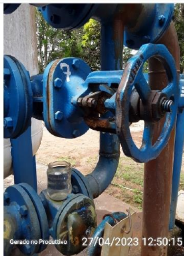
Vazamento da válvula do filtro
