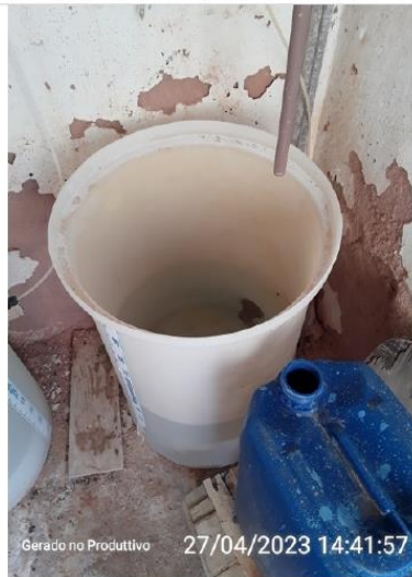
Cloro dosado por bomba dosadora
