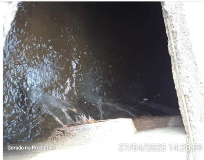
Tanque de contato ETA
