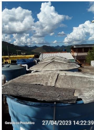
Filtros da ETA Penha
