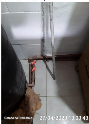
Saída do produto para o tanque de contato por gravidade
