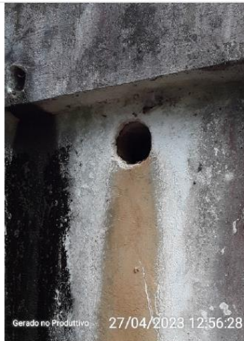
Ventilação do reservatório
