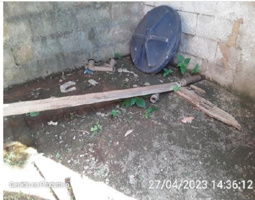
Parte interna da EEAT
