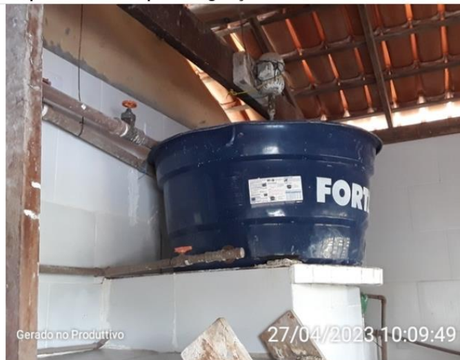
Reservatório de preparo de produto para coagulação
