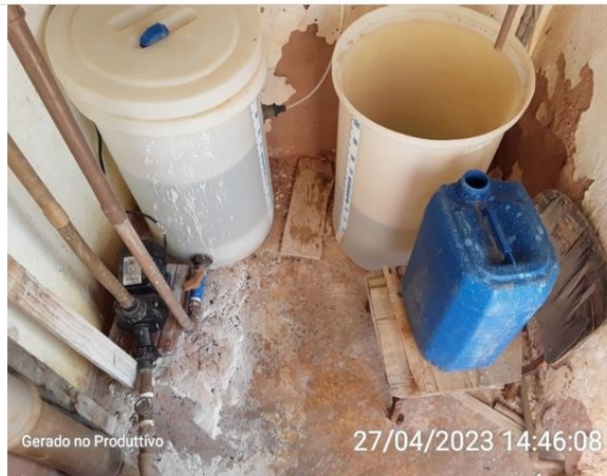
Condições de limpeza na área de dosagem
