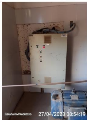
Quadro de comando
