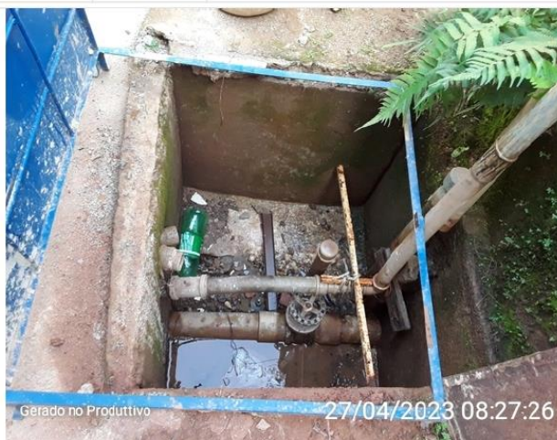
Caixa de descarga de fundo
