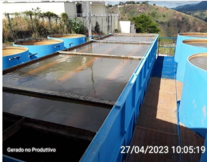
Filtros, decantadores e floculadores
