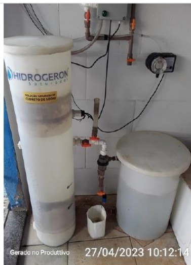
Preparo de cloro para desinfecção
