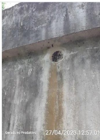
Ventilação do reservatório
