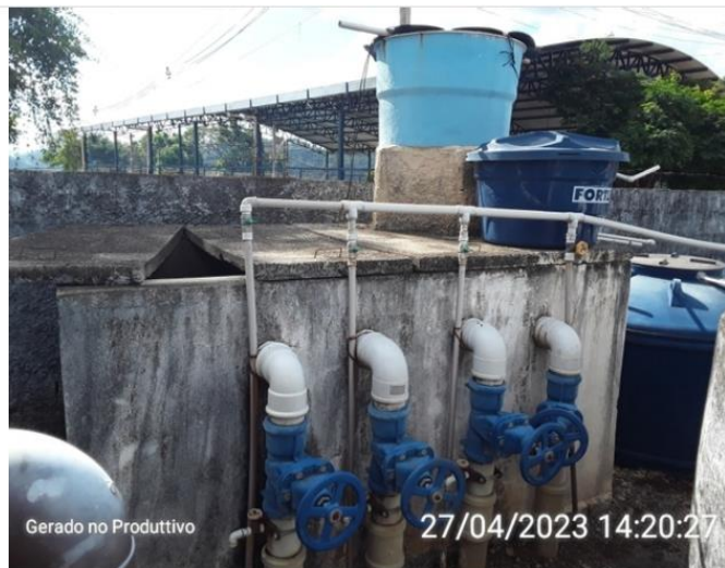
Componente da ETA Penha
