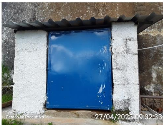
Casa de bombas
