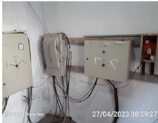
Fiação exposta na entrada dos quadros
