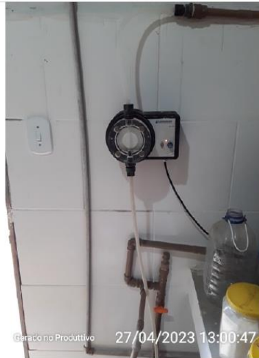
Bomba dosadora (coagulante)
