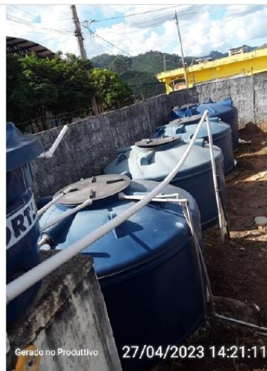
Tanques de contato interligados
