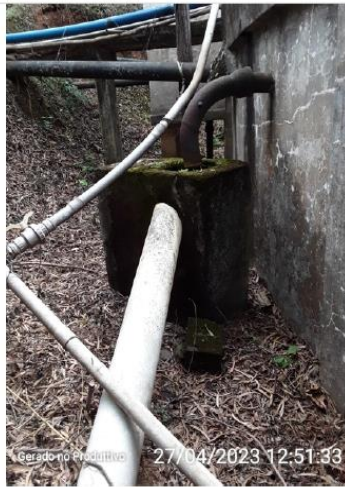
Caixa de descarga
