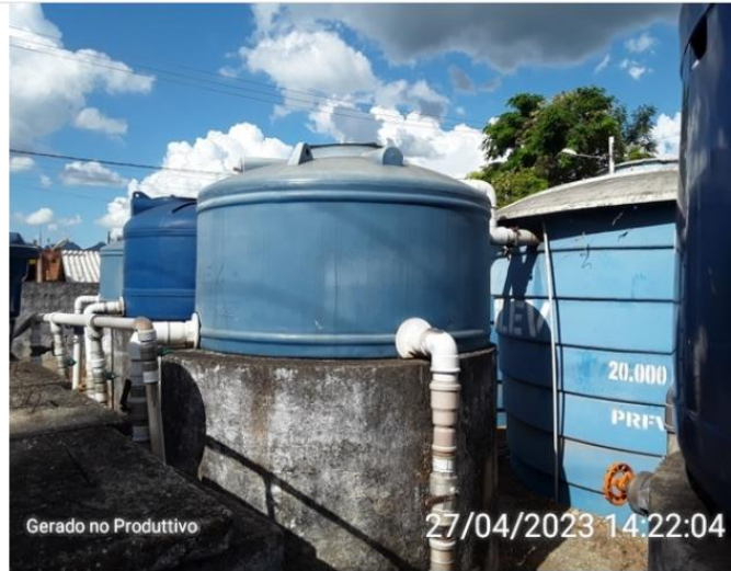
Filtros da ETA Penha
