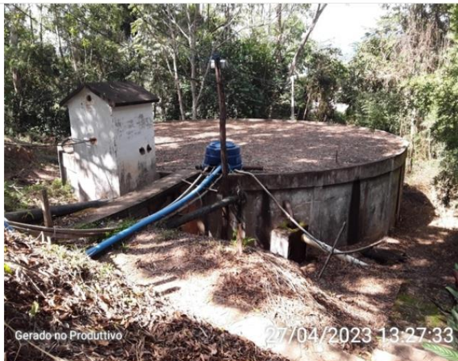
Tanque de contato
