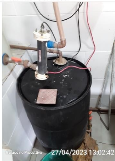
Tambor de armazenamento do cloro produzido
