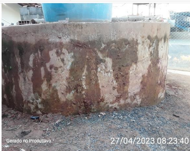
Infiltrações na estrutura do reservatório
