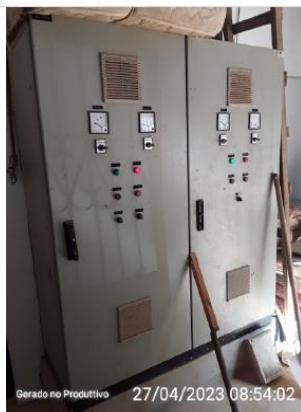
Quadros de comando
