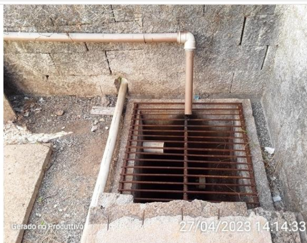
Caixa de descarga
