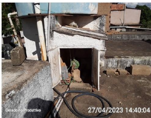
Casa de bombas
