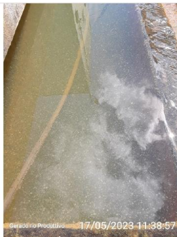
Passagem de flocos para os filtros - Decantador n° 1
