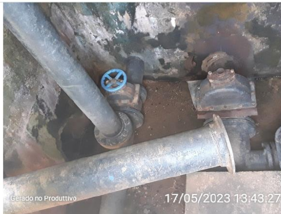
Válvula de fechamento na saída do reservatório
