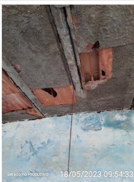
Gerado no Produto 18/05/2023 09:54:33 Estrutura requer manutenção
