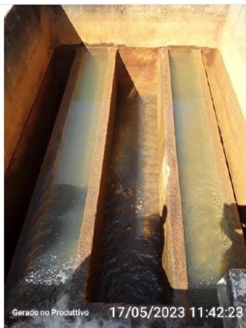
Presença de flocos no filtros
