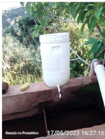
Tanque de cloração
