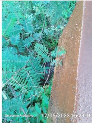
Vazamentos nas estruturas
