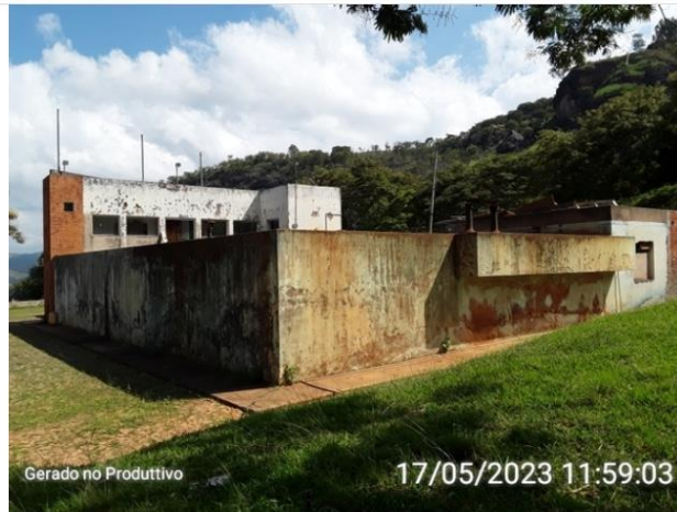
Ausência de guarda corpos
