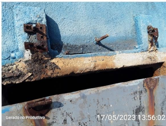
Dobradiça da tampa de inspeção corroída
