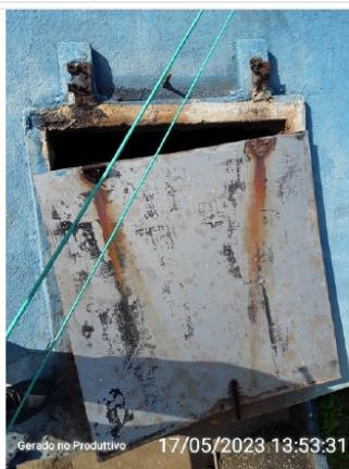
Tampas de inspeção solta
