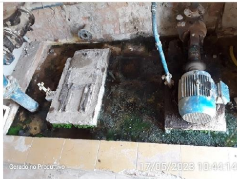
Lodo acumulado por falta de drenagem
