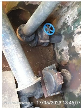
Válvula de fechamento na saída do reservatório
