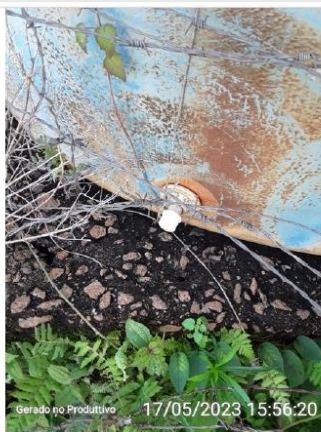
Descarga de fundo
