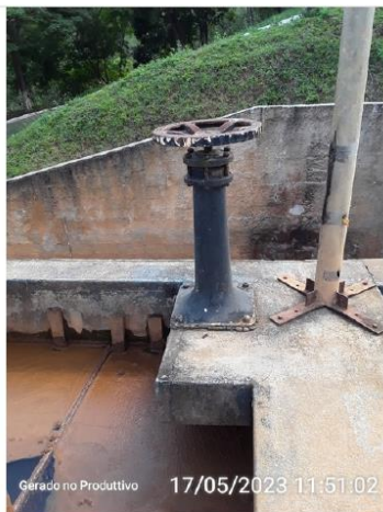
Descarga de floculadores
