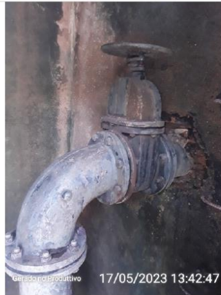
Válvula de fechamento na entrada do reservatório
