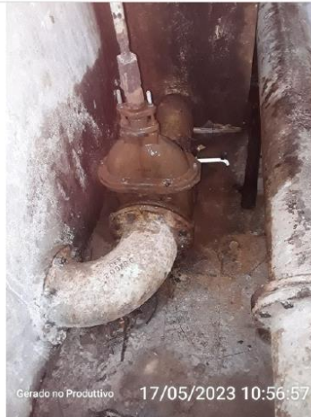
Vazamentos nas válvulas dos filtros
