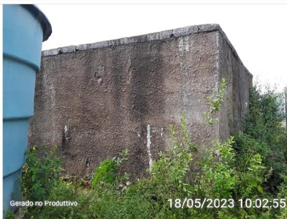
Local necessitando de limpeza
