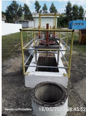
Tratamento preliminar e medição de vazão
