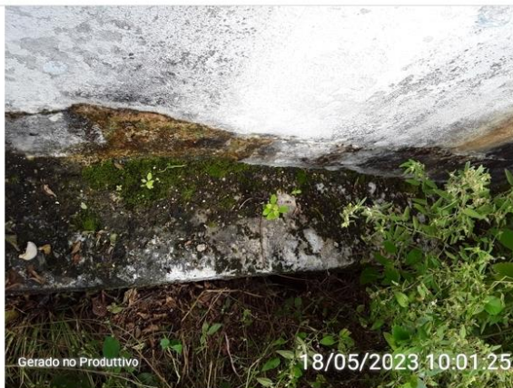
Pontos de infiltrações
