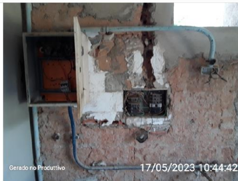
Quadros de comando com quadros abertos e fio exposto
