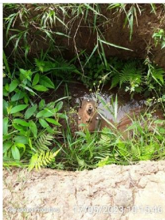
Registro de fechamento na saída do reservatório
