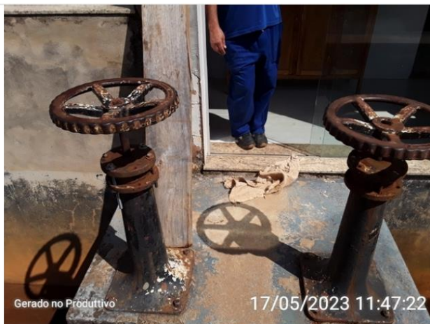
Válvulas de fechamento dos filtros
