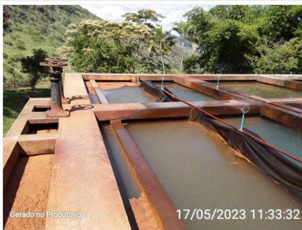
Ausência de guarda-corpos
