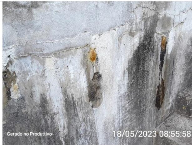
Ponto de infiltração
