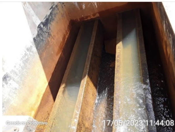
Vista superior dos filtros
