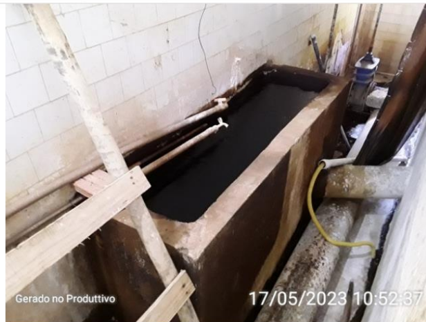
Tanque de contato - interno
