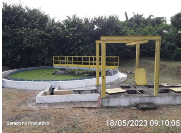
Elevatória e decantador
