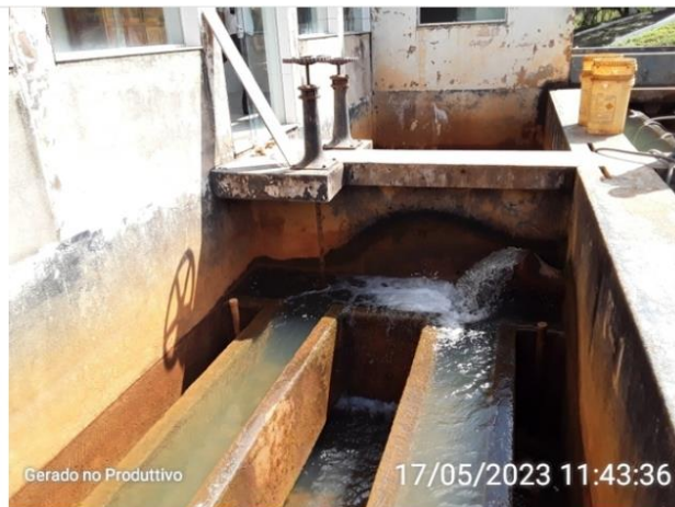
Vista superior dos filtros
