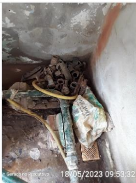
Gerado no Produto 18/05/2023 09:53:32 EAT utilizada de forma inadequada
