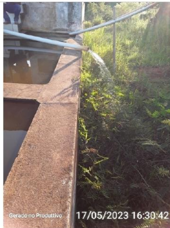
Vazamentos e perdas
