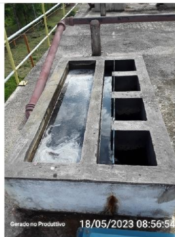
Trinca com vazamento
