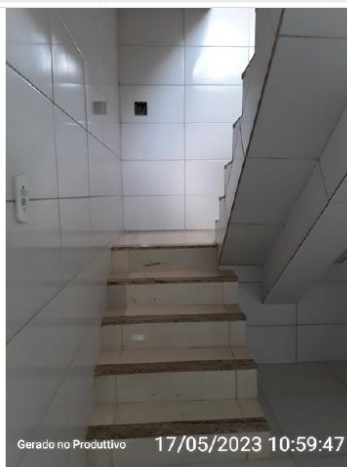
Escadas sem guarda corpos
