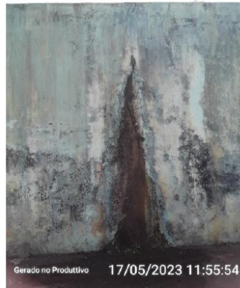
Infiltrações na estrutura do decantador
