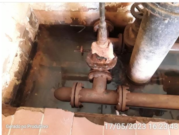
Infiltrações nas válvulas
