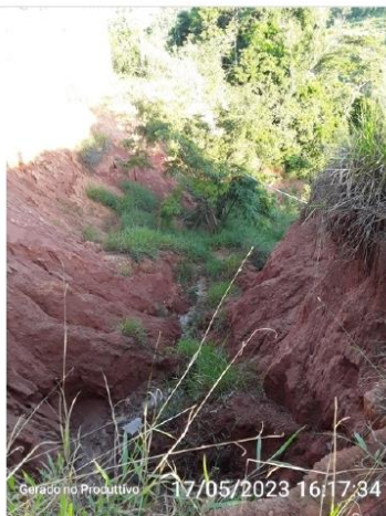
Estrada principal interditada
