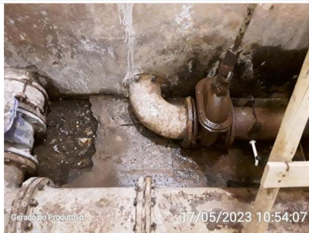
Vazamentos nas válvulas dos filtros
