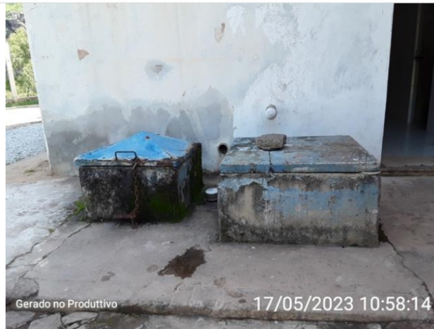
Tanque de contato - externo
