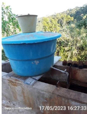
Local de dosagem do coagulante
