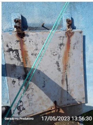
Tampa de inspeção só apoiada
