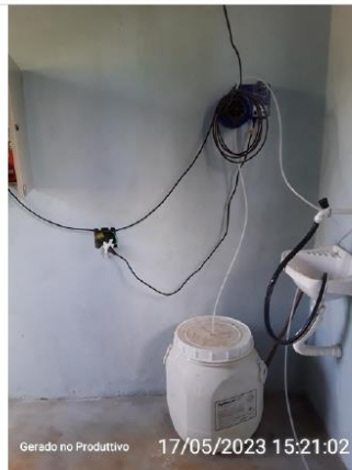
Dosagem e preparo do Cloro
