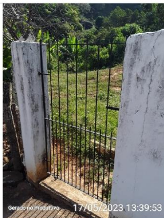
Portão de acesso sem tranca com cadeado
