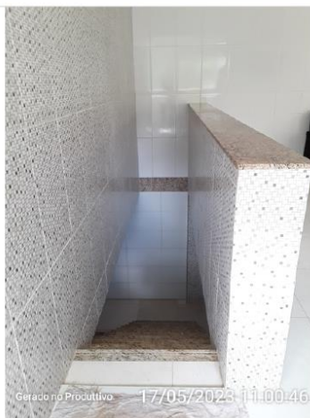
Escadas sem guarda corpos
