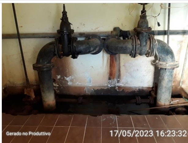
Infiltrações nas válvulas
