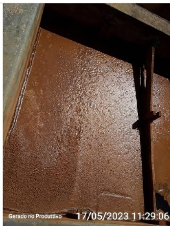
Floculadores com flotação
