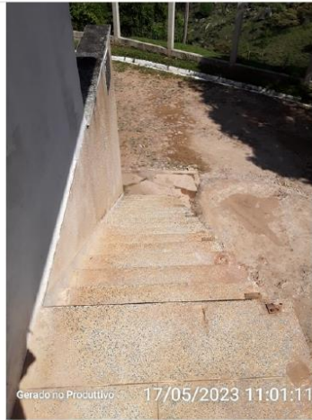
Escada de acesso sem guarda corpos
