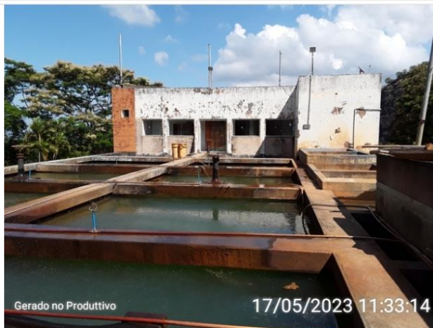
Ausência de guarda-corpos
