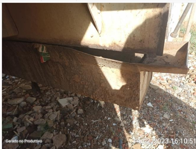
Calha coletora de chorume
