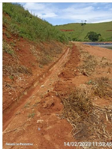
Sistema de drenagem
