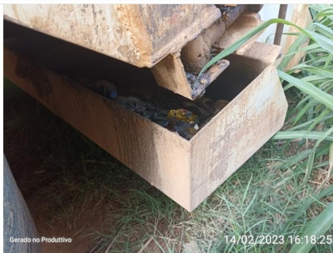
Calha coletora de Chorume
