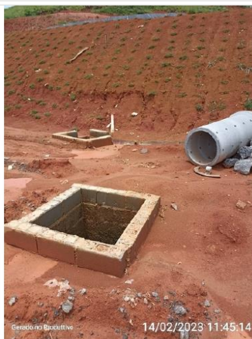
Sistema de drenagem
