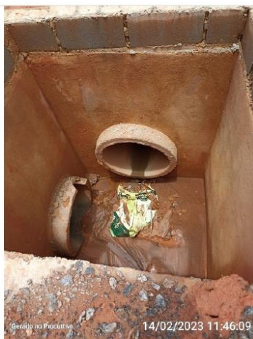
Sistema de drenagem
