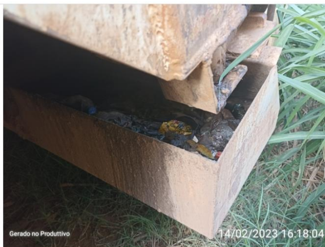
Calha coletora de Chorume
