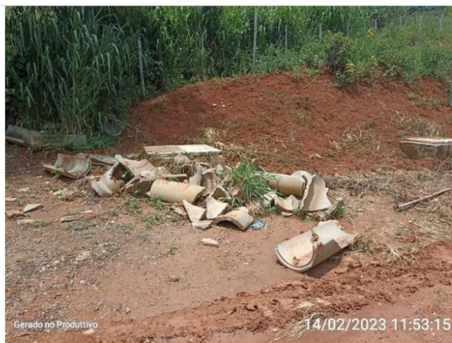
Sistema de drenagem danificado
