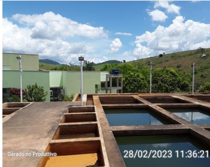
Refletores na ETA
