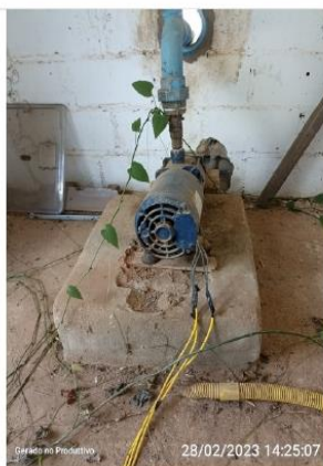
Emenda de cabos expostas
