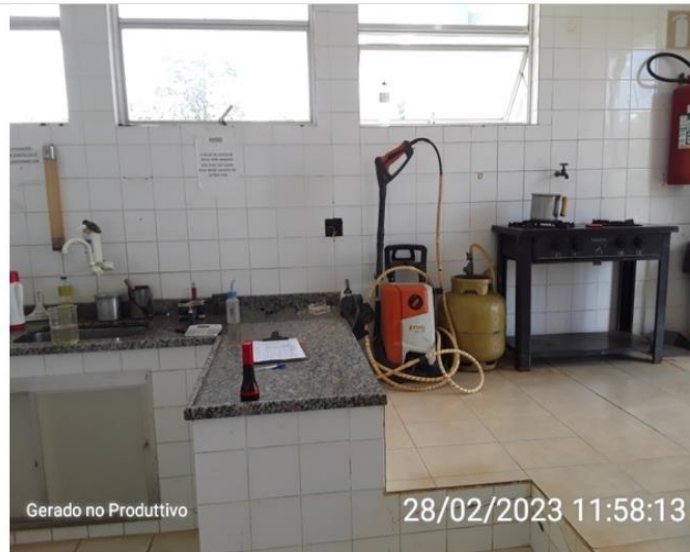
Falta divisória entre laboratório e cozinha
