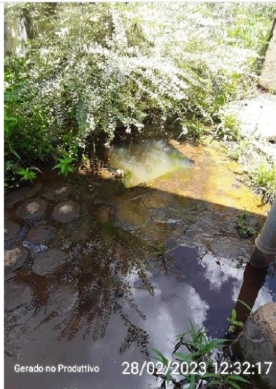
Registro com vazamento
