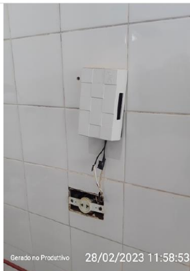
Falta manutenção elétrica
