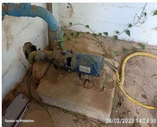
Cabos com emenda exposta na alimentação da bomba.
