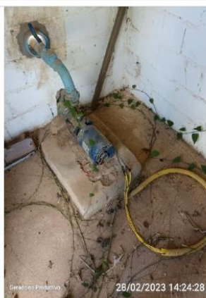
Cabos com emenda exposta na alimentação da bomba.
