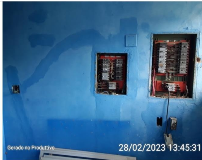
Quadros precisando de manutenção
