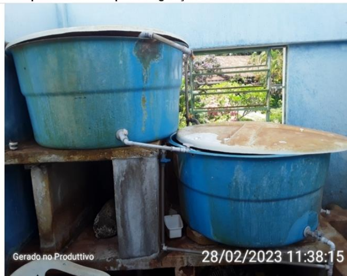
Reservatório de sulfato de alumínio
