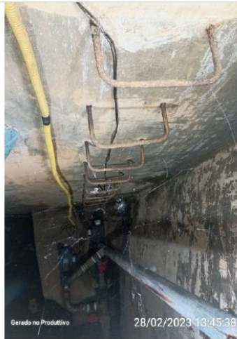
Escada sem componente de segurança
