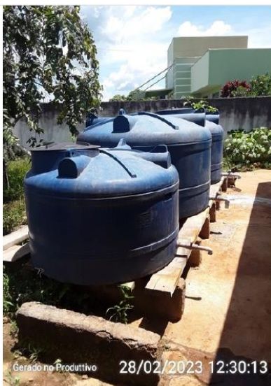
Reservatório de sulfato
