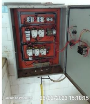
Cabos desorganizados no quadro de comando
