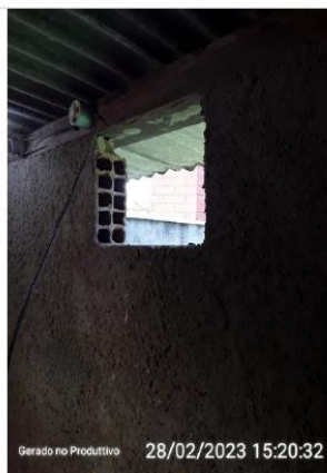
Abertura para circulação de ar
