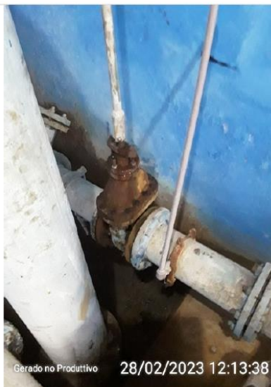
Registro com vazamento
