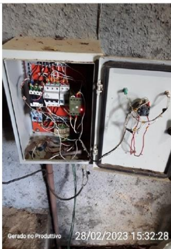
Sobras de cabos mal distribuída dentro do quadro
