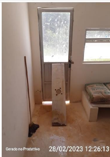
Porta de acesso à casa de química escorada
