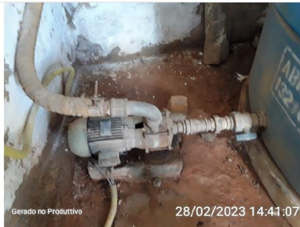
Bomba da EEAT
