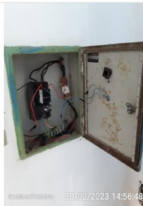
Sobras de fiação em excesso e desorganizado dentro do quadro de comando.
