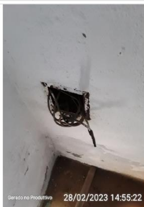
Caixa de passagem com fiação exposta
