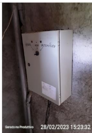
Quadro de comando - Externo
