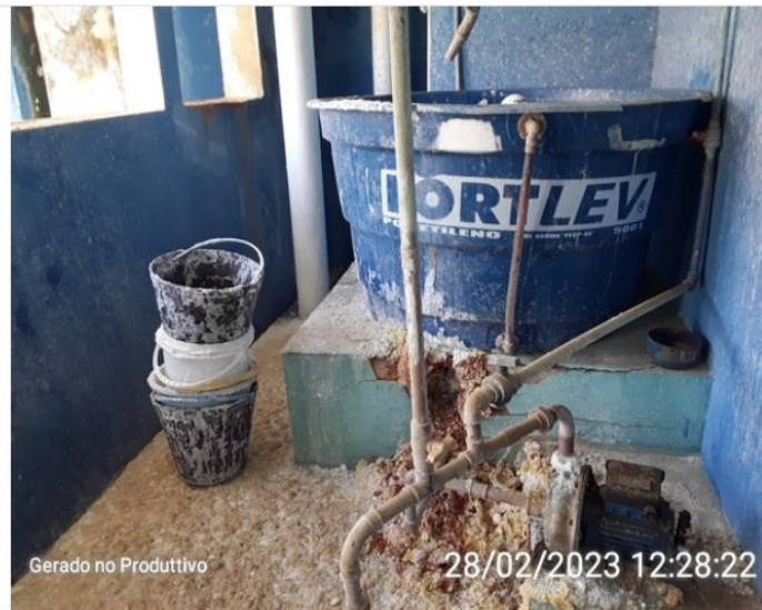
Baldes utilizados na dosagem de sulfato
