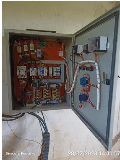
Quadro de comando - interno
