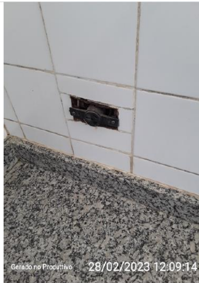
Tomada sem capa de proteção
