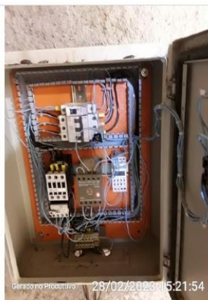
Quadro de comando - Interno
