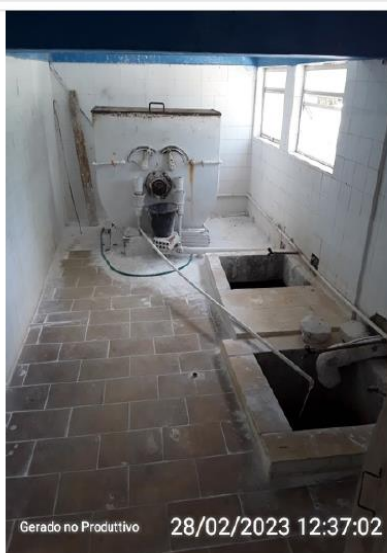
Espaço tanque de contato
