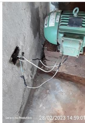
Fiação de alimentação da bomba exposta
