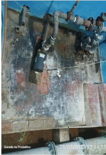
Inexistência de ralo para drenagem
