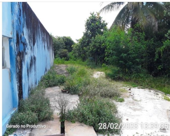
Espaço precisando de manutenção
