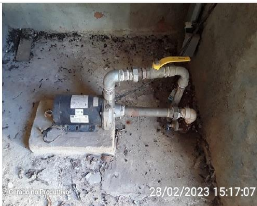
Bomba da EEAT
