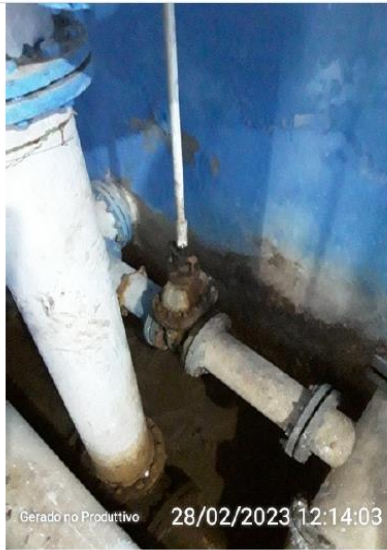
Registro com vazamento
