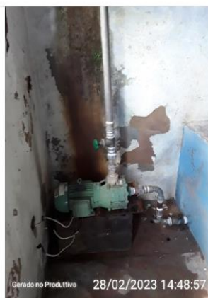
Bomba da EEAT
