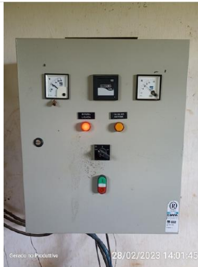
Quadro de comando
