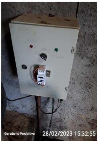
Quadro de comando
