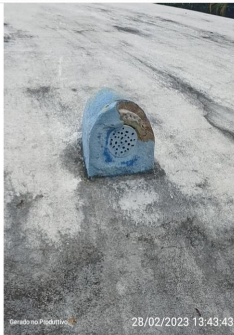
Ventilação do reservatório
