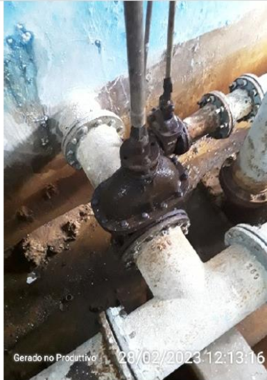
Registro com vazamento
