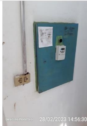
Quadro de comando - Externo
