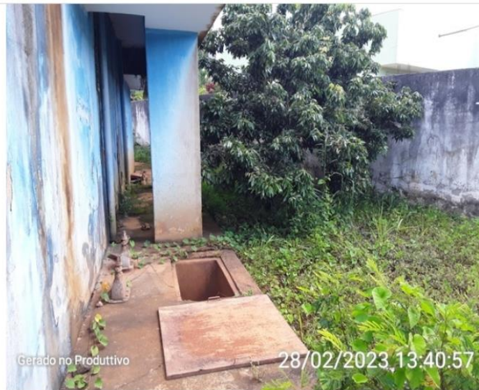
Espaço precisando de manutenção
