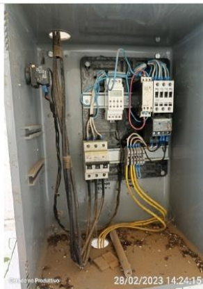
Quadro de comando - Interno
