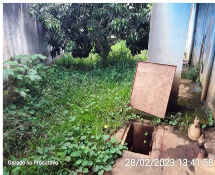
Espaço precisando de manutenção
