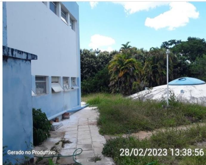
Espaço precisando de manutenção
