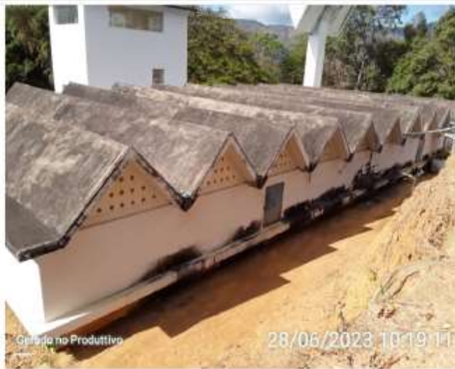
Tanque de contato
