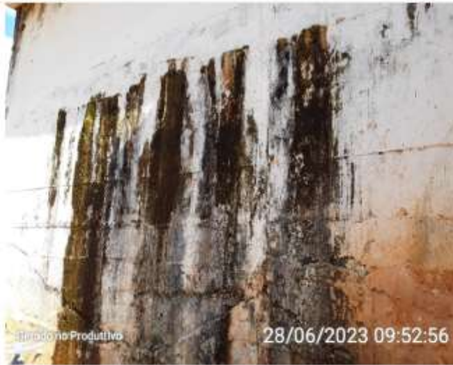
Infiltrações no decantador - Sistema Circular
