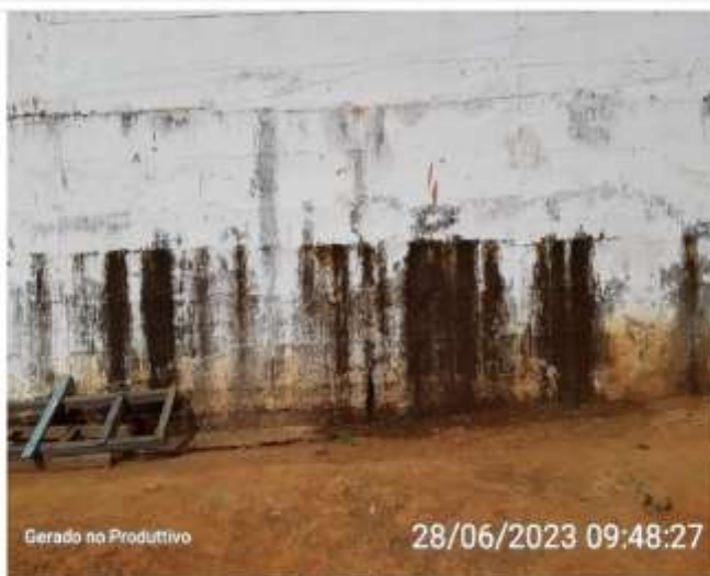
Infiltrações nos decantadores - Sistema retangular
