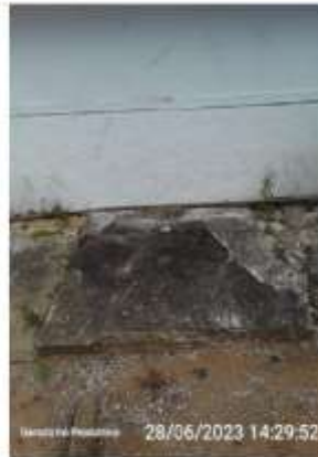
Caixa de descarga
