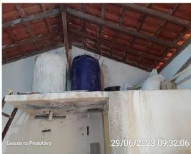
Local de preparo dos produtos químicos
