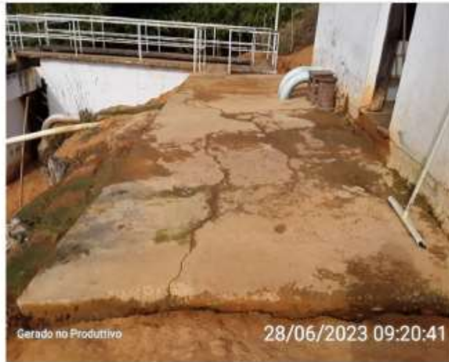
Local sem guarda corpo
