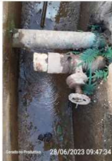
Descarga do decantador com vazamentos
