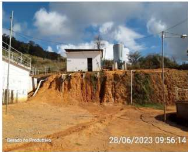
Parte elevada sem guarda corpos
