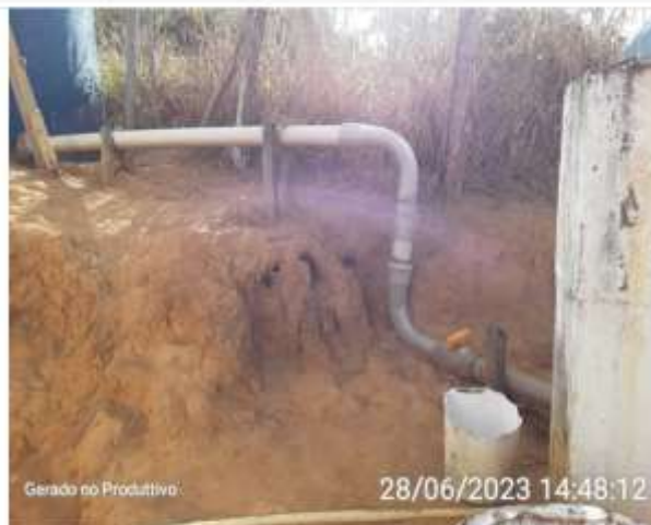
Interligação dos reservatórios
