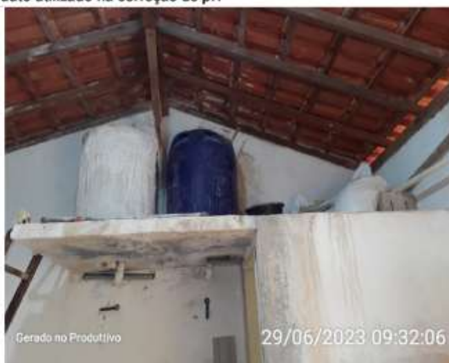
Local de dosagem do cal.
