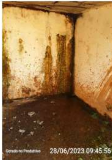
Infiltrações - Sistema circular
