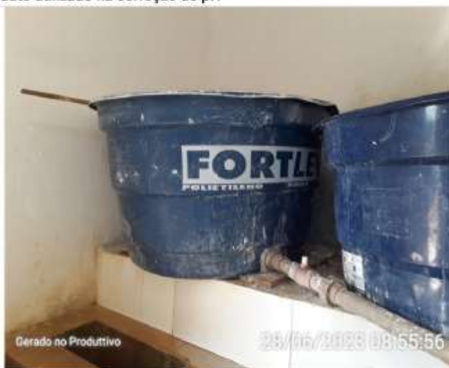
Tanque de preparo do cal
