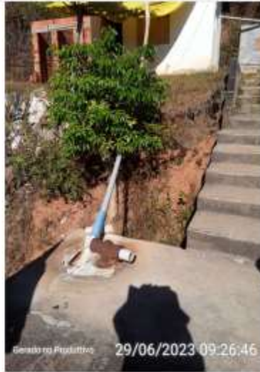
Local de dosagem do cloro
