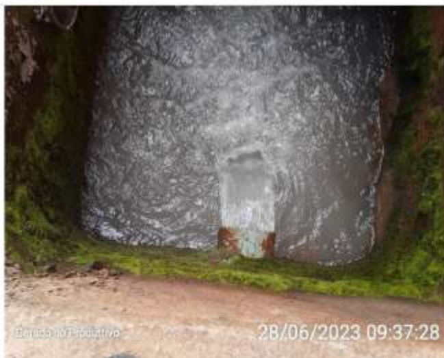
Chegada da água bruta na ETA
