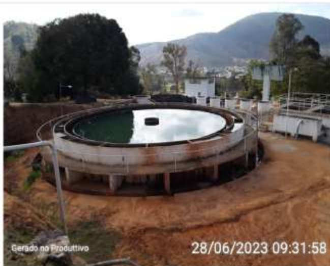
Decantador - Sistema de Circular
