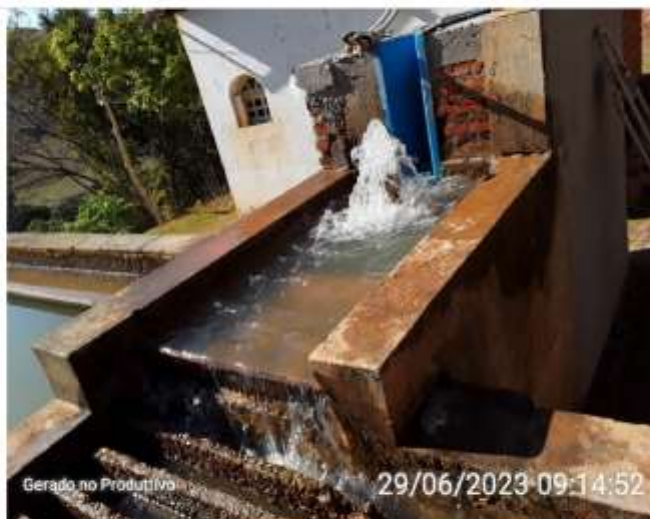
Chegada de água na entrada da ETA.
