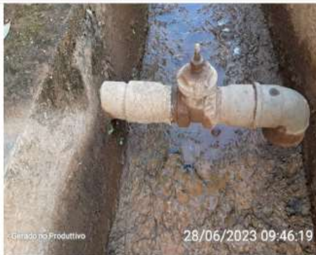
Válvula de descarga do decantador - Sistema Circular
