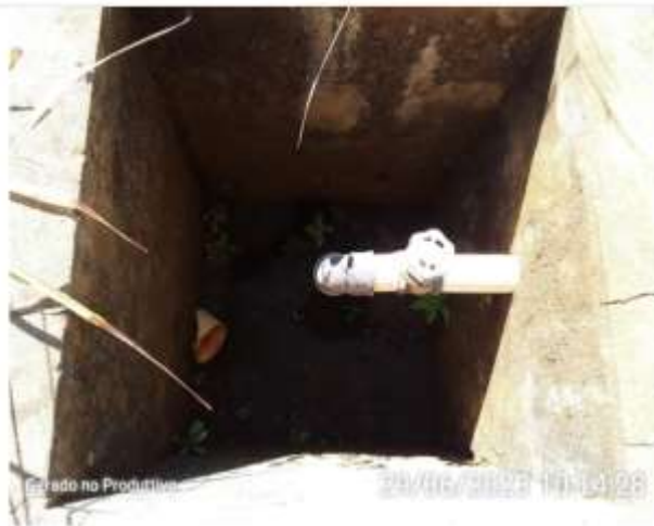
Descarga para tubo extravassor
