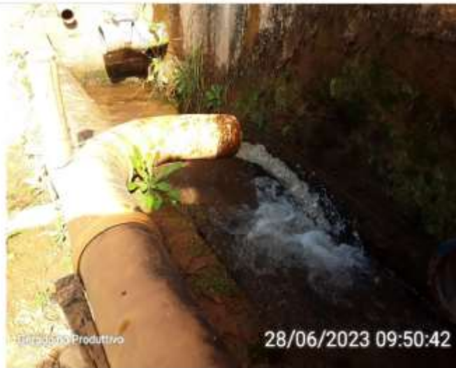
Perda de água bruta por gravidade
