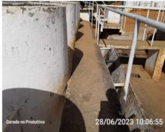
Guarda corpos insuficientes
