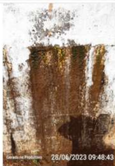
Infiltrações dos decantadores - Sistema retangular
