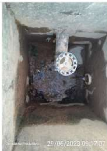
Descarga do decantador com vazamentos.
