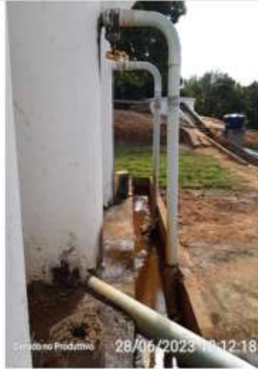
Vazamentos nas válvulas dos filtros - Sistema Circular
