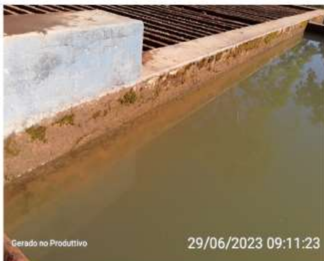
Acúmulo de matéria orgânica nas paredes dos decantadores.
