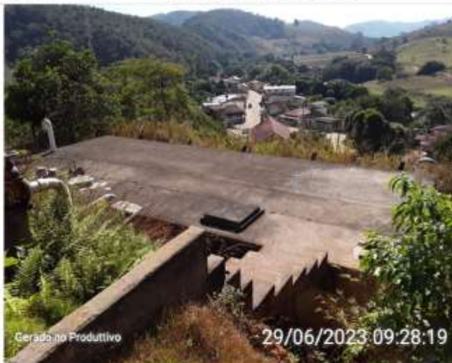
Tanque de contato
