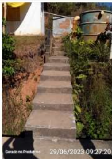
Escadas sem guarda-corpos
