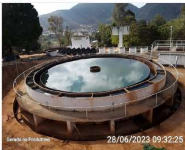
Decantador - Sistema de Circular
