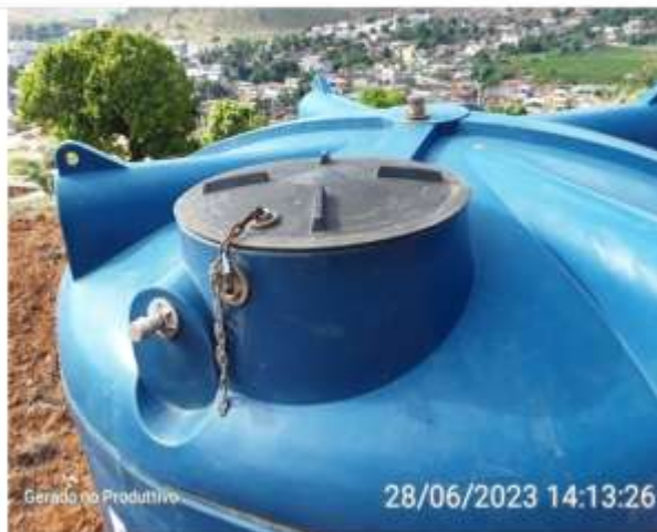
Tampas de inspeção
