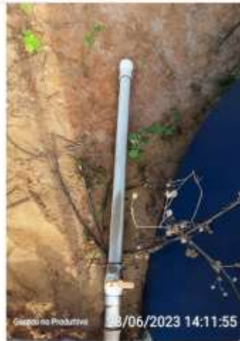
Descarga de fundo
