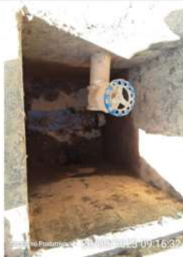
Descarga do decantador com vazamentos
