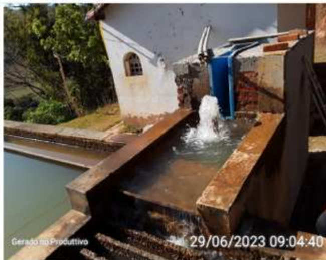
Chegada de água na entrada da ETA.
