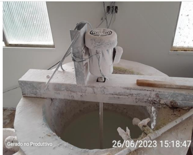
Tanque de preparo - II
