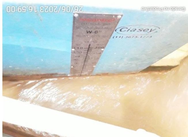
Réguas de medição de vazão
