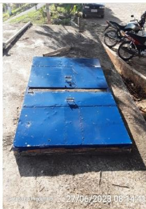
Tampas de inspeção
