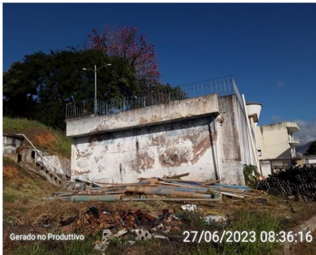
Vista Lateral da ETA
