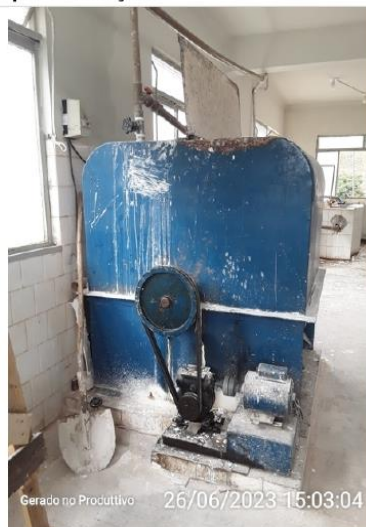
Tanque de preparo do cal
