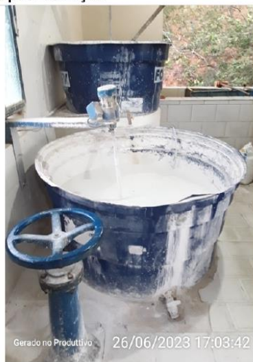
Tanque de preparo do cal
