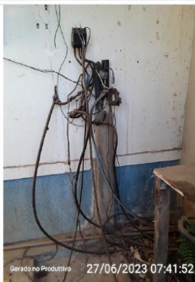
Fios elétricos emaranhados
