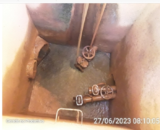
Descarga de fundo
