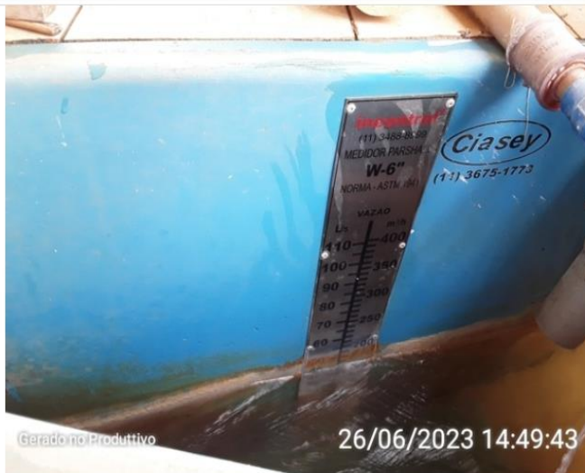
Medidor de vazão
