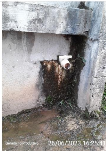
Descarga do floculadores
