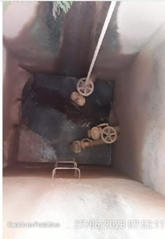
Descarga do reservatório
