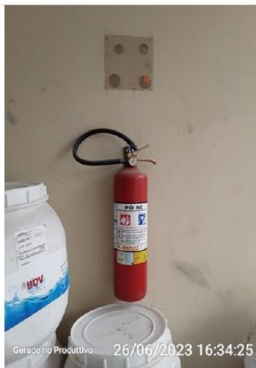
Extintor de incêndio no local
