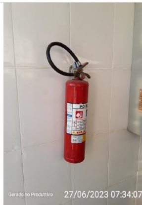
Extintor de incêndio no local
