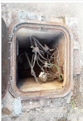
Fios elétricos emaranhados
