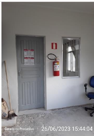
Extintor de incêndio no segundo piso
