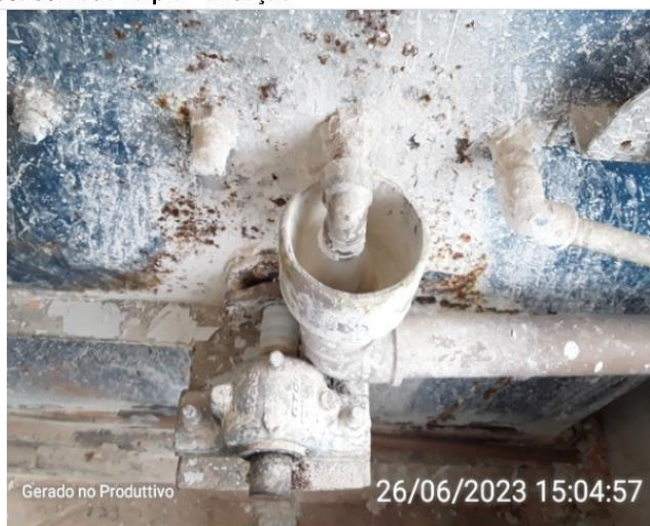
Local de dosagem do produto químico
