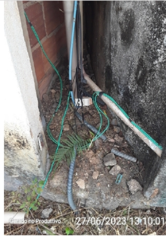
Parte elétrica da EEAT
