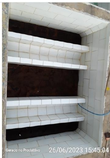
Filtro III - Material Filtrante
