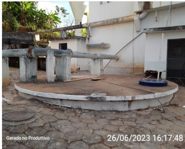
Tanque de contato
