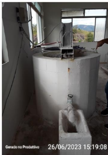
Tanque de preparo - II
