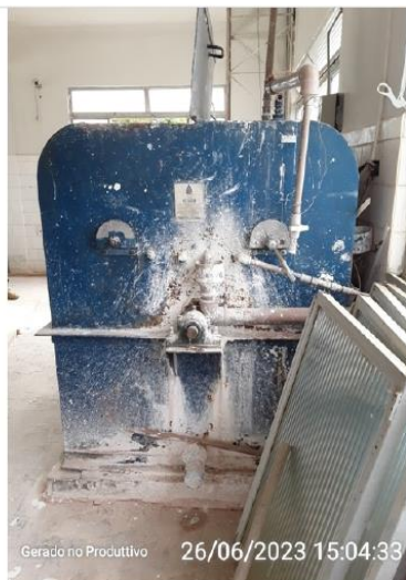
Vista lateral do tanque de preparo do cal
