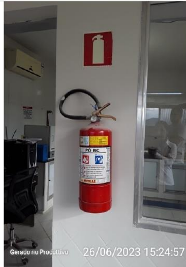
Extintor de incêndio no segundo piso
