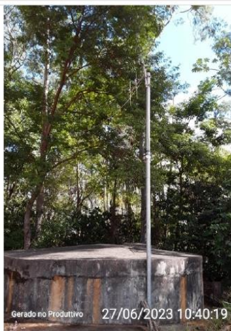
Antena de acionamento da boia de nível
