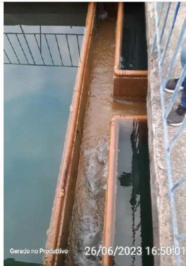
Calha de passagem de água para os filtros
