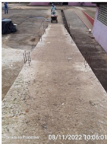
Rampa de acesso sem guarda corpo
