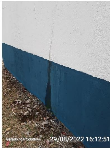
Infiltração na estrutura
