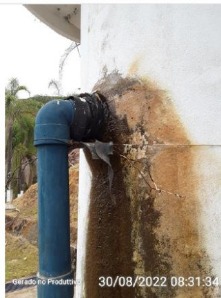
Tubulação de descarga dos filtros
