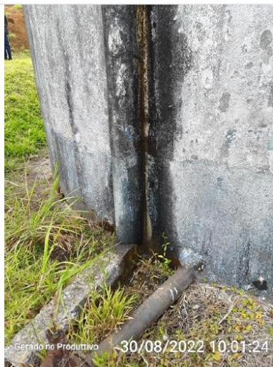
Infiltração na estrutura do reservatório
