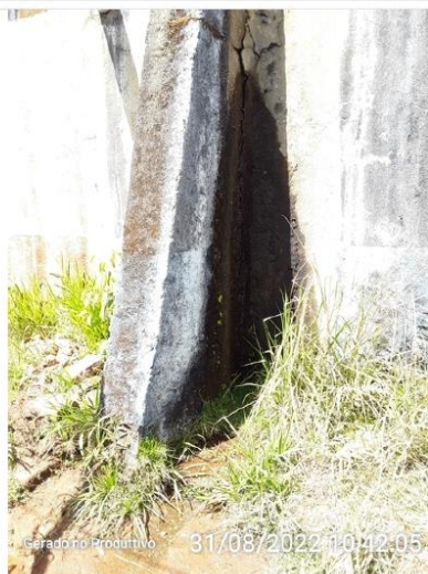
Vazamento na estrutura
