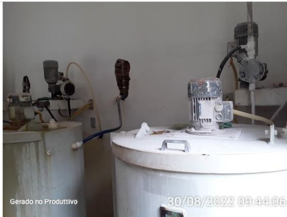
Tanques de agitação
