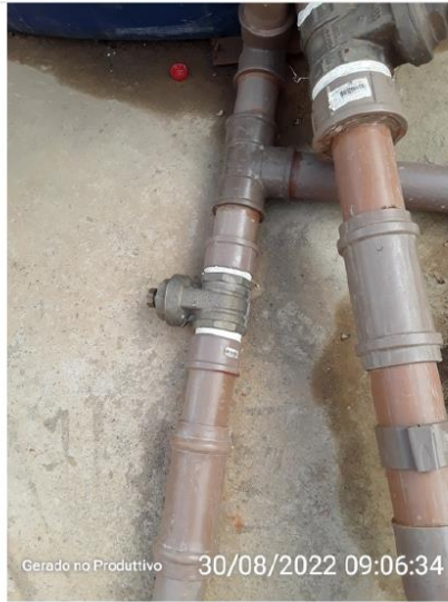
Válvula de fechamento na entrada do reservatório
