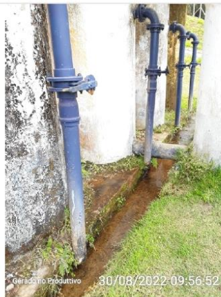
Registros de descarga dos filtros.
