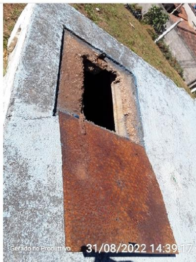
Tampas de inspeção
