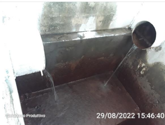
Vazamento dos registros dos filtros
