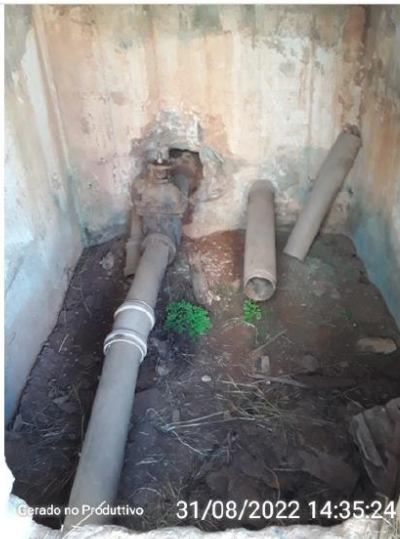
Válvula de fechamento na saída do reservatório
