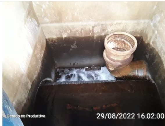
Caixa de passagem
