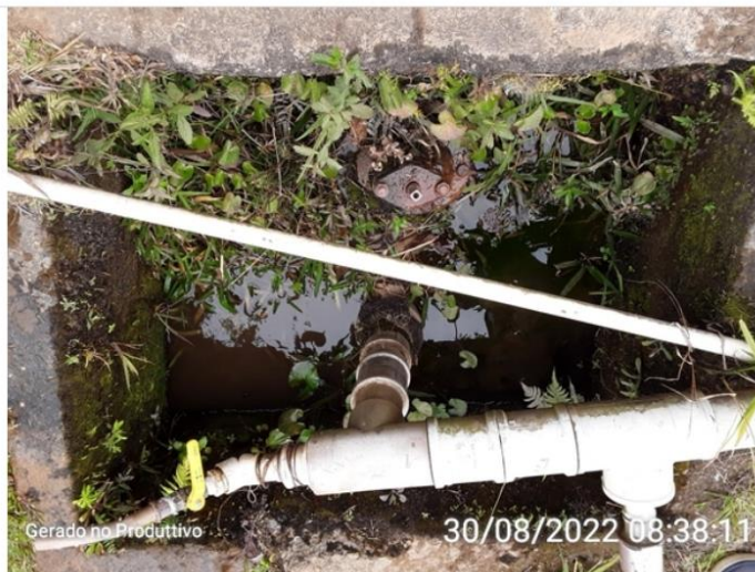
Válvula de fechamento na saída do reservatório
