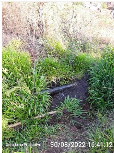
Furo na tubulação
