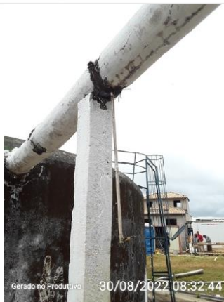
Tubulação entre os filtros e reservatórios
