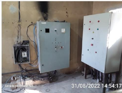
Quadros e cabos elétricos
