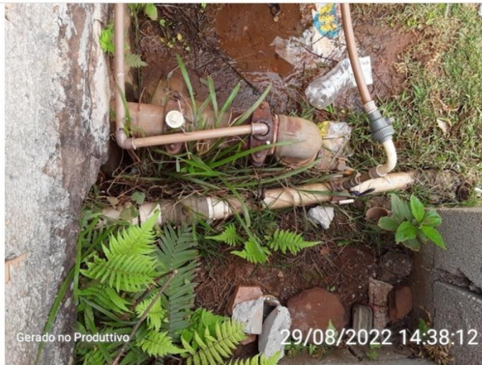
Válvula de fechamento na entrada do reservatório
