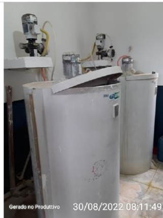
Tanques de agitação
