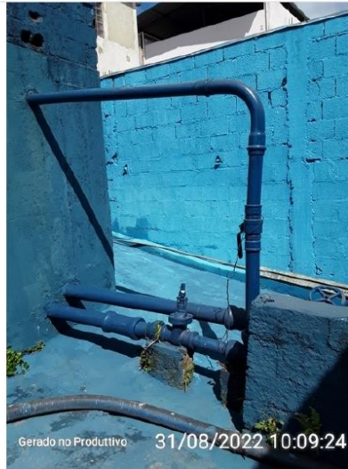
Válvula de fechamento na saída do reservatório
