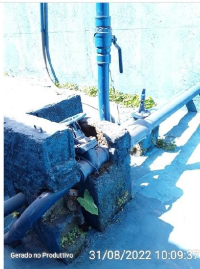
Válvula de fechamento na saída do reservatório
