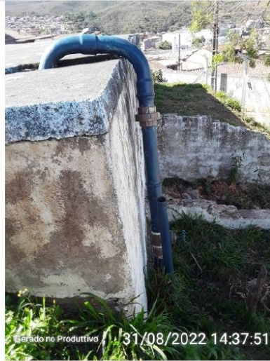
Válvula de fechamento na entrada do reservatório
