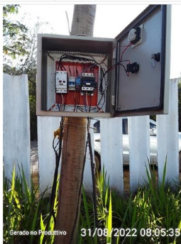
Quadros e cabos elétricos
