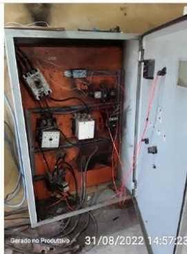
Quadros e cabos elétricos
