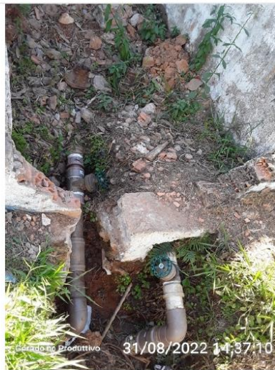
Válvula de fechamento na saída do reservatório
