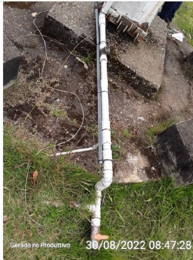
Válvula de fechamento na saída do reservatório
