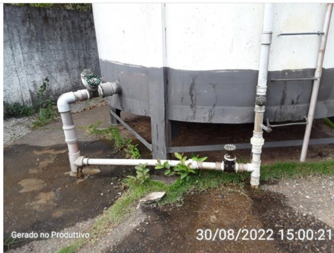
Válvula de fechamento na saída do reservatório
