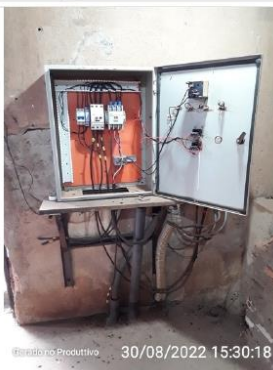
Quadros e cabos elétricos
