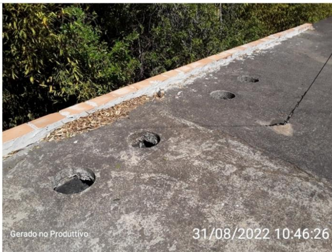
Tubulações de ventilação
