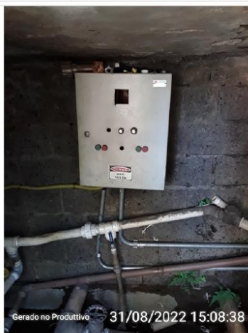
Quadros e cabos elétricos
