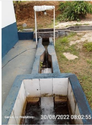
Calha parshall e macromedidor
