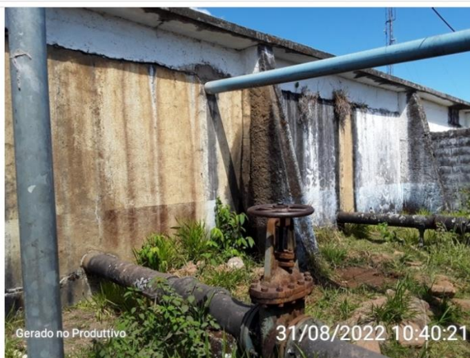
Infiltração na estrutura do reservatório
