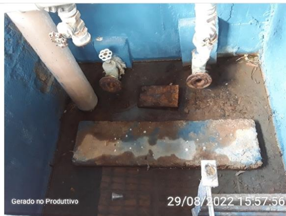
Vazamento no registro do tanque de contato
