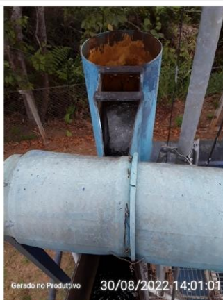
Abrigo do macromedidor
