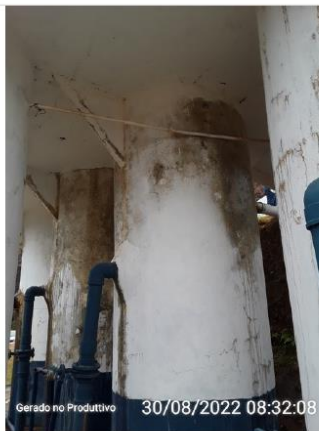
Tubulação de descarga dos filtros
