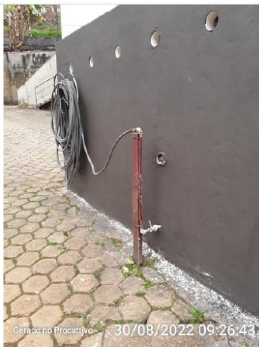
Torneira de água bruta
