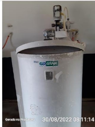
Tanques de agitação
