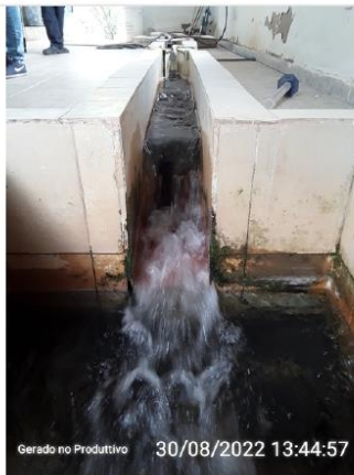
Trecho onde ocorre a dosagem do coagulante
