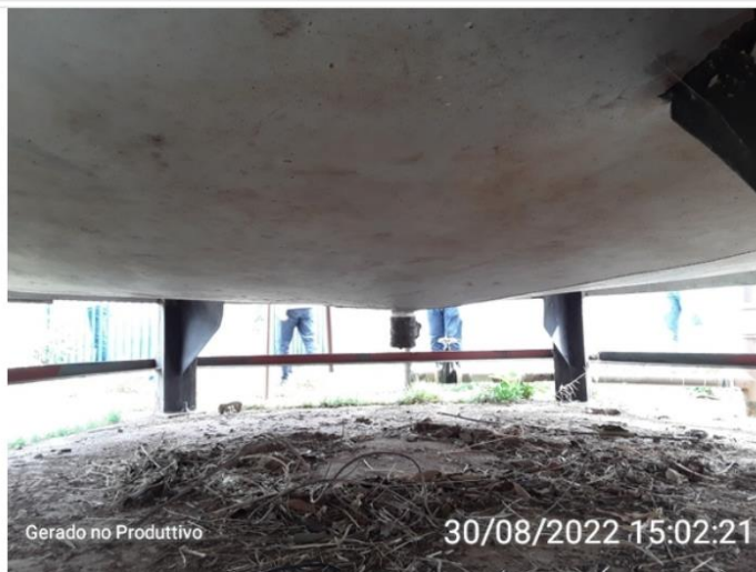
Tubo de descarga de fundo
