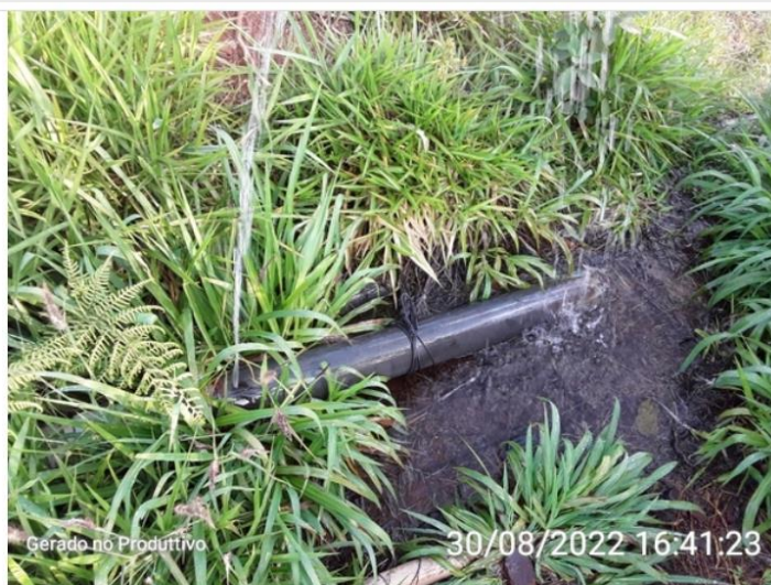
Furo na tubulação
