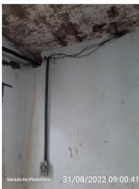
Quadros e cabos elétricos
