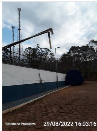
Tubulação para abastecimento dos caminhões pipas
