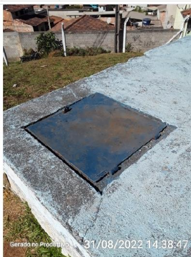
Tampas de inspeção
