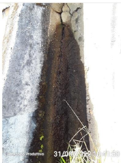
Vazamento na estrutura
