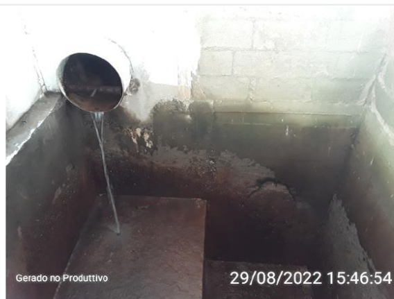
Vazamento dos registros dos filtros
