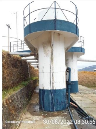
Estrutura dos filtros
