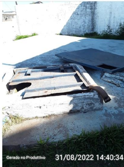
Tampas de inspeção
