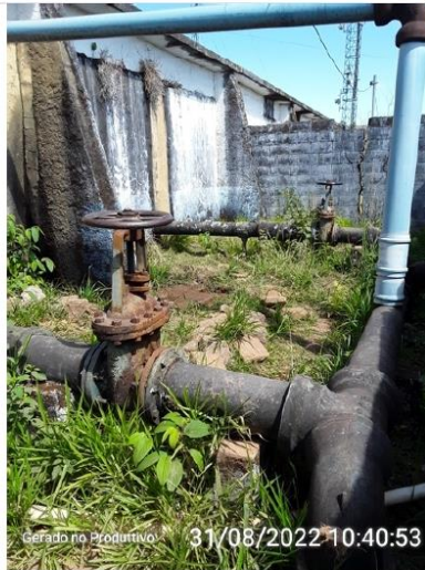
Válvula de fechamento na saída do reservatório
