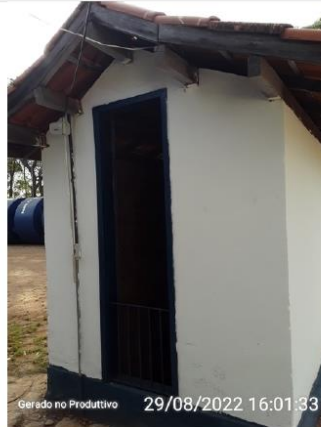
Caixa de passagem
