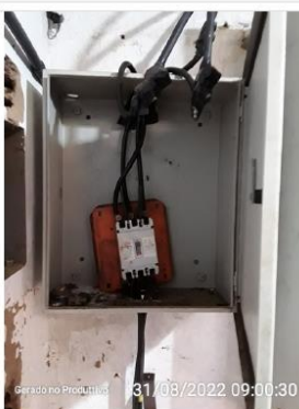
Quadros e cabos elétricos
