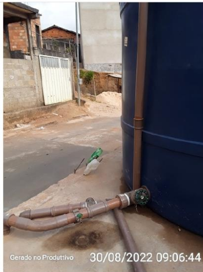
Válvula de fechamento na saída do reservatório
