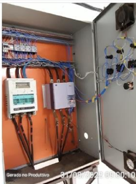
Quadros e cabos elétricos
