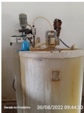
Tanques de agitação
