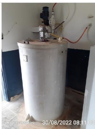
Tanques de agitação
