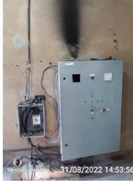
quadros e cabos elétricos
