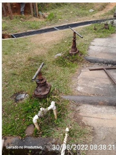
Válvula de fechamento na saída do reservatório
