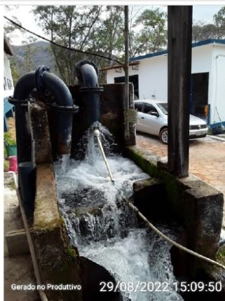
vertedouro retangular e medidor de vazão Ultrassônico
