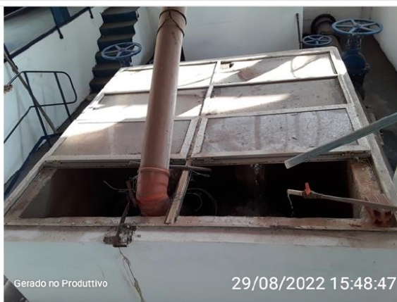
Tanque de contato
