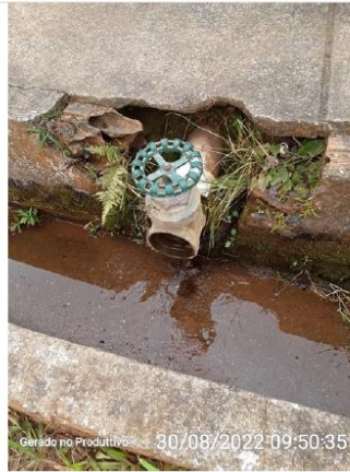
Registro do decantador
