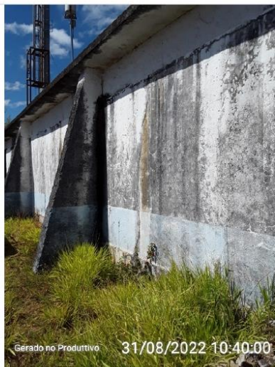
Infiltração na estrutura do reservatório
