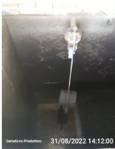
Tampas de inspeção
