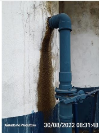
Tubulação de descarga dos filtros
