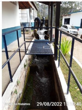
Entrada da água bruta
