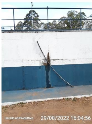
Infiltração na estrutura da ETA
