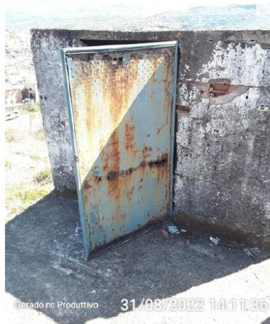
Tampas de inspeção
