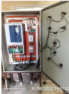
Quadros e cabos elétricos
