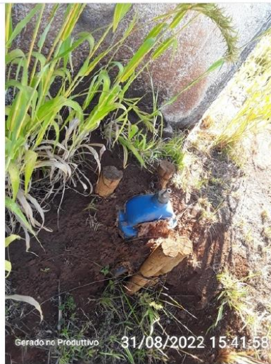
Válvula de fechamento na entrada do reservatório
