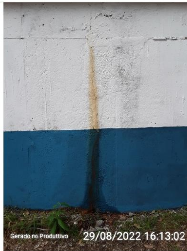
Infiltração na estrutura
