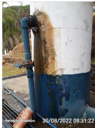
Estrutura dos filtros
