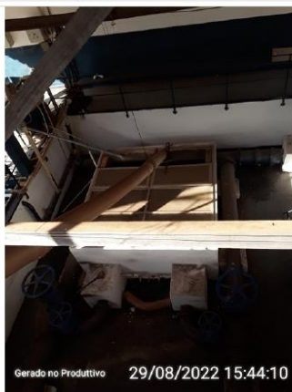
Tanque de contato
