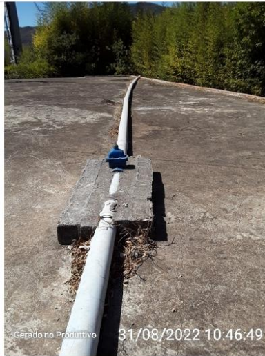
Válvula de fechamento na entrada do reservatório
