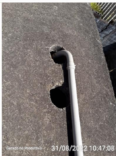
Tubulações de ventilação
