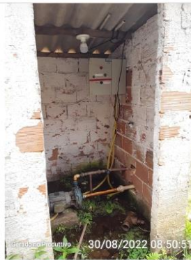
EEAT ETA Santa Rita
