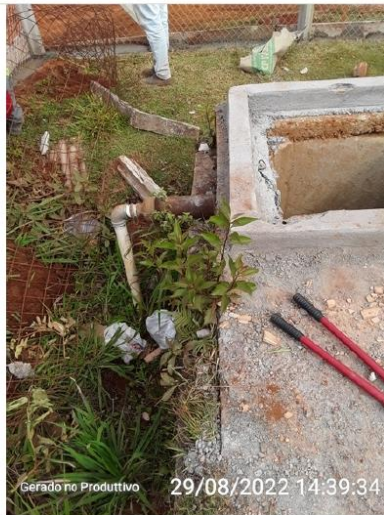
Válvula de fechamento na saída do reservatório
