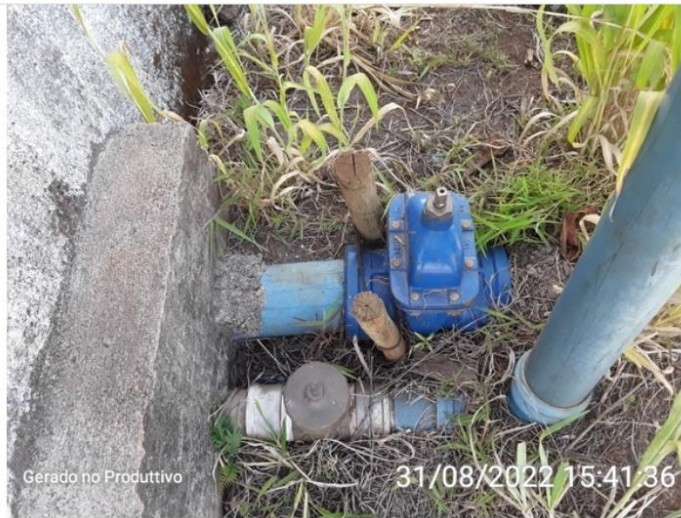
Válvula de fechamento na entrada do reservatório
