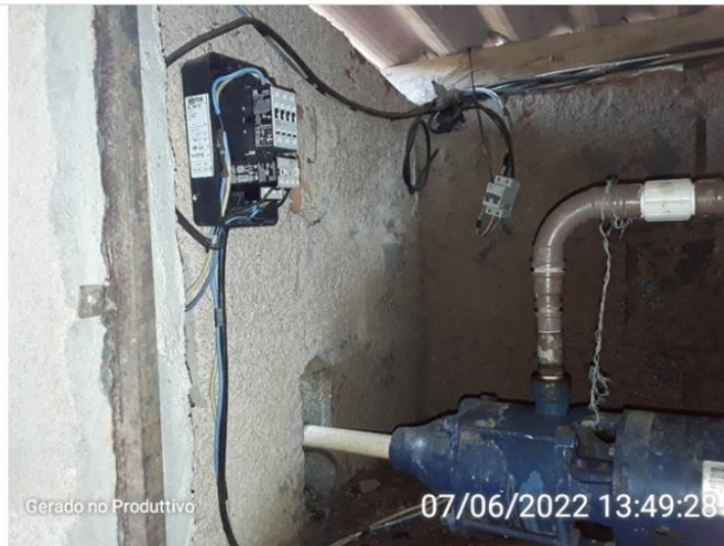
Cabos elétricos sem painel de controle.
