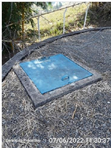
Tampas de inspeção
