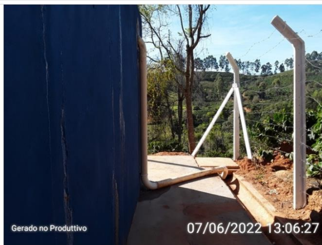
Caixa de descarga de fundo.
