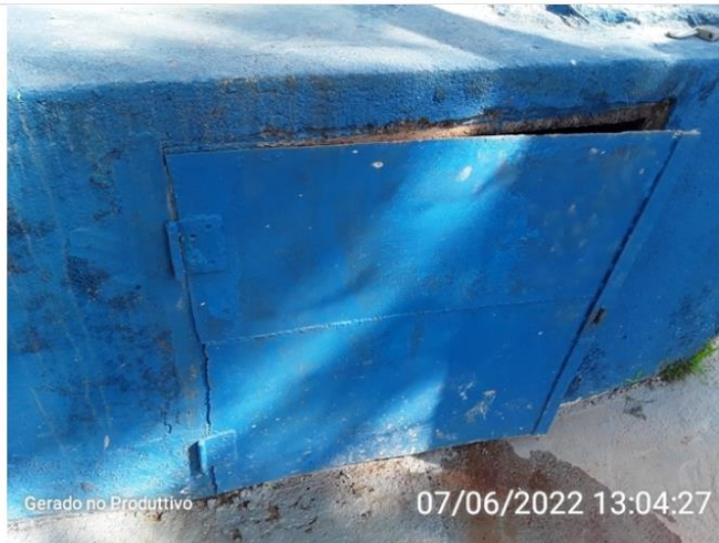
Local com porta de acesso as válvulas.
