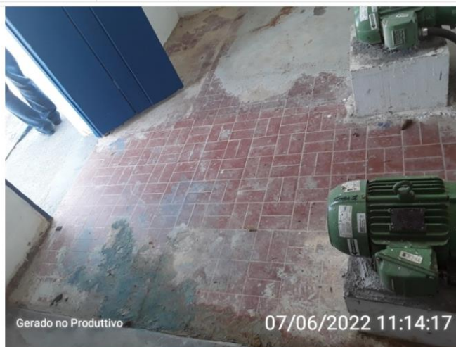
Piso impermeável, porém sem estrutura de drenagem.
