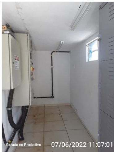
Estrutura elétrica adequada.
