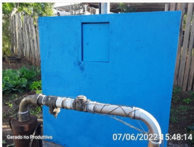
Poste com o painel elétrico da moto-bomba.
