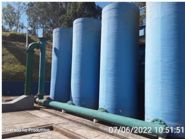
Filtros em boas condições.
