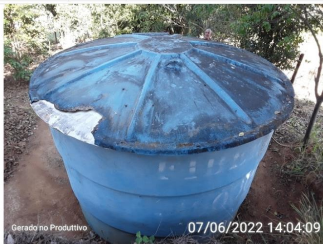
Tampa de inspeção.
