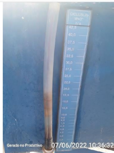
Medidores de vazão.
