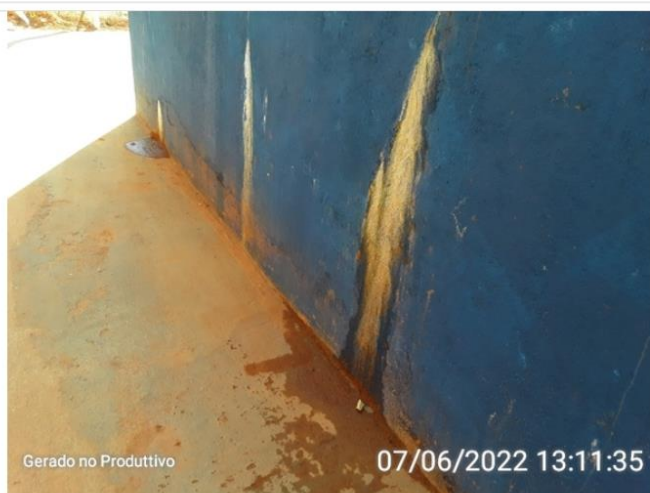
Infiltrações nas paredes laterais do reservatório.
