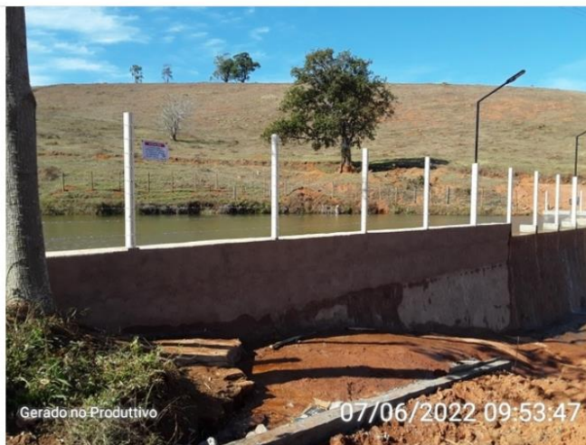
Barragem de captação de água bruta.
