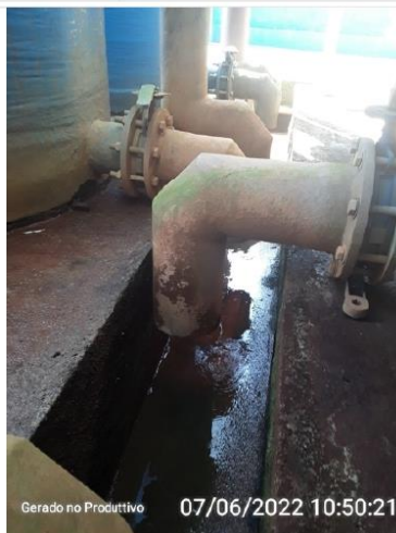
Vazamentos no decantador.
