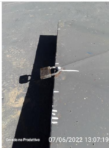
Cadeado usado para proteger a tampa de inspeção.
