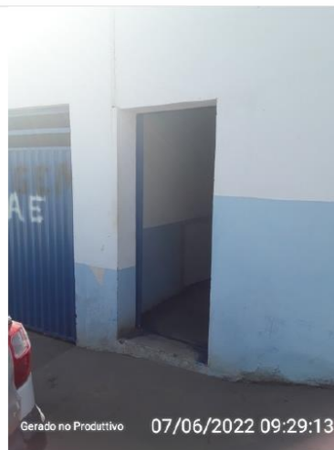
Porta sem a rampa de acesso a recepção.
