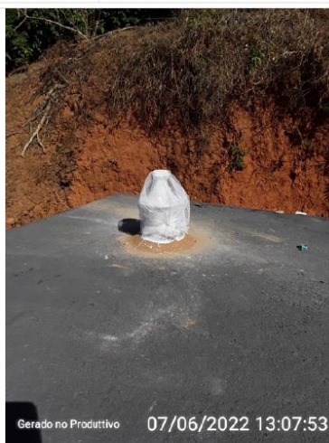
Dispositivo com ventilação e telas de proteção.
