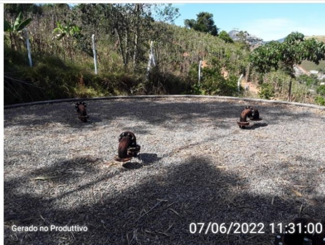
Tubos de ventilação.
