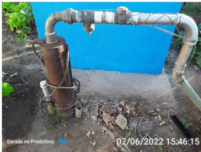
Ausência de laje sanitária no local do poço.
