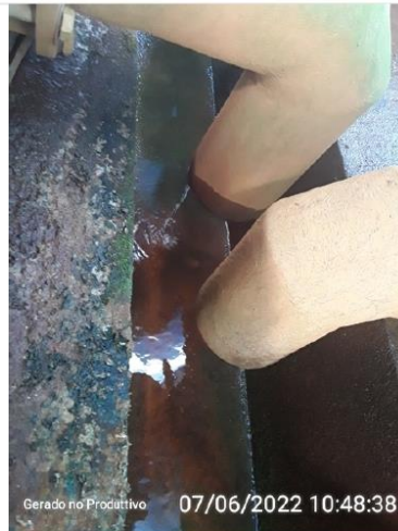
Vazamento de água do decantador
