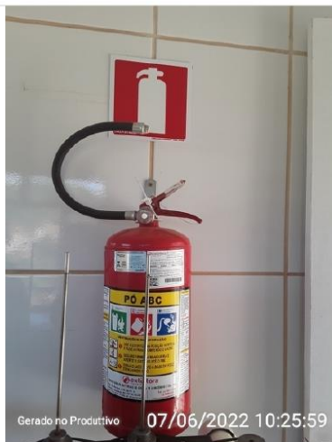
Extintor de incêndio na área do laboratório.
