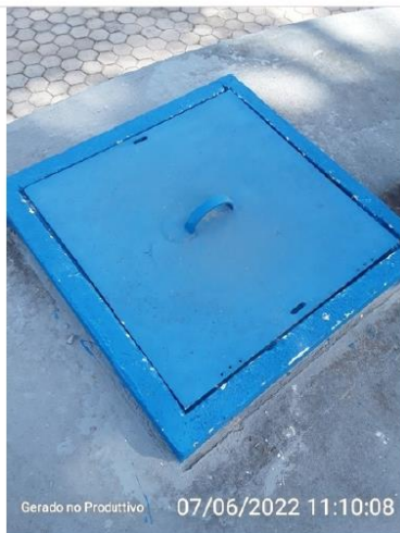
Tampa de inspeção.
