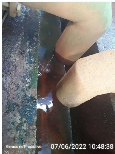
Vazamentos no decantador.
