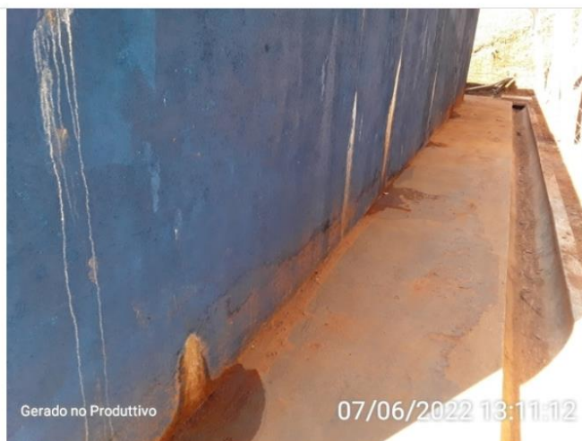
A estrutura apresentou várias fissuras que estão causando infiltrações.
