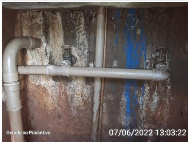
Válvula de fechamento na entrada do reservatório.
