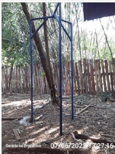
Guindaste para troca de bomba.
