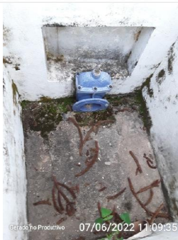
Tubo de descarga de fundo.
