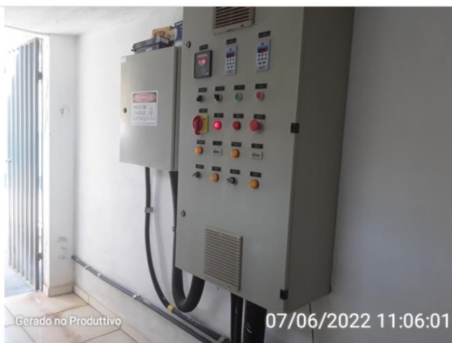
Painéis de controle em bom estado de conservação.
