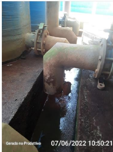
Vazamento no registro do decantador.
