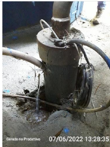
Vazamento de água.
