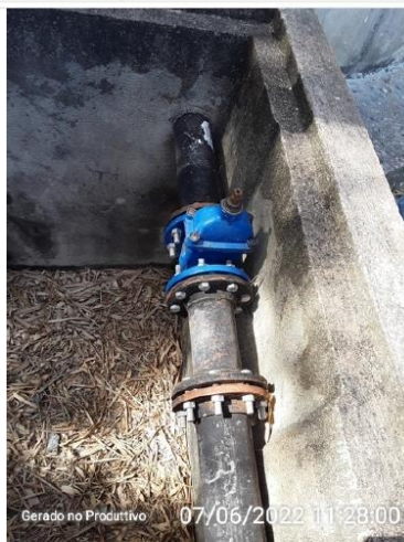
Válvula de fechamento na saída.
