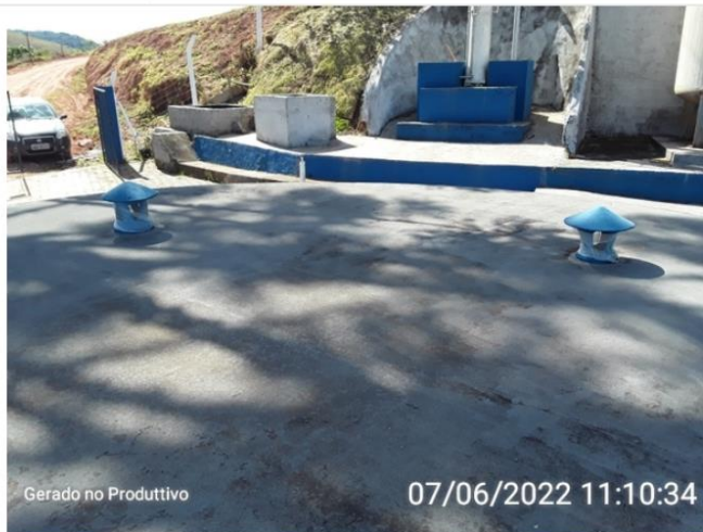
Tubos de ventilação.
