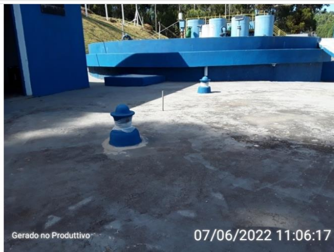
Tubos de ventilação
