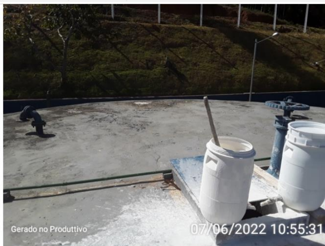
Tanque de contato.
