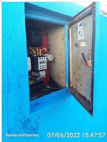
Painel com a parte interna oxidada.
