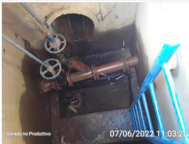
Válvulas de saída do reservatório.
