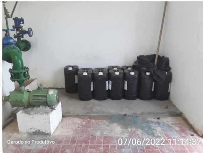
Produto Químico no espaço da casa de bombas.
