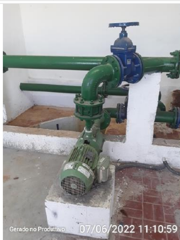
Moto bomba reserva.
