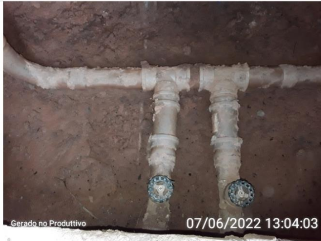
Válvulas de fechamento de entrada.
