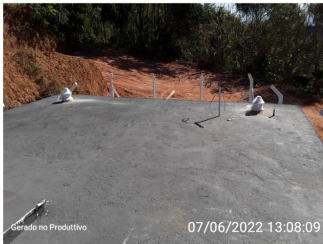
Ventilação do reservatório.
