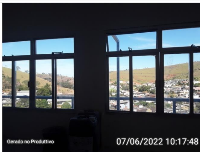
Ventilação na casa de química
