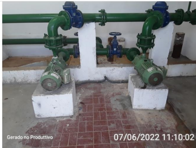
Dimensão permite a manutenção e troca do conjunto motobomba.
