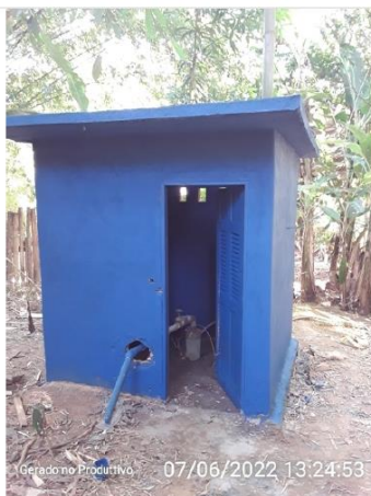
EEAB Poço Pinheiro.
