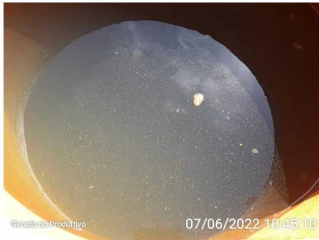
Passagem de flocos para os filtros.
