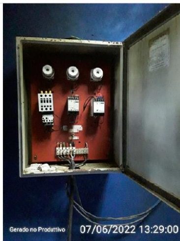
Fios elétricos em bom estado.
