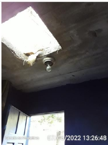
Iluminação noturna não esta funcionando. Apenas tem a iluminação do dia.
