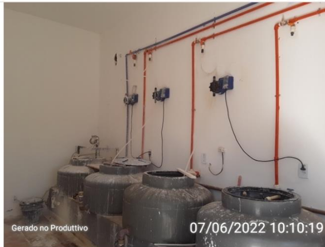
Bombas Dosadoras de produtos químicos.
