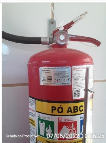
Extintor dentro da validade até o dia da fiscalização.
