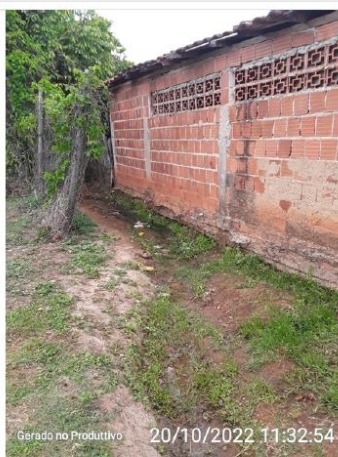
Esgoto a céu aberto
