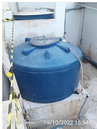
Reservatório do Cloro Gerado
