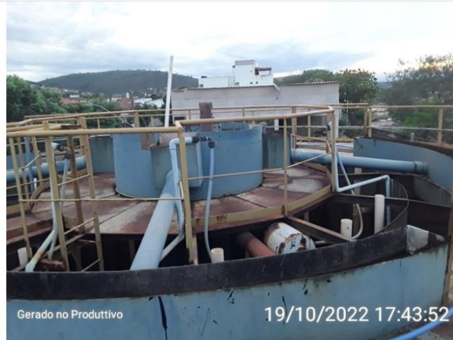
Distribuição do esgoto bruto no Reator UASB
