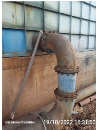
Chegada da água bruta na ETA
