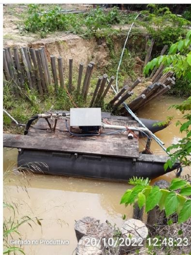
Estação elevatória flutuante
