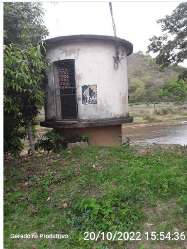
Torre de tomada inoperante
