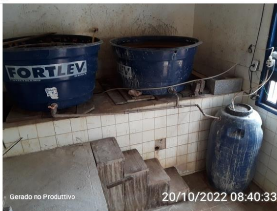
Tanques de preparo de produtos químicos
