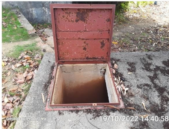
Acesso ao local com vazamentos
