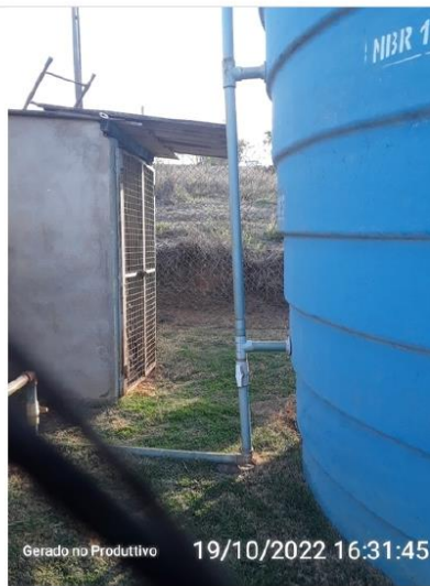
Válvula de fechamento na entrada do reservatório
