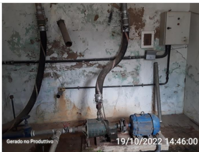
EEAT - Lavagem dos filtros ETA principal
