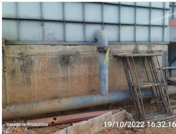
Descarga do decantador
