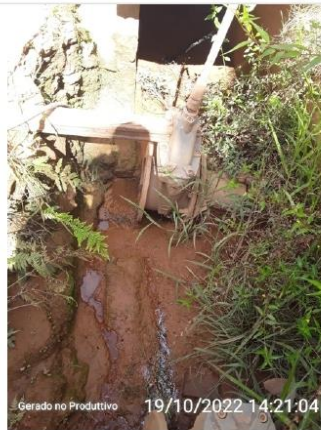
Vazamentos nas válvulas de descarga dos flocladores
