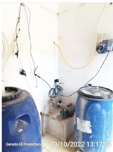
Elevatória Penha do Capim
