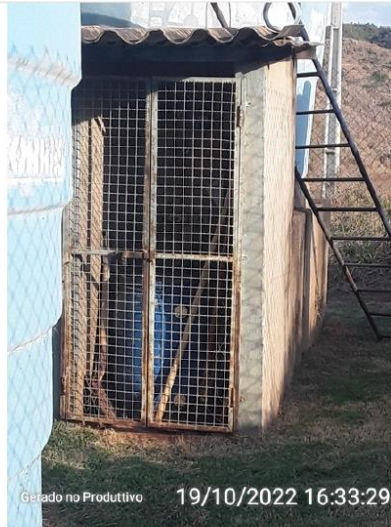
Cloro e bomba dosadora
