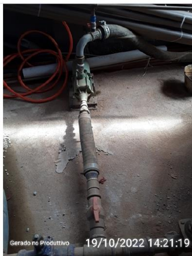
Tubulações da EEAT
