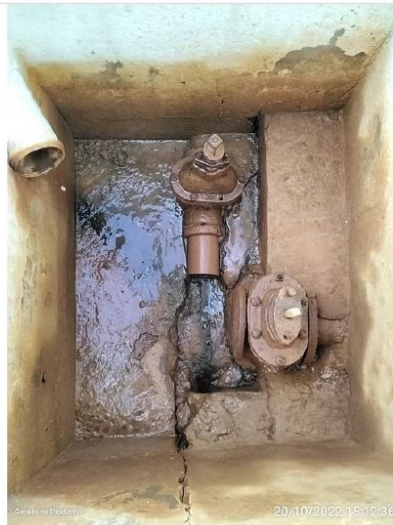
Válvula de fechamento na saída do reservatório
