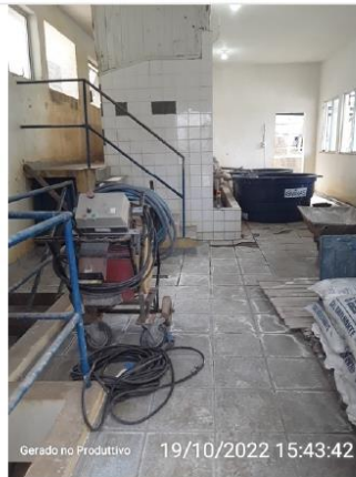
Equipamentos dispersos na casa de químicos
