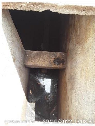
Parte interna da EEE
