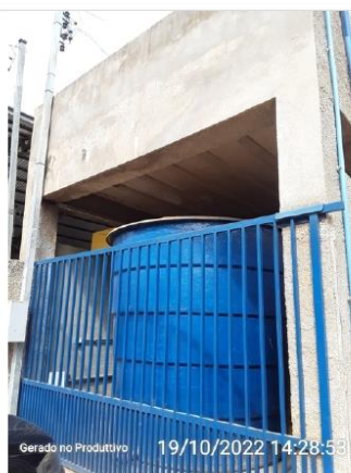
Unidade de tratamento
