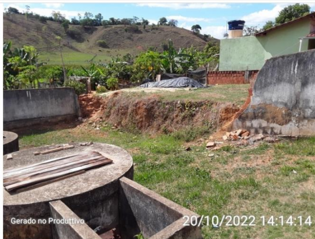
Ausência de cercamento
