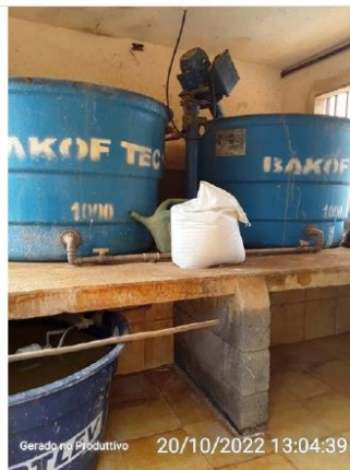
Tanques de preparo
