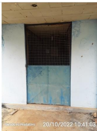
Área de dosagem de hipoclorito de cálcio.
