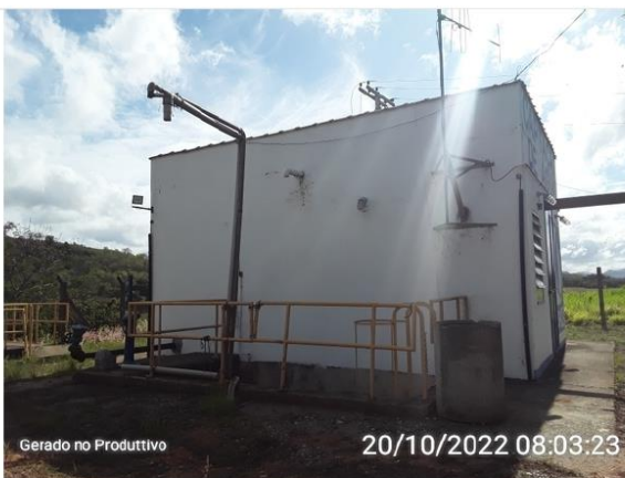
Casa de bombas
