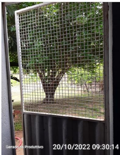
Sistema de ventilação
