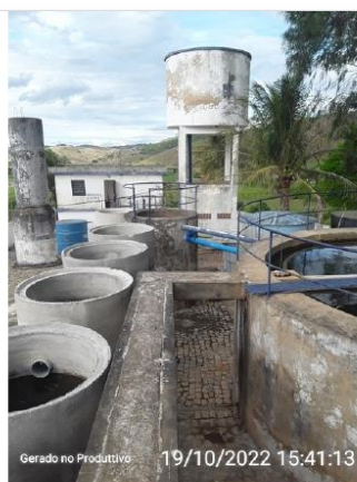
ETA São Sebastião Da Vala
