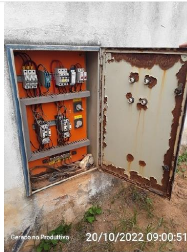
Painel elétrico com muita corrosão
