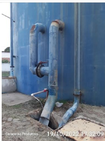
Tubos de saída do efluente tratado
