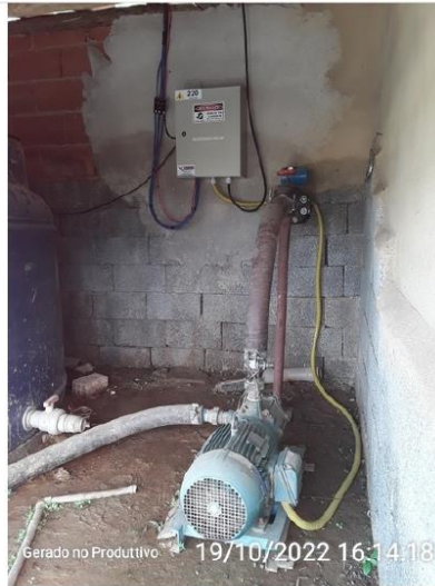
Conjunto motobomba e parte elétrica
