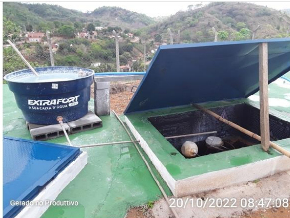
Sistema para dosagem do hipoclorito de cálcio
