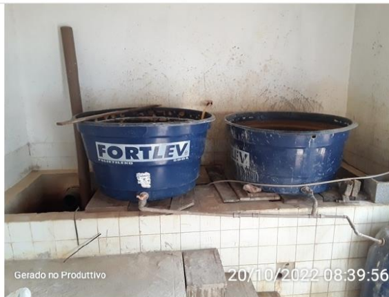
Local da entrada da água bruta
