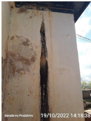
Patologias nas estruturas da ETA
