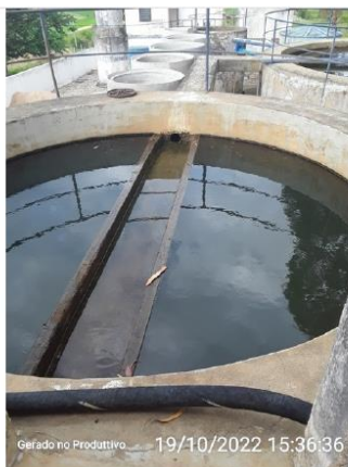
Floculador granular/Pré - filtro
