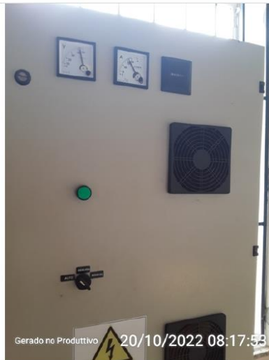
Paínel de comando motobomba III (150 cv)
