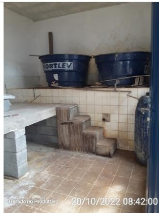
Local da entrada da água bruta
