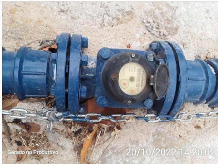
Macromedidor da distribuição alternativa
