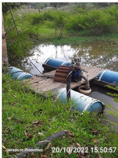
Estação elevatória flutuante
