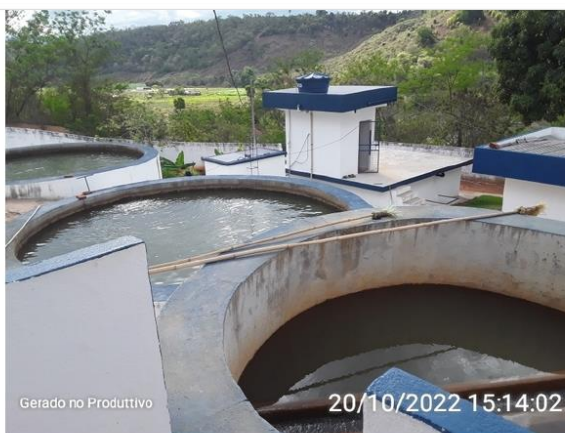
ETA do Distrito de Conceição do Capim
