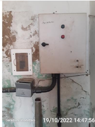
Painel de controle lavagem dos filtros
