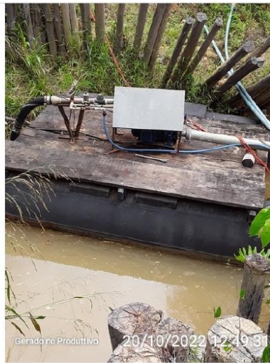
Plataforma onde se encontra o conjunto motobomba
