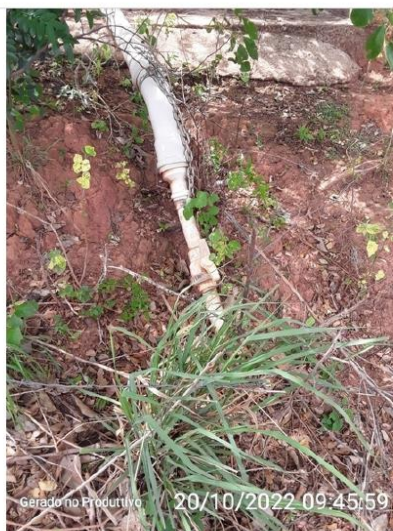
Válvula de fechamento na entrada do reservatório
