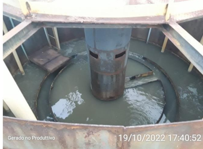
Local onde ficam os biofiltros
