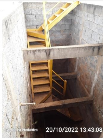
Escada para acesso ao reator
