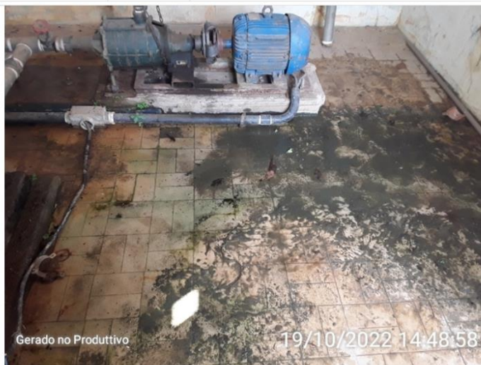
Piso sem drenagem da água
