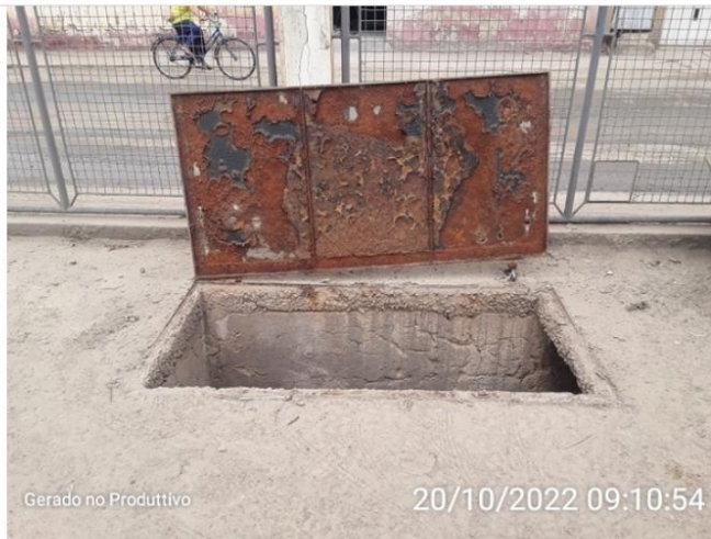
Tampas de inspeção com corrosão
