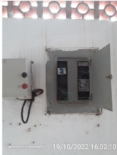
Fios elétricos expostos
