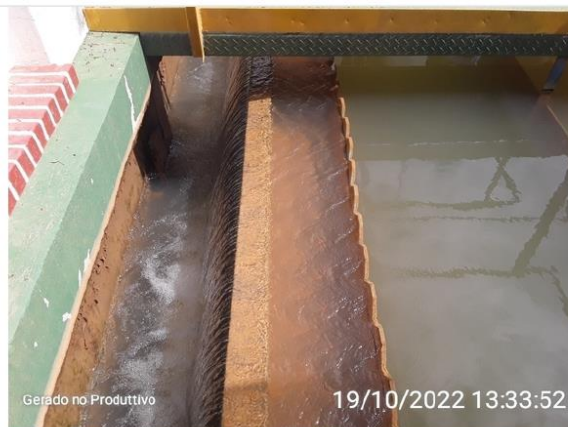
Calha de distribuição da água para os filtros
