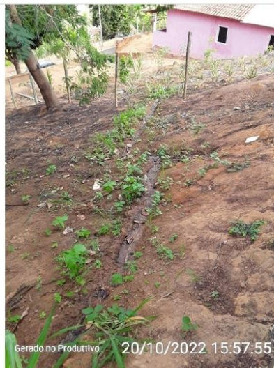
Perda água tratada no local
