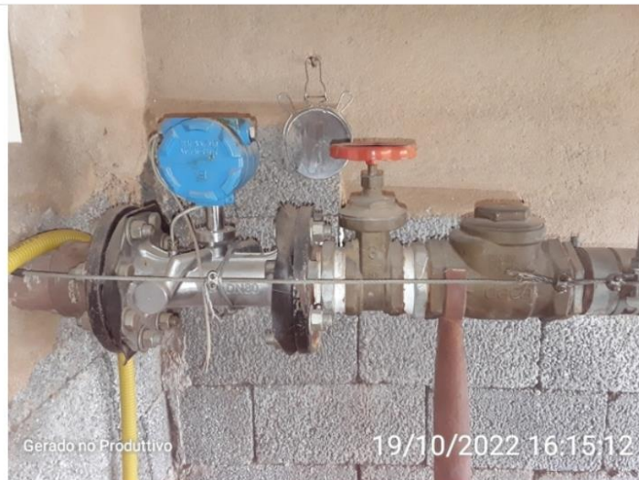
Válvulas e Hidrômetro
