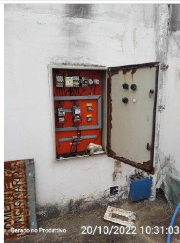
Parte interna do painel elétrico em oxidação
