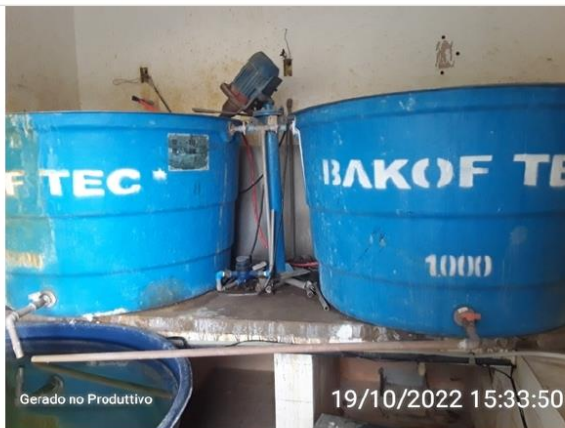
Tanques de preparo de produtos químicos com bomba agitadora
