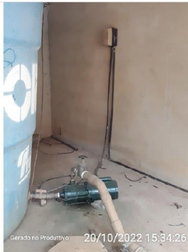
Fios e cabos elétricos desprotegidos
