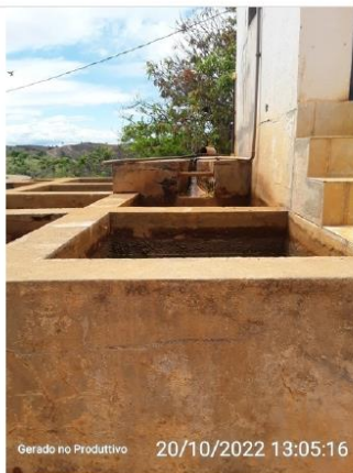
Calha parshall e floculadores
