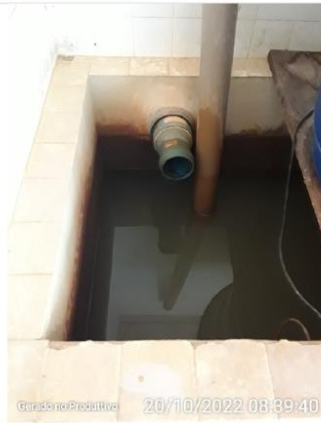
Entrada da água bruta
