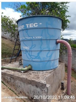
Tanque de contato
