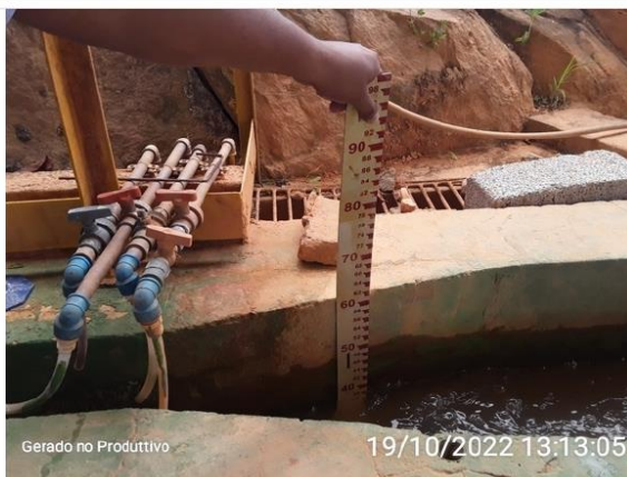
Medidor de vazão
