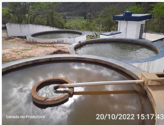
Área da ETA
