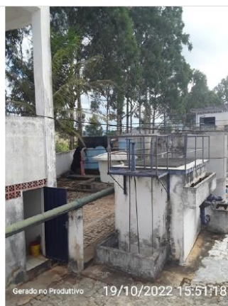
ETA São Sebastião Da Vala
