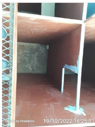
Parte interna do floculador sem impermeabilização
