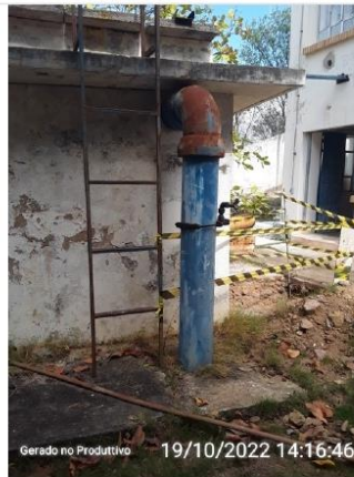
Chegada da água filtrada da ETA metálica
