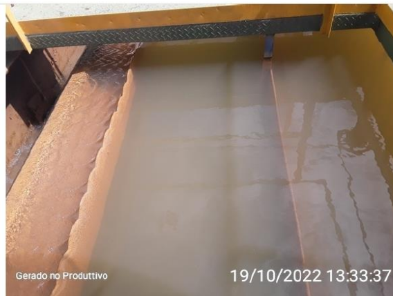
Saída do decantador para os filtros onde se tem a presença de sólidos suspensos na água.
