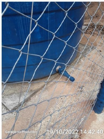
Tubo de descarga de fundo
