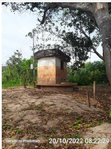
Local exposto à inundações
