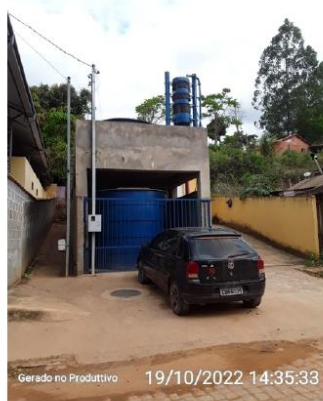
Unidade de tratamento
