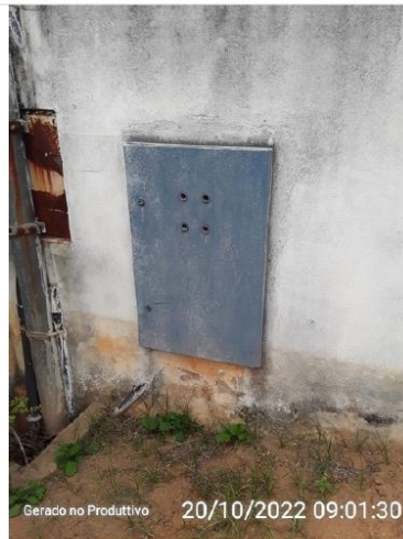
Painel elétrico exposto a intempéris
