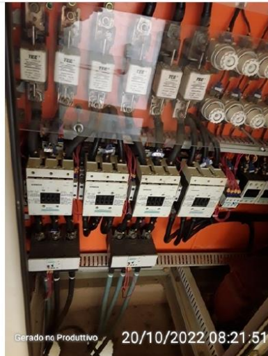
Capacitores conjunto motobomba I e II
