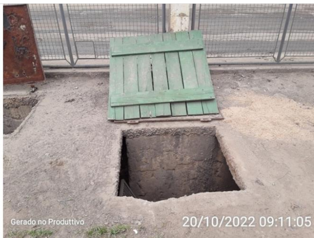
Tampas de inspeção
