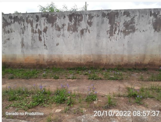
Marcas de inundação no local
