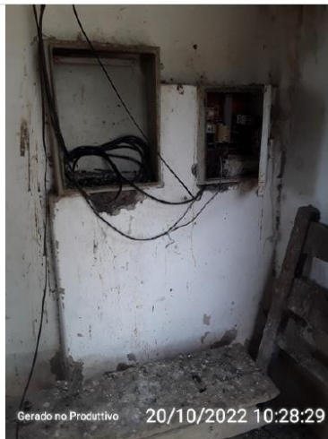
Abriço do painel de controle
