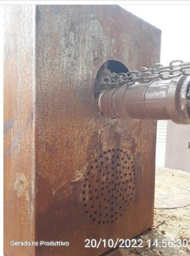
Tubulação de recalque
