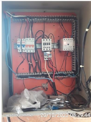
Parte interna do painel de controle
