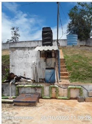
Sistema de tratamento
