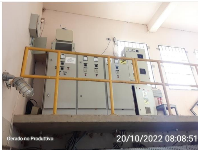
Painéis de comando
