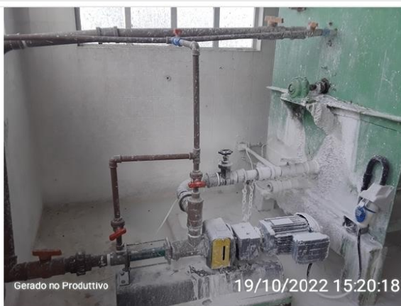
Vazamentos na Graxeta
