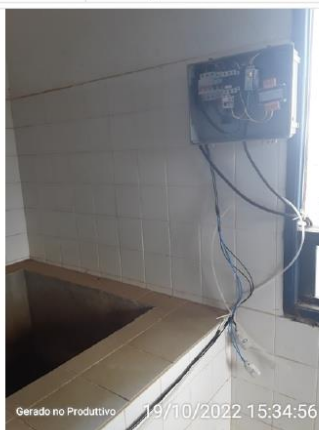
Fios e painel elétrico
