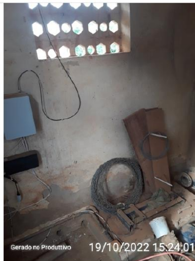
Sistema de ventilação
