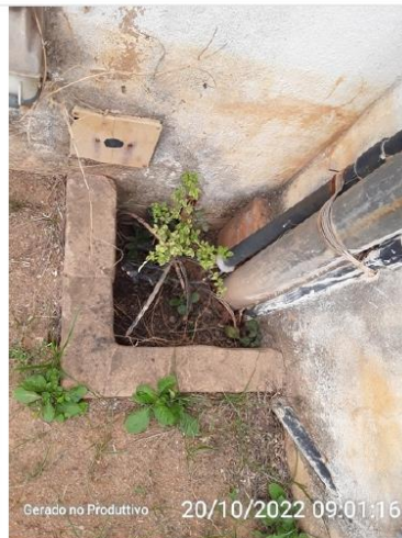
Cabos elétricos sem aterramento adequado
