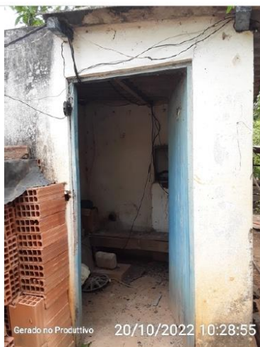
Abrigo do painel de controle
