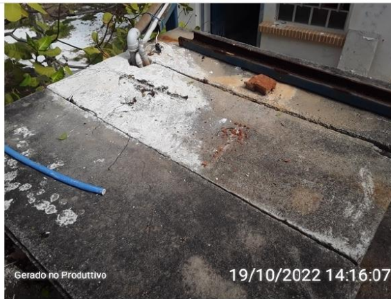
Tampa de inspeção do tanque de contato
