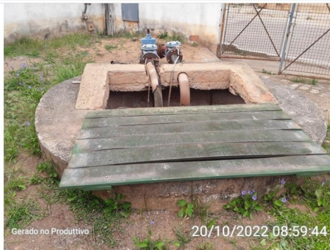
Tubulações e válvulas de retenção
