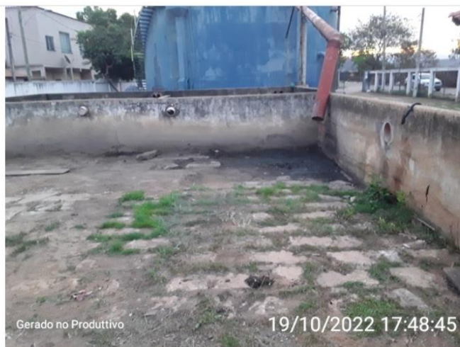
Descarga dos sólidos das peneiras do reator
