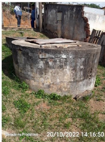
Patologias na estrutura do poço de sucção
