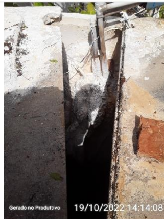
Calcificação prejudicando os processos de desinfecção, correção de pH, clarificação e fluoretação.
