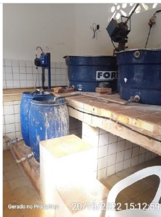
Tanques de preparo de produtos químicos
