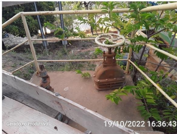
Válvulas de entrada da água bruta
