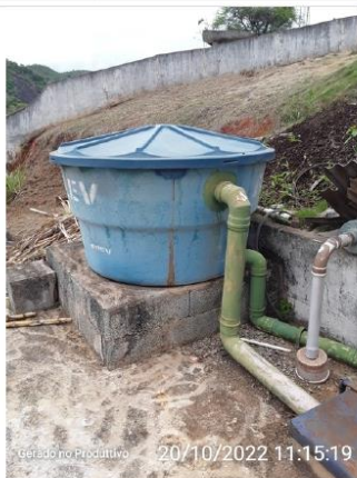
Tanque de contato
