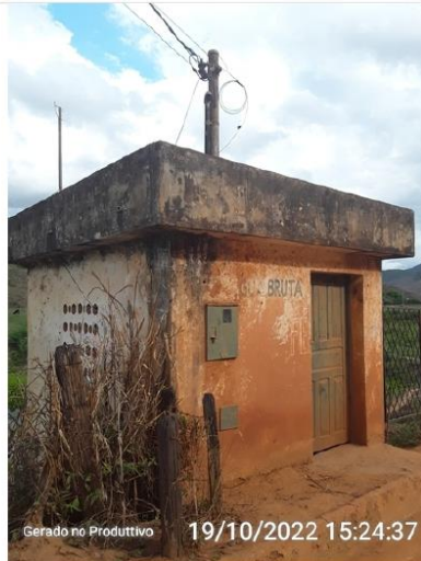
Casa de bombas
