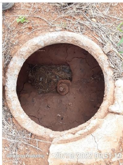
Válvula de fechamento na saída
