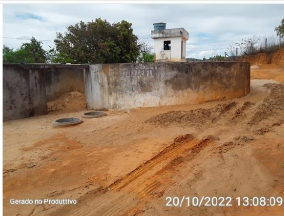
Areia retirada dos filtros
