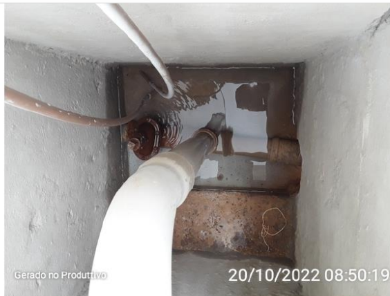
Vazamento na válvula
