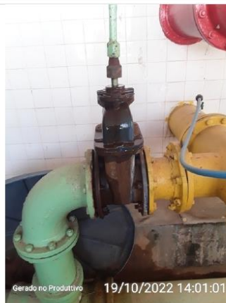
Vazamentos das válvulas de filtros
