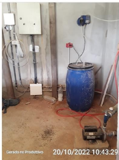
Bomba dosadora no local
