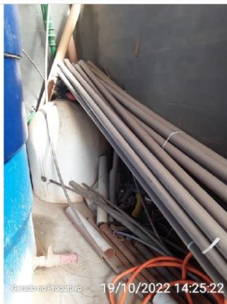
Tubulações para manutenção
