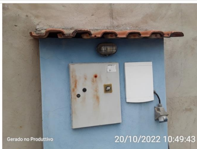
Quadro elétrico com proteção contra intempéries
