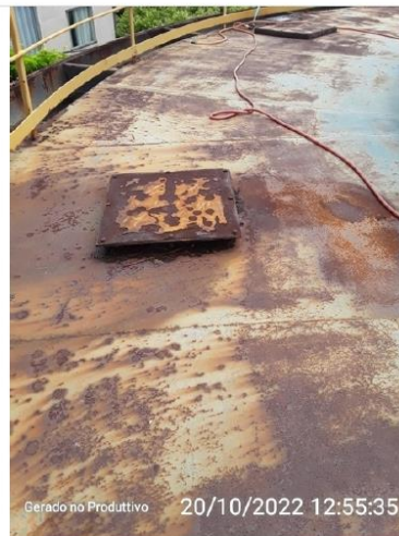
Corrosão na cobertura do Reator UASB
