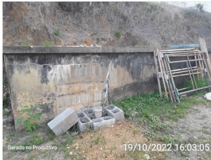
Local onde se encontra a válvula
