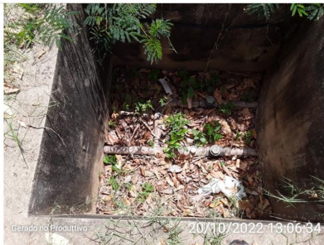
Válvulas de retenções
