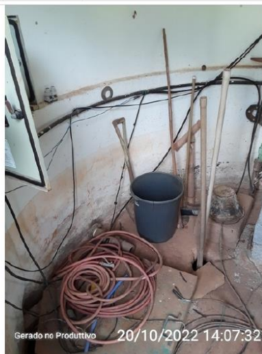
Materiais e ferramentas na sala de bombas
