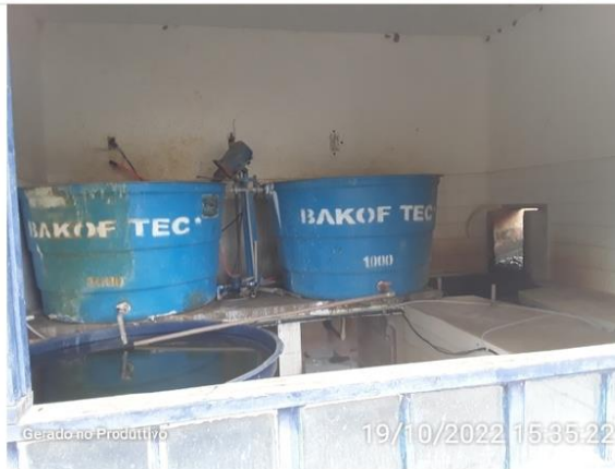
Tanques de preparo de produtos químicos com bomba agitadora
