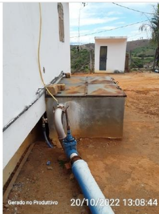
Caixa De Passagem
