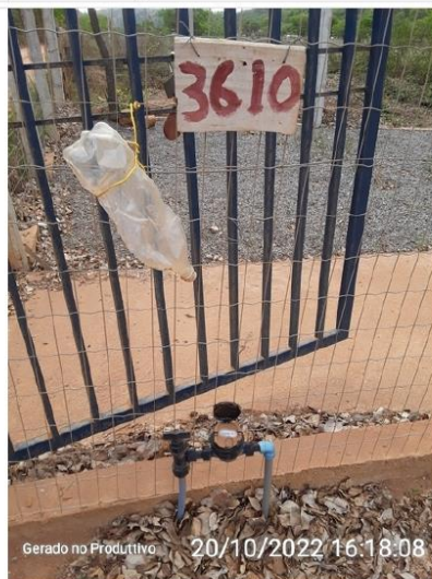
Local do hidrômetro
