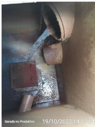
Vazamentos nas válvulas dos filtros ,decantadores, e floculadores que são destinados a rede coletora de esgoto.
