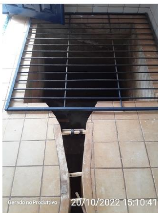
Chegada da água bruta
