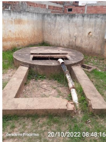
Ausência de tampa de inspeção
