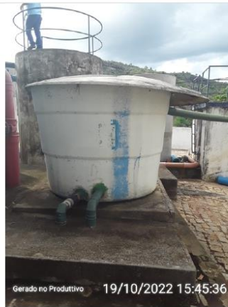
Caixa de fibra (Desativada)
