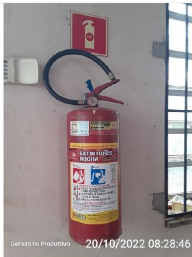
Extintor de incêndio
