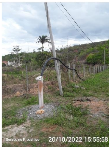
Tubulação de recalque
