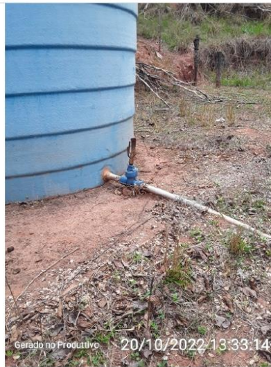
Válvula de fechamento na saída do reservatório
