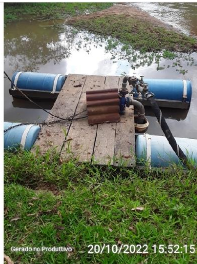
Plataforma onde se encontra o conjunto motobomba
