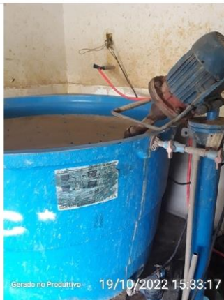
Tanque de preparo de produtos químicos com bomba agitadora
