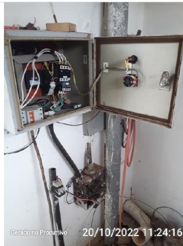
Quadro e cabos elétricos
