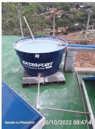
Sistema para dosagem do hipoclorito de cálcio
