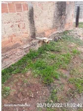
Esgoto a céu aberto
