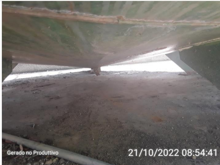
Tubo de descarga de fundo
