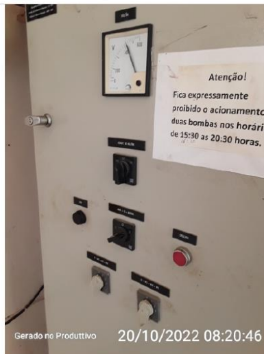
Painel de comando motobomba I e II (100 cv)
