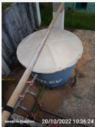
Tanque de contato
