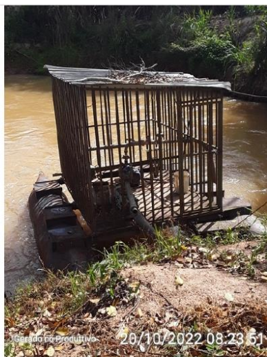
Estrutura de proteção do conjunto motobomba
