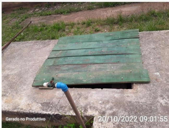
Tampas de inspeção
