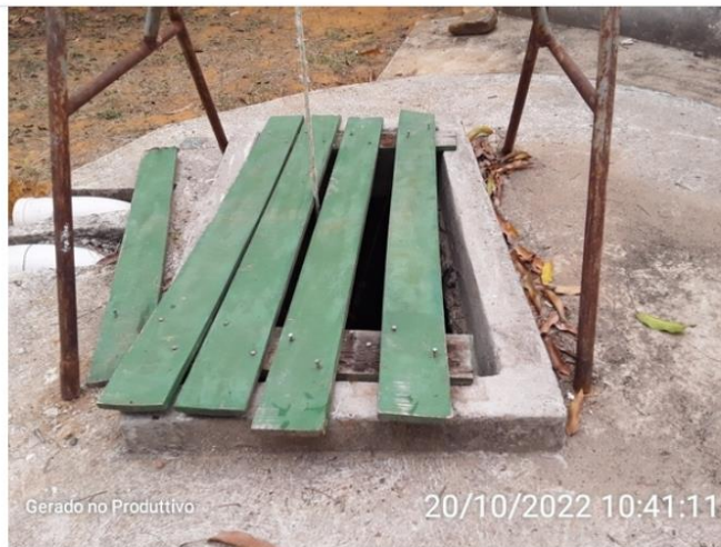
Tampa de inspeção danificada
