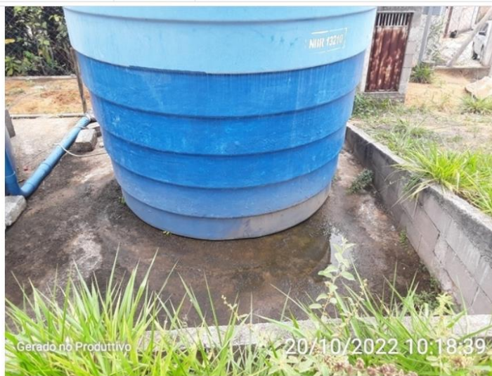
Transbordamento de água
