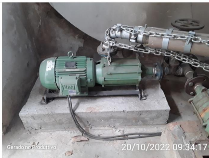
Conjunto motobomba (15 cv)
