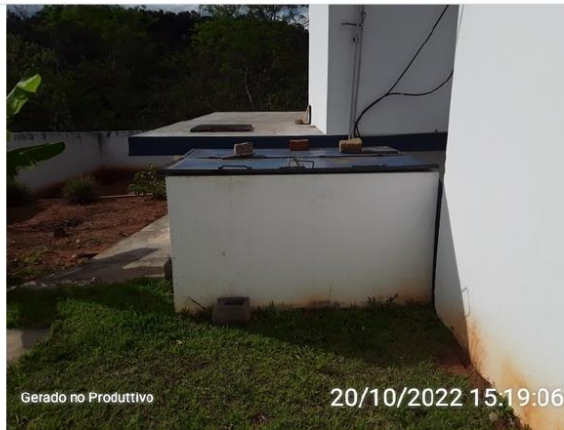
Tanque de desinfecção
