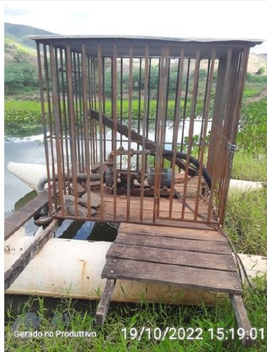
Estação Elevatória Flutuante
