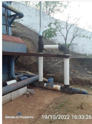
Sistema de afogamento dos filtros
