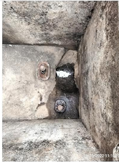
Válvula de fechamento na saída do reservatório
