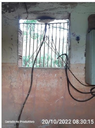
Cabos elétricos expostos
