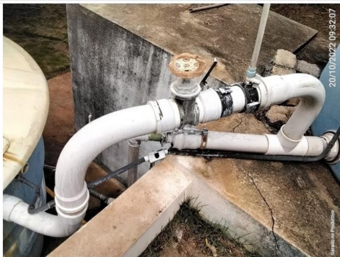
Válvula de fechamento na entrada do reservatório
