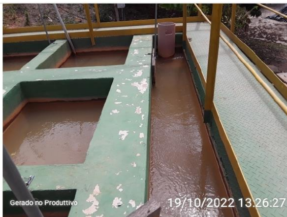
Canal de passagem da água floculada para os decantadores
