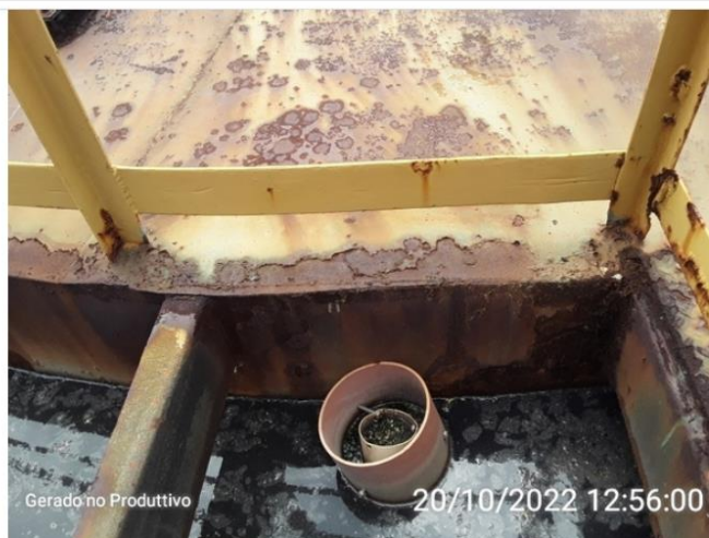
Estrutura em corrosão
