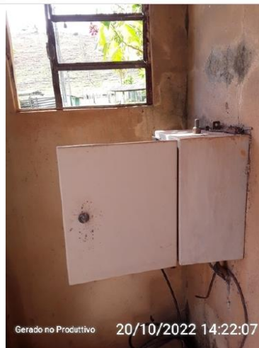
Painel elétrico aberto
