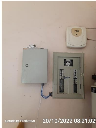
Chave elétrica dos conjuntos motobomba
