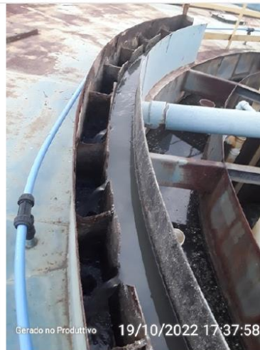
Calhas de distribuição para os biofiltros
