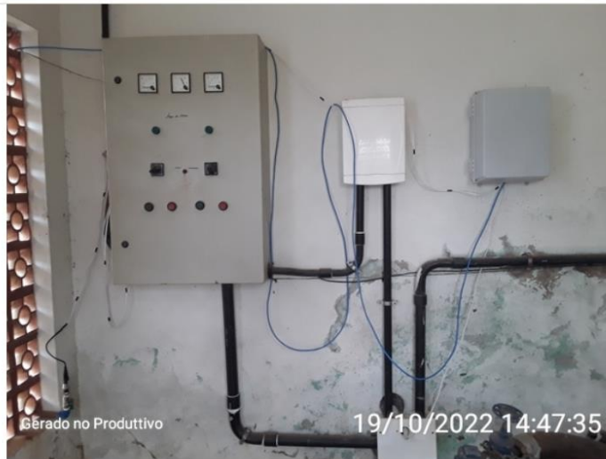
Painel de controle EEAT morro da caixa d'agua
