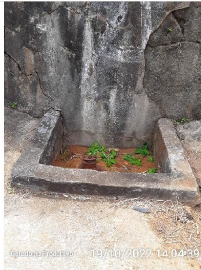
Tubo de descarga de fundo
