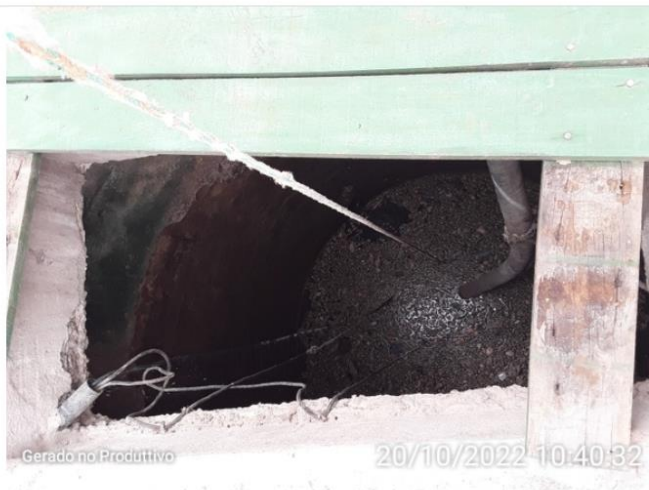
Conjunto motobomba submerso
