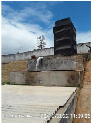
Aerador e Decantador
