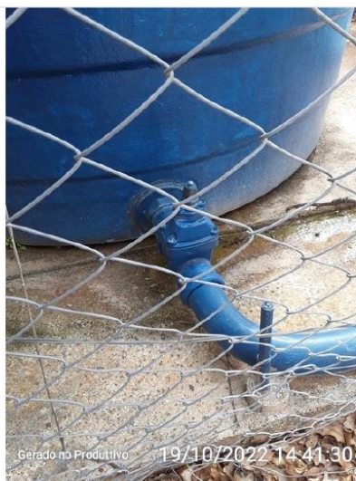
Válvula de fechamento na saída do reservatório
