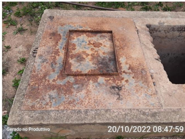
Tampa de inspeção parte externa
