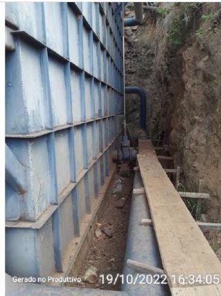
Descarga de fundo do decantador
