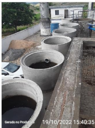
Câmaras de floculadores
