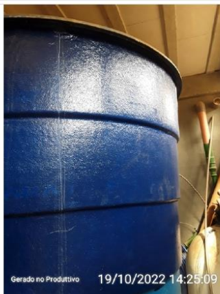
Tanque de contato
