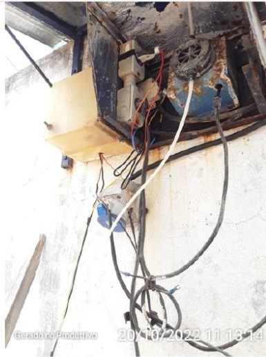
Fios e cabos elétricos expostos
