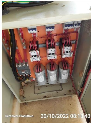
Capacitores da motobomba III
