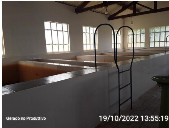
Vista frontal dos filtros
