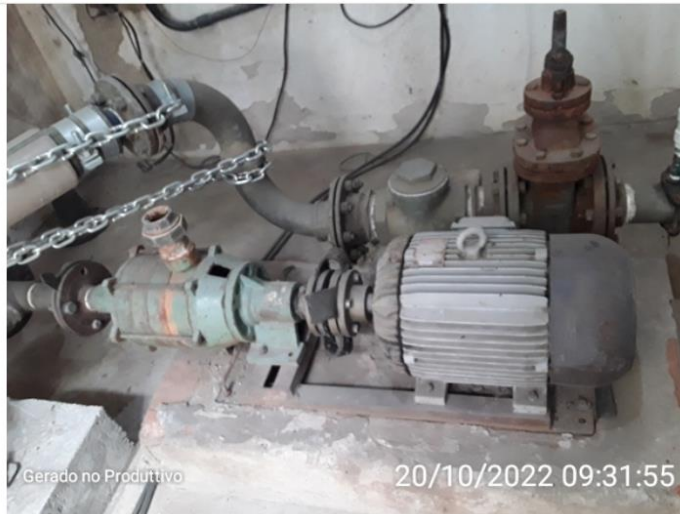
Conjunto motobomba reserva
