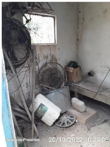
Abrigo do painel de controle
