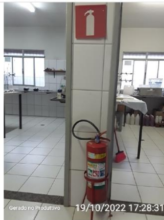
Extintor de incêndio
