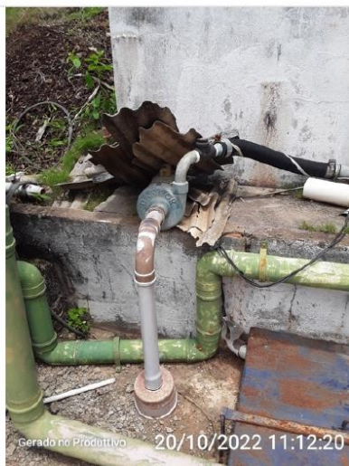
Elevatória Mundo Novo de Minas
