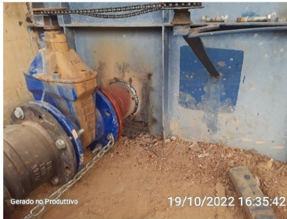
Soldagem - Infiltrações nas válvulas dos filtros
