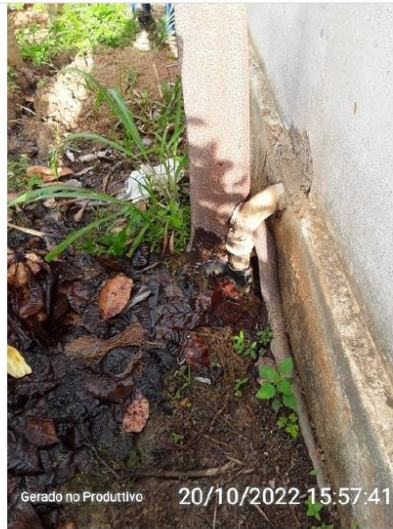
Cano com vazamento
