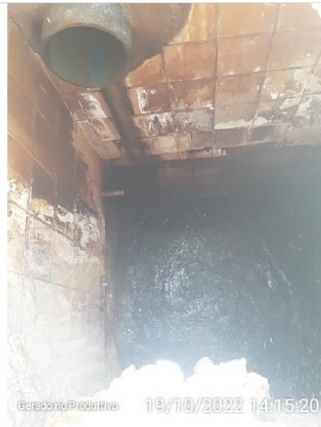
Parte interna do tanque de contato
