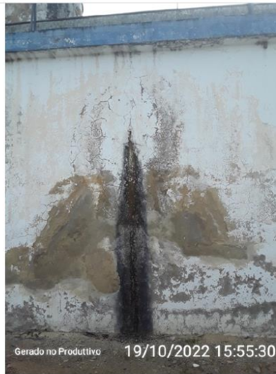
Infiltração na estrutura do reservatório
