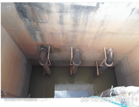
Tubulações de sucção
