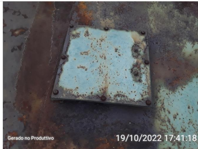
Corrosão nas caixas de gorduras
