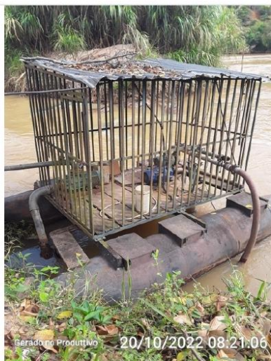
Estação elevatória flutuante
