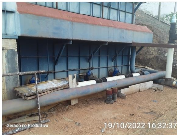
Válvulas dos filtros
