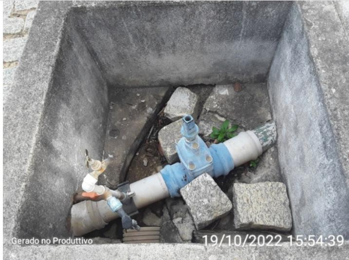
Válvula de fechamento na saída do reservatório
