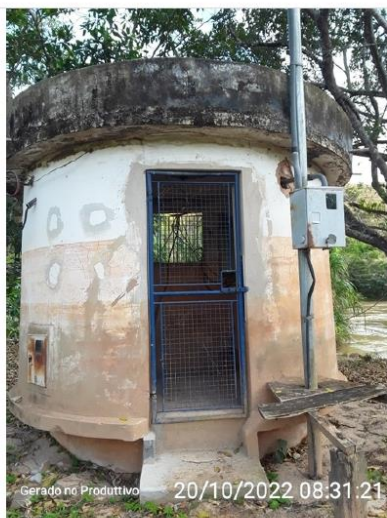
Local de acionamento do conjunto motobomba
