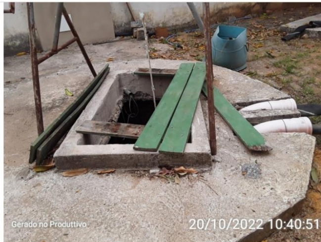
Local sem tampa de inspeção
