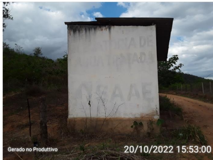
Casa de bombas
