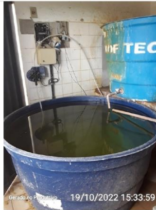
Tanque de preparo de solução de sulfato de alumínio
