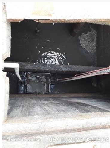
Caixa de remoção de sólidos grosseiros
