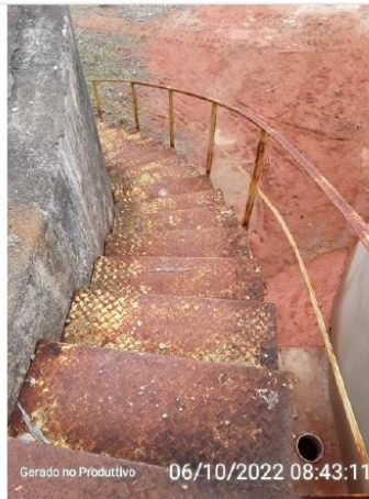
Escada de acesso oxidadas
