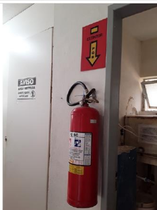
Extintor de incêndio
