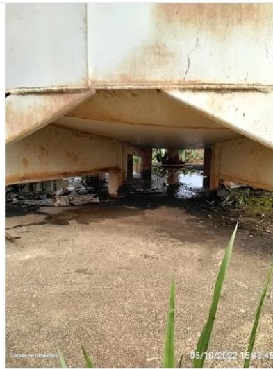
Tubo de descarga de fundo
