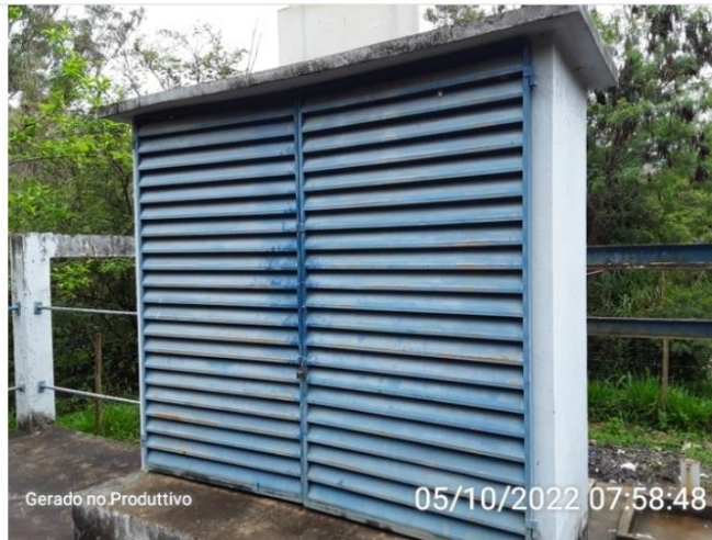
Local dos painéis elétricos
