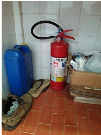
Extintor de incêndio
