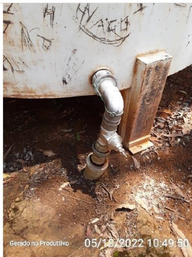
Válvula de fechamento na saída
