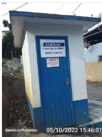
Casa de bomba
