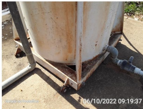
Corrosão na parte inferior do reservatório
