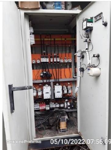
Painel elétrico da motobomba em funcionamento
