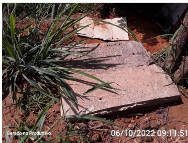
Caixa de passagem
