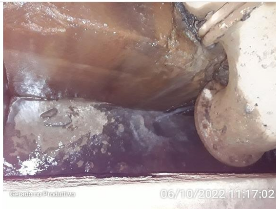
Vazamento na válvulas de descarga dos filtros
