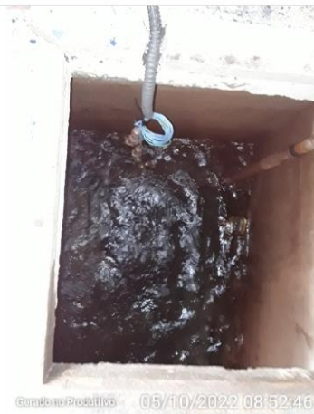
Boia de nível do reservatório de sucção
