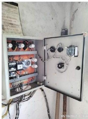
Parte interna do painel elétrico
