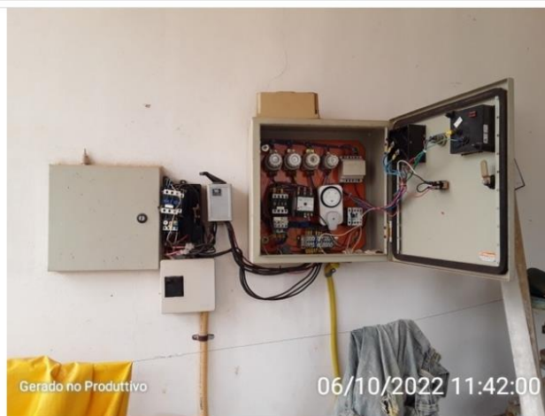
Fios elétricos expostos
