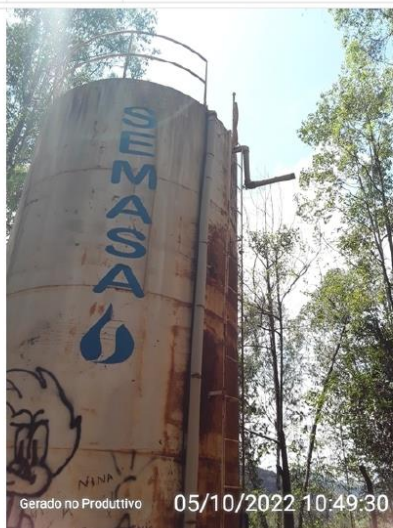
Escada sem guarda-corpo
