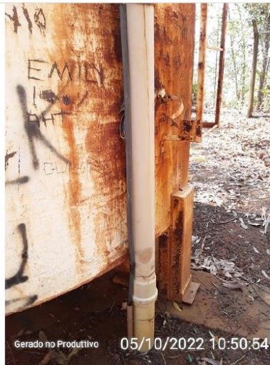
Sistema de boia de nível
