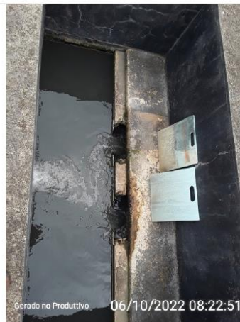
Caixa separação do esgoto para os reatores
