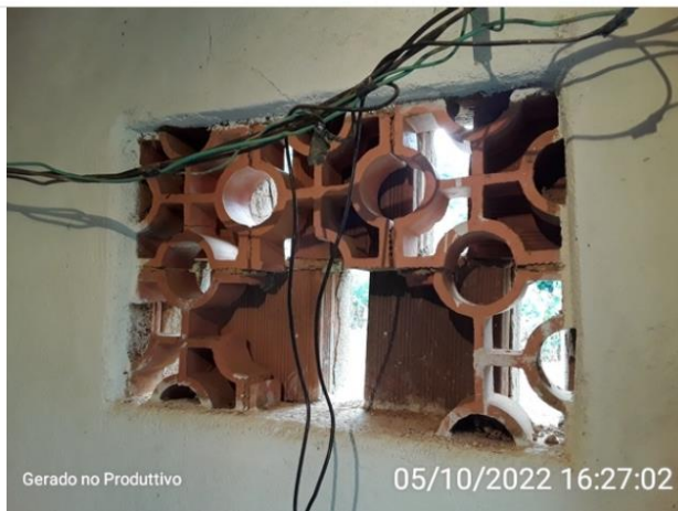
Sistema de ventilação
