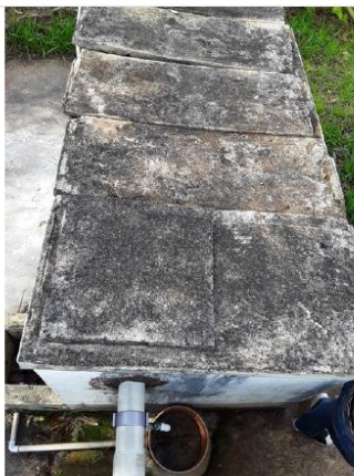
Tampa de inspeção do tanque de contato
