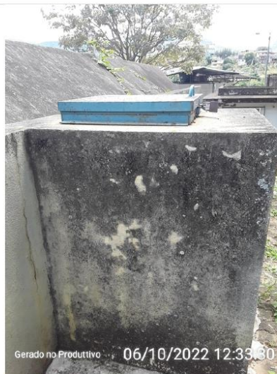
Entrada de água
