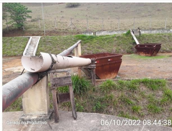
Caçamba de recolhimento de sólidos formados no processo biológico
