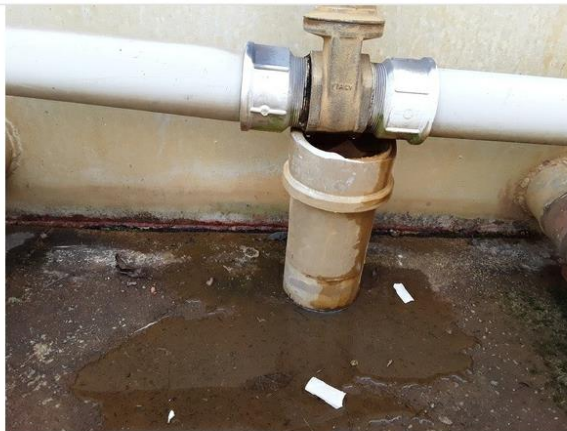
Vazamentos nas válvulas
