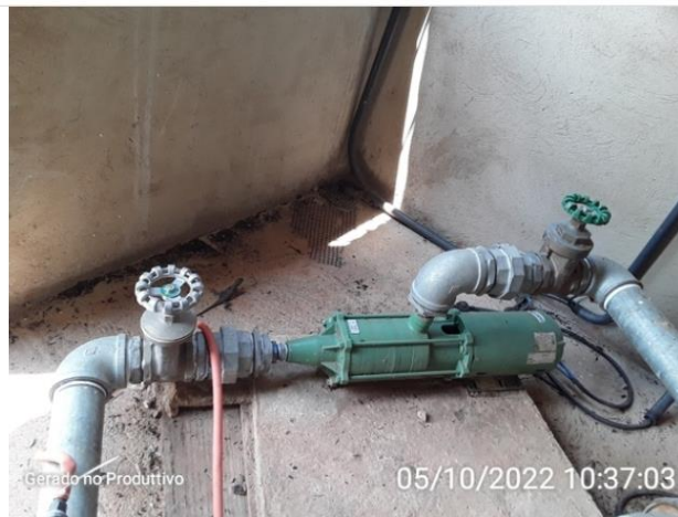
Conjunto motobomba reserva
