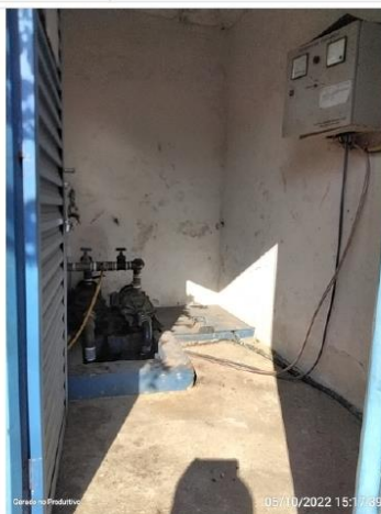
Piso sem sistema de drenagem
