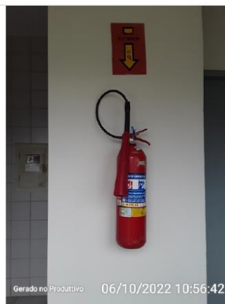
Extintor de incêndio no local
