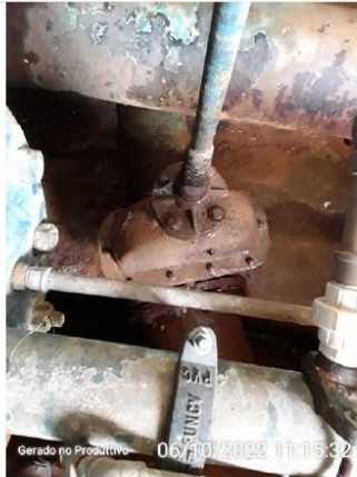
Vazamento na válvulas de descarga do filtro
