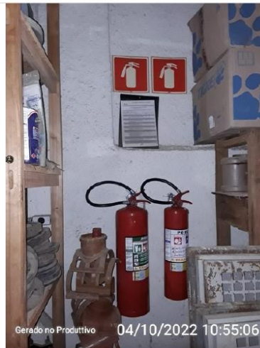
Extintor de incêndio
