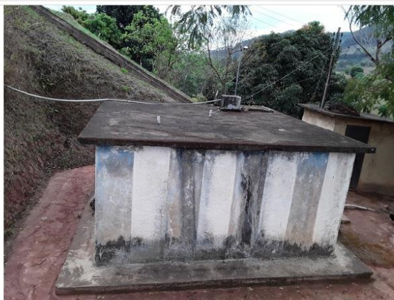
Tanque de contato
