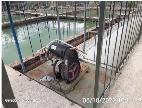
Bomba de retrolavagem
