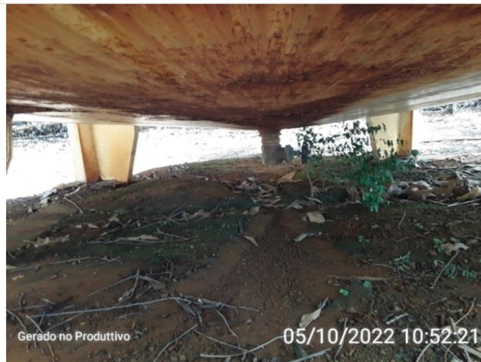
Tubo de descarga de fundo
