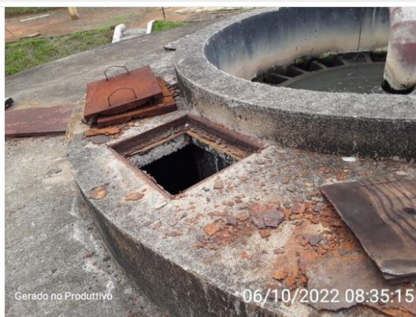
Tampas de inspeção oxidadas
