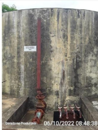
Tubo de descarga do lodo
