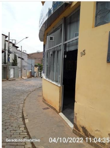
Ausência de rampa de acessibilidade
