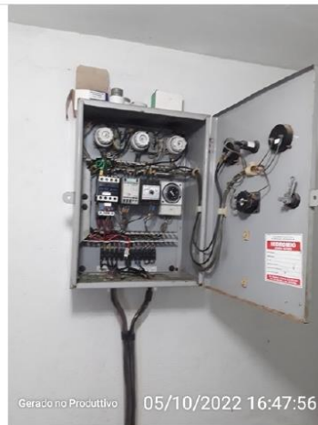
Fios elétricos adequados
