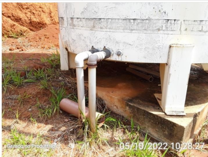
Válvula de fechamento na saída
