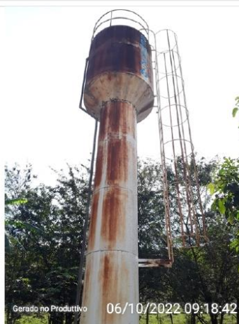
Reservatório de água potável
