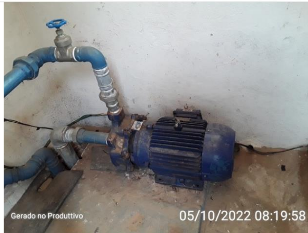
Conjunto motobomba reserva
