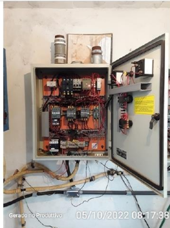
Fios elétricos emaranhados
