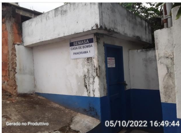
Casa de bombas
