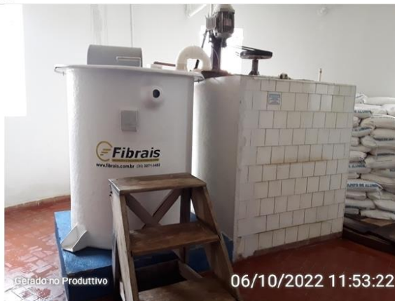
Preparo de sulfato alumínio
