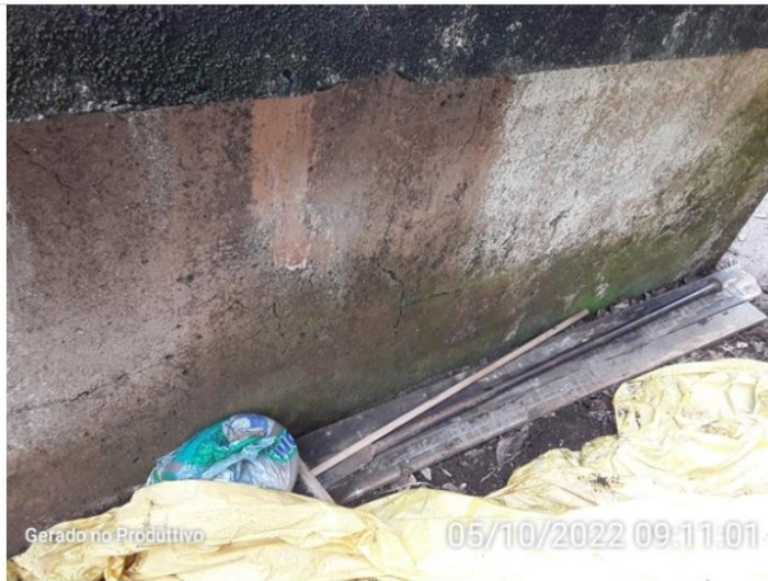
Trincas nas laterais do reservatório
