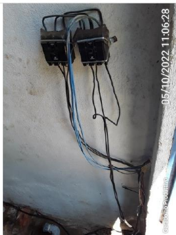
Chaves elétricas e fios sem condutas
