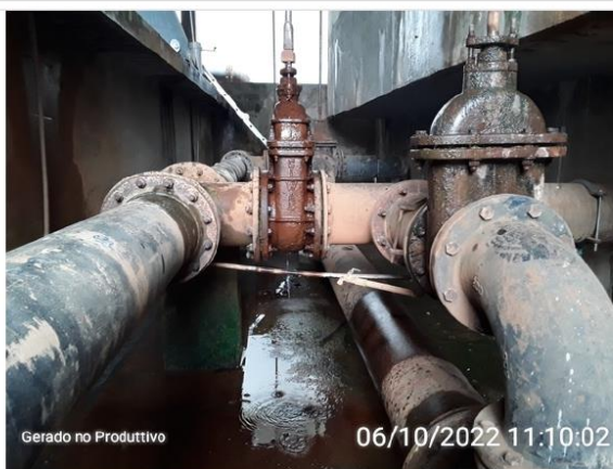
Válvulas dos filtros com vazamentos
