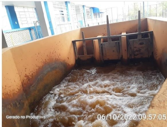
Manobras para enviar a água para os flocladores
