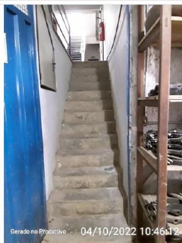
Escada de acesso sem guarda-corpo
