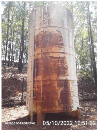
Presença de corrosão no reservatório
