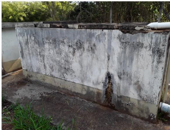
Infiltrações na estrutura do tanque de contato
