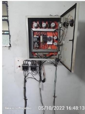
Cabos e fios elétricos expostos
