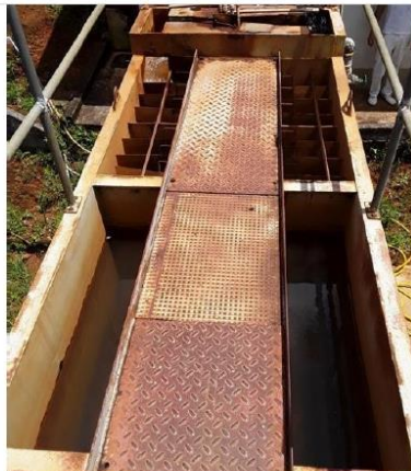
Floculadores e decantadores
