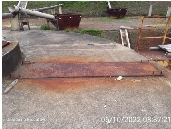
Tampa de inspeção oxidadas
