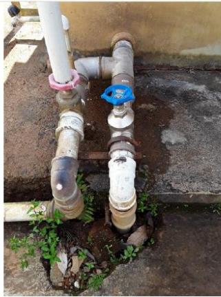
Válvulas com vazamentos
