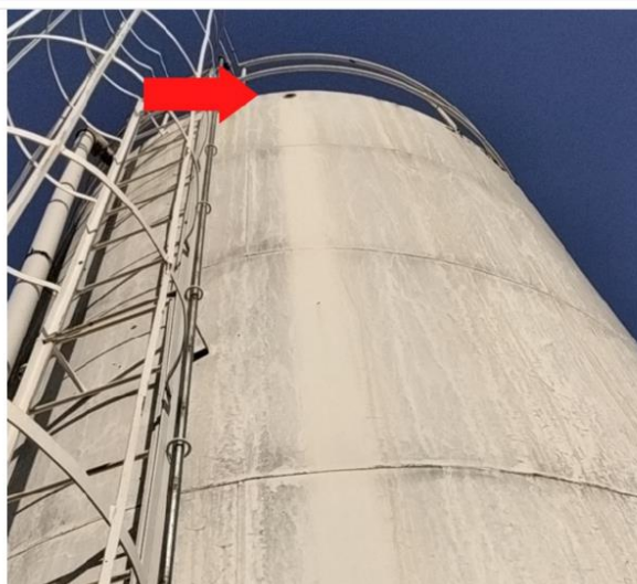
Saída para tubo extravassor
