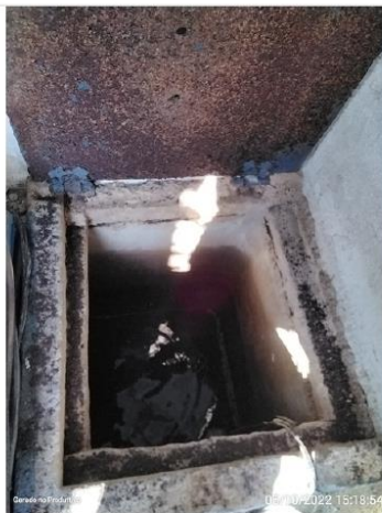
Tampa de inspeção oxidada
