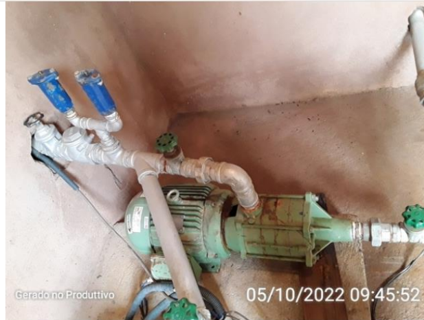
Conjunto motobomba reserva
