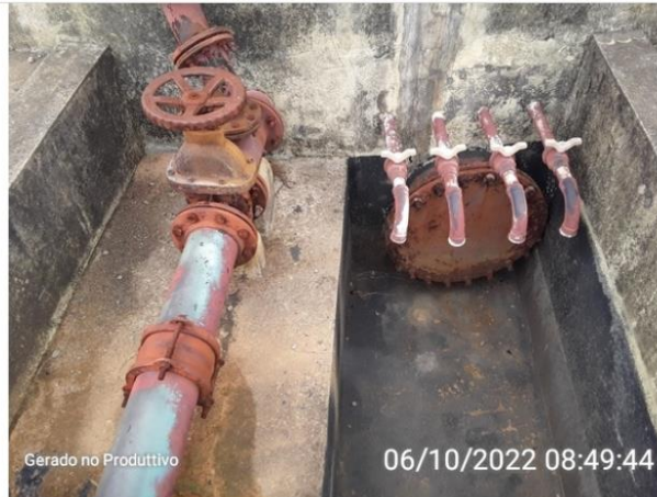
Válvulas para verificação do tempo de maturação do lodo
