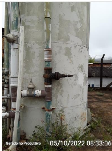
Válvulas de fechamento na saída
