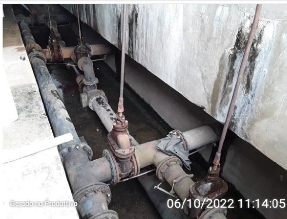
Vazamento na válvulas de descarga do filtro
