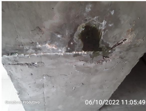
Parte de baixo dos filtros
