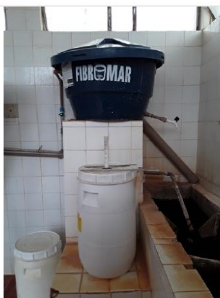
Local de dosagem
