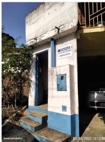
Casa de bombas
