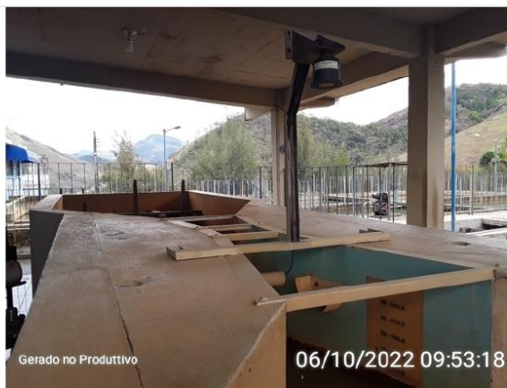
Calha Parshall e medidor ultrassônico
