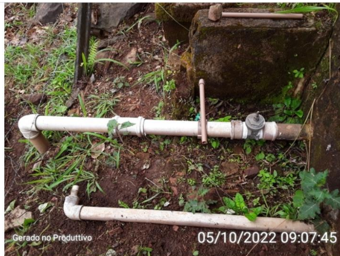
Válvula de fechamento na saída
