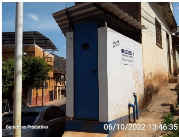
Casa de bombas
