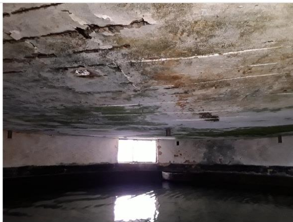
Patologias na estrutura interna do filtro lento
