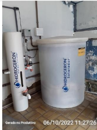
Tanque de cloro
