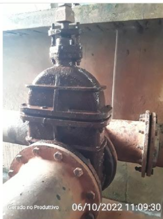
Válvulas com vazamentos
