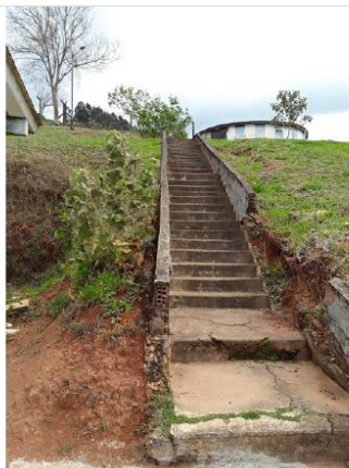
Escada sem guarda-corpo
