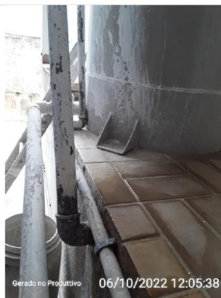
Dosagem do cal no tanque de contato
