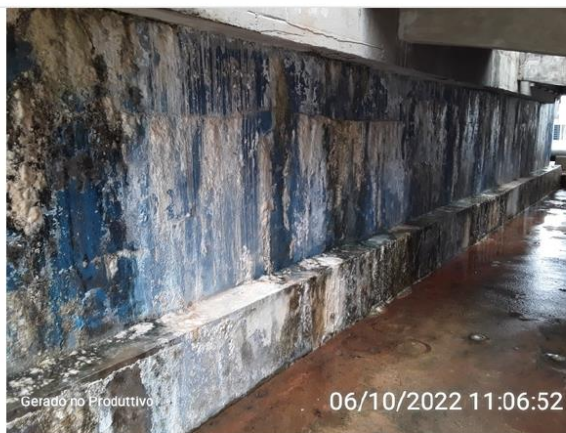
Infiltrações e vazamentos
