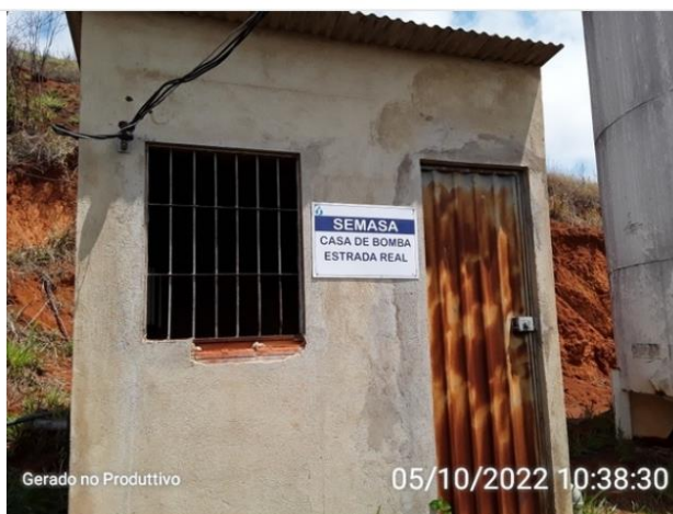
Casa de bombas
