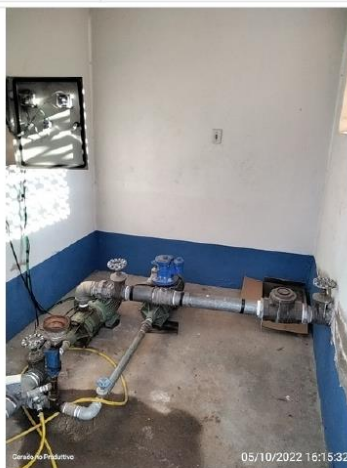
Piso sem drenagem
