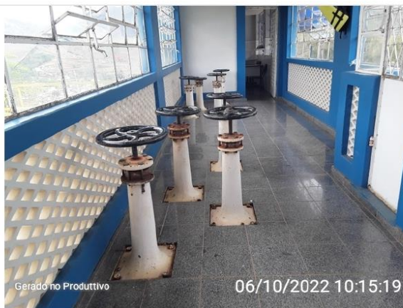
Válvulas dos filtros
