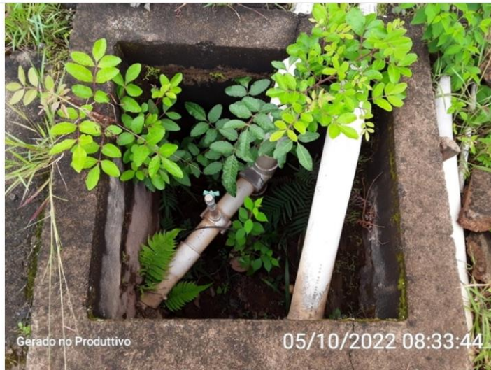
Válvula de fechamento na saída
