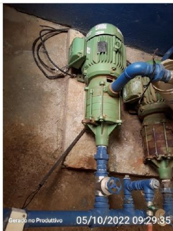
conjunto motobomba reserva
