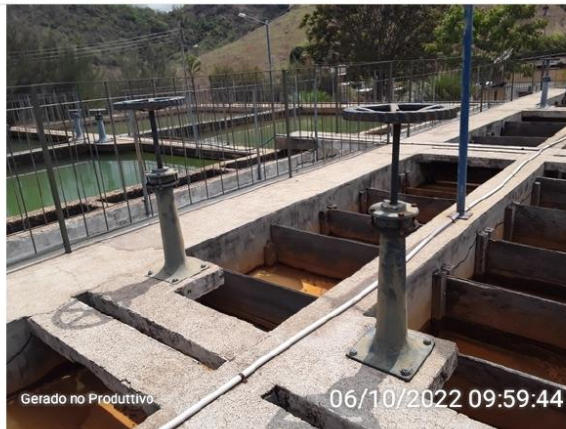
Válvulas para limpeza dos floculadores
