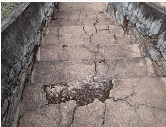
Patologias na estrutura da escada
