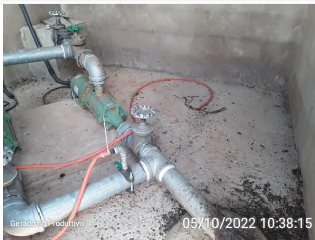
Piso sem sistema de drenagem
