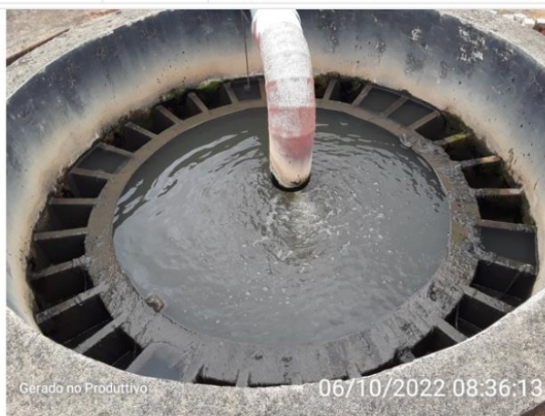
Caixa de distribuição do esgoto
