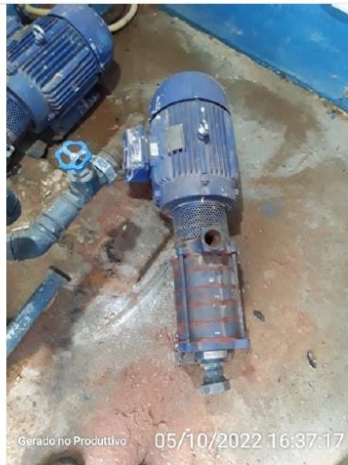
Conjunto motobomba reserva
