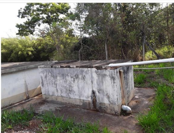
Tanque de contato de concreto - Desinfecção
