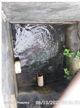
Vazamento no registro do desarenador
