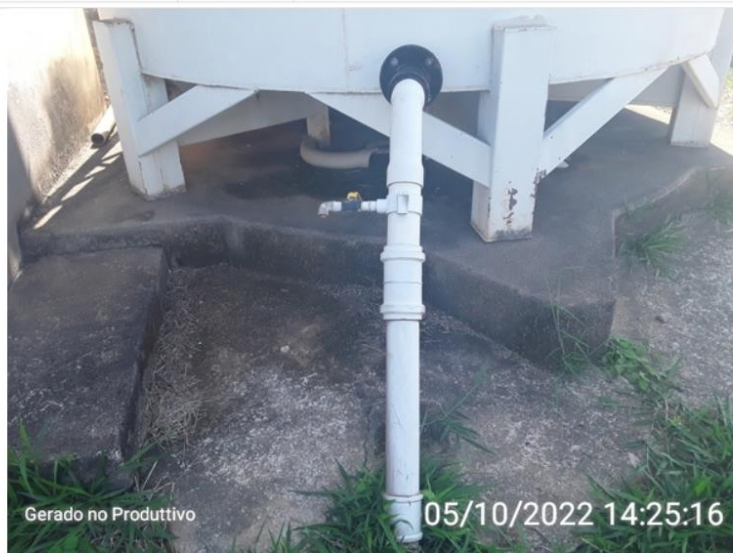
Válvula de fechamento na saída
