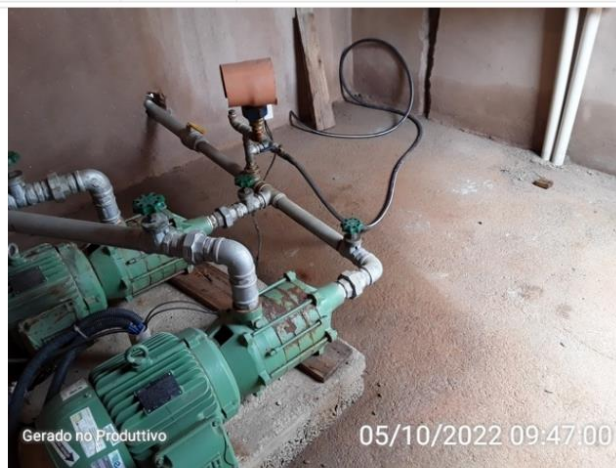
Piso sem drenagem
