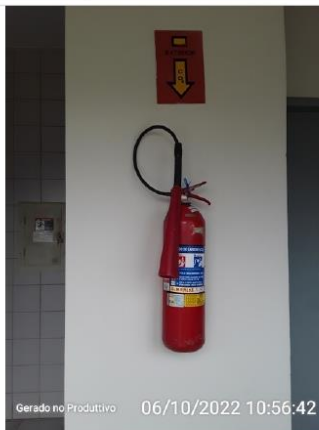
Extintor de incêndio
