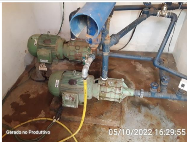
Ausência de sistema de drenagem no piso
