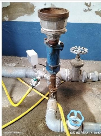
Vazamentos na ventosas
