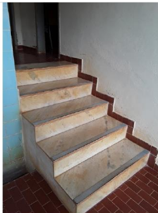
Escada sem guarda - corpo
