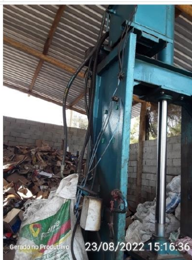
Prensa com fios elétricos expostos
