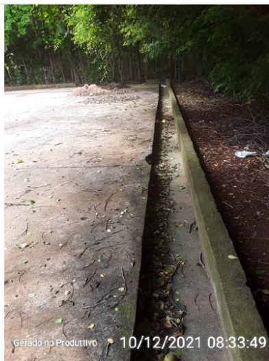
Canaletas de drenagem
