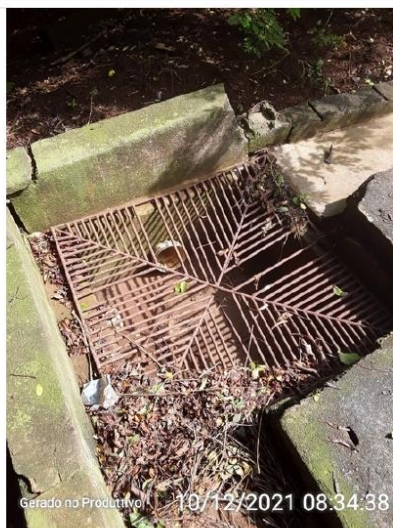
Drenagem de águas pluviais
