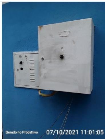
Quadros de controle.
