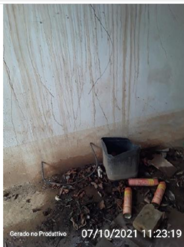
Marcas d'água na parede, indicando inundações da área da EE.
