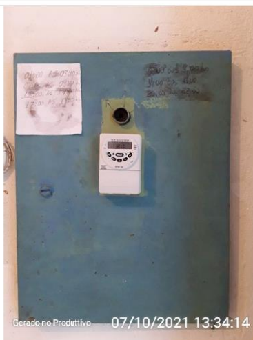
Quadro de comando e controle da EE.
