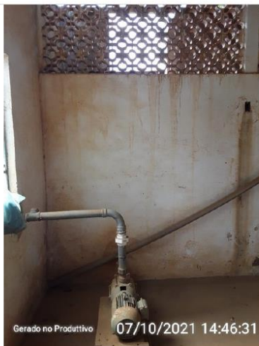
Dispositivo para renovação do ar no interior da casa de bomba.
