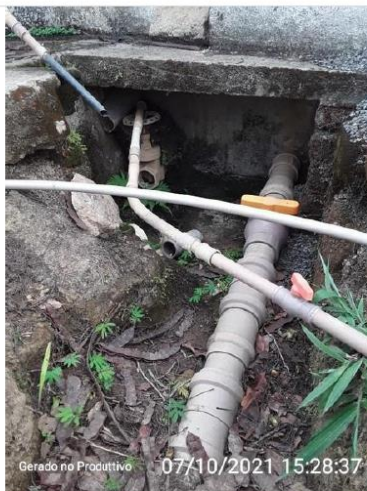
Descarga de fundo no reservatório.
