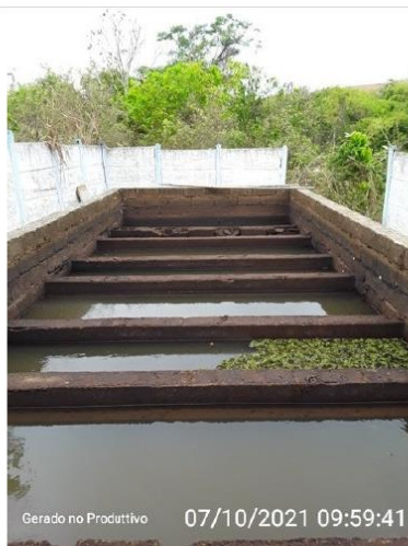
Desarenador da captação.
