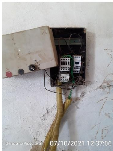
Condições dos cabos elétricos.
