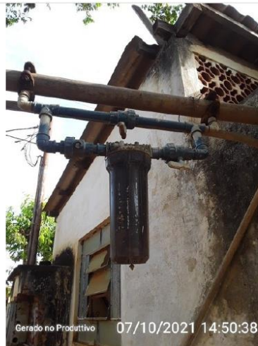
Clorador do poço.
