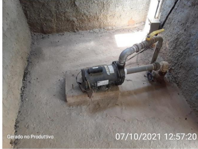
Pisa sem sistema de drenagem.
