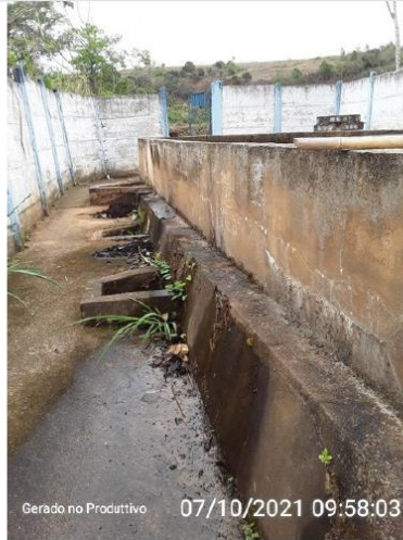
Vazamentos no desarenador.
