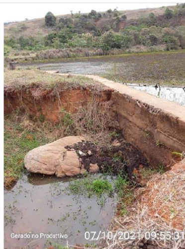
Ausência de vazão residual a jusante da barragem.
