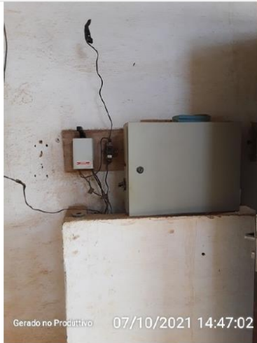
Quadro elétrico apoiado em mureta.
