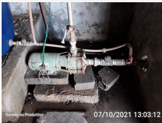
Conjunto motobomba existente na EEAT.
