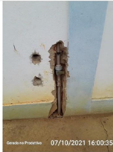
Válvula de fechamento na saída do reservatório.
