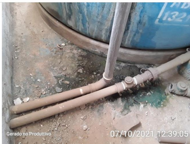
Vazamento na tubulação.
