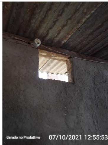
Dispositivo de ventilação e/ou renovação do ar (2).
