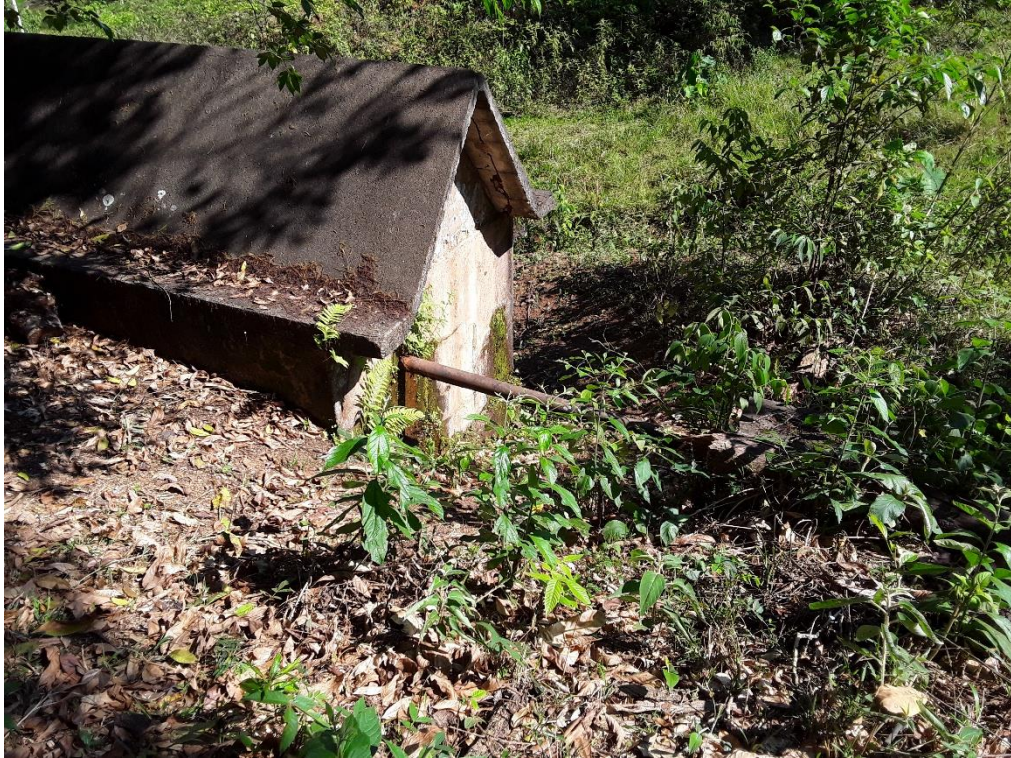
Figura 4 - Caixa de passagem e adutora a jusante da captação superficial.
