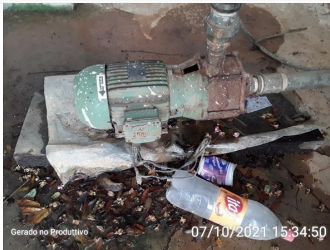
Vazamento no conjunto motobomba.
