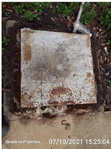
Tampas de inspeção oxidada.
