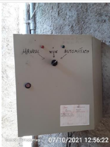
Quadro de comando e controle.
