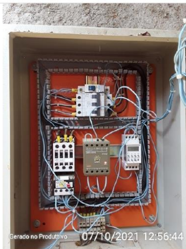
Condições aparentes dos quadros de comando e controle.
