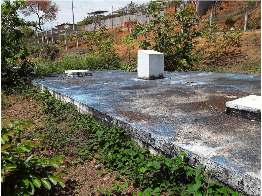
Figura 7 – Reator anaeróbio da ETE.
