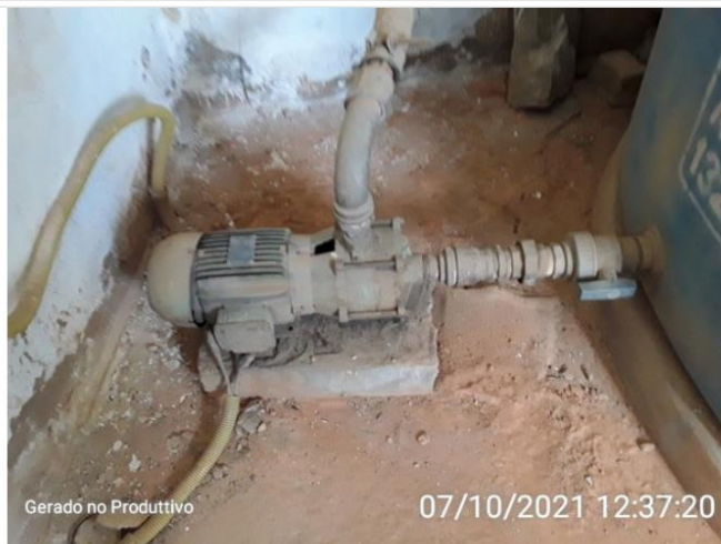
Conjunto motobomba utilizado na EEAT.
