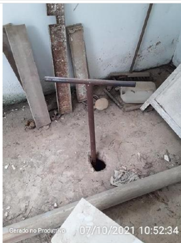
Válvula de fechamento na saída do reservatório.
