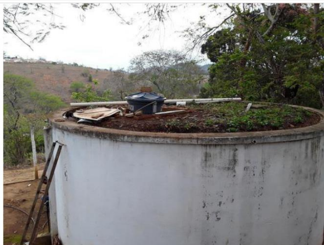
Ausência de tampa de inspeção no reservatório.
