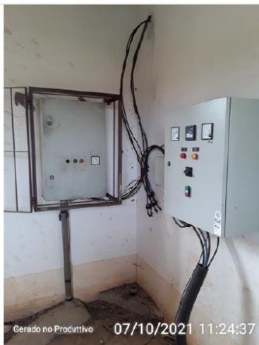
Quadro de comando acima da cota de inundação.
