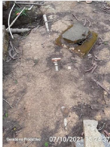
Válvula de fechamento na saída do reservatório.
