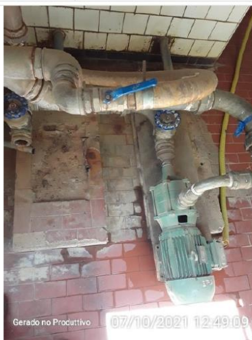
Conjunto motobomba da EEAT.
