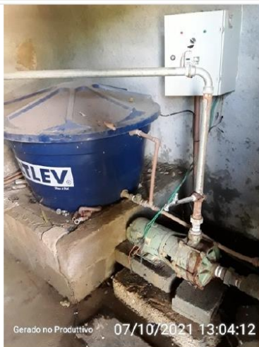
Reservatório de sucção anexo à bomba.
