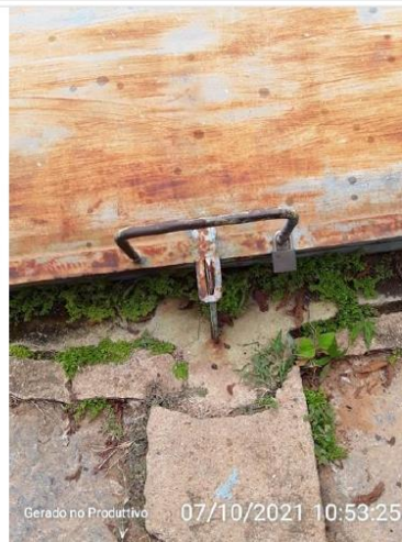
Tampa de inspeção sem cadeado.
