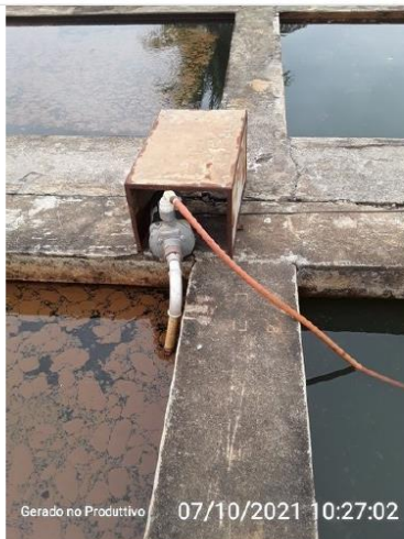
Bomba utilizada para a lavagem dos filtros com água decantada.
