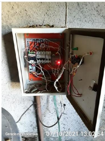
Condições aparentes dos cabos e fios elétricos.
