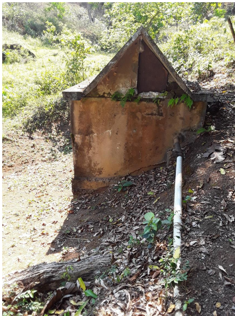
Figura 3 – Caixa de passagem a jusante da captação superficial.
