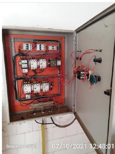
Condições aparentes do quadro de comando.
