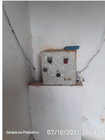
Quadro de comando e controle.
