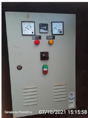
Caixa do painel elétrico.
