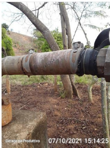
Conexão na tubulação de saída do poço.
