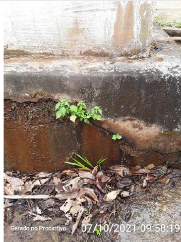
Vazamento na estrutura do desarenador.
