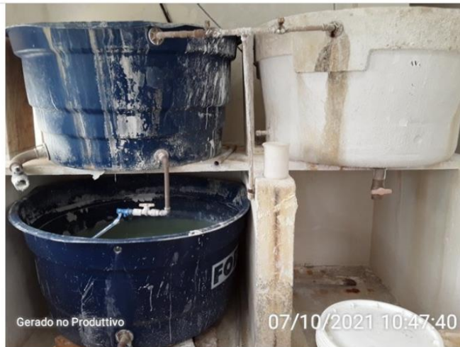
Tanques de preparo de produto químico
