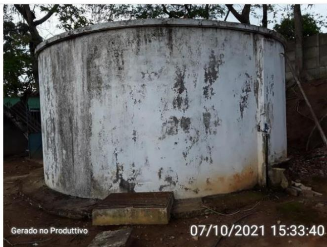
Reservatório da Escola
