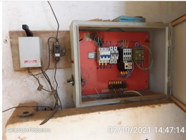
Indícios de curto circuito no painel.
