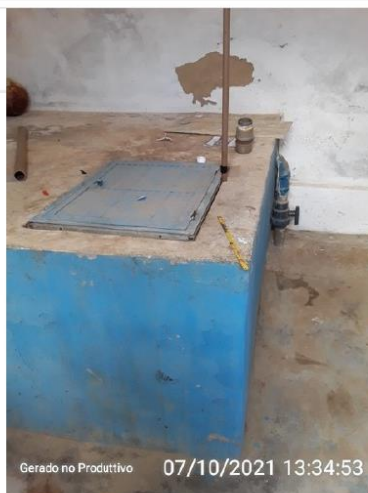
Reservatório de sucção.
