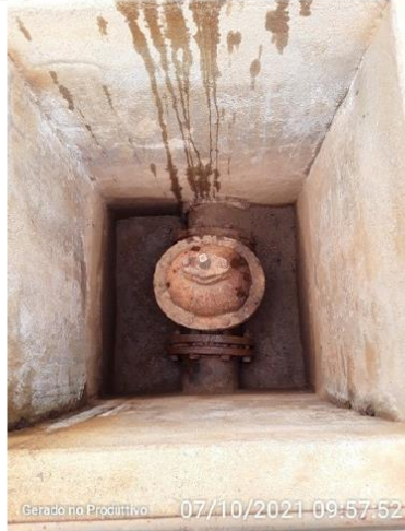
Válvula de fechamento na tubulação de captação.
