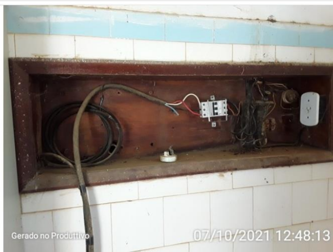
Condições dos cabos e fios elétricos.
