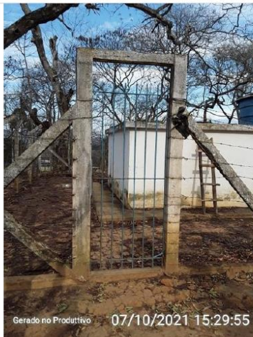
Portão de acesso sem cadeado.
