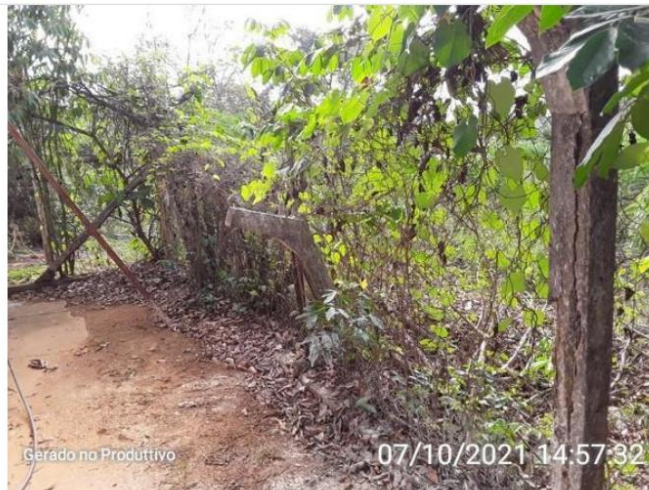
Necessidade de manutenção na cerca.
