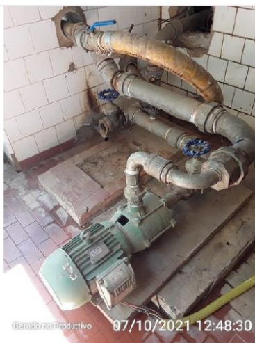
Conjunto motobomba existente na EEAT.
