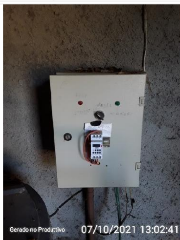
Quadro de comando e controle.
