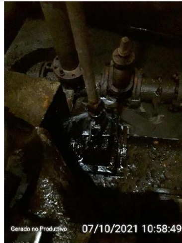
Grande vazamento na válvula de fechamento na saída do reservatório.
