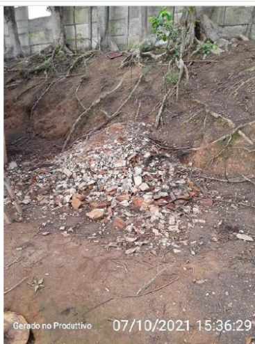
Resíduos da construção civil na área do reservatório.
