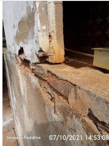
Estrutura do reservatório danificada.
