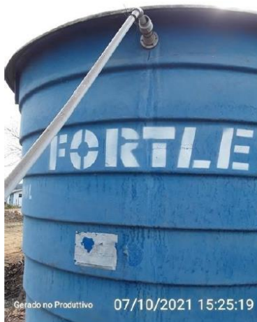
Tubo extravasor e tubulação de entrada.
