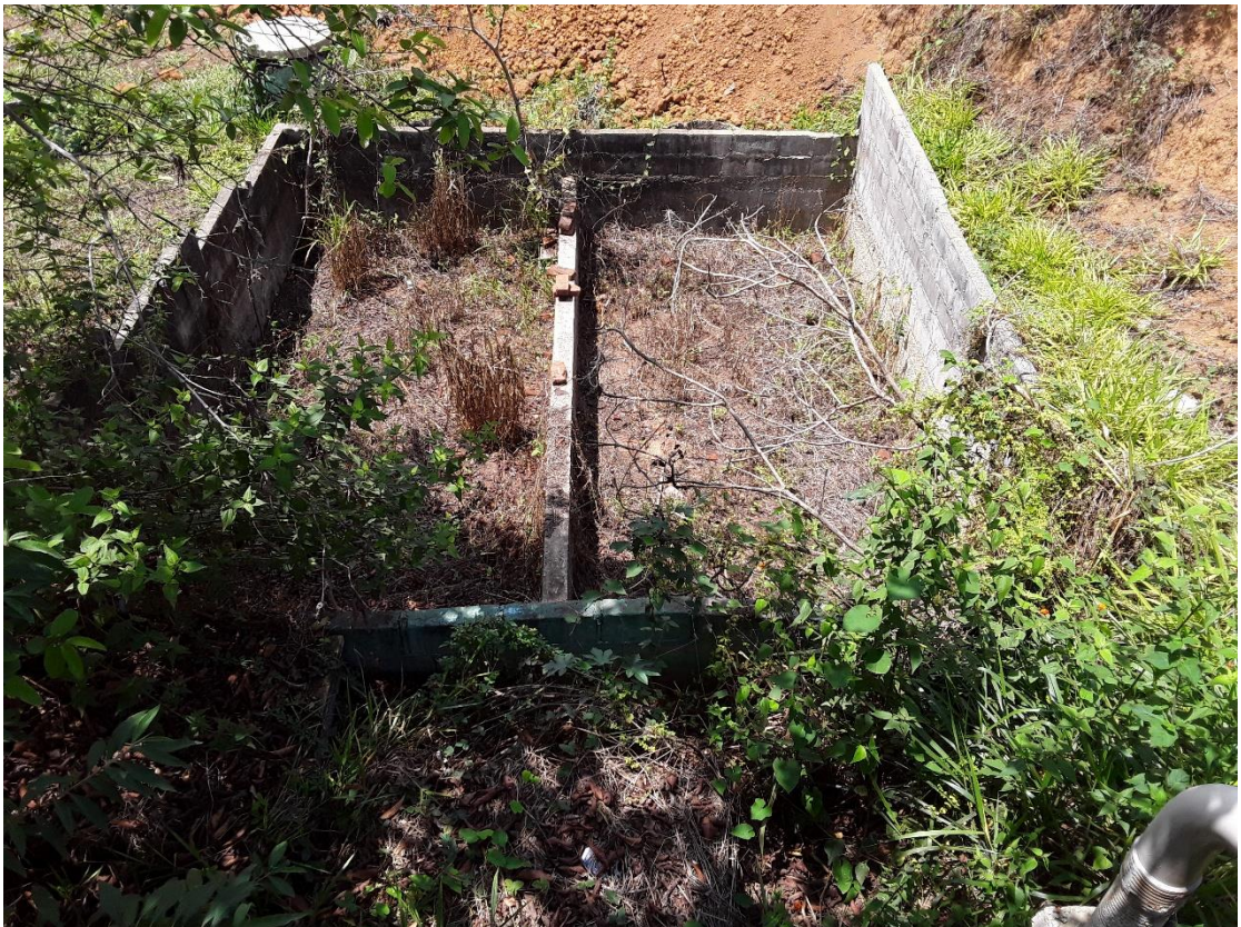
Figura 8- Leito de secagem da ETE.
