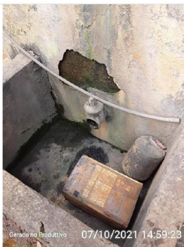
Gerado no Produtivo 07/10/2021 14:59:23 Tubo de descarga de fundo.
