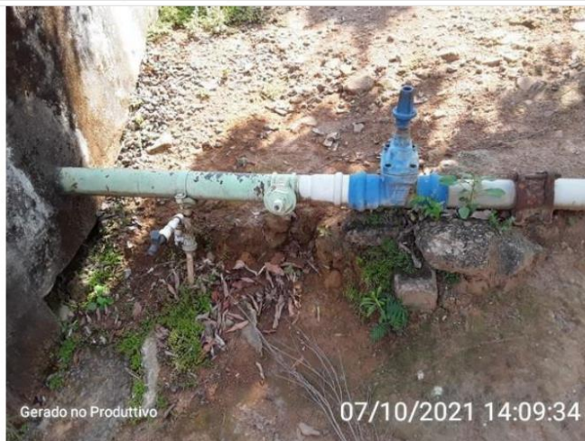
Válvula de fechamento na saída do reservatório.
