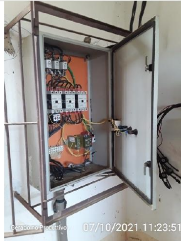
Quadro de comando.
