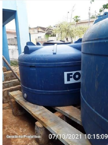
Reservatório de sulfato
