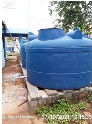
Reservatório de sulfato
