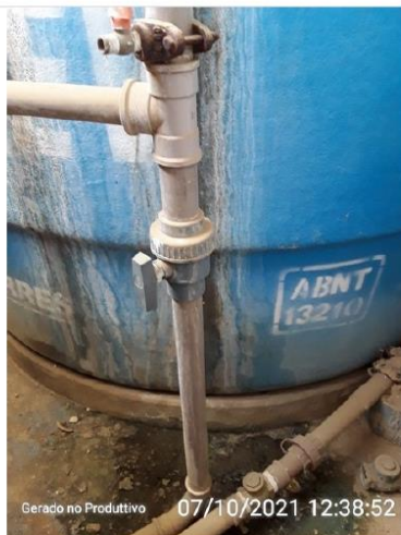
Vazamento no registro.
