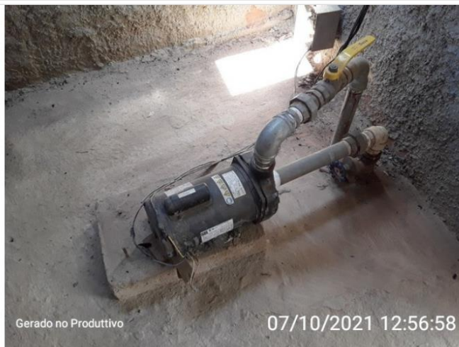
Conjunto motobomba existente na EEAT.
