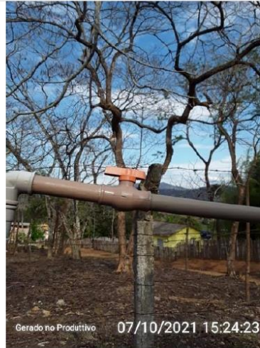
Válvula de fechamento na entrada do reservatório.
