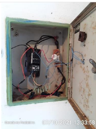
Condições dos cabos e fios elétricos no quadro de comando.
