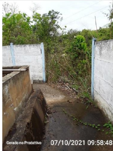
Cercamento incompleto, que permite livre acesso à área do desarenador.
