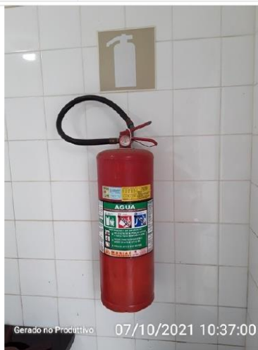
Extintor de incêndio.
