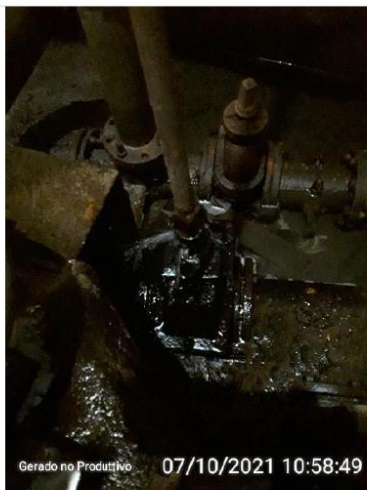
Válvula de fechamento na saída do reservatório (2).
