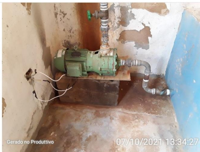
Conjunto motobomba utilizada na EE.
