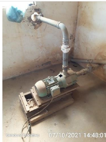
Conjunto moto-bomba existente.
