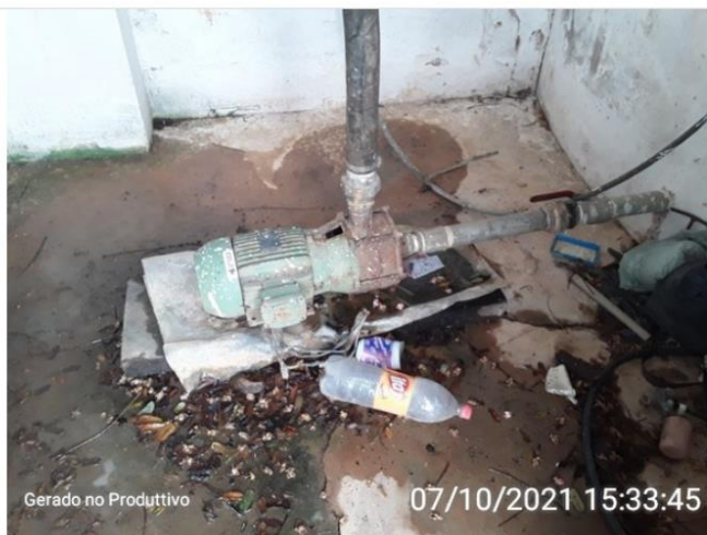
Conjunto motobomba da EEAT.
