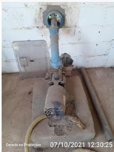
Conjunto motobomba existente na EEAT.
