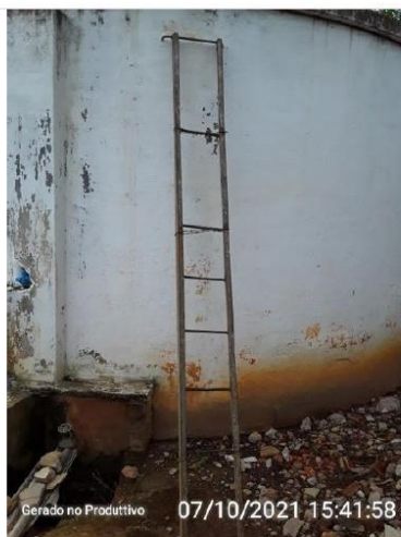
A escada existente não está em condições de uso.
