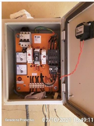
Quadro de comendo.
