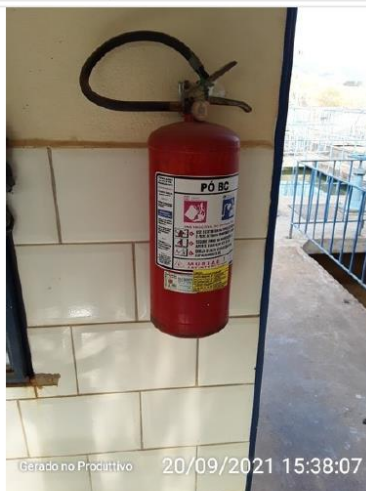
Extintor de incêndio
