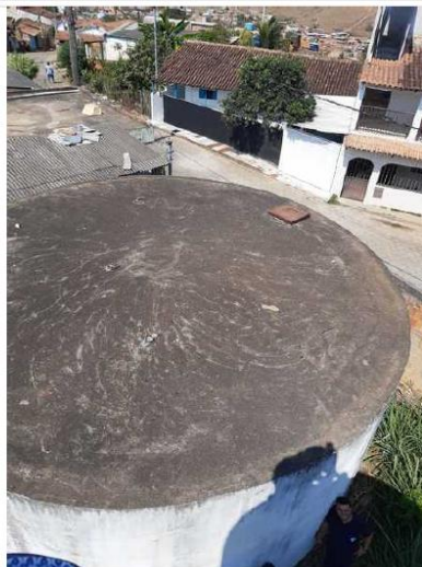
Cobertura do reservatório
