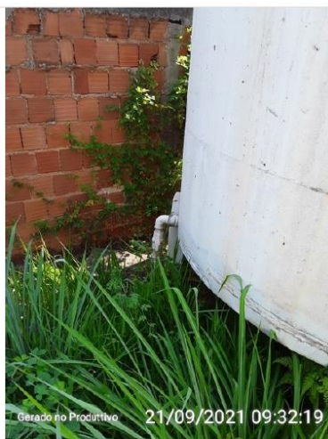
Caixa do registro de saída
