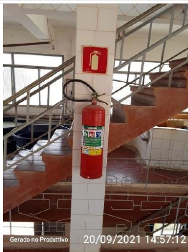
Extin tor de incêndio
