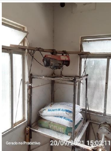
Elevador de produtos químicos
