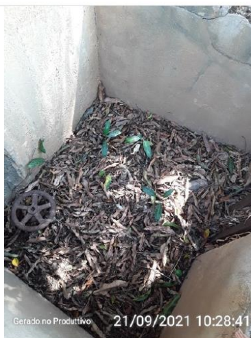
Descarga de fundo
