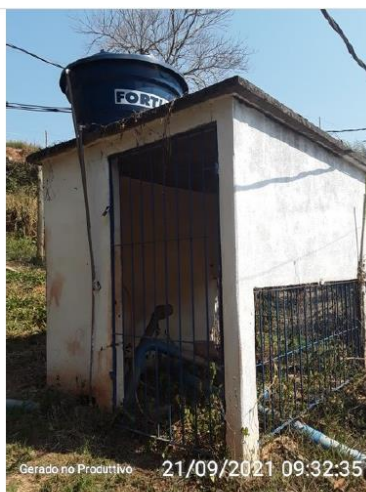
Local de instalação do conjunto motobomba
