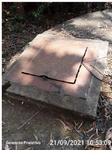
Tampa de inspeção
