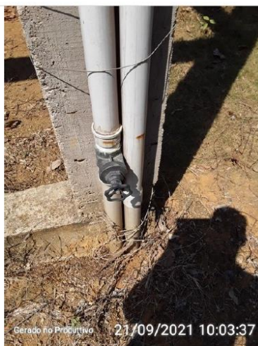
Registro na saída do reservatório
