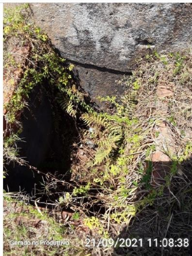
Descarga de fundo
