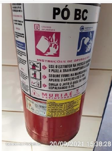
Extintor de incêndio
