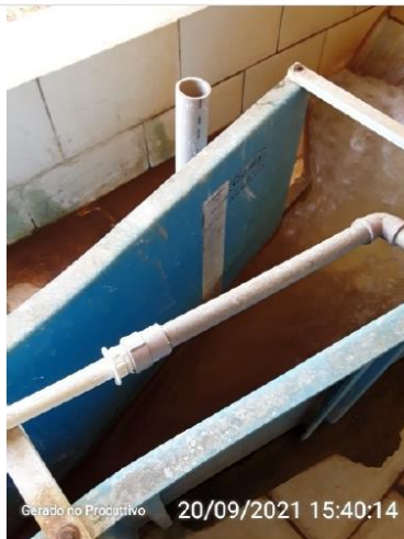
Régua na calha Parshall
