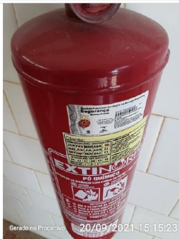
Extintor de incêndio
