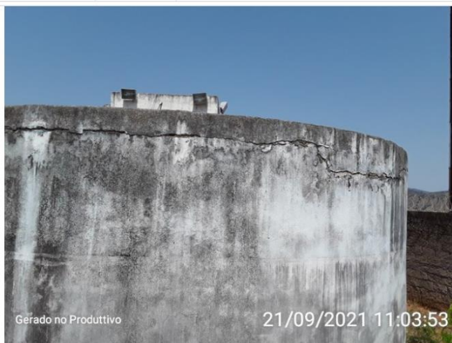
Cobertura do reservatório
