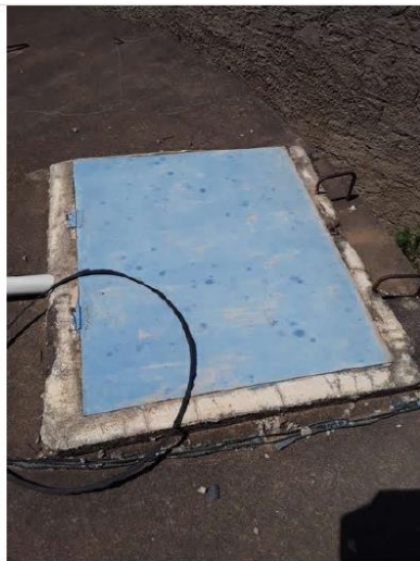
Tampa de inspeção
