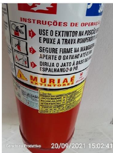
Extintor de incêndio
