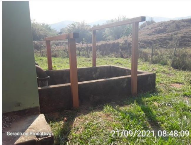
Poço de sucção
