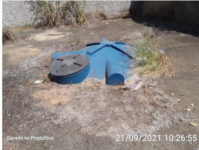
Reservatório de sucção
