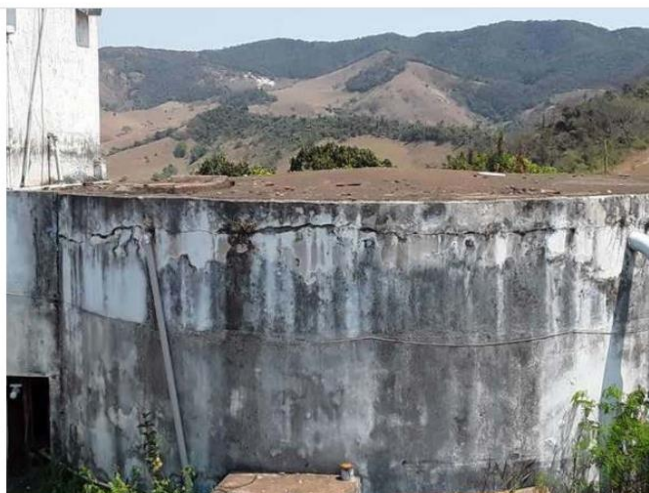
Cobertura do reservatório
