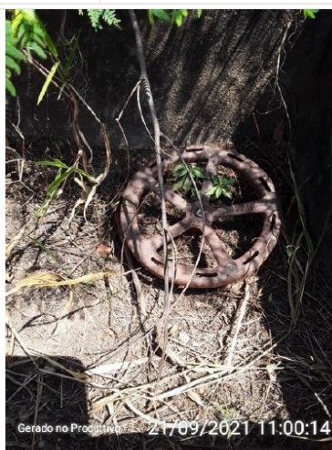
Válvula na saída do reservatório
