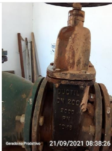
Vazamento na válvula
