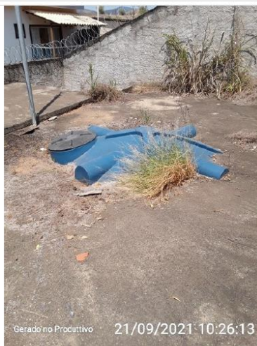
Reservatório de sucção
