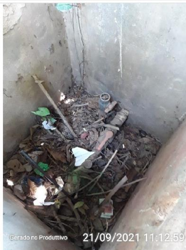
Registro de saída do reservatório
