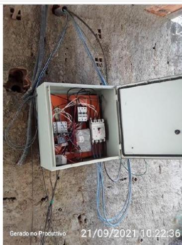
Quadro de comando
