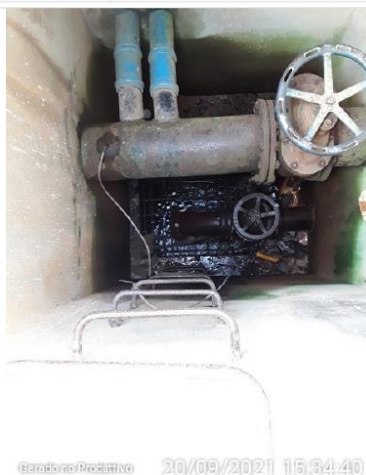
Descarga de fundo
