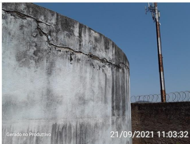
Rachadura na estrutura do reservatório
