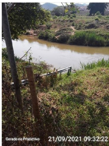
Captação no Rio José Pedro
