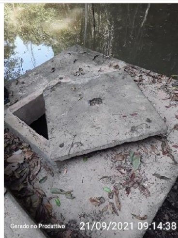
Caixa de passagem
