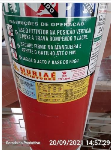
Extin tor de incêndio
