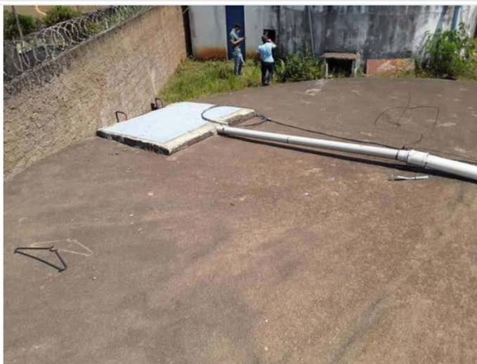
Cobertura do reservatório
