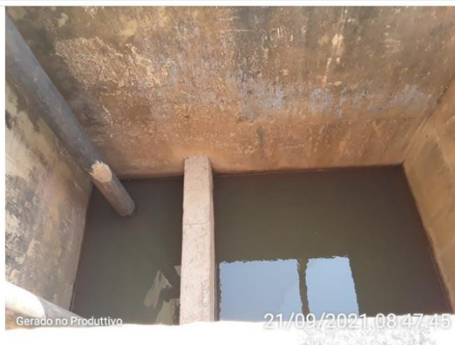
Poço de sucção
