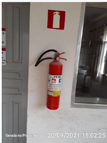
Extintor de incêndio
