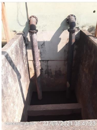
Poço de sucção
