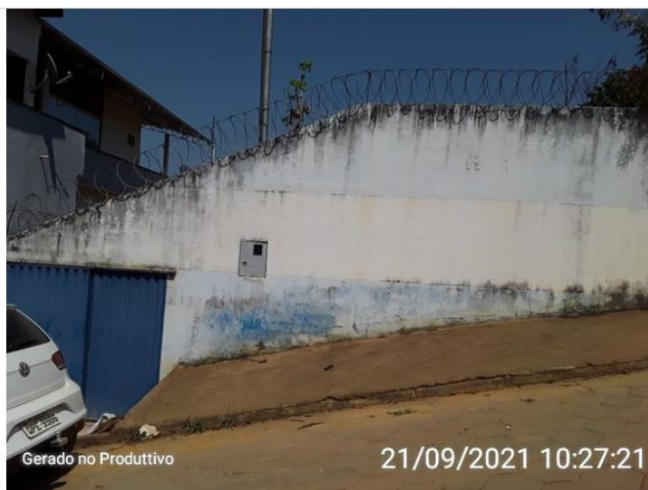
Área da estação elevatória
