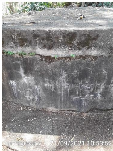
Rachadura na estrutura do reservatório
