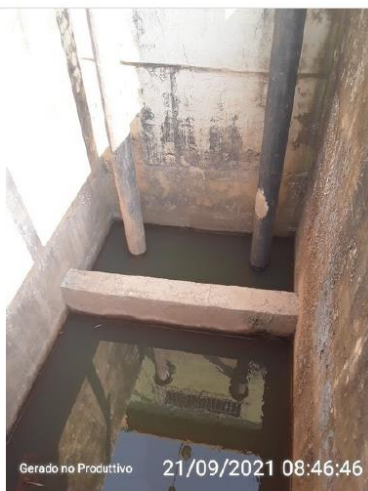
Poço de sucção
