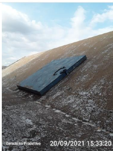
Tampa de inspeção
