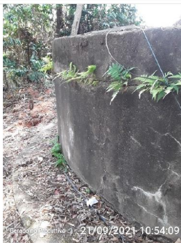
Rachadura na estrutura do reservatório
