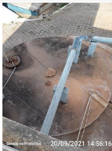
Tanque de contato
