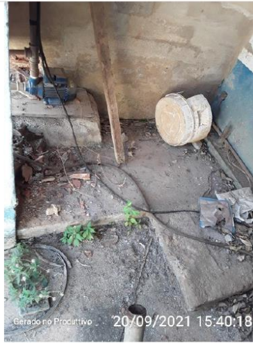
Casa de bomba
