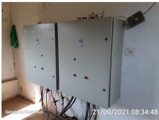
Painéis de controle
