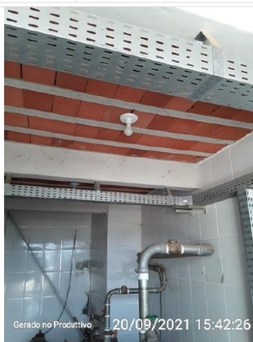
Iluminação na casa de bombas
