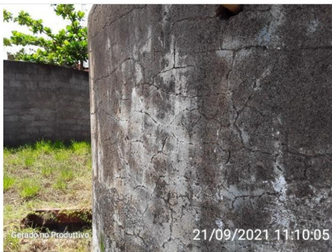
Rachaduras na estrutura do reservatório
