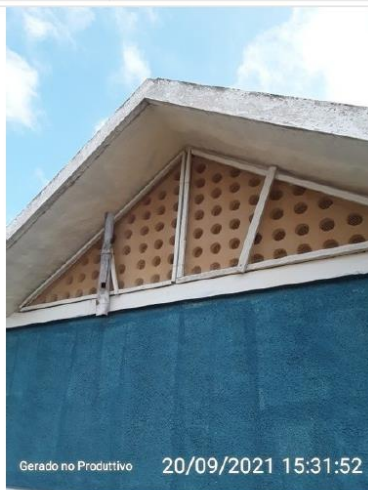
Estrutura de ventilação
