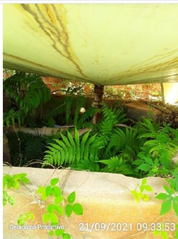
Tubo de descarga de fundo
