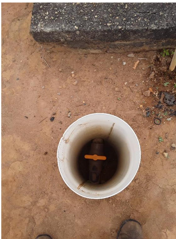
Figura 188 – Registro – Reservatório de Taquaral
