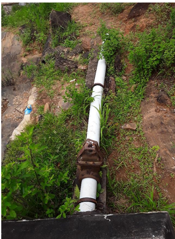
Figura 28 – Válvula na adutora de água bruta
