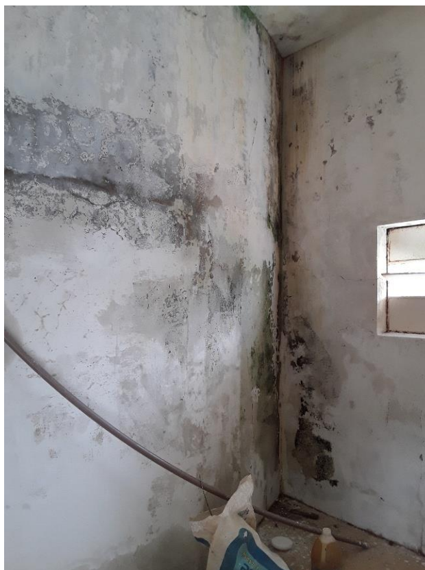
Figura 174 – Marcas de possíveis infiltrações
