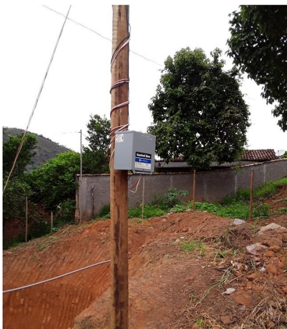
Figura 122 – Painel de controle
