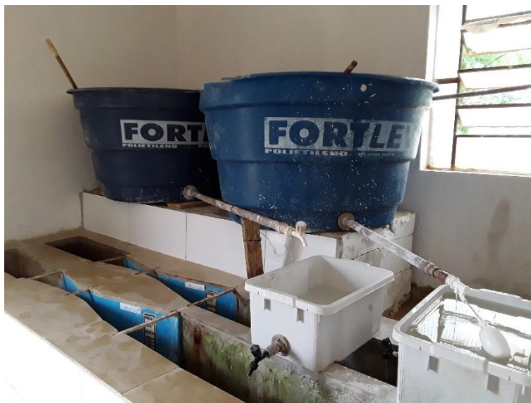
Figura 68 – Área de preparo e dosagem do sulfato de alumínio e a cal
