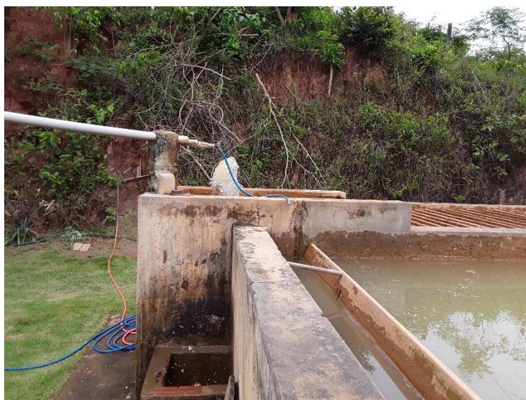
Figura 136 – Chegada da água na ETA
