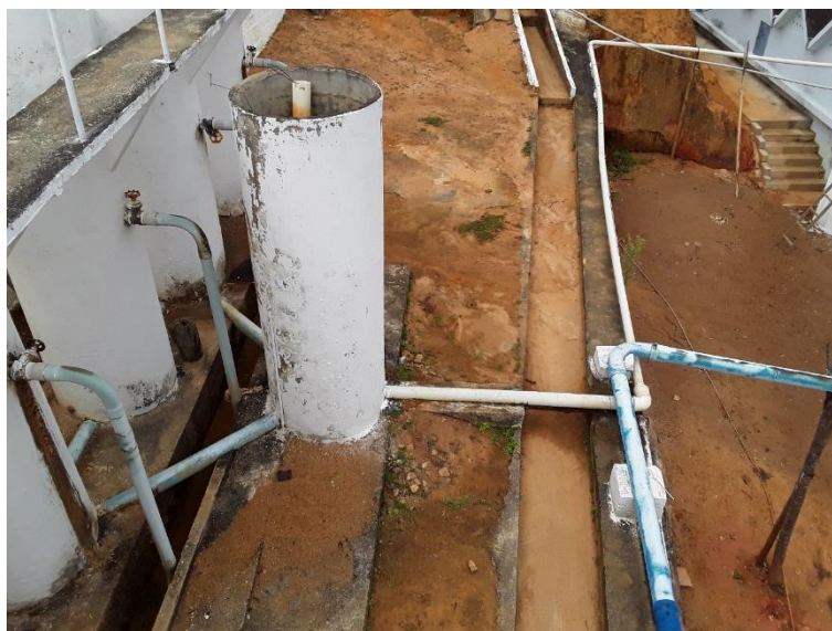
Figura 63 – Reservatório para retrolavagem
