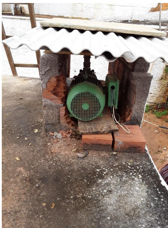
Figura 114 – Conjunto moto bomba
