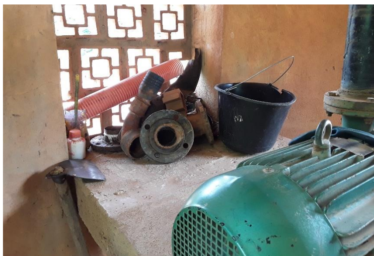
Figura 133 – Materiais na casa de bomba
