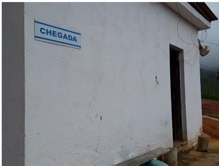
Figura 38 – Área de chegada da água bruta
