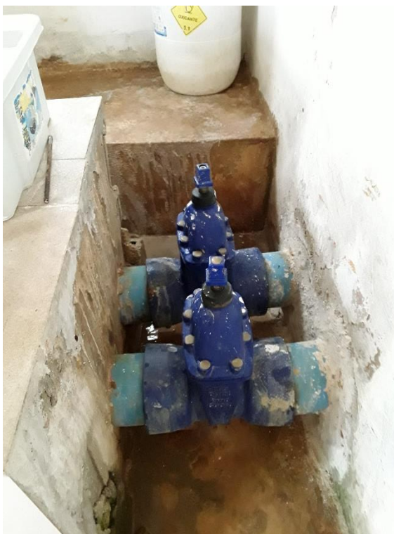
Figura 39 – Válvulas na entrada da ETA
