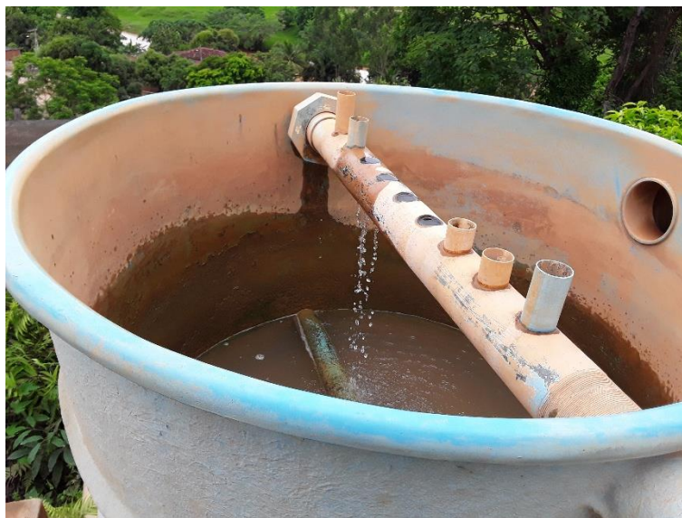
Figura 140 – Filtro em funcionamento
