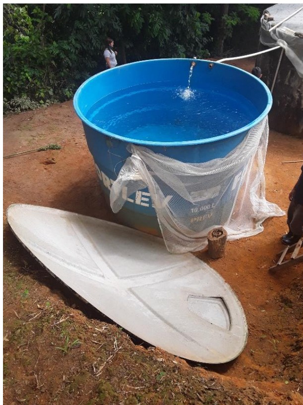
Figura 190 – Reservatório de Fibra de Vidro - Cachoeirão
