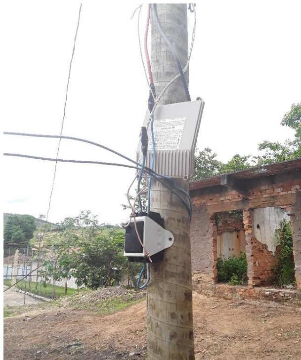
Figura 183 – Painel de controle do Poço II
