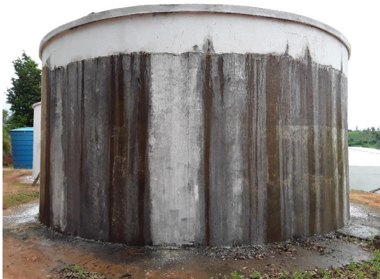
Figura 173 – Marcas de umidade
