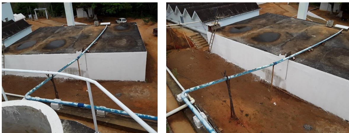
Figura 65 – Tubulação de água filtrada
