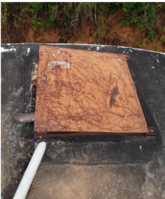
Figura 176 – Tampa de inspeção mantida aberta com pedaço de cano
