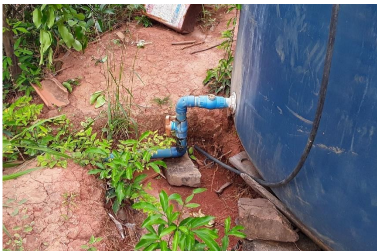
Figura 164 – Registro de saída do reservatório
