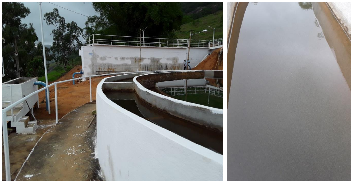
Figura 55 – Câmaras de floculação
