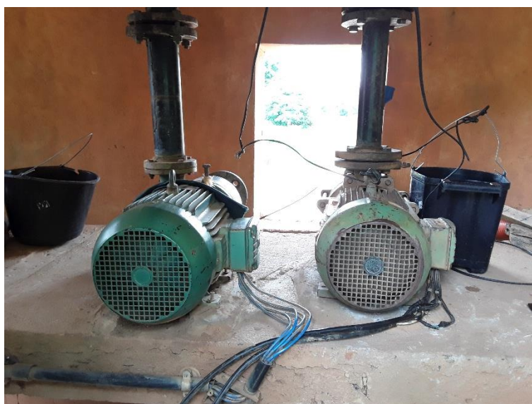
Figura 131 – Bomba em uso e reserva
