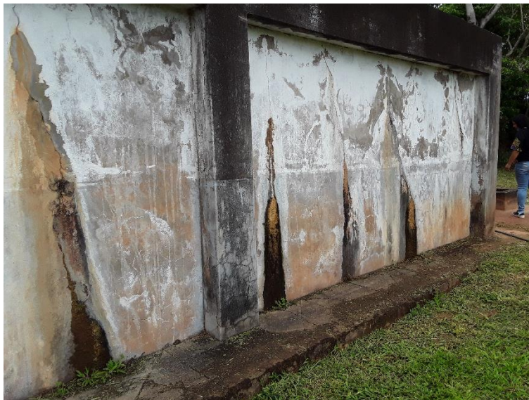
Figura 146 – Pontos de vazamento
