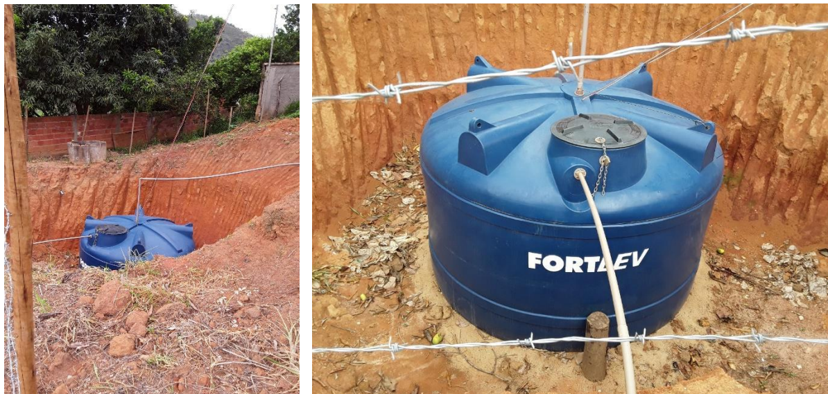
Figura 121 – Reservatório de sucção
