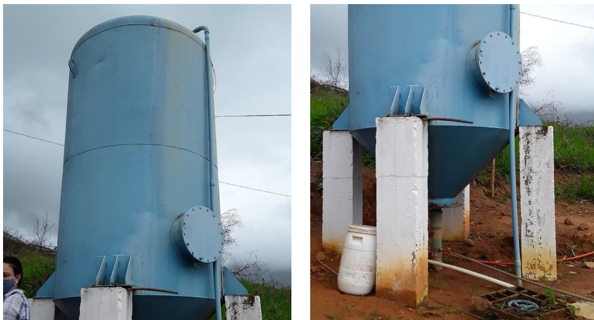
Figura 52 – Reservatório de água para lavagem dos filtros
