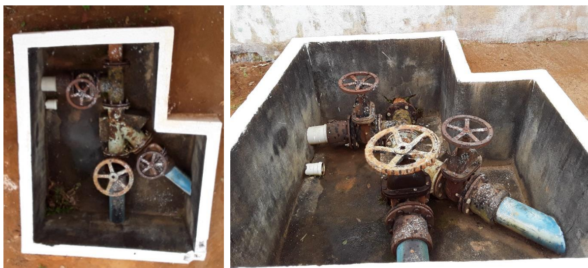
Figura 113 – Caixa de Válvulas
