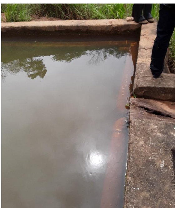
Figura 27 – Tubulação perfurada para captação de água
