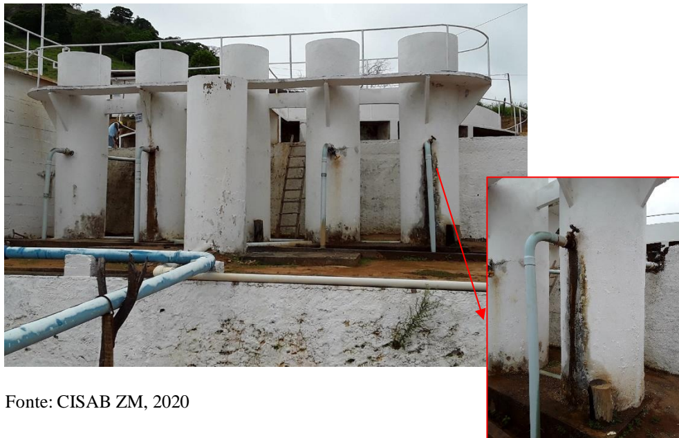
Figura 64 – Infiltração na tubulação de saída - Filtros
