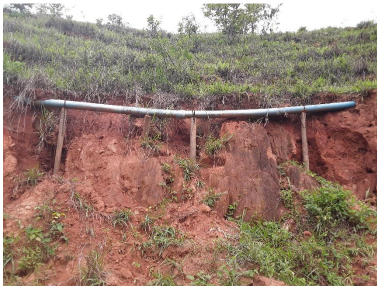
Figura 29 – Adutora de água bruta – Captação Córrego Bom Retiro
