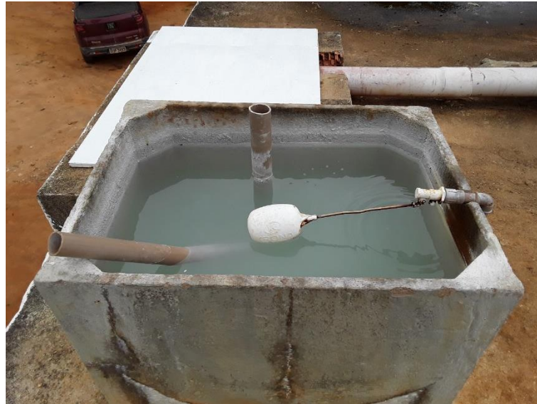
Figura 66 – Reservatório da solução de hipoclorito de cálcio
