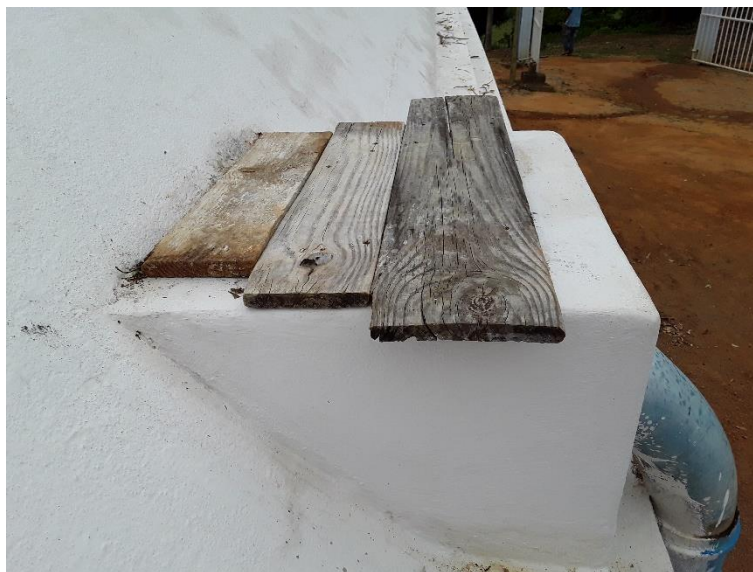
Figura 118 – Tampa de inspeção
