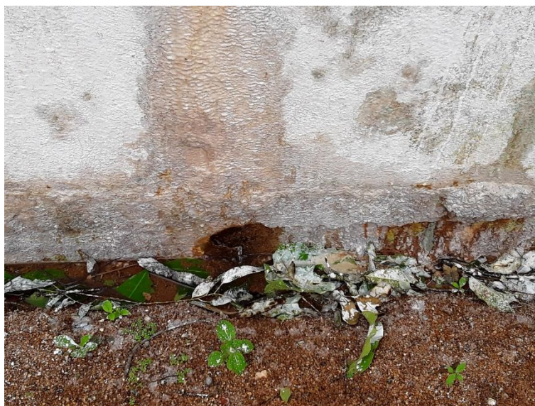
Figura 109 – Vazamento na base do reservatório
