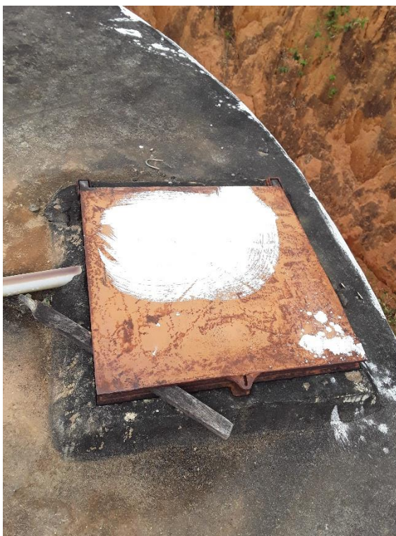
Figura 175 – Tampa de inspeção mantida aberta com pedaço de madeira
