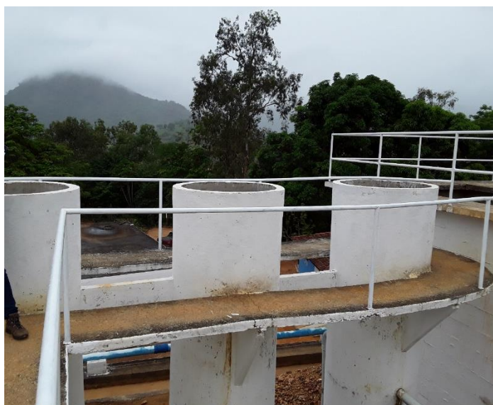
Figura 60 - Área dos filtros
