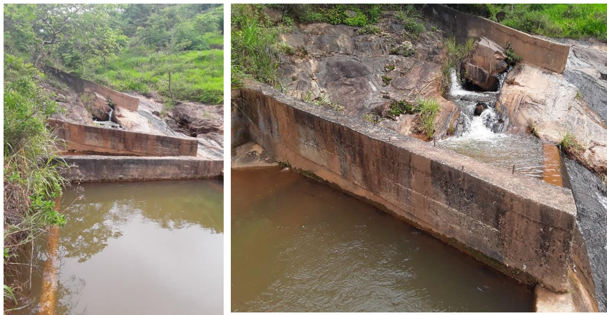
Figura 24 – Captação Córrego Bom Retiro
