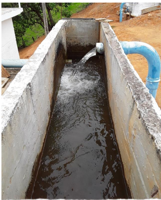
Figura 48 – Canaleta de distribuição para os filtros
