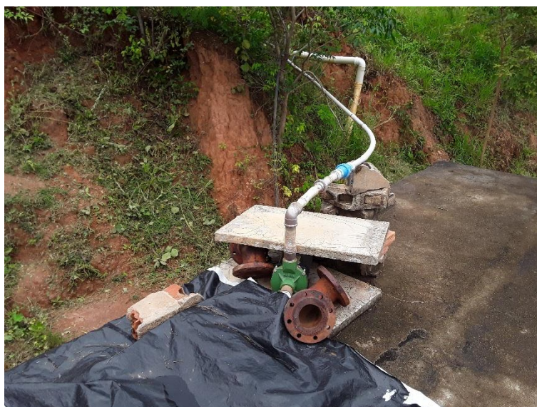
Figura 145 – Proteção inadequada da bomba
