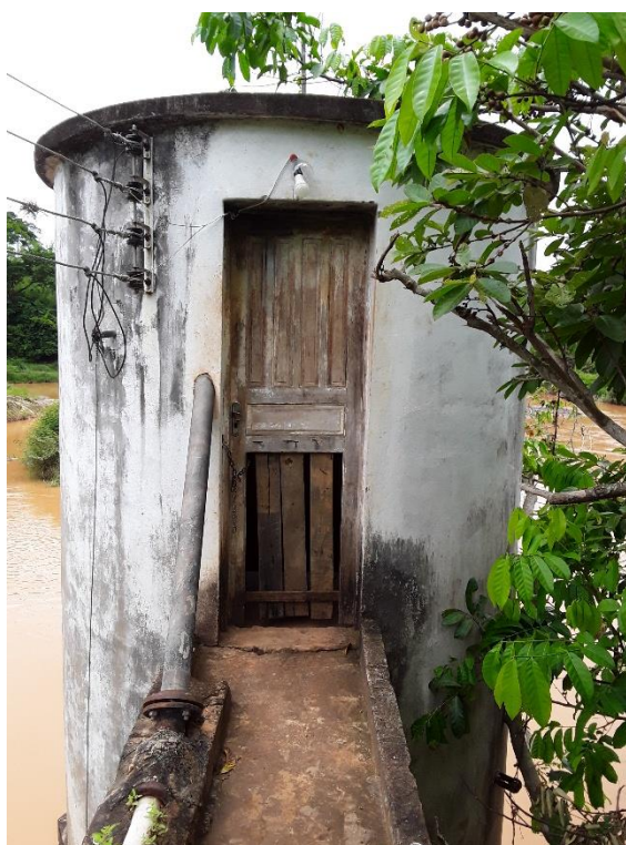
Figura 129 – Casa de bombeamento para captação e adução
