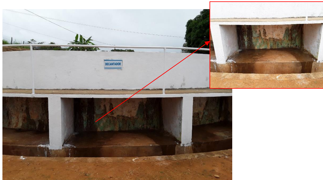
Figura 58 – Decantador – Pontos de infiltração
