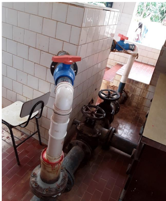
Figura 96 – Válvulas e registros
