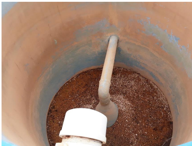
Figura 141 – Filtro fora de operação
