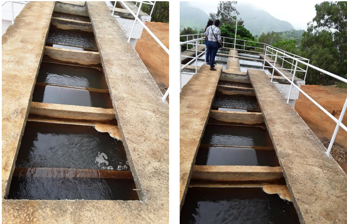
Figura 45 – Câmaras de Floculação
