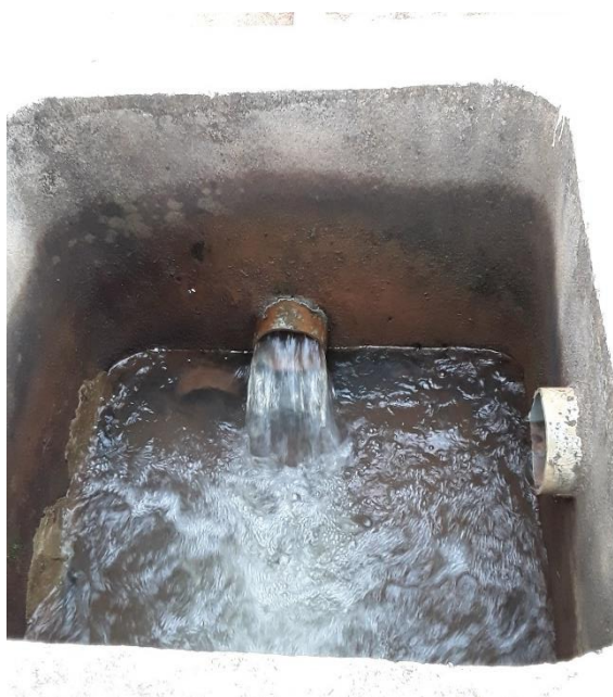
Figura 37 – Caixa de chegada da água bruta
