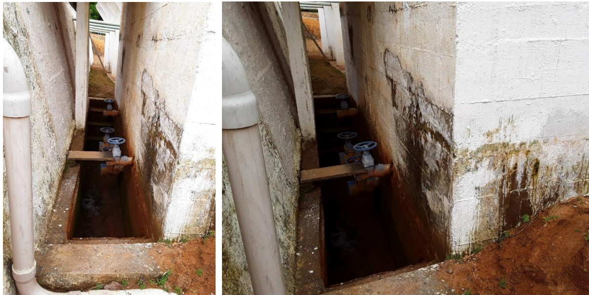
Figura 51 – Válvulas de descarga dos Filtros
