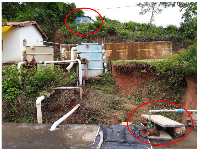
Figura 144 – Bombeamento e reservatório da ETA
