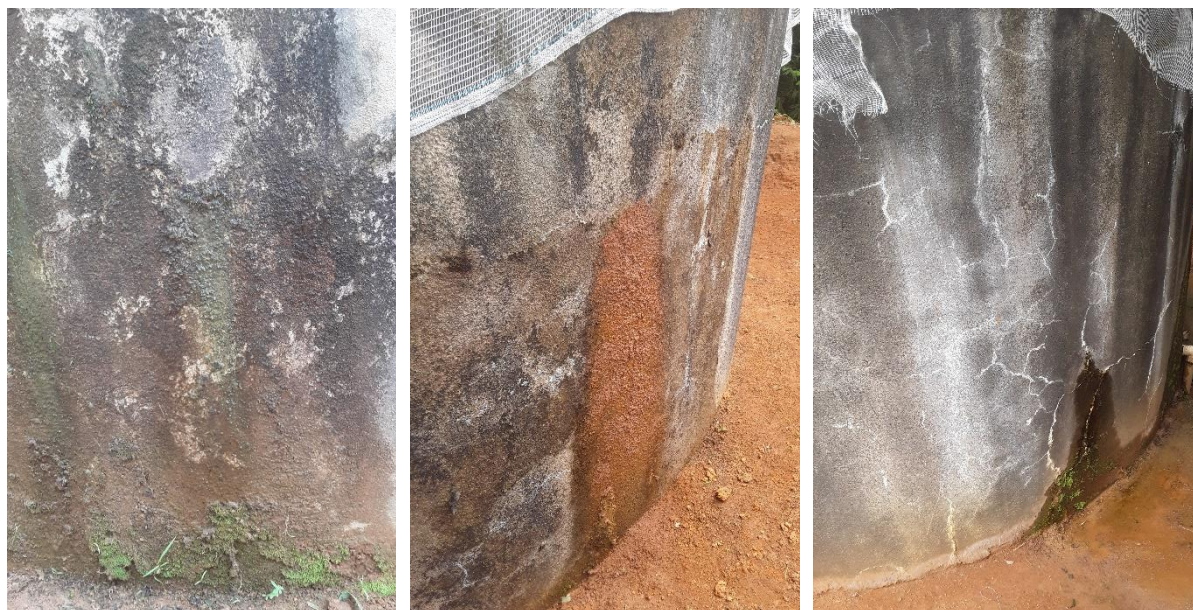
Figura 193 – Infiltração no reservatório de concreto
