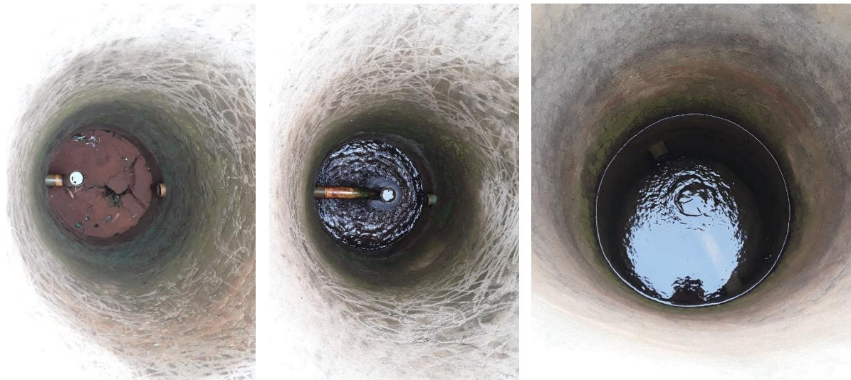
Figura 62 – Vista interna dos filtros
