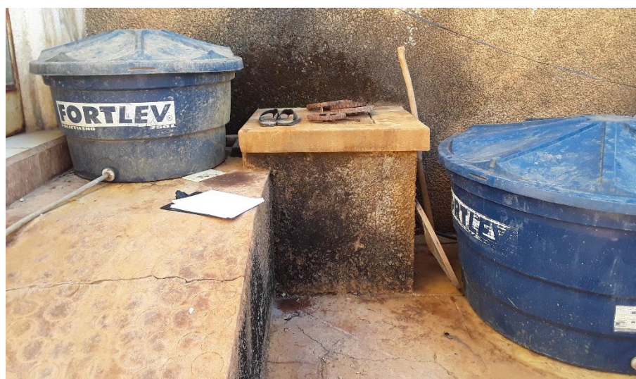
Figura 50 - Depósitos de sulfato de alumínio
