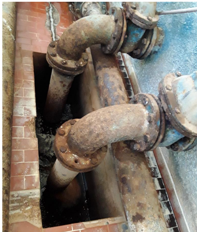
Figura 46 – Descarga dos filtros
