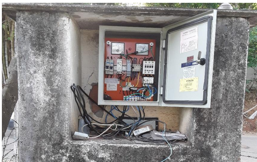
Figura 90 – Quadro e cabos elétricos
