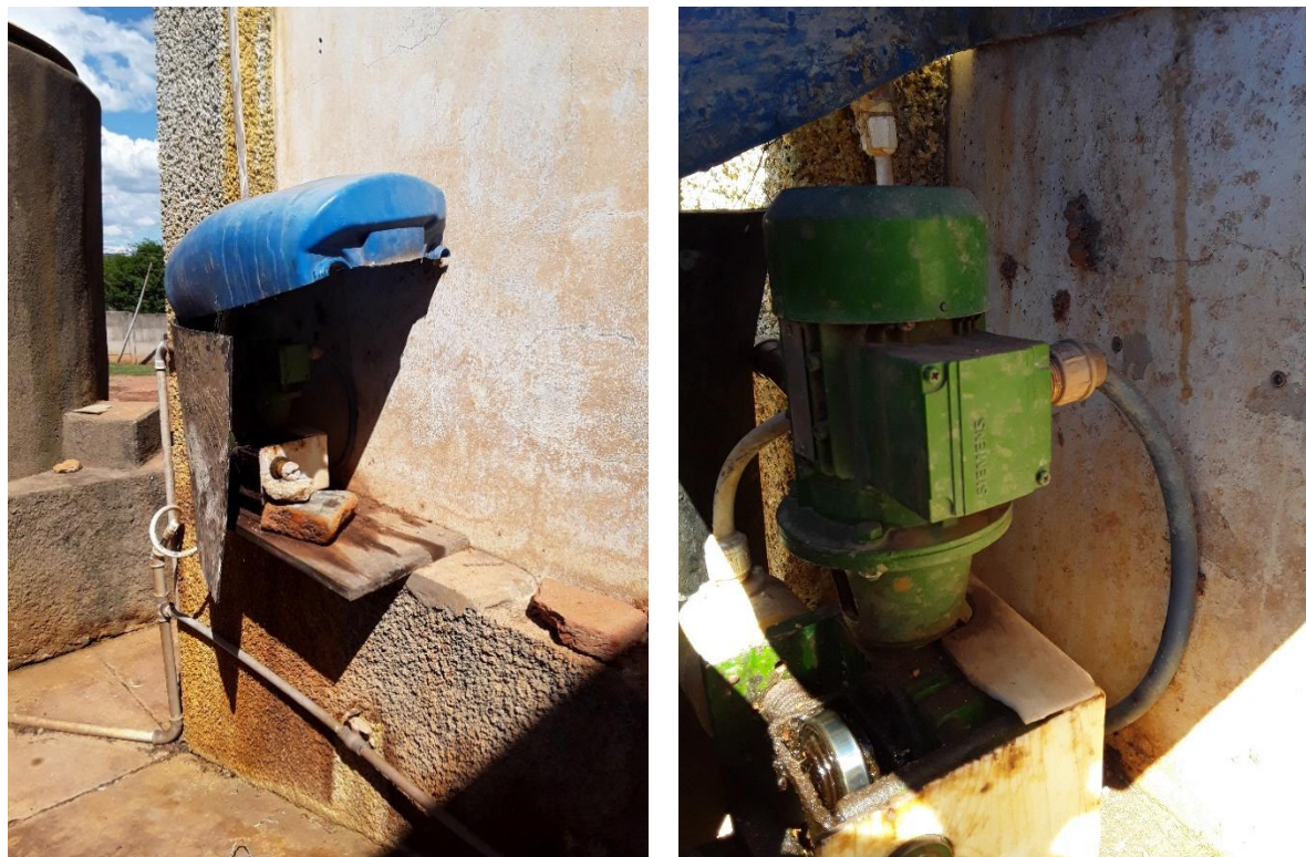
Figura 52 – Bomba dosadora – Sulfato de alumínio
