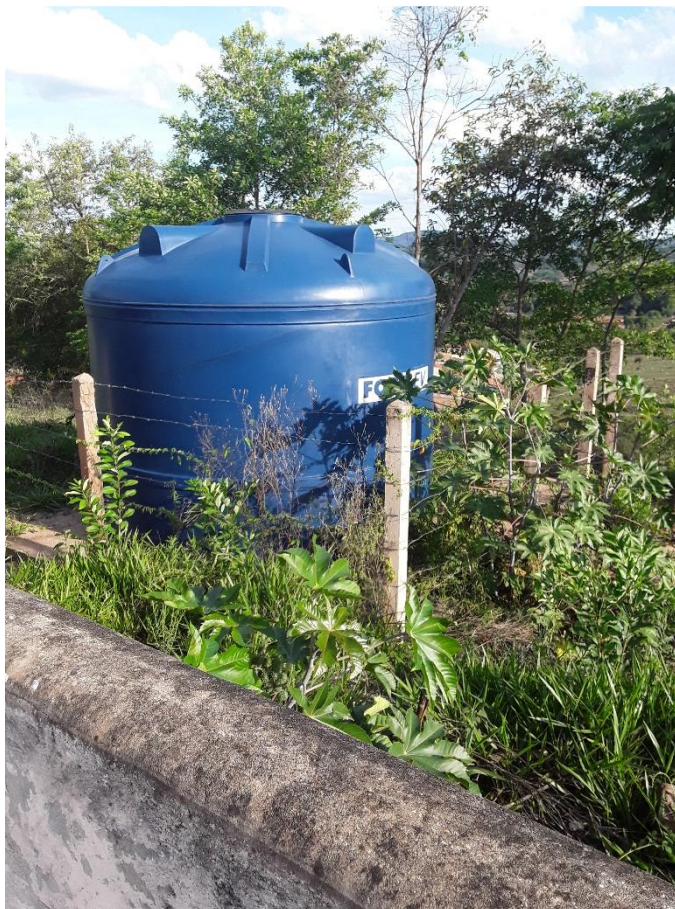
Figura 96 – Reservatório Santa Matilde
