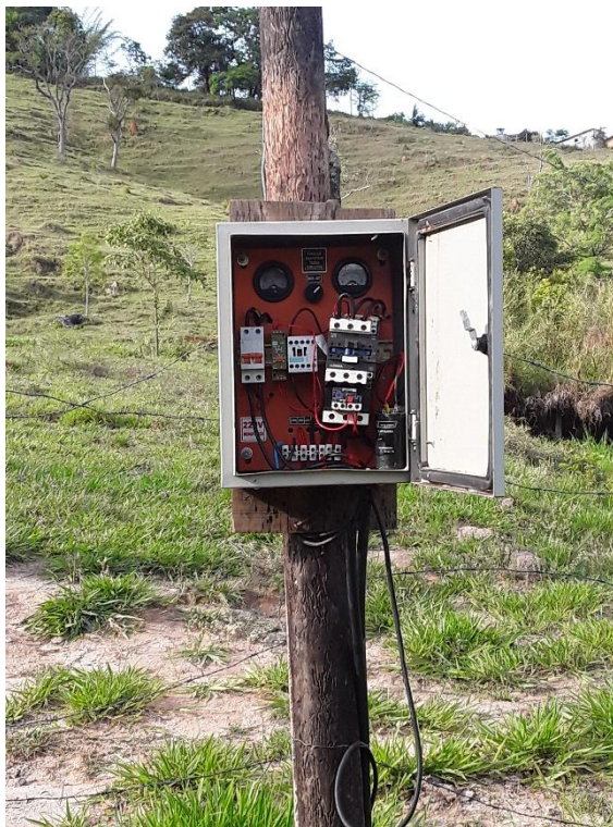
Figura 95 – Quadro e cabos elétricos
