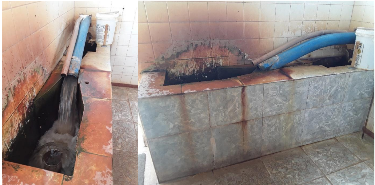
Figura 23 – Chegada da água Bruta – Calha Parshall
