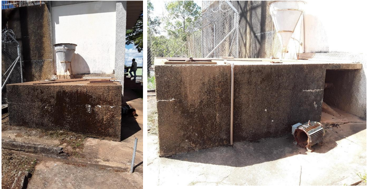
Figura 34 – Tanque de contato
