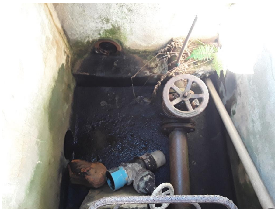
Figura 38 – Caixa de descarga
