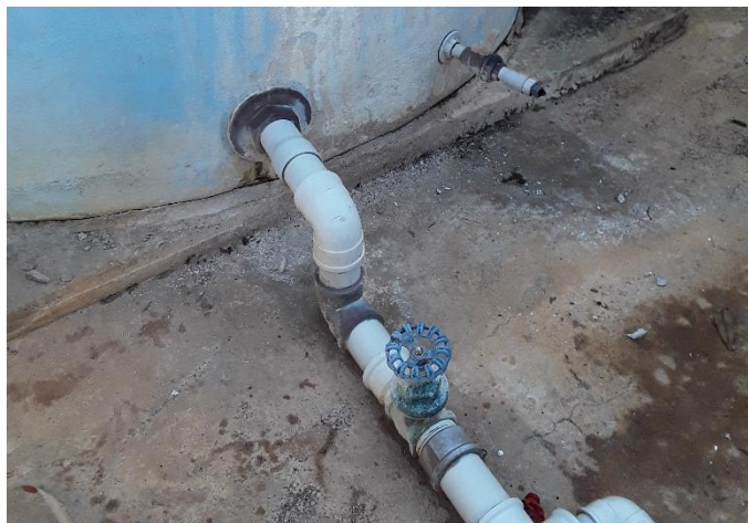
Figura 86 – Registro de saída
