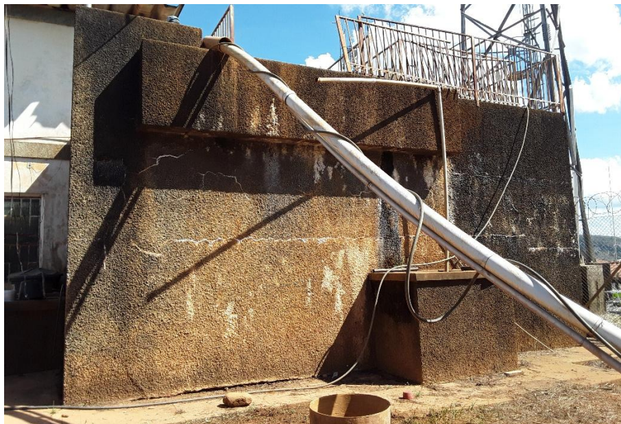
Figura 28 – Vista lateral da área de tratamento
