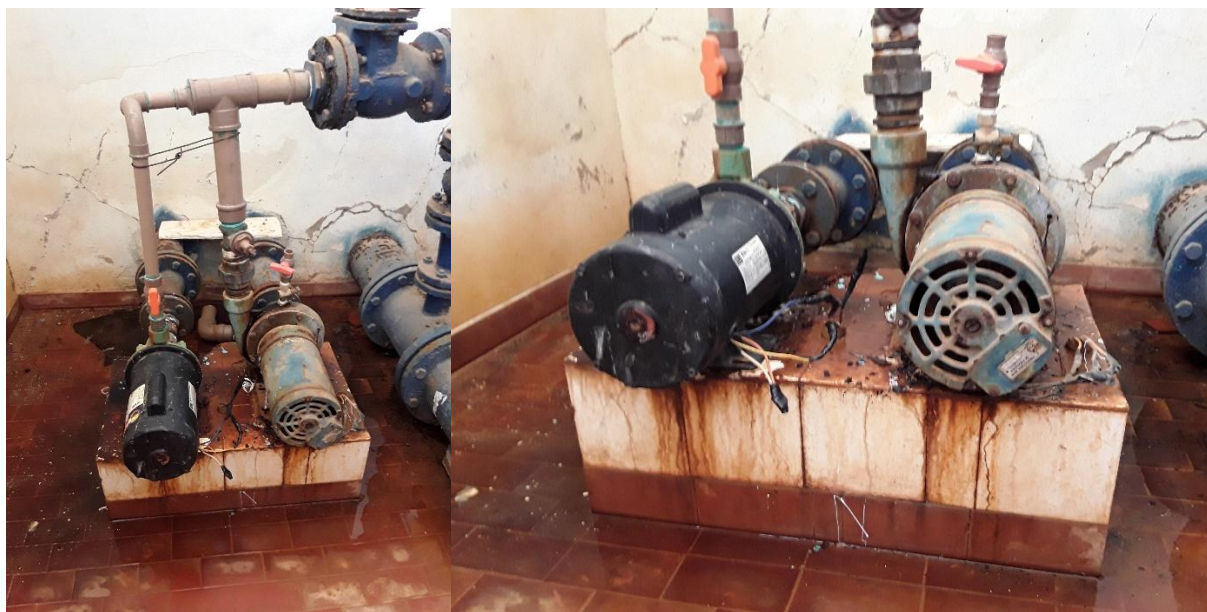
Figura 47 – Conjunto Moto Bomba
