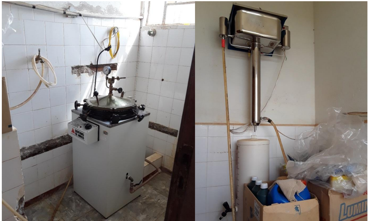
Figura 69 – Autoclave e Destilador
