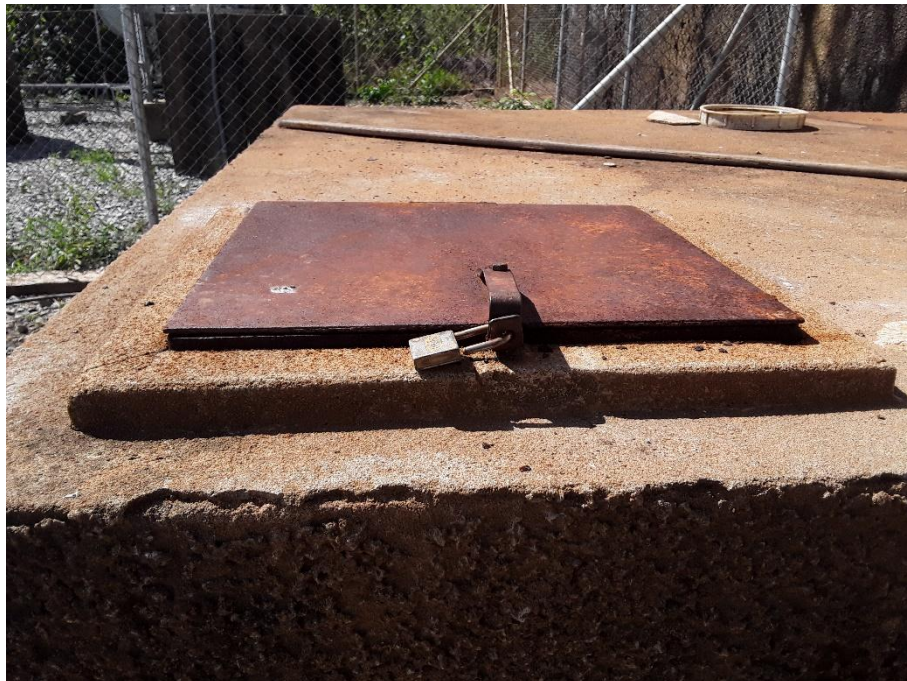
Figura 35 – Tampa de inspeção do tanque de contato
