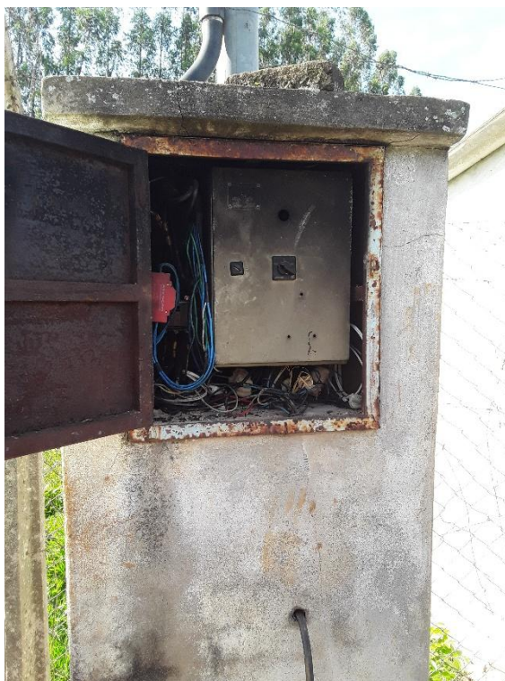
Figura 80 – Quadro e cabos elétricos em condições precárias
