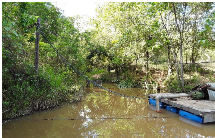
Figura 18 – Fiação da bomba
