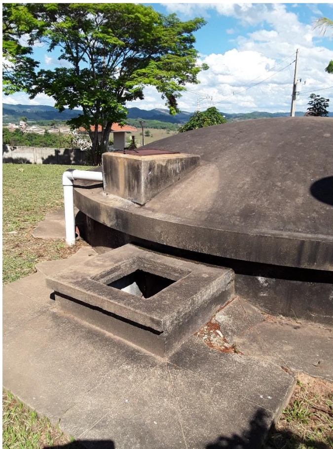
Figura 39 – Tampa de inspeção
