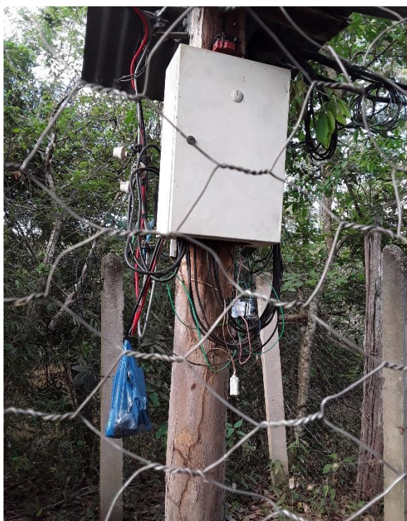
Figura 19 – Painel de controle da bomba
