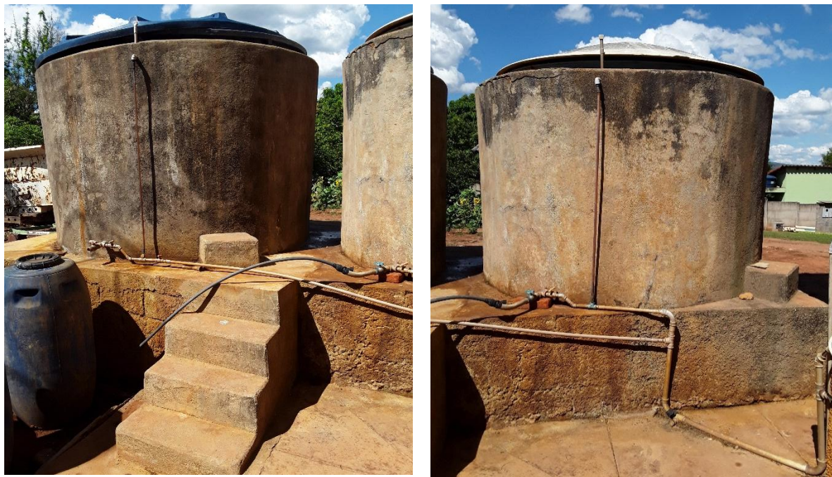
Figura 49 – Depósitos de sulfato de alumínio
