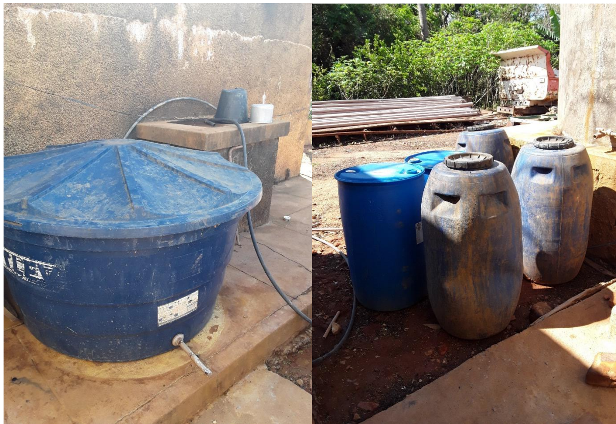
Figura 51 – Depósitos de sulfato de alumínio
