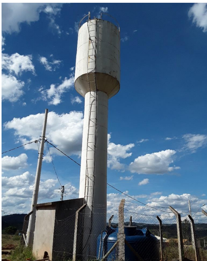
Figura 91 – Reservatório Casas Populares
