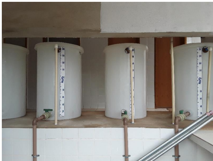
Figura 52 – Recipientes para dosagem dos produtos químicos
