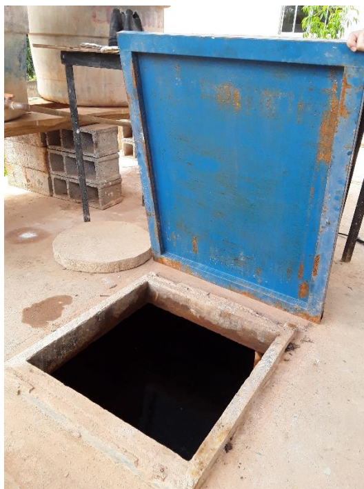
Figura 36 – Tanque de contato
