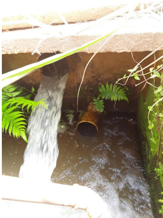
Figura 27 – Chegada da água bruta
