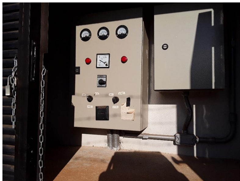
Figura 70 - Quadro de energia EEAT Boa Vista
