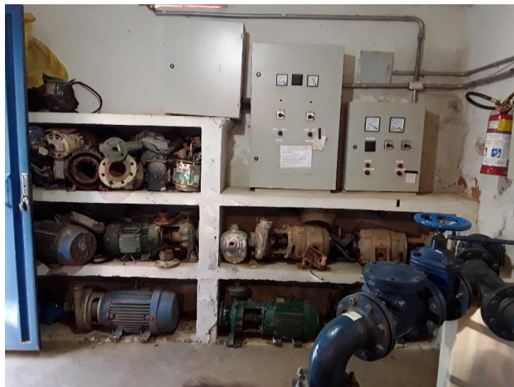
Figura 71 - Local de depósito das bombas fora de funcionamento
