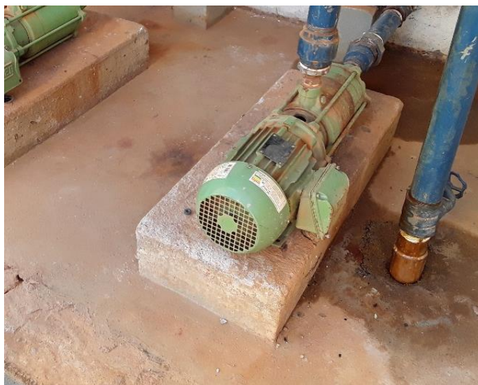
Figura 73 - Pequeno vazamento Booster Alto Samambaia
