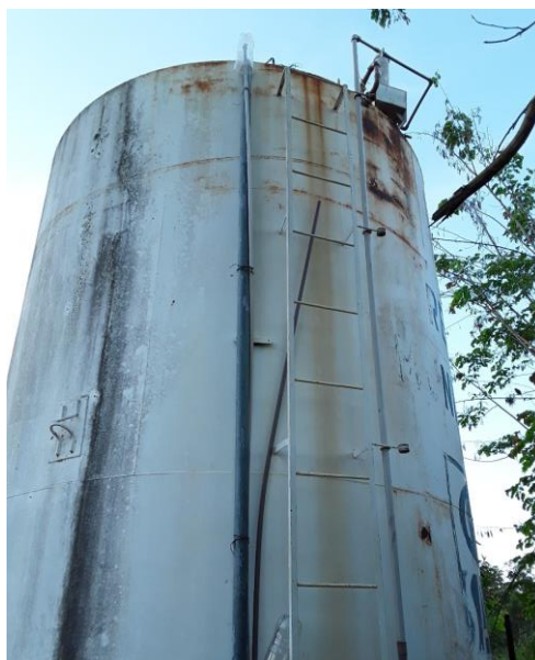
Figura 86 – Reservatório – Povoado Grama
