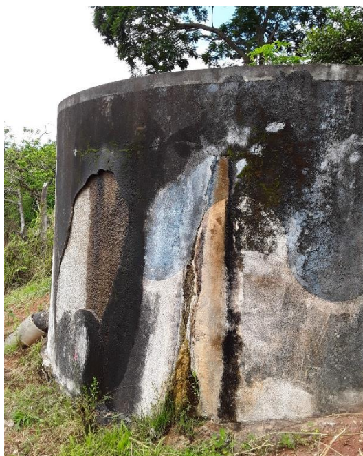
Figura 38 – Vazamentos no reservatório para armazenamento de água de lavagem dos filtros
