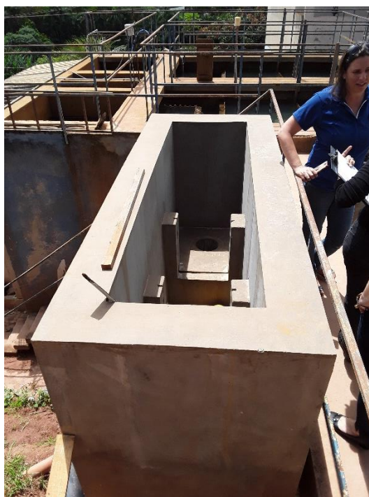
Figura 32 – Caixa de passagem para os floculadores
