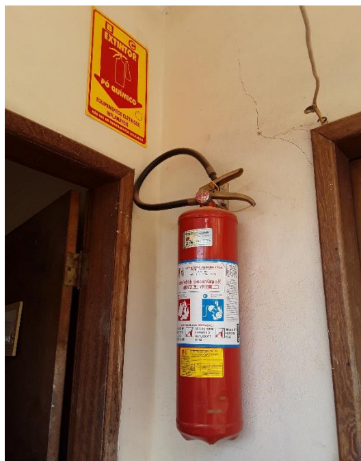
Figura 44 – Extintor de incêndio na entrada do depósito de produtos químicos
