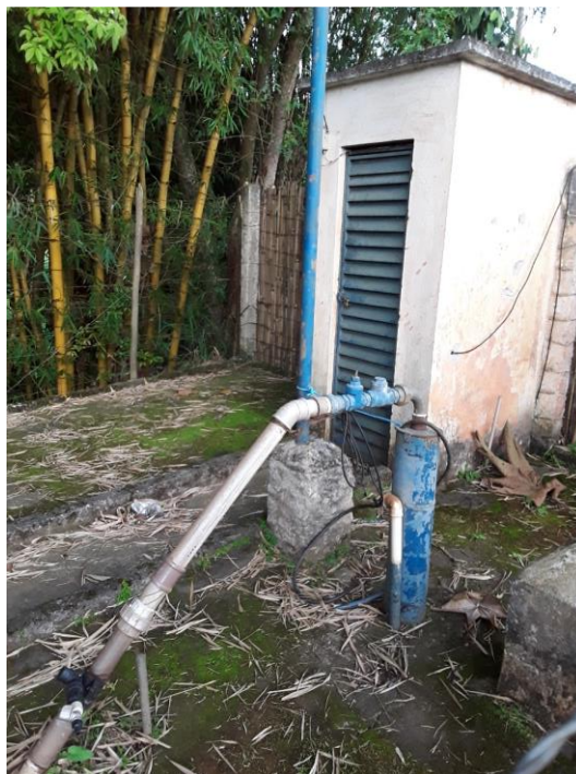
Figura 83 – Captação subterrânea – Povoado Grama
