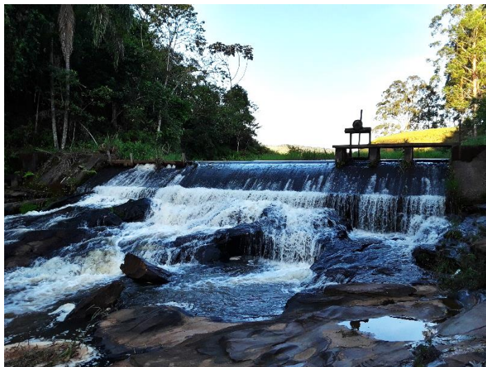
Figura 24 – Captação de água
