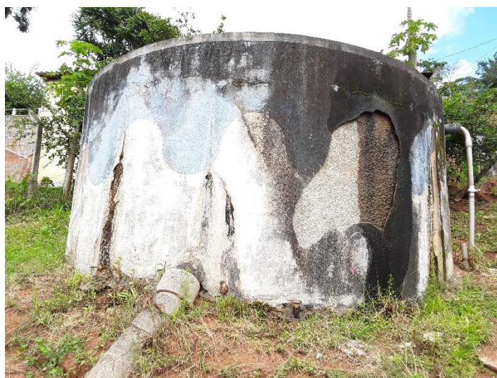
Figura 39 – Reservatório para armazenamento de água de lavagem dos filtros
