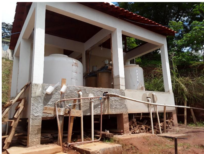
Figura 51 – Plataforma de preparo dos produtos químicos
