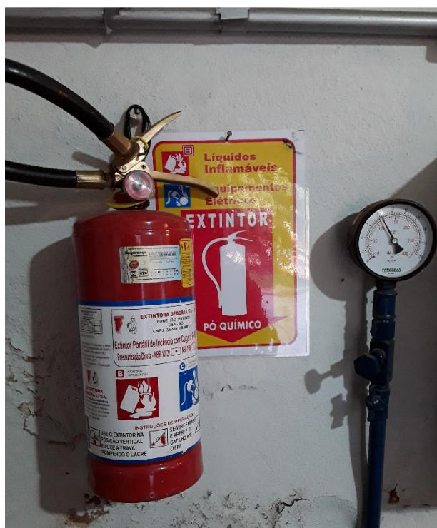
Figura 78 - Extintor na EEAT Central
