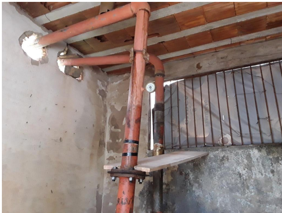
Figura – Apoio improvisado na tubulação de recalque
