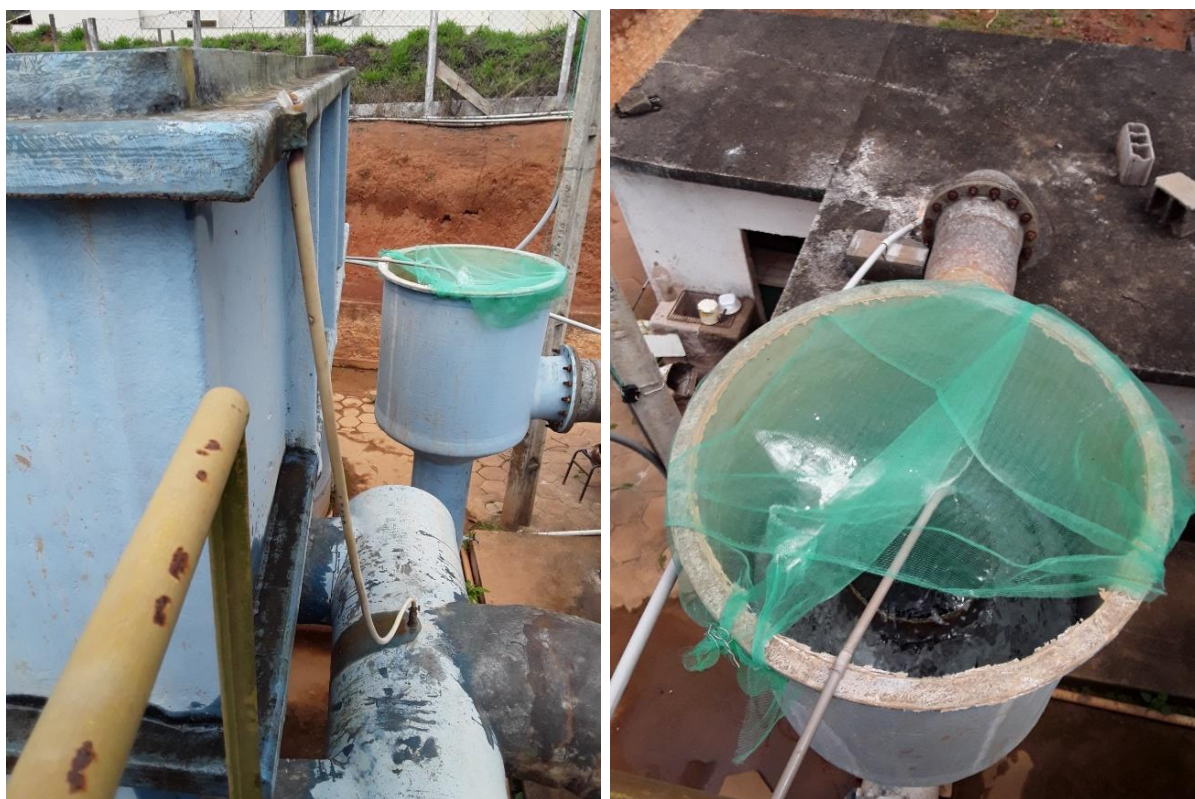
Figura – Local de adição do hipoclorito de cálcio
