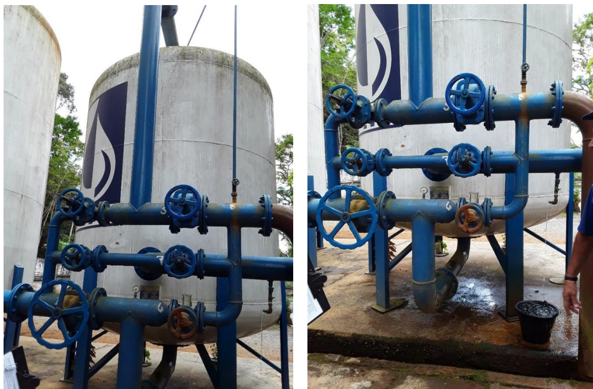
Figura – Filtro Pressurizado e válvulas
