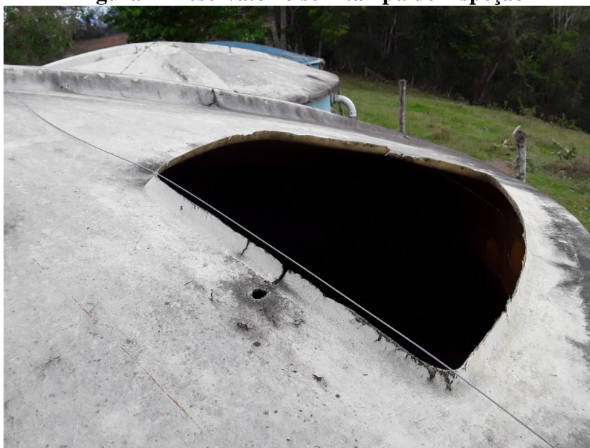
Figura – Reservatório sem tampa de inspeção
