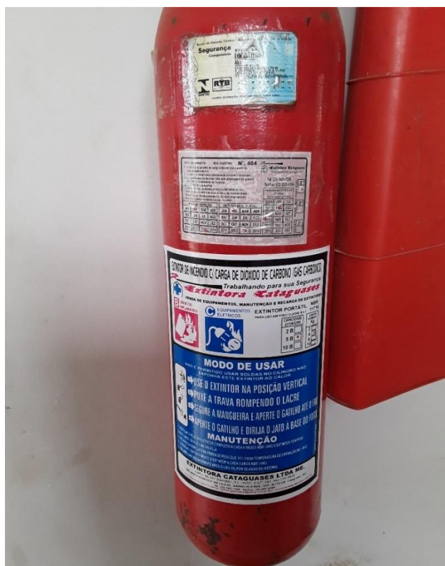
Figura – Extintor de incêndio
