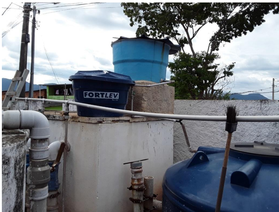
Figura – Área de armazenamento da solução de hipoclorito de cálcio
