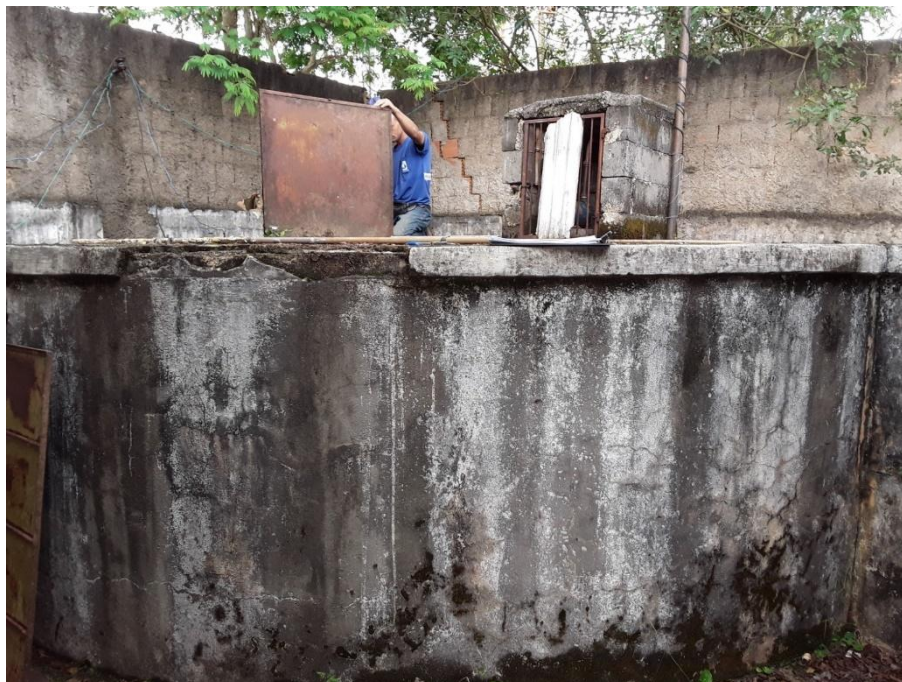
Figura – Reservatório de sucção
