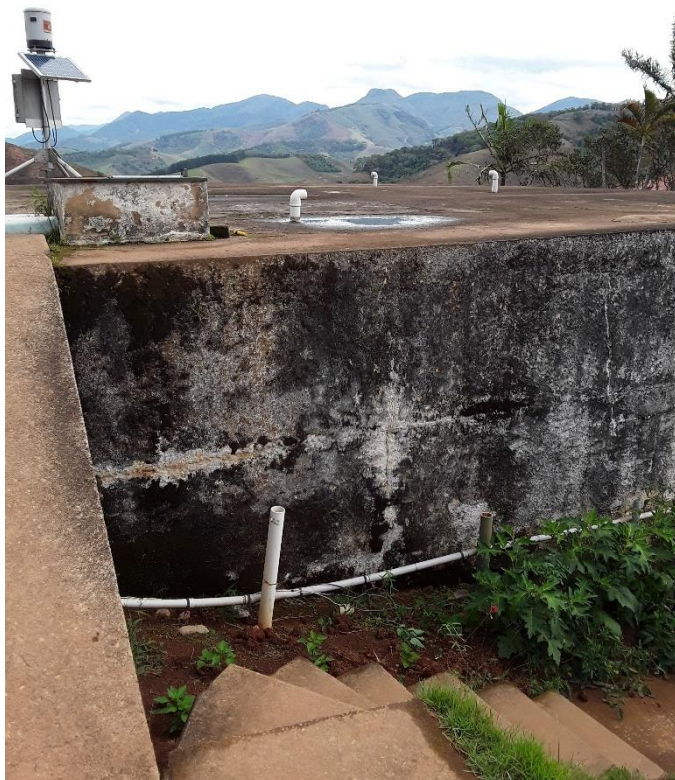
Figura – Reservatório ETA - Cantamissa
