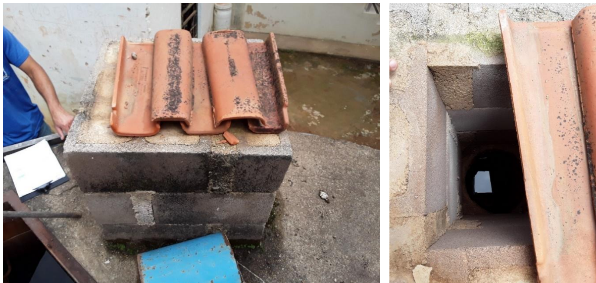
Figura – Estrutura elevada no reservatório com cobertura inadequada
