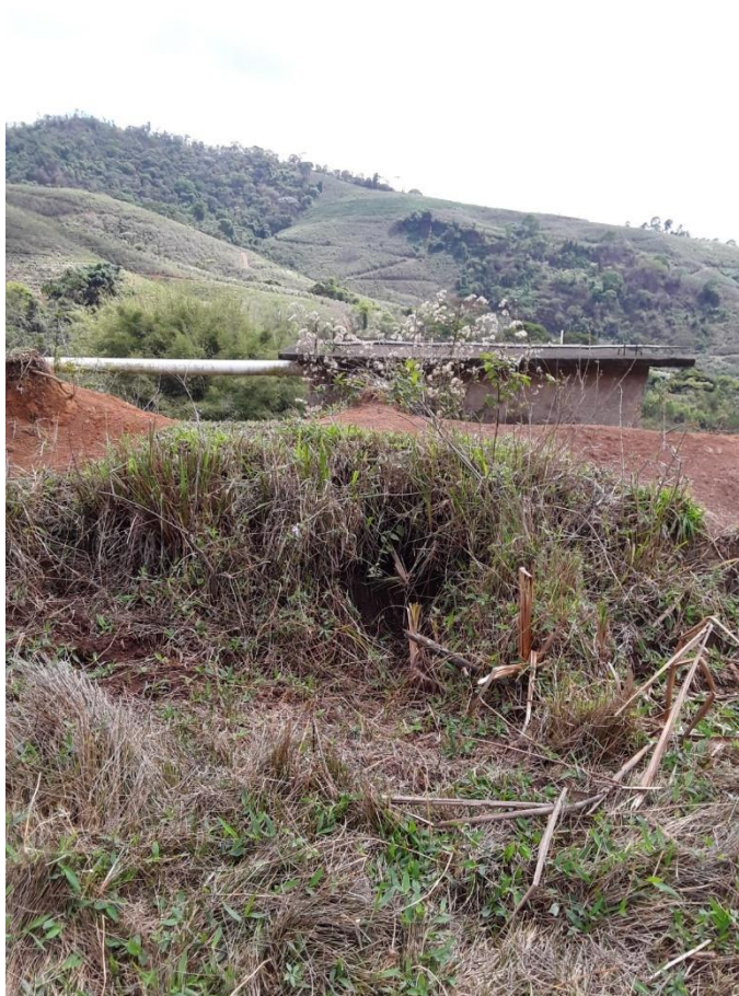
Figura – Tubo extravasor do reservatório de água bruta
