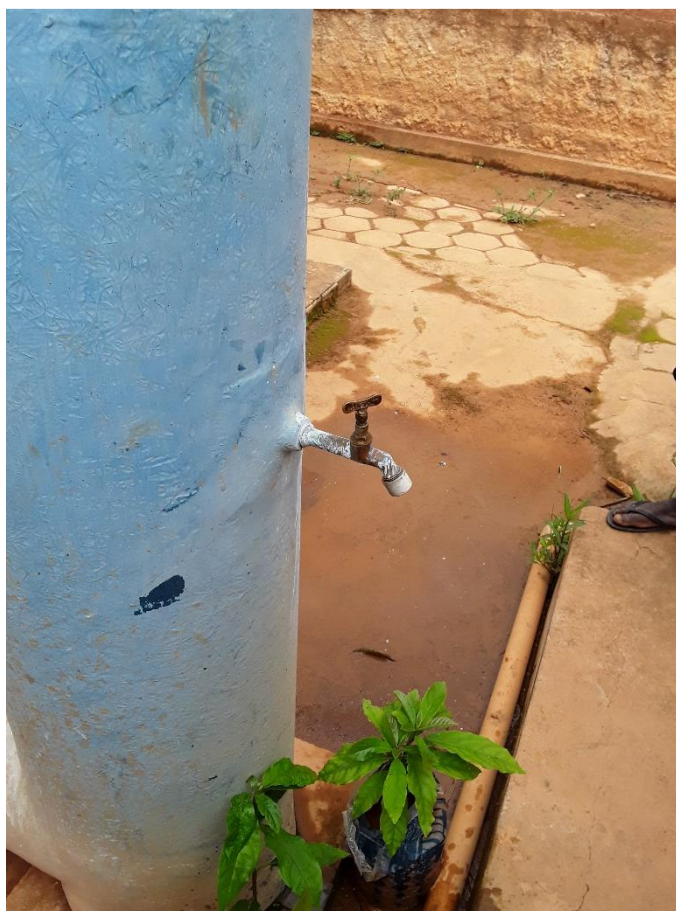
Figura – Torneira para coleta de água filtrada
