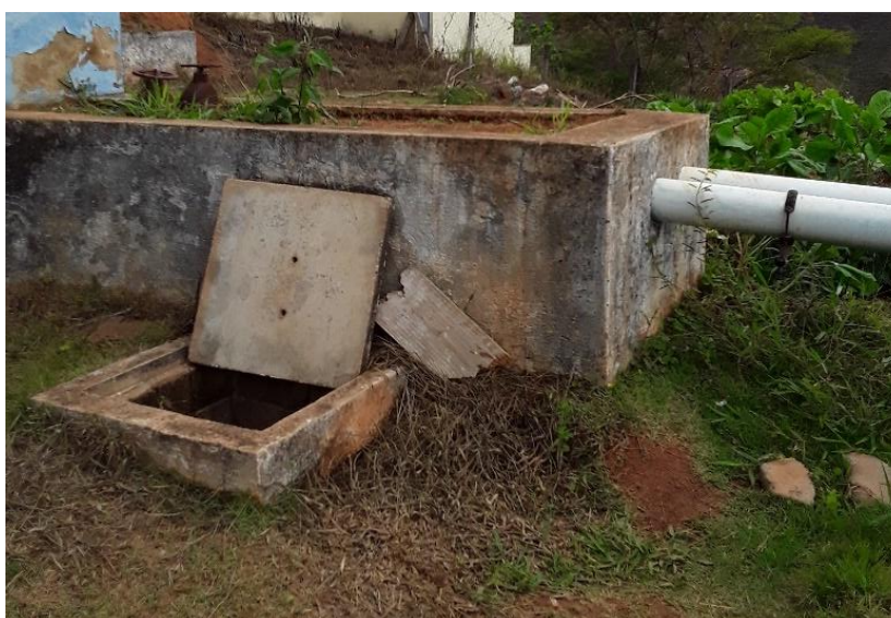
Figura – Caixa de registro e tubulação de água tratada para o reservatório
