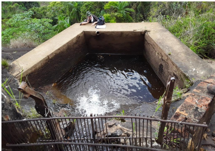
Figura – Barragem da Captação Ouro – Vista superior
