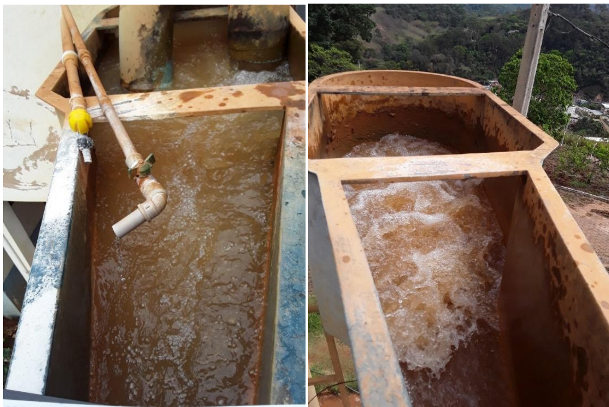
Figura – Calha Parshal
