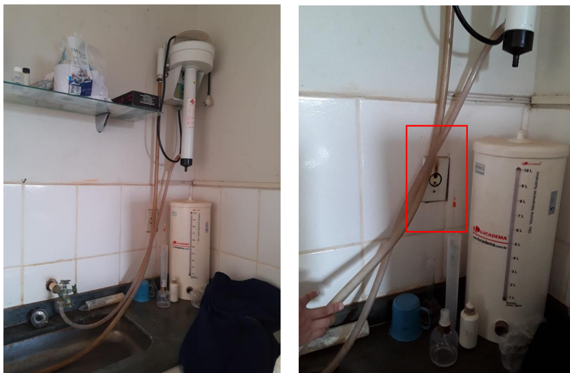
Figura – Destilador e ponto de energia
