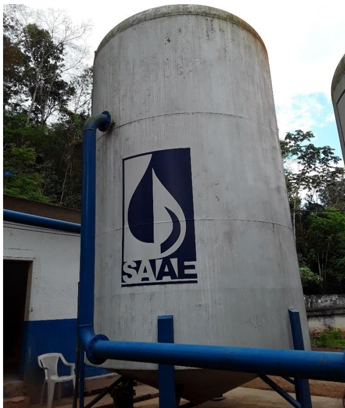
Figura – Floco - decantador pressurizado
