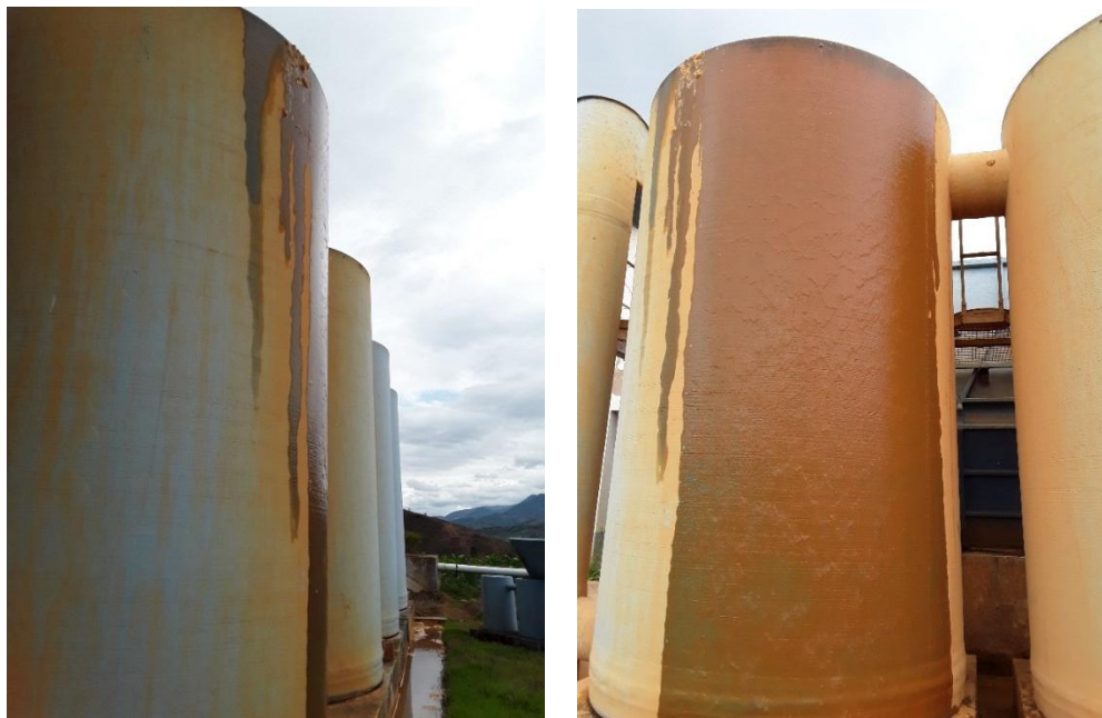
Figura – Extravassamento nos floculadores
