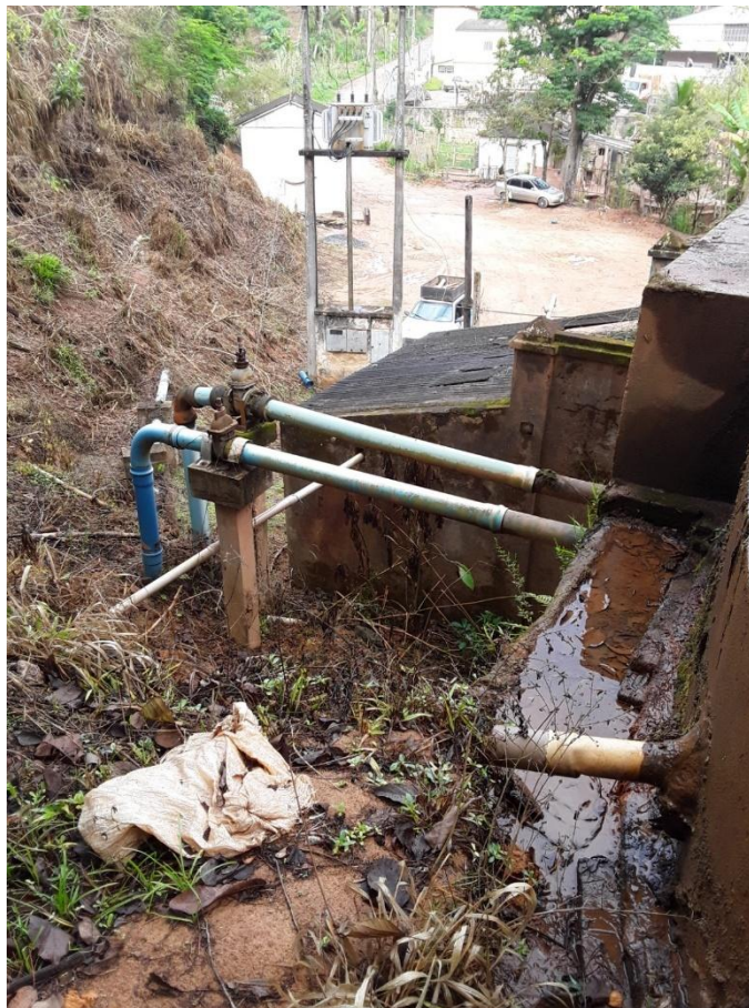
Figura – Valvulas na tubulação da adutora
