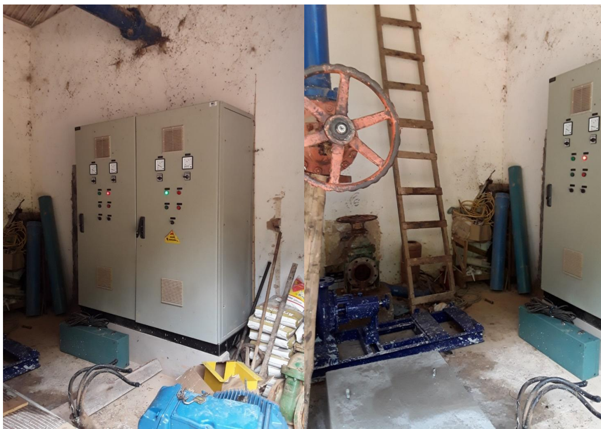
Figura – Equipamentos armazenados na EEAB Usina – EEAB Usina
