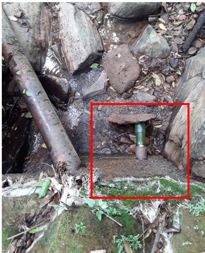
Figura – Tubulação de descarga de fundo -Captação Limeira
