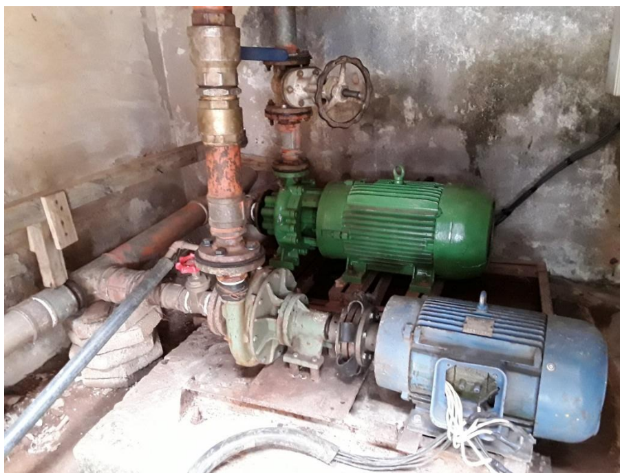
Figura – Área dos conjuntos motobombas – EEAT Escola
