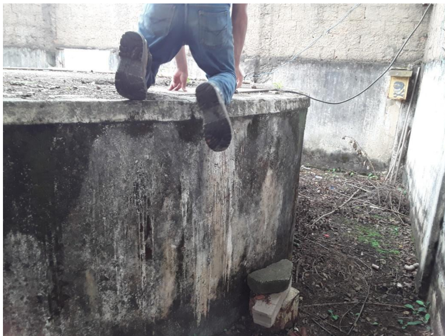
Figura – Solução improvisada para falta de escada
