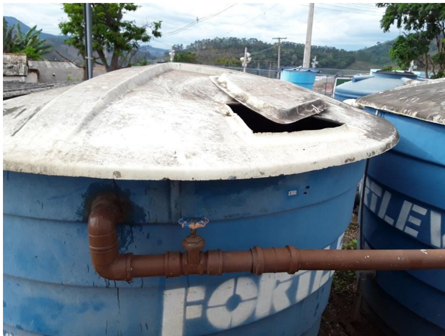
Figura -Tampa de inspeção dos filtros - Penha
