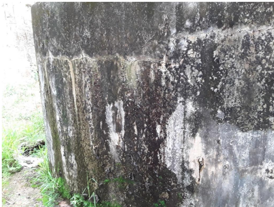
Figura – Fissuras e pontos de vazamento
