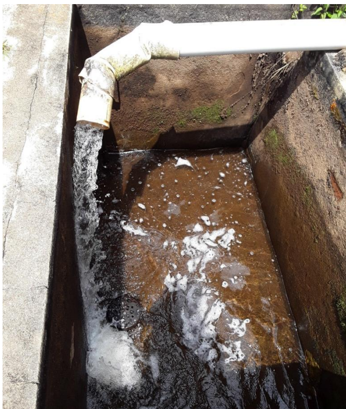
Figura – Tanque de água bruta
