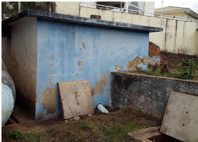
Figura – Tanque de contato
