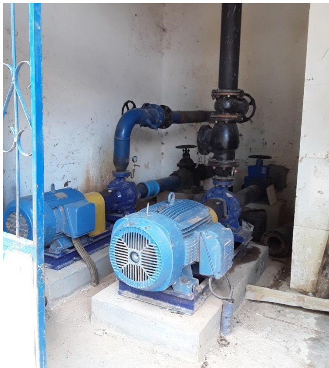
Figura – Conjuntos motobomba – EEAB Usina
