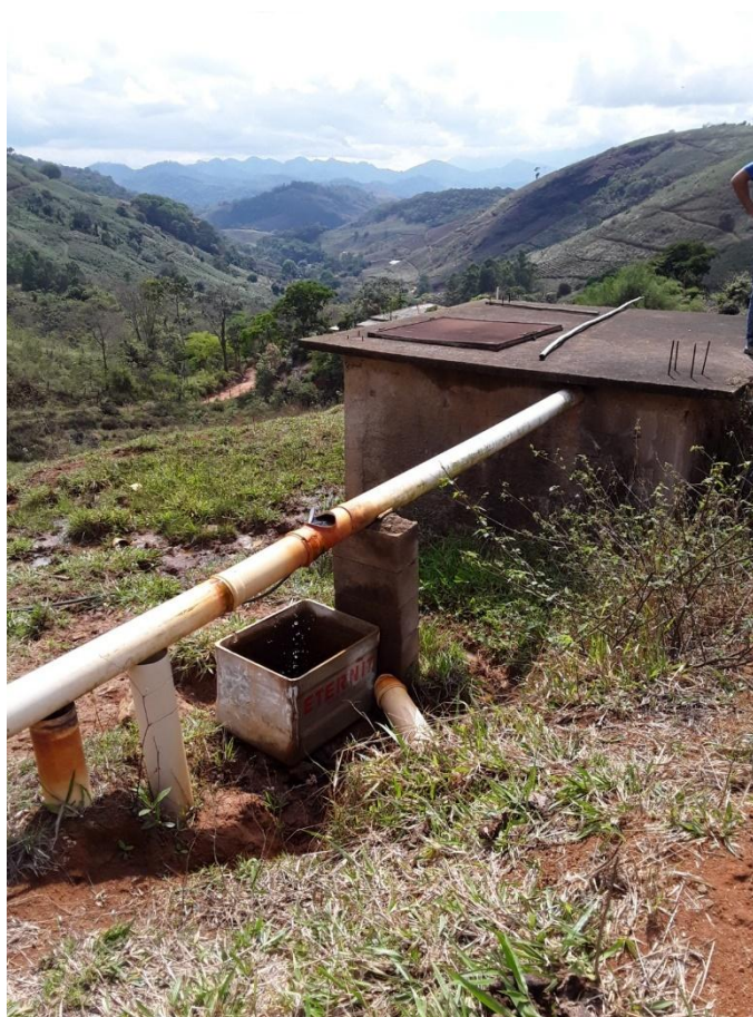
Figura – Reservatório de água bruta Captação Caatinga
