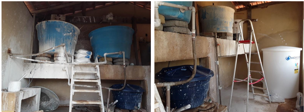
Figura – área de preparo e dosagem dos produtos químicos
