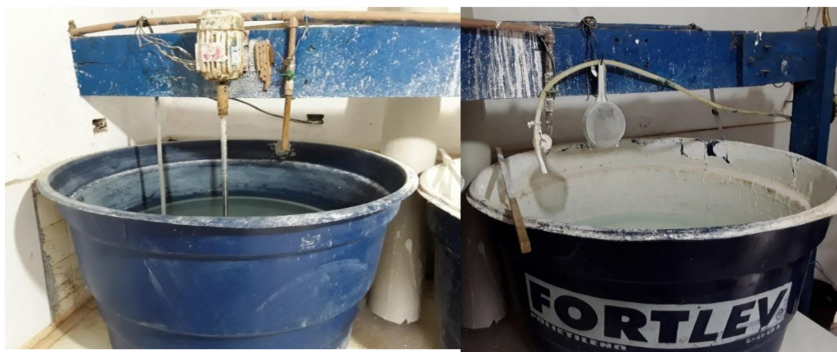
Figura – Tanque de preparo do sulfato de alumínio com agitador e tanque de armazenamento
