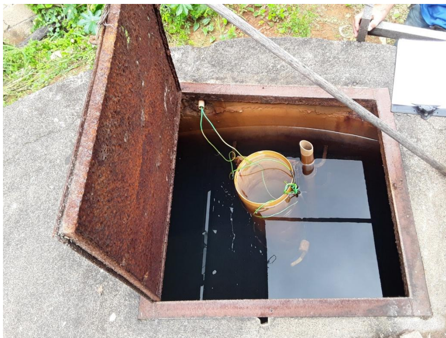
Figura – Tampa de inspeção corroída
