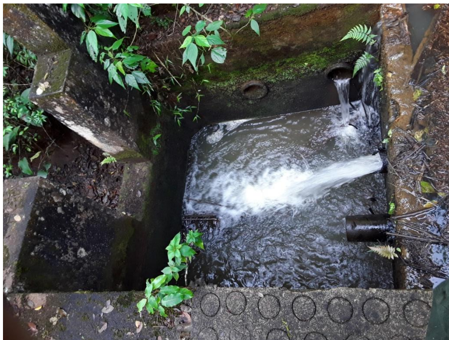
Figura – Caixa de Passagem – Captação Ventania
