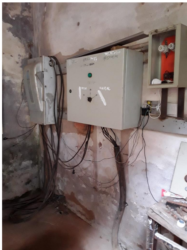
Figura – Área dos painéis de controle
