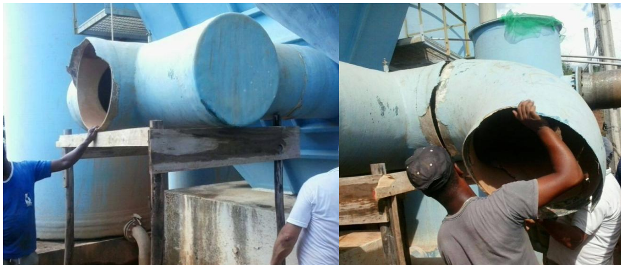
Figura – Tubulação da ETA que se rompeu
