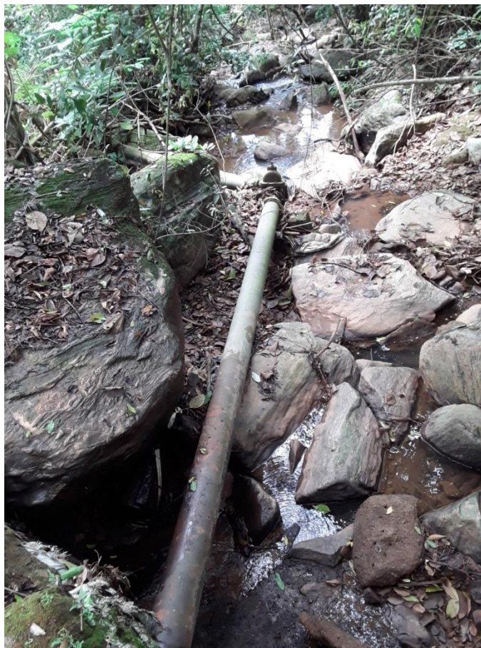
Figura – Adutora de água bruta – Captação Limeira
