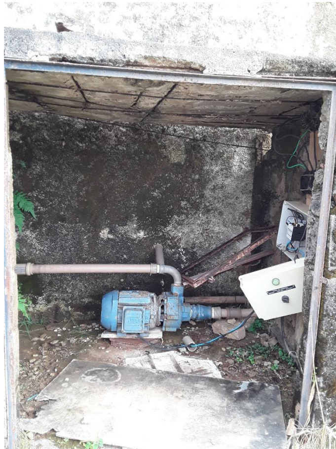
Figura – Conjunto motobomba – ETA Cantamissa
