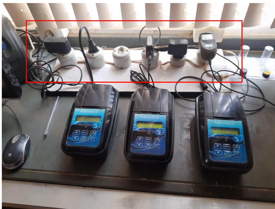
Figura – Equipamentos para monitorar os parâmetros cor, turbidez e cloro
