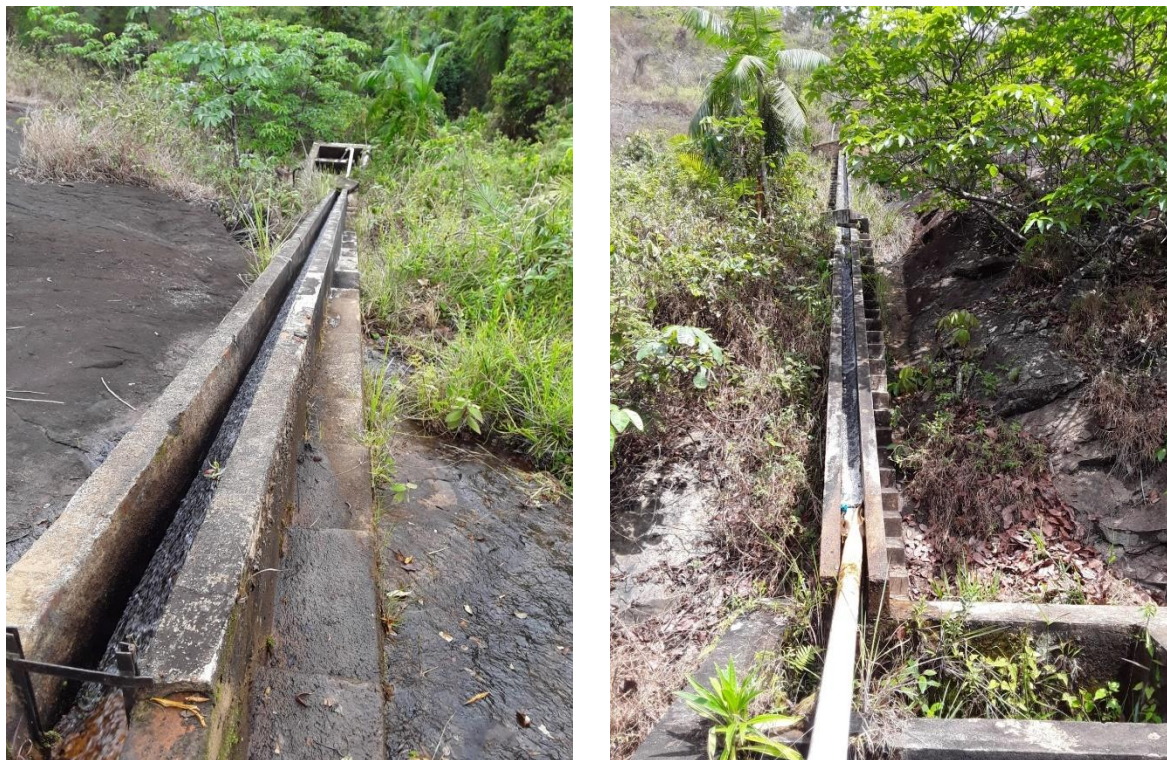
Figura – Adução de água bruta em canal aberto
