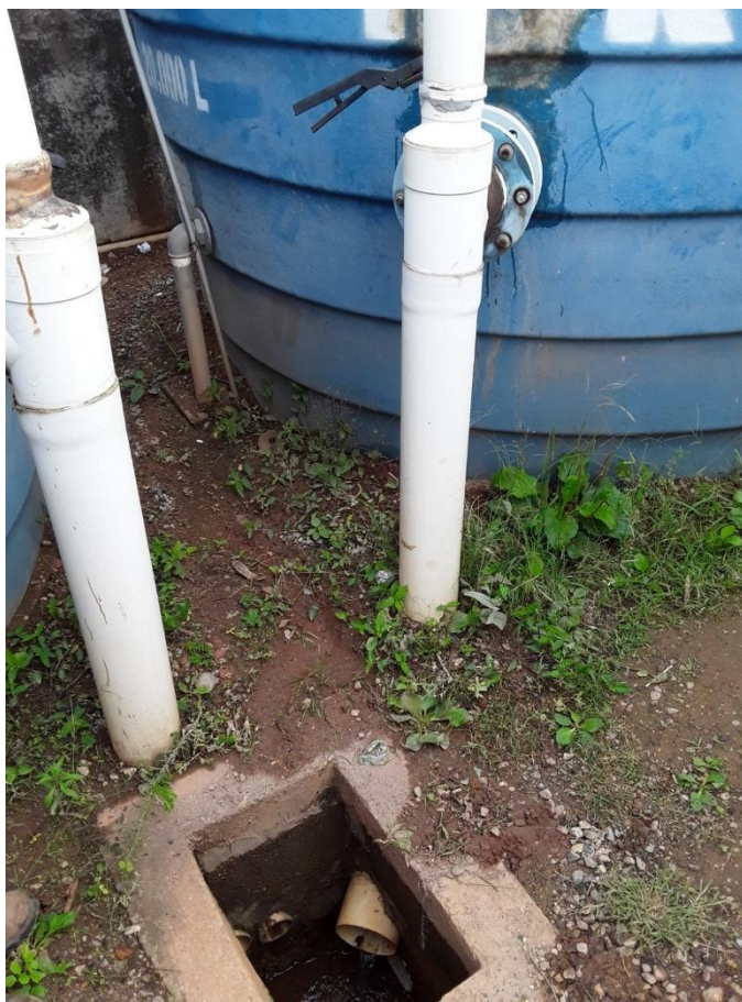
Figura – Caixa de descarga dos filtros - Penha
