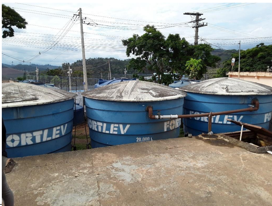
Figura – Área dos filtros - Penha
