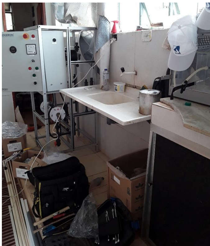
Figura – Área da casa de química onde será instalado o gerador de hipoclorito de sódio
