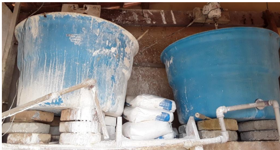
Figura – Tanques de preparo dos produtos químicos
