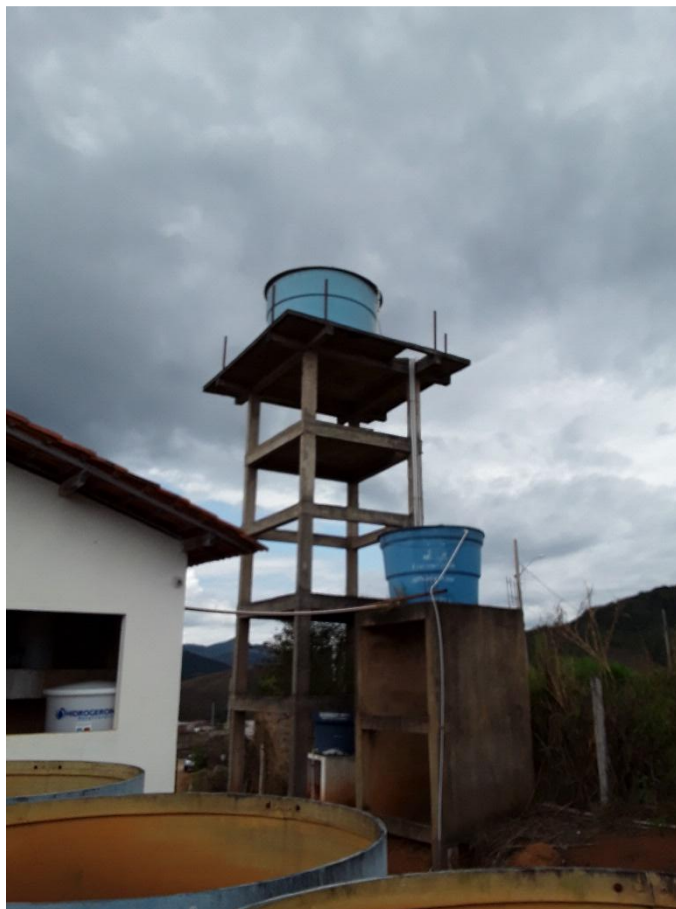
Figura – Reservatórios elevados – ETA Cantamissa
