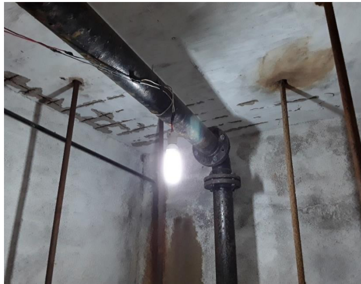
Figura 21 – Vazamento estrutura inferior do filtro - ETA
