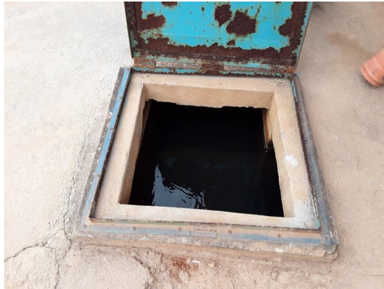
Figura 24 – Tanque de contato - ETA
