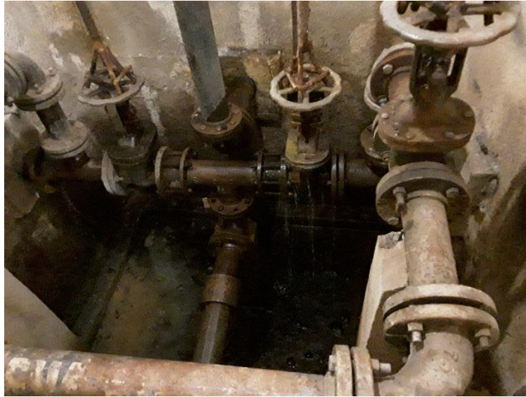
Figura 22 – Vazamento no registro do filtro - ETA
