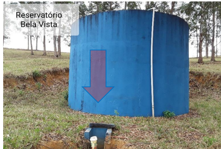
Figura 43 – Sistema de cloração no reservatório fiscalizado
