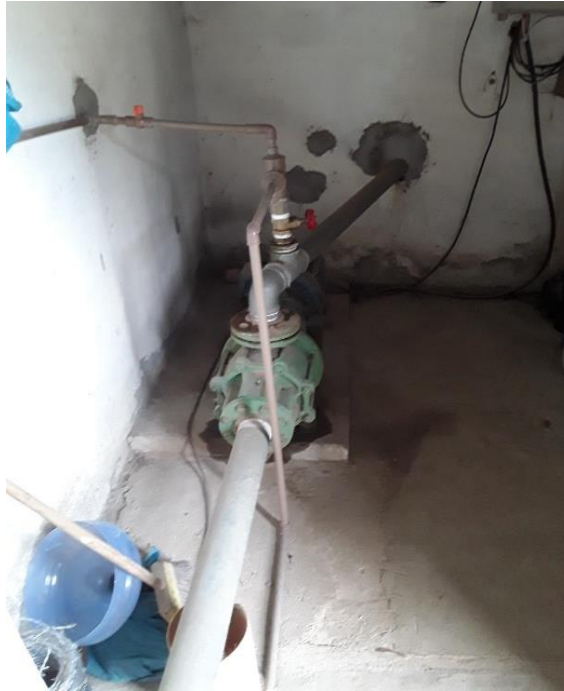
Figura 32 – Estação elevatória Dario 1
