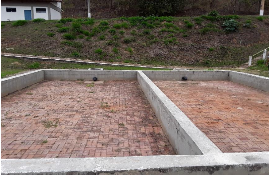
Figura 59 – Leito de secagem do lodo
