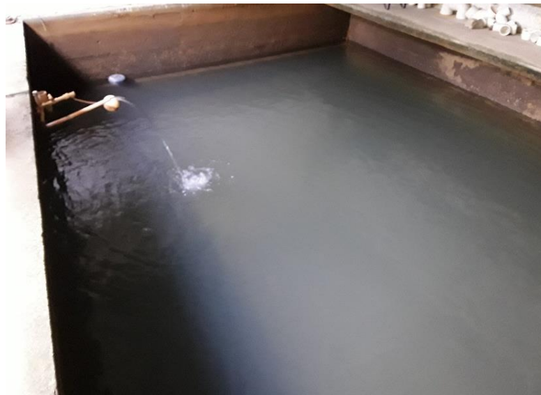
Figura 40 – Estação elevatória de água Bruta
