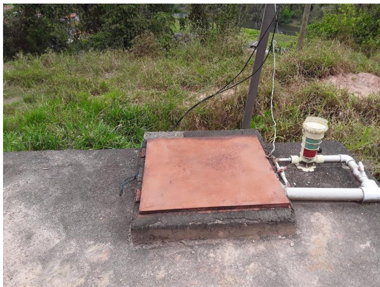
Figura 41 – Unidade de cloração do Reservatório Nova Esperança
