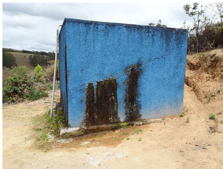
Figura 52 – Reservatório do Distrito de Palmeiras
