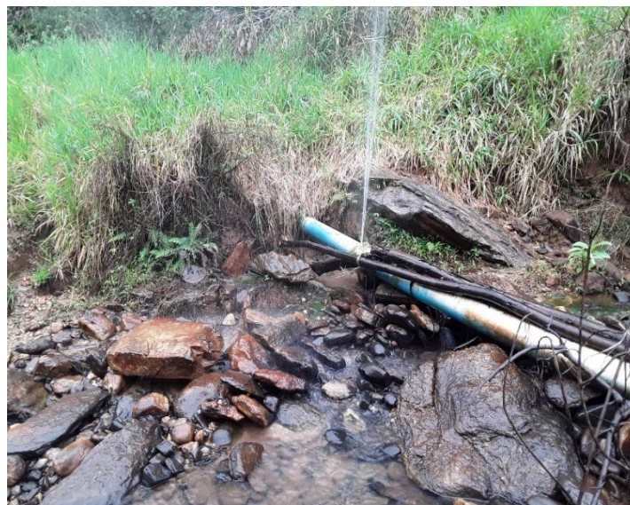
Figura 8 – Vazamento Adutora de água bruta – Captação 2 Sede
