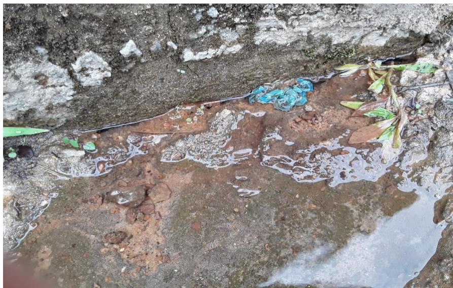
Figura 37 – Existem vazamentos na estrutura no R2
