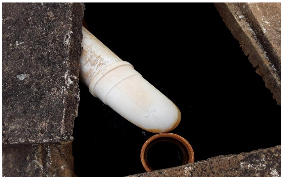
Figura 38 – A tampa do local de inspeção
