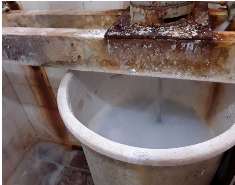
Figura 26 – Preparo do Sulfato de alumínio
