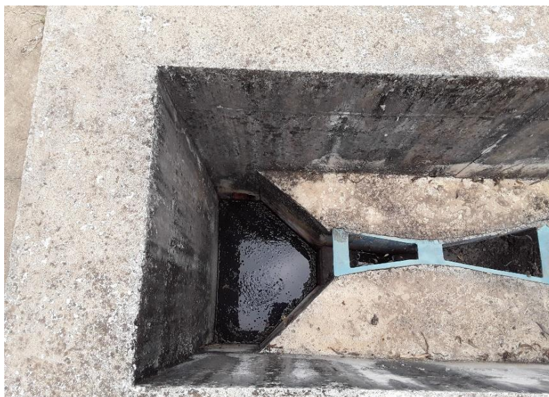
Figura 56 – Calha Parshall próxima ao tratamento preliminar
