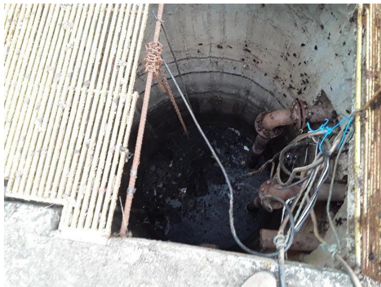
Figura 61 – Poço de sucção na ETE de Acaiaca
