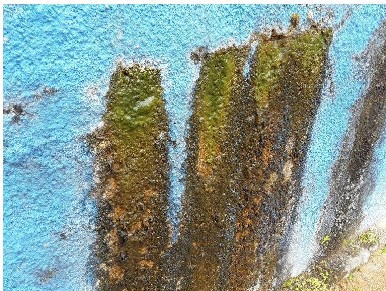
Figura 53 – Locais com vazamento no reservatório de Palmeiras
