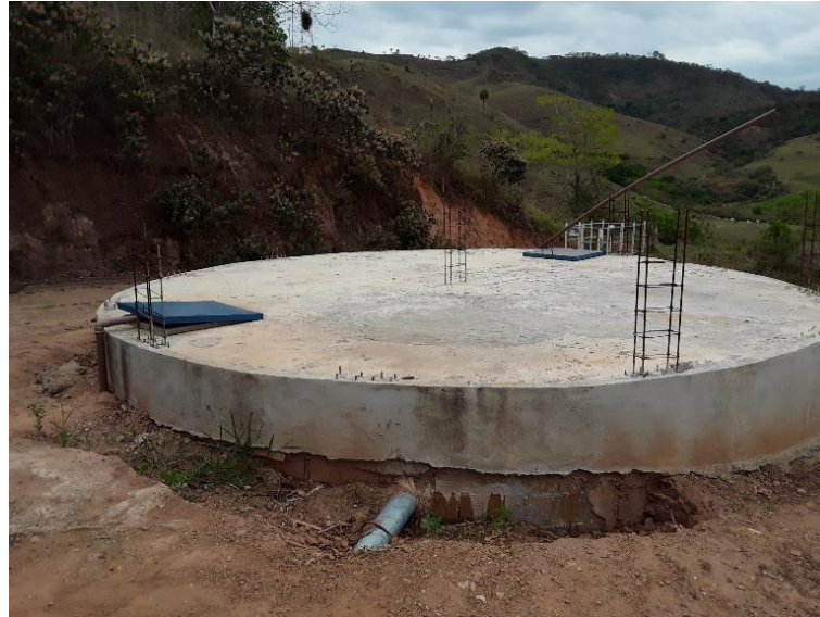
Figura 34 – Reservatório R1 na ETA de Acaiaca
