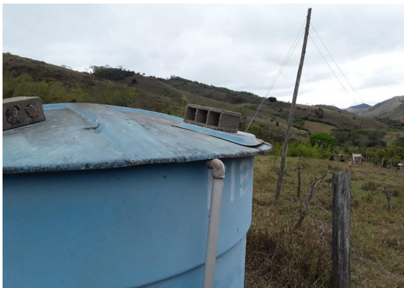
Figura 45 – Tampa sem a devida proteção
