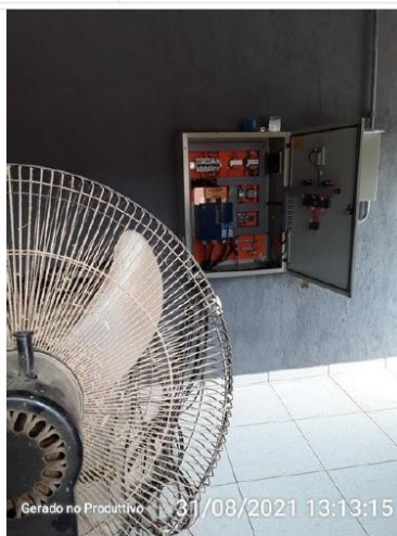
Ventilador para circulação do ar próximo ao painel de controle
