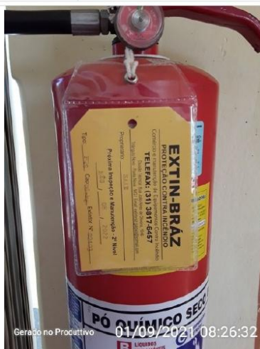
Data de validade do extintor de incêndio
