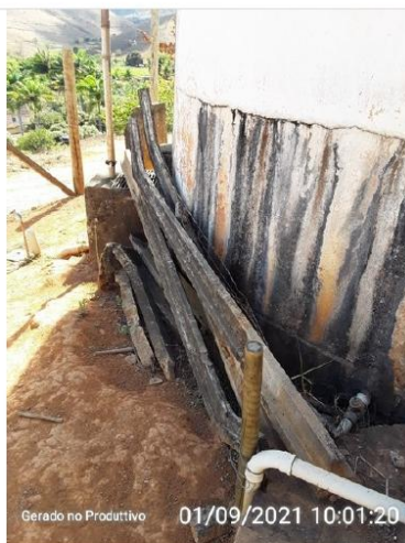
Entulho depositado na área do reservatório.
