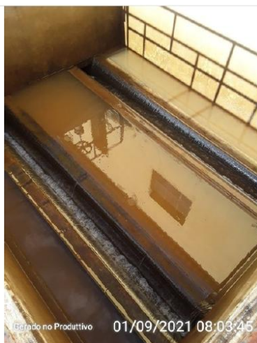
Filtro sendo lavado
