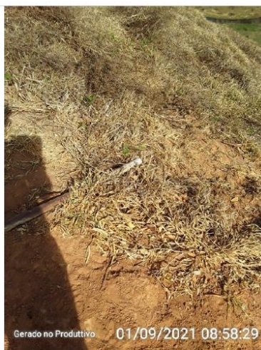
Ausência de caixa de descarga do tubo extravasor.
