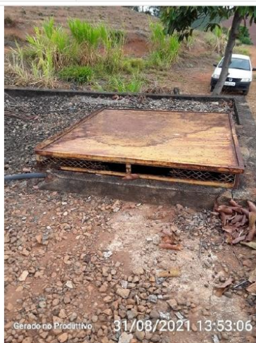
Condições da tampa de inspeção.
