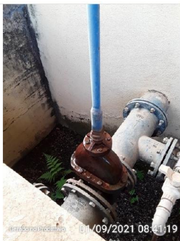
Válvula com vazamento
