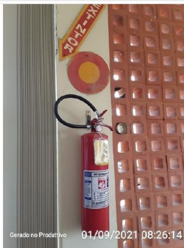
Extintor de incêndio
