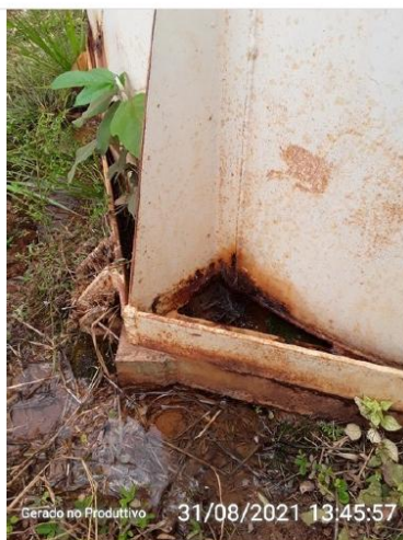
Vazamento na base do reservatório
