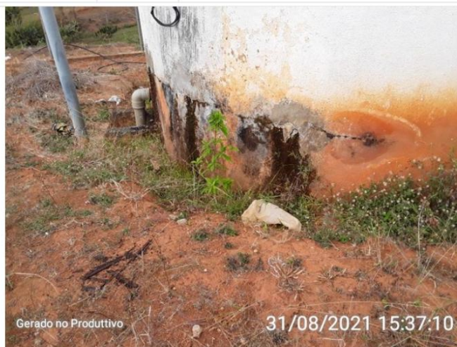
Rachaduras no reservatório.
