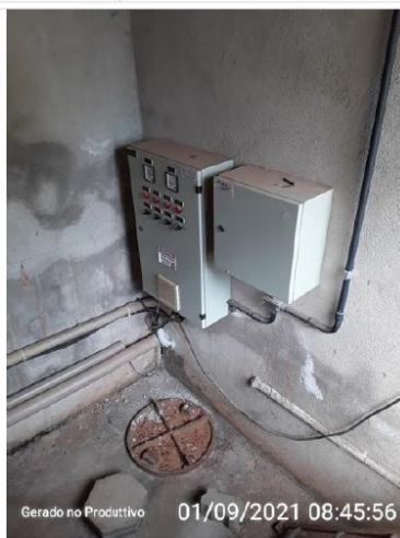
Quadros de comando
