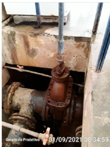
Válvula dos filtros com vazamento
