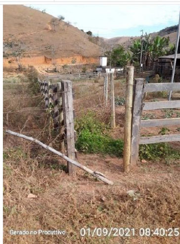
Acesso ao poço, sem portão
