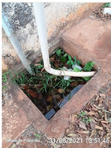
Caixa de descarga do tubo extravasor.
