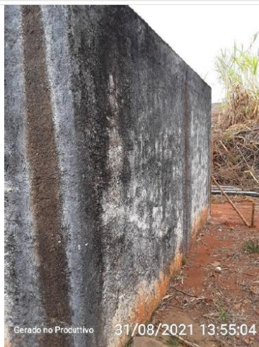
Infiltrações na estrutura do reservatório
