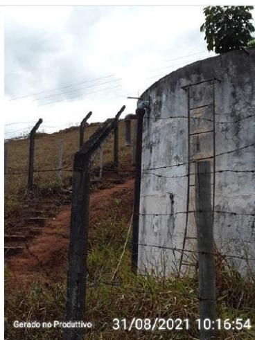
Tubo extravasador do reservatório.
