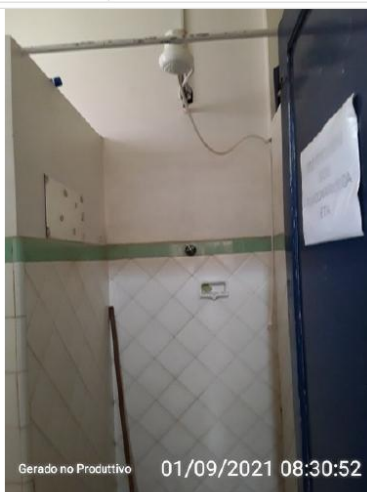
Chuveiro no depósito de produtos químicos
