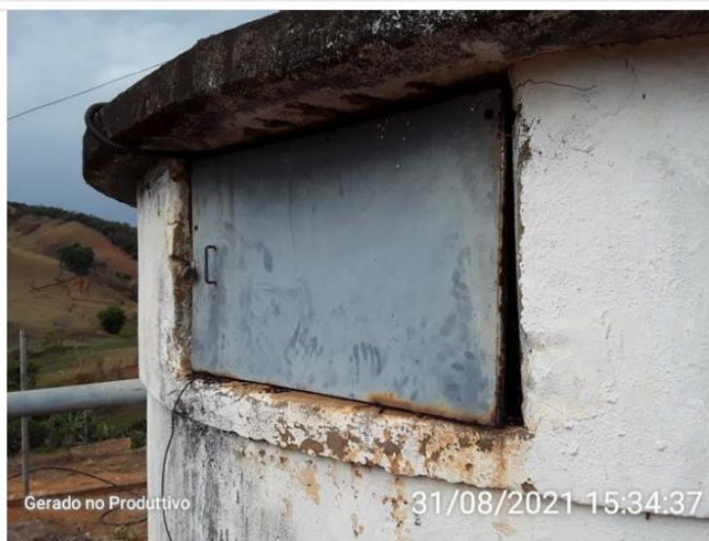
Tampa de inspeção do reservatório violada
