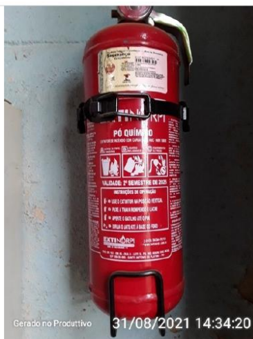
Extintor de incêndio
