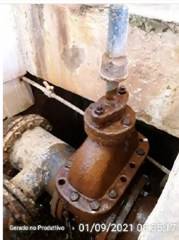
Válvula dos filtros com vazamento
