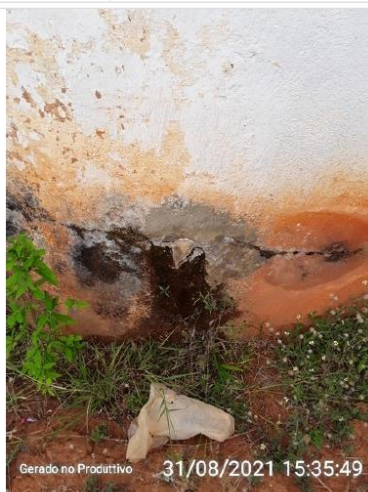
Vazamento na estrutura do reservatório.
