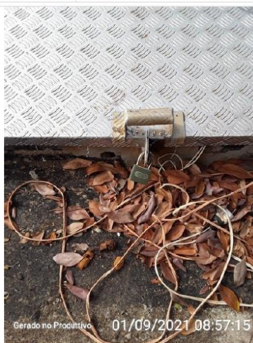
Cadeado na tampa de inspeção
