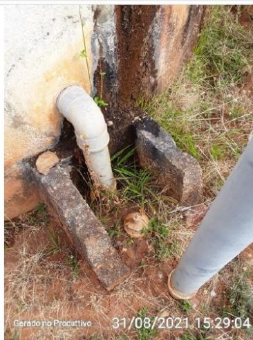
Válvula de fechamento na saída do reservatório
