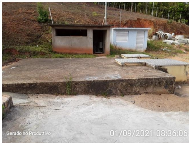
Tanque de contato
