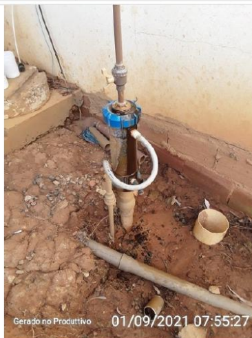
Clorador na entrada dos reservatórios.
