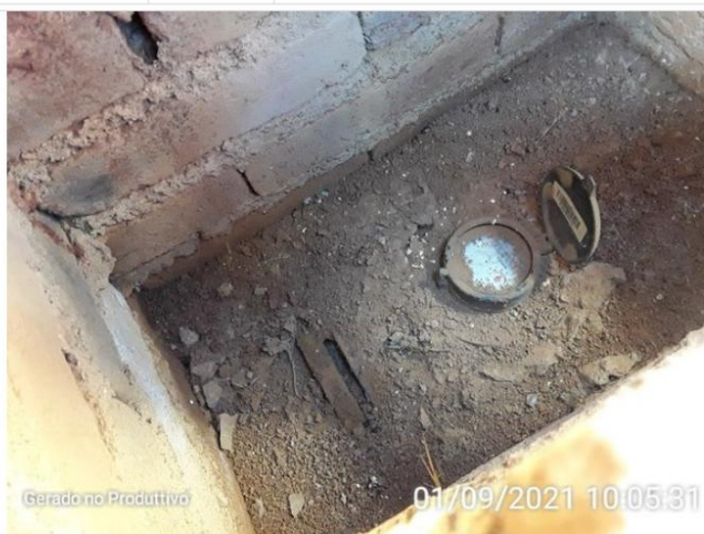
Hidrometro na entrada do reservatório.
