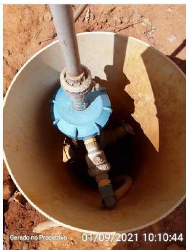
Sistema de cloração do reservatório.
