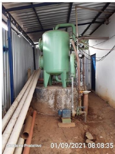
Filtro removedor de Fe/Mn (2).
