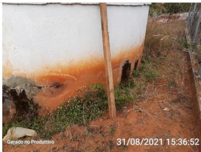
Infiltrações no reservatório.
