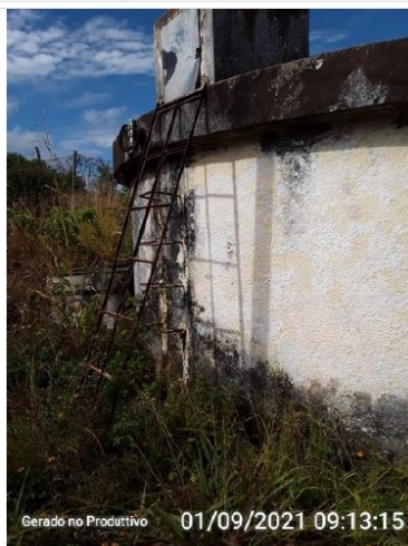
Infiltração na estrutura do reservatório
