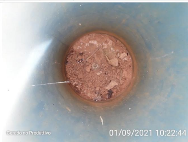
Válvula de fechamento na saída do reservatório.
