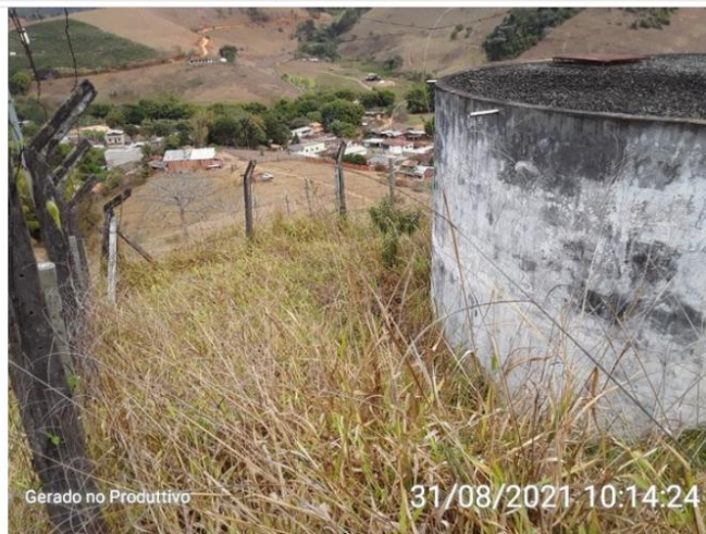
Área do reservatório necessitando de manutenção e limpeza.
