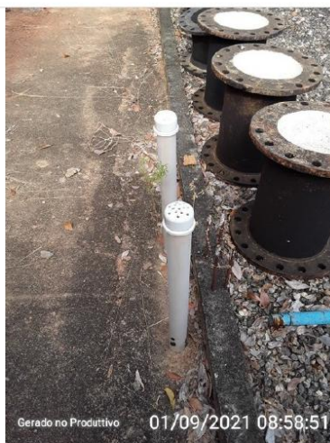
Tubulação de ventilação
