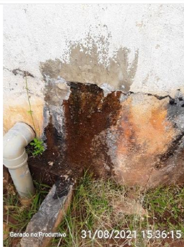
Vazamento na estrutura do reservatório (3).
