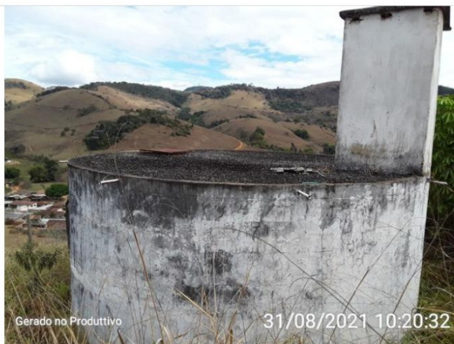
Cobertura do reservatório sem guarda-corpo.
