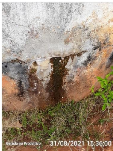
Vazamento na estrutura do reservatório (2).
