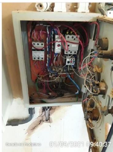
Condições do quadro elétrico.
