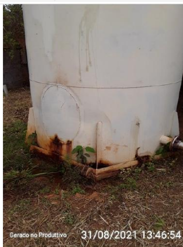
Pontos de oxidação na estrutura do reservatório
