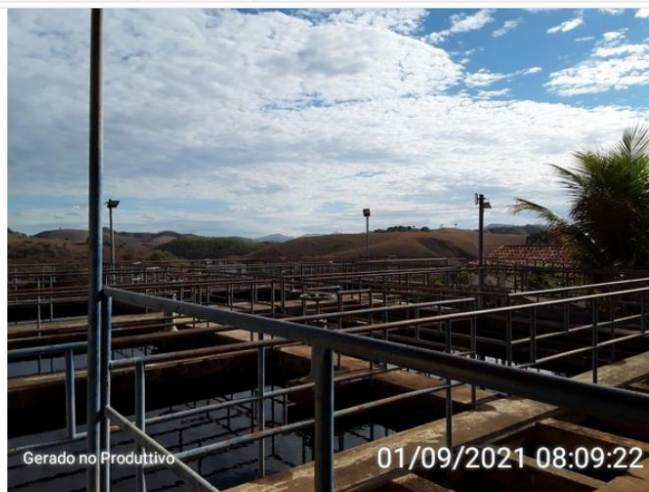
Iluminação na área da ETA
