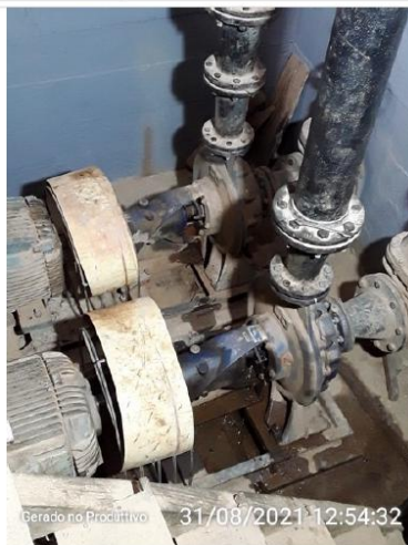
Vazamento nos conjuntos motobomba
