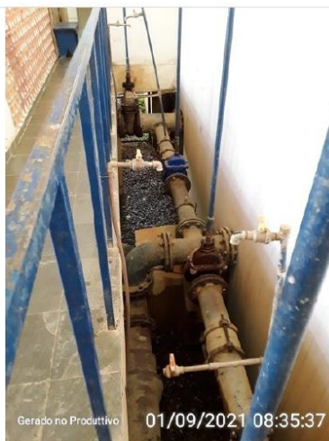
Área das válvulas dos filtros
