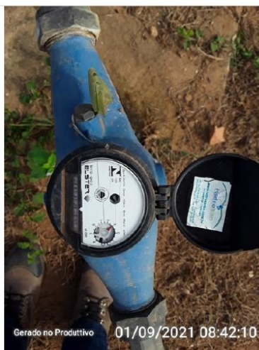
Medidor de vazão instalado no poço
