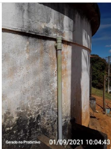
Tubo extravasor do reservatório.
