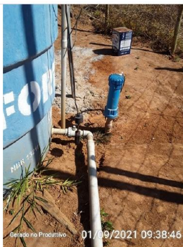
Registro de fechamento na saída do reservatório
