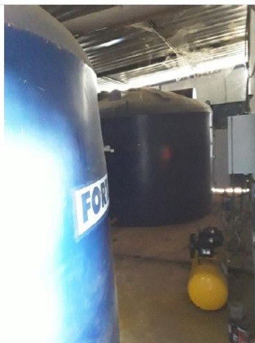
Reservatório 1 e Reservatório 2, interligados.
