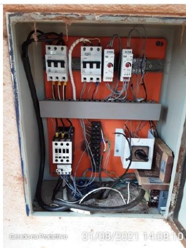
Condições do quadro elétrico.
