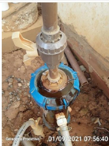
Vazamento na tubulação de entrada do reservatório.
