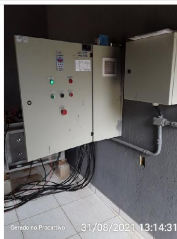
Painéis de controle
