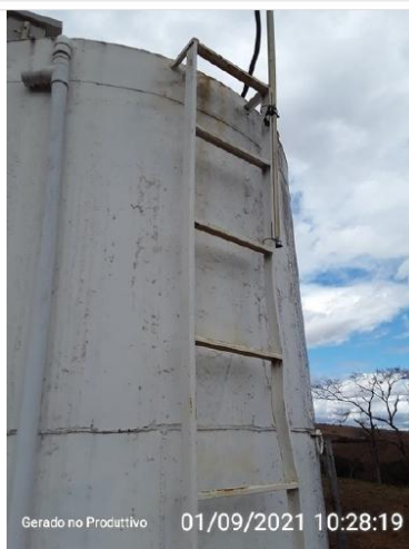
Ponto de oxidação no reservatório.
