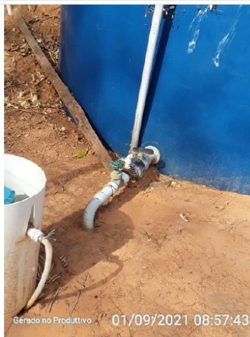
Válvula de fechamento na saída do reservatório.
