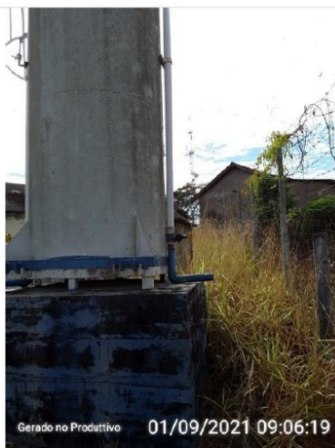
Tubo de descarga de fundo
