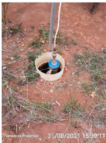
Clorador do reservatório.
