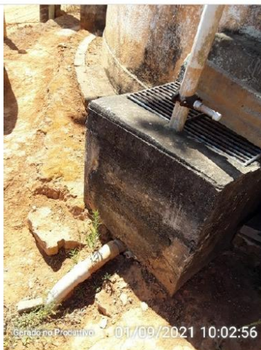
Tubulação 1 de saída do reservatório.
