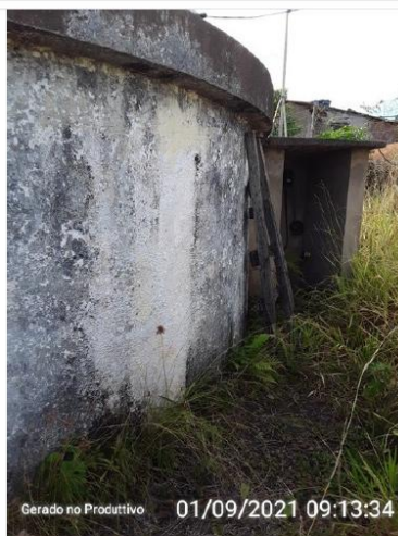
Pequenos pontos de infiltração na estrutura do reservatório
