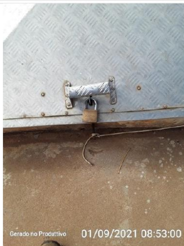
Cadeado na tampa de inspeção
