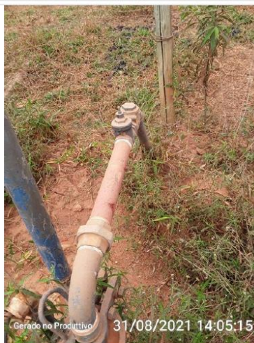
Ausência de dispositivo de controle de vazão.
