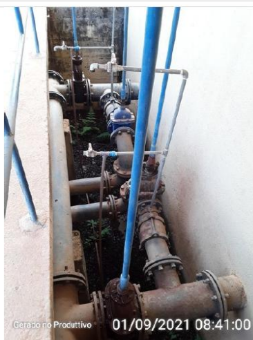
Área das válvulas dos filtros
