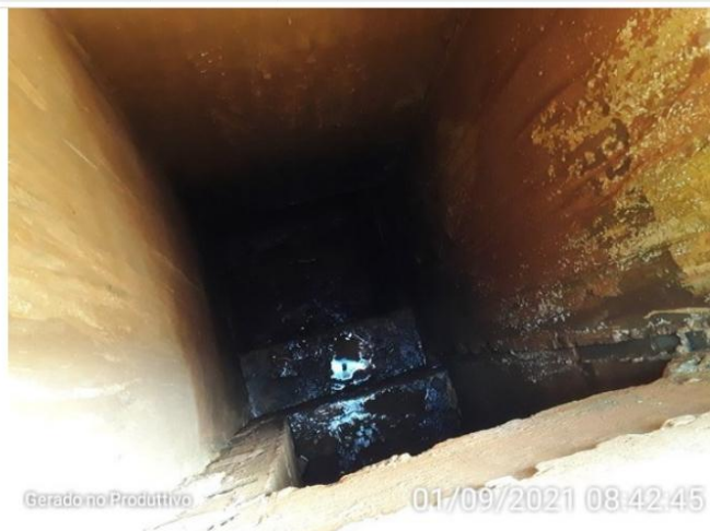
Vazamento proveniente dos filtros
