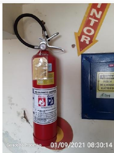
Extintor de incêndio
