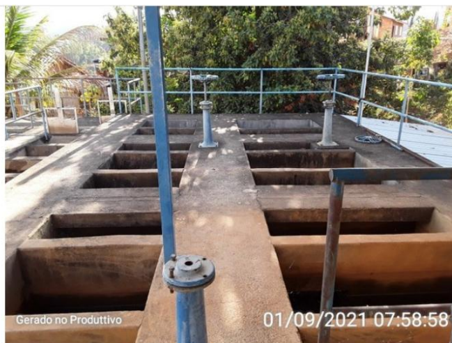
Câmaras de floculadores
