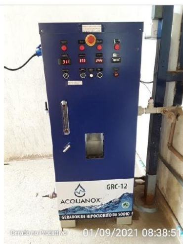
Gerador de hipoclorito de sódio
