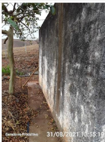
Infiltrações na estrutura do reservatório (2)
