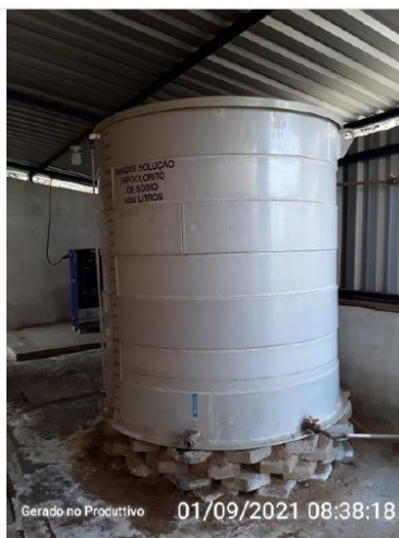
Tanque com solução de hipoclorito de sódio
