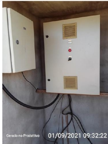
Quadro de comando
