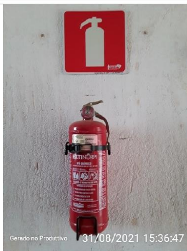
Extintor de incêndio
