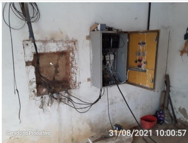
Condições dos quadros e cabos elétricos.
