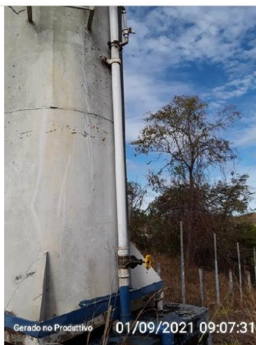
Pequeno vazamento na válvula de fechamento do sistema de nível do reservatório.
