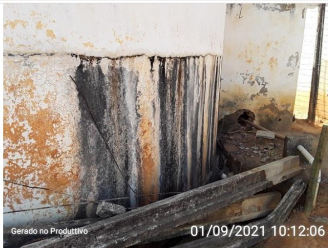
Infiltrações na estrutura do reservatório.
