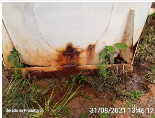
Vazamento na base do reservatório
