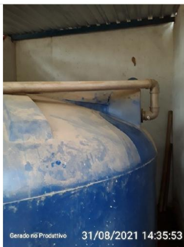
Gerado no Produttivo 31/08/2021 14:35:53 Reservatório de sucção
