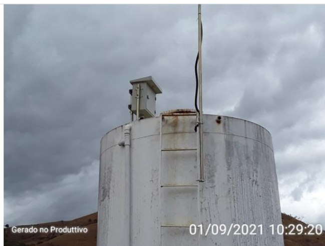
Cobertura do reservatório sem guarda corpo.
