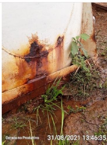
Vazamento na base do reservatório
