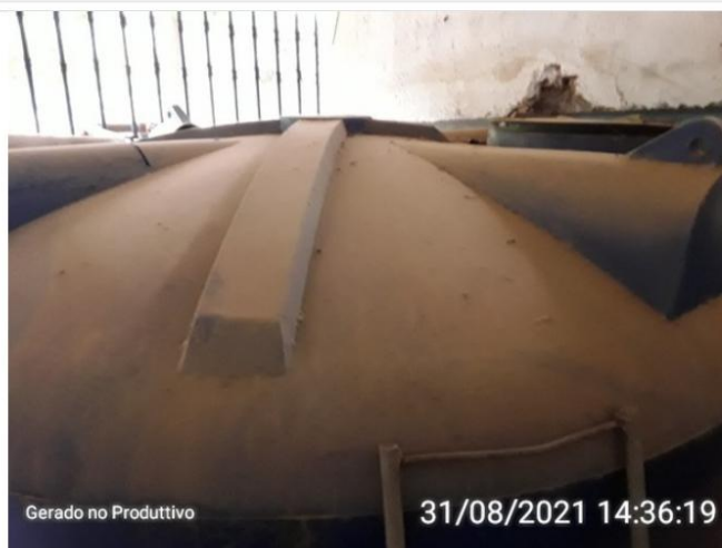
Gerado no Produttivo 31/08/2021 14:36:19 Reservatório de sucção
