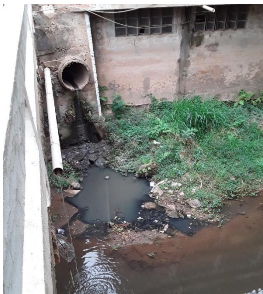
Figura 77 – Lançamento de esgoto no Ribeirão São Domingos
