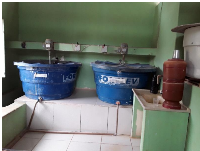
Figura 28 – Equipamento de preparo do Sulfato de Alumínio
