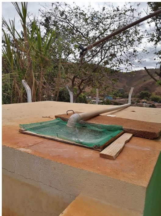
Figura 62 – Tanque de contato
