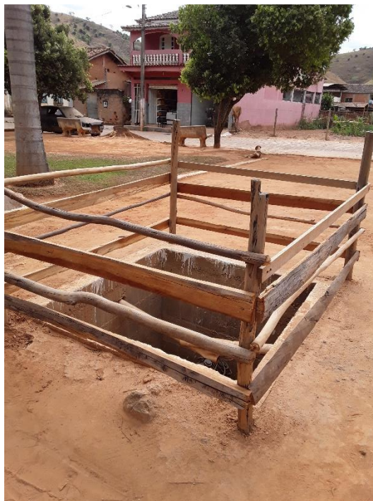
Figura 45 – Área da Captação Subterrânea – Distrito de Professor Sperbert
