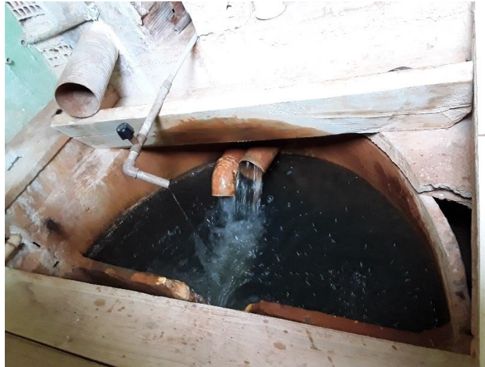
Figura 17 – Chegada da água Bruta
