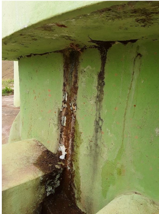
Figura 21 – Vazamento no decantador
