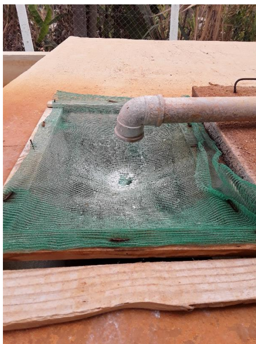
Figura 63 – Adição de Cloro
