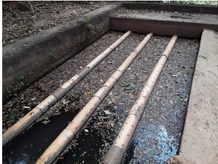
Figura 15 – Captação Córrego São Bento
