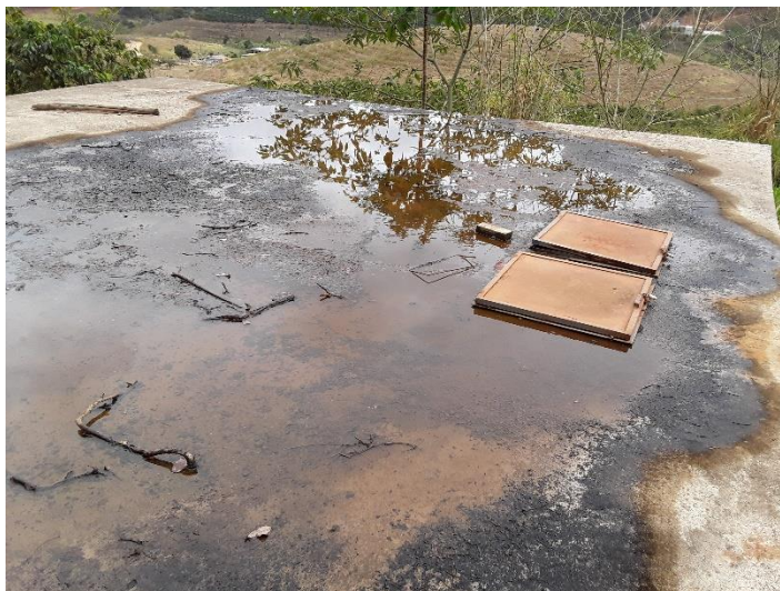
Figura 75 – Reservatório do Povoado Penha do Coco
