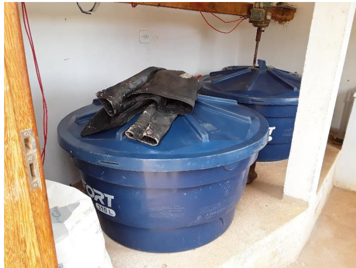
Figura 57 – Equipamento de preparo do sulfato de alumínio
