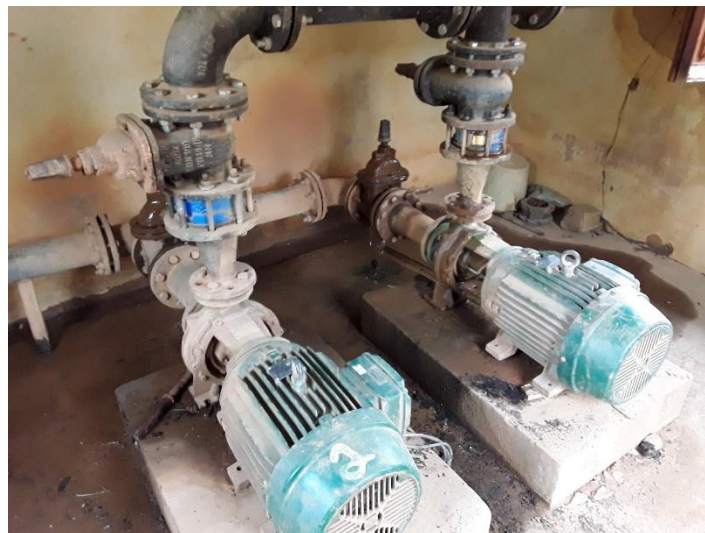
Figura 10 – Conjunto Moto – Bomba
