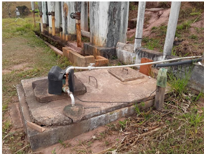
Figura 36 – Bomba para reservatório da ETA
