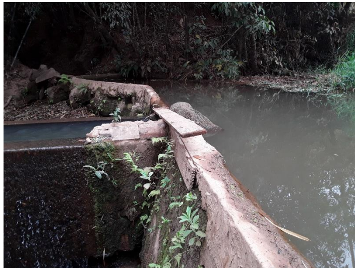
Figura 7 – Barragem – Captação água Limpa
