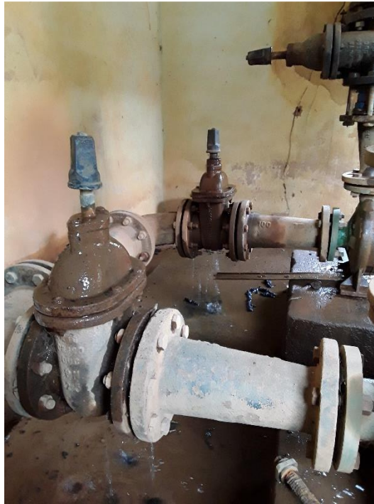
Figura 11 – Vazamento nos registros
