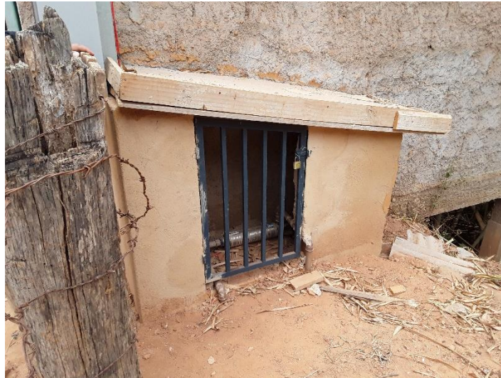
Figura 37 – Casa de Bomba
