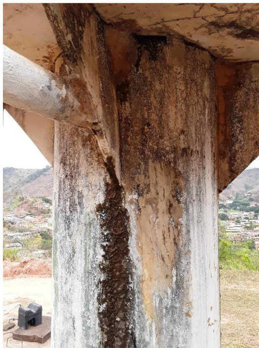
Figura 25 – Vazamento na estrutura dos Filtros
