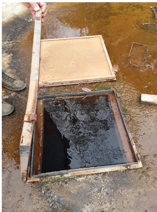
Figura 76 – Tampa de inspeção - Reservatório do Povoado Penha do Coco
