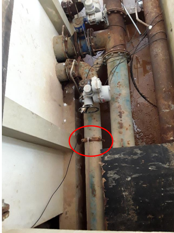
Figura 1 – Aplicação do ortopolifosfato na tubulação de saída dos filtros
