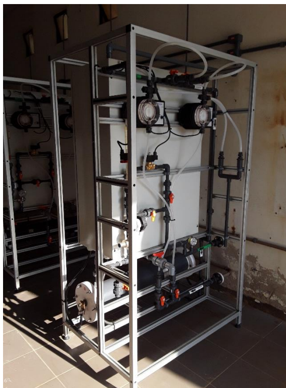
Figura 4 – Geradores de hipoclorito de sódio da ETA II
