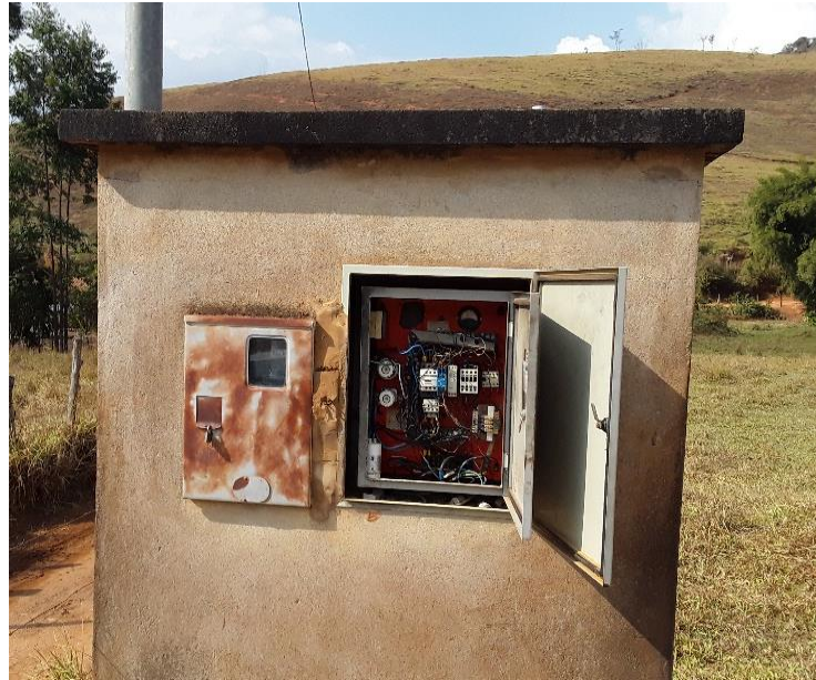
Figura 35 - Quadro de comando próximo ao poço tubular em Santa Efigênia.
