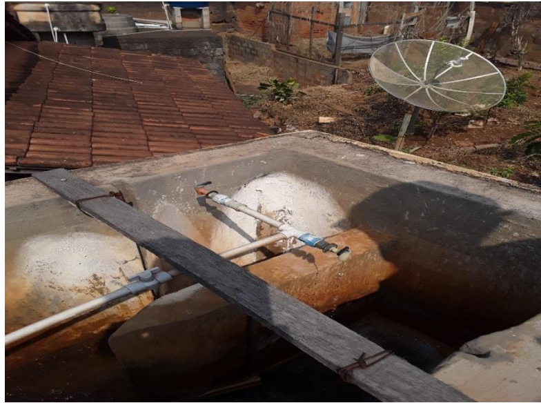
Figura 16 – Aplicação do coagulante no tratamento de água
