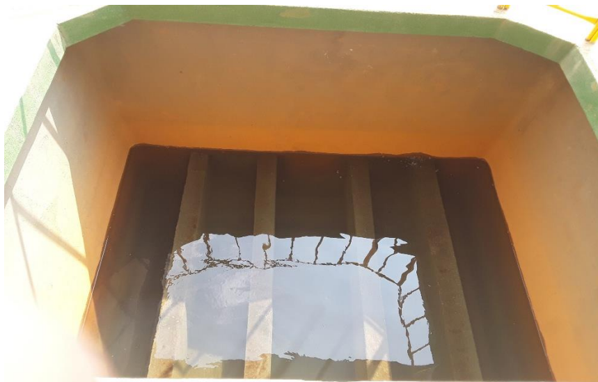
Figura 19 – Filtro da ETA de Abre Campo
