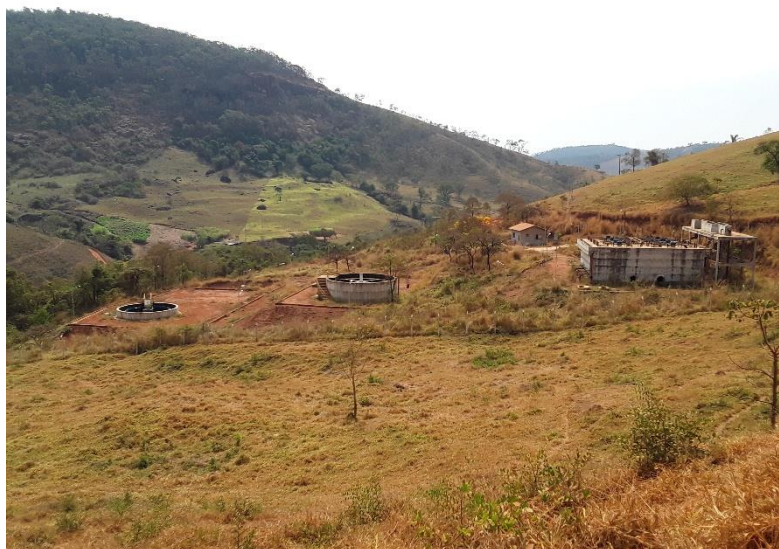
Figura 47 – Vista global da ETE sendo construída na Zona Rural em Abre Campo
