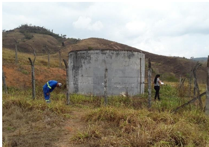
Figura 33 – Reservatório local necessita de manutenção.
