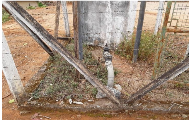
Figura 32 – Poço tubular 2 no distrito de Granada
