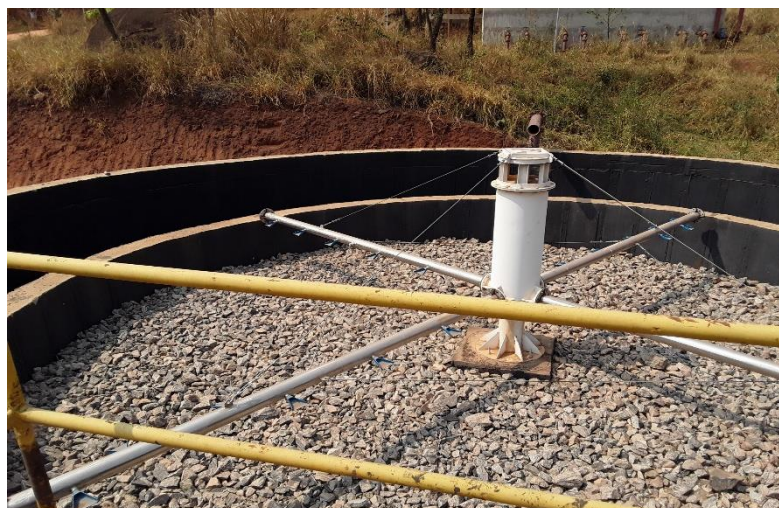
Figura 51 – Estrutura do Filtro Biológico na ETE de Abre Campo
