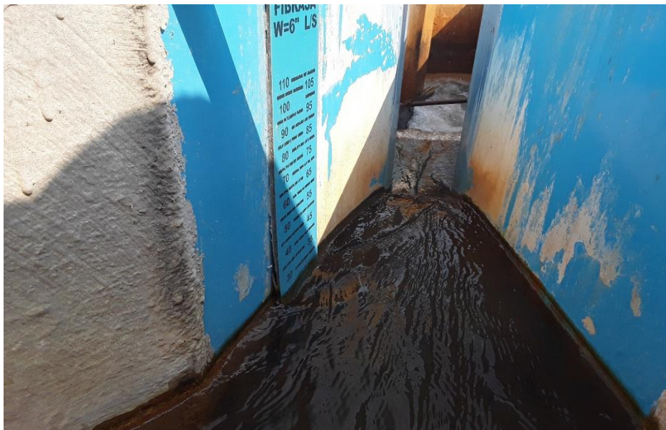
Figura 15 – Calha Parshall da ETA da Sede do Município de Abre Campo
