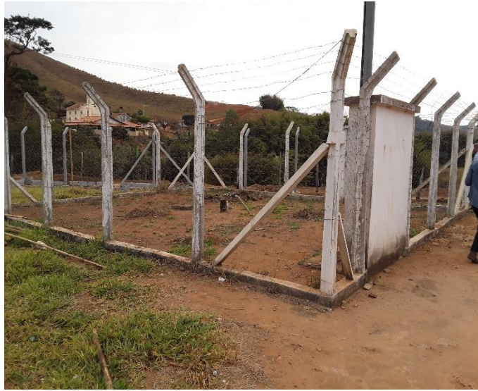
Figura 40 – Área do poço tubular na localidade de Aparecida.
