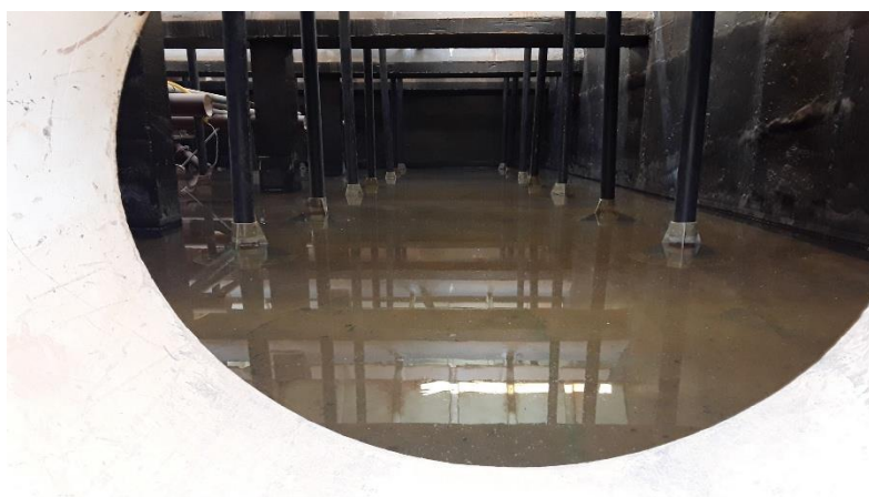
Figura 50 – Água acumulada na unidade de tratamento de esgoto
