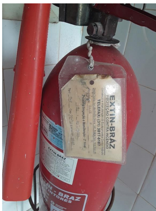
Figura 26 – Extintor de incêndio
