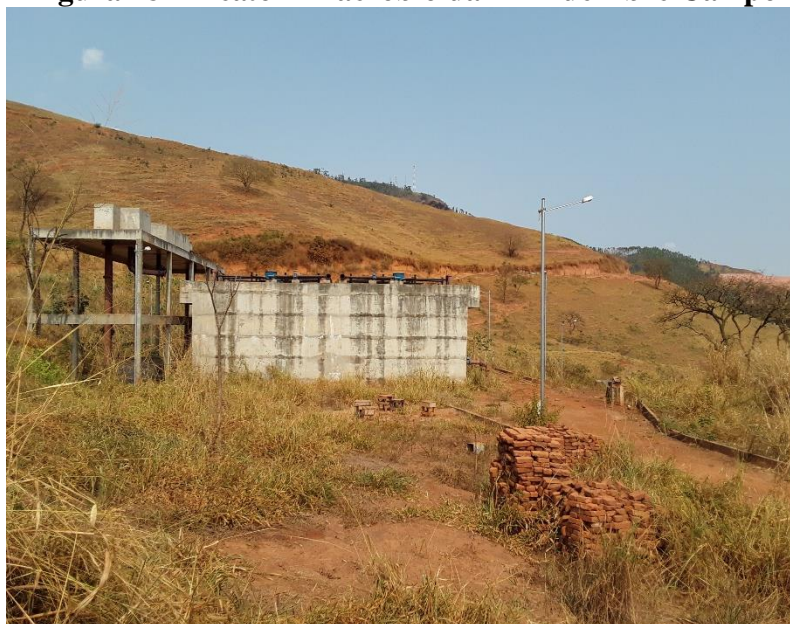
Figura 48 – Reator Anaeróbico da ETE de Abre Campo
