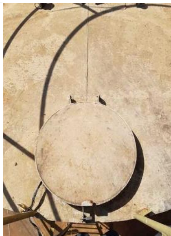
Tampa de Inspeção
