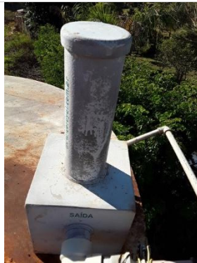
Clorador de pastilha no reservatório.
