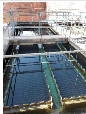
Decantadores da ETA
