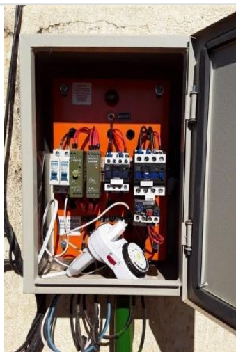
Quadro elétrico do Poço da Escola
