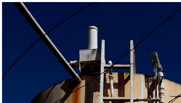
Clorador do reservatório
