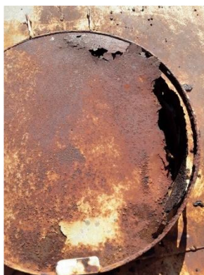
Tampa de inspeção do reservatório corroída
