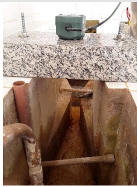
Medidor ultrassônico de vazão instalado na entrada da ETA.
