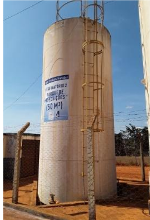
Reservatório Parque de Exposição 50m 3
