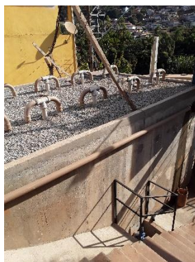
Tanque de contato da ETA
