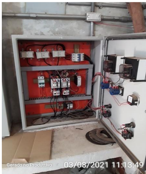
Quadro de comando
