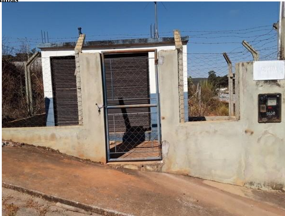
Casa de bomba
