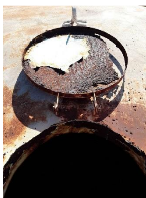
Condições da tampa de inspeção do reservatório
