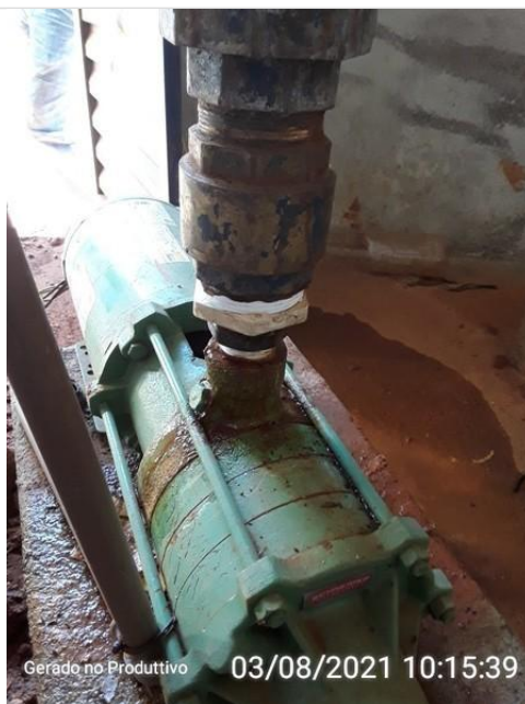
Vazamento no conjunto motobomba
