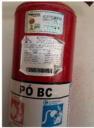
Etiquetado extintor indicando necessidade de manutenção em junho de 2021
