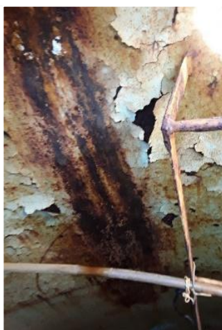
Pontos de oxidação/corrosão no interior do reservatório
