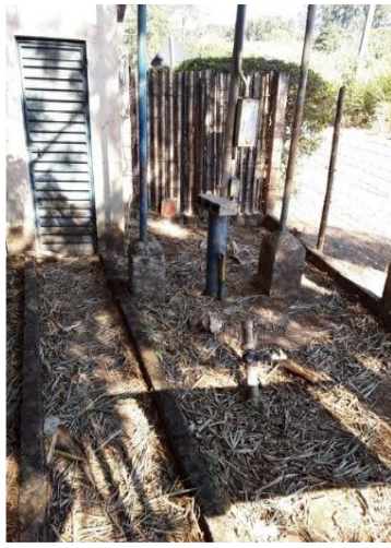
Poço sem a bomba de sucção
