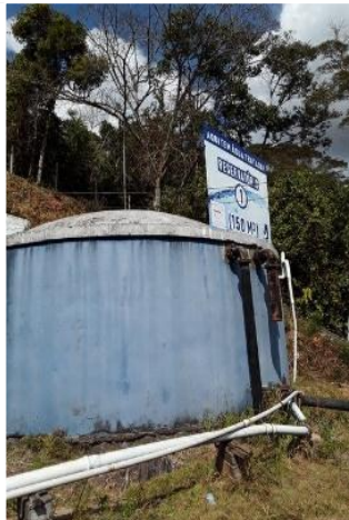
Reservatório ETA 150 m³
