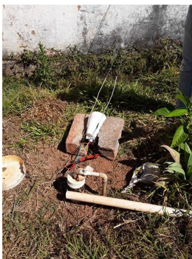
Fios e cabos elétricos do poço sem proteção.
