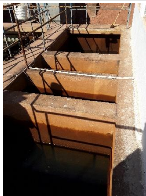
Filtros em operação da ETA
