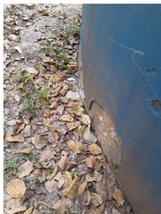
Ponto no reservatório com danificação na estrutura
