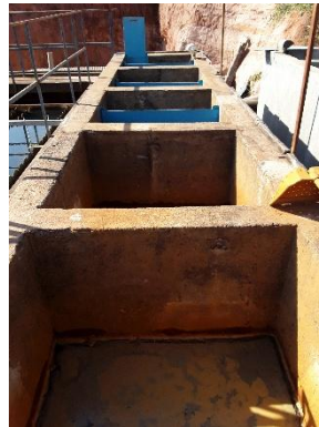
Floculadores em operação na ETA
