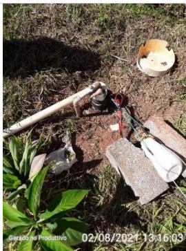
Poço de abastecimento de água do Povoado de São Manoel
