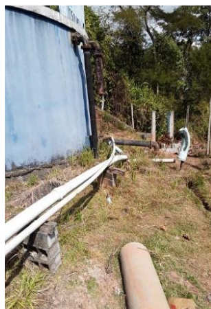
Tubulação de entrada temporária, sem válvula de fechamento.
