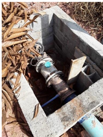
Instalação do macromedidor na saída dos reservatórios ETA I e ETA II
