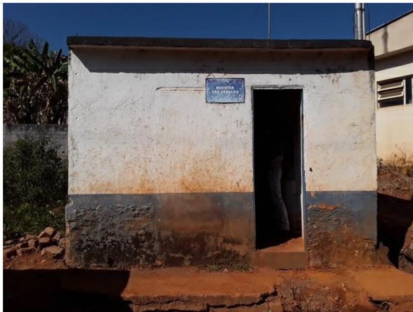
Casa de Bomba São Geraldo
