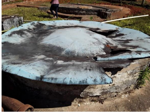
Estado de conservação da tampa do reservatório de água bruta
