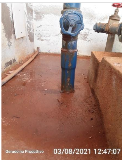
Pequeno vazamento no registro
