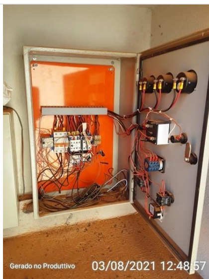
Quadro de comando
