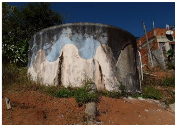
Reservatório para armazenamento de água de lavagem dos filtros
