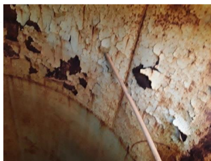
Pontos de oxidação/corrosão no interior do reservatório (2)
