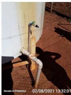
Tubulação de saída do reservatório
