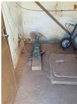
Estação Elevatória de Água Bruta no Distrito de São Manoel
