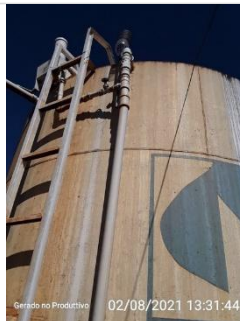
Tubulação de entrada do reservatório
