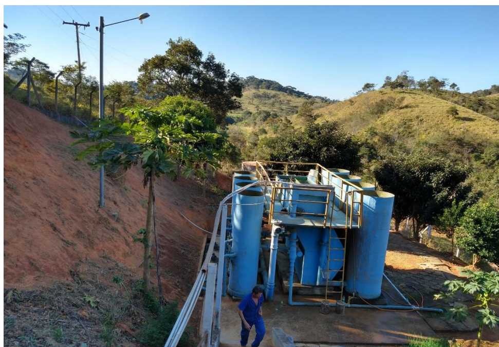
Figura 19 – Estruturas da ETA de Manejo
