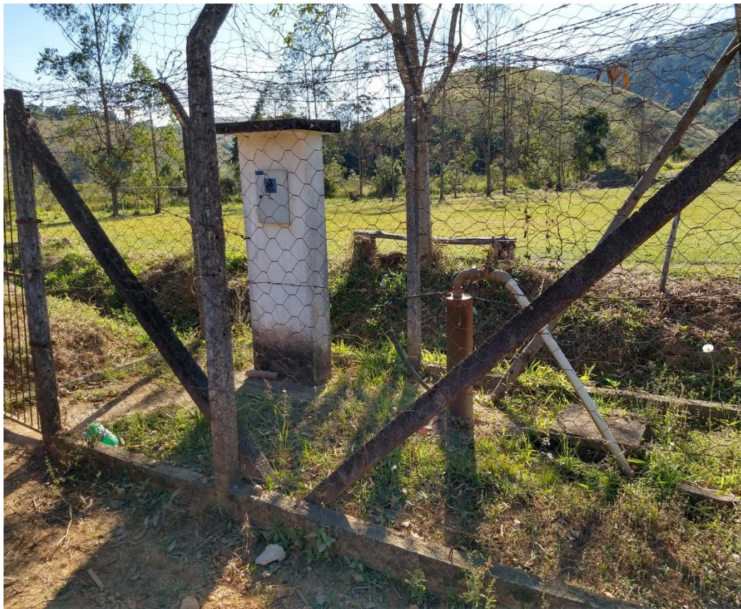
Figura 10 – Captação subterrânea sem identificação no poço tubular de Orvalho
