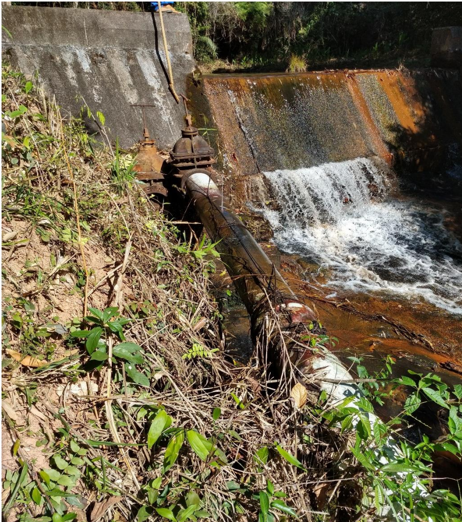
Figura 3 – Área no entorno da Captação sem identificação e delimitação
