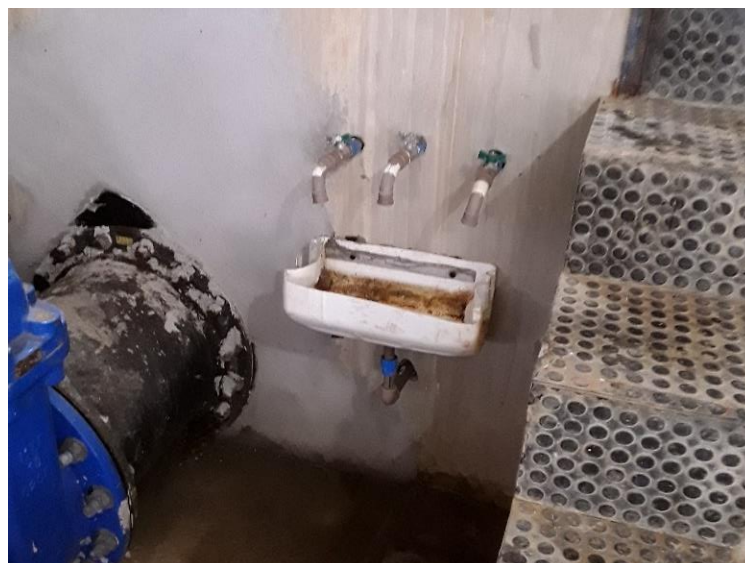
Figura 152 – Torneira para coleta de água dos filtros
