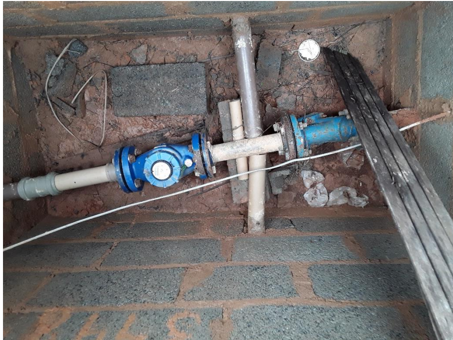
Figura 194 – Medidor de vazão – Poço tubular Buieié
