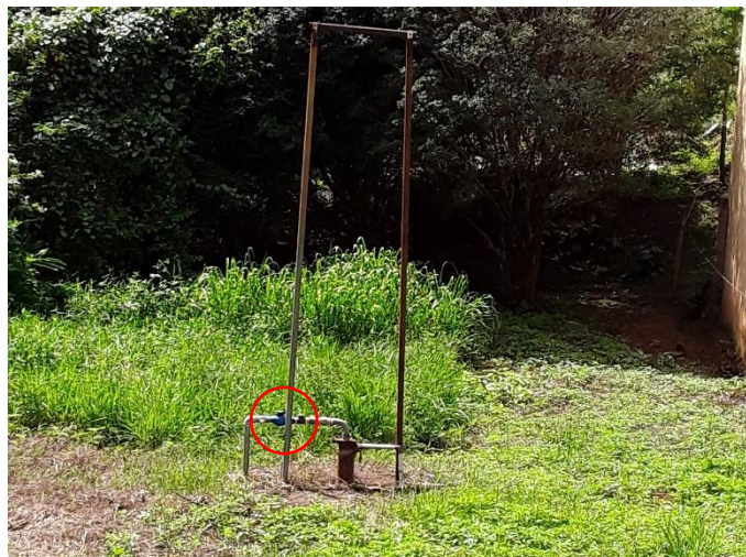
Figura 79 – Poço Tubular – Rua Nova 2
