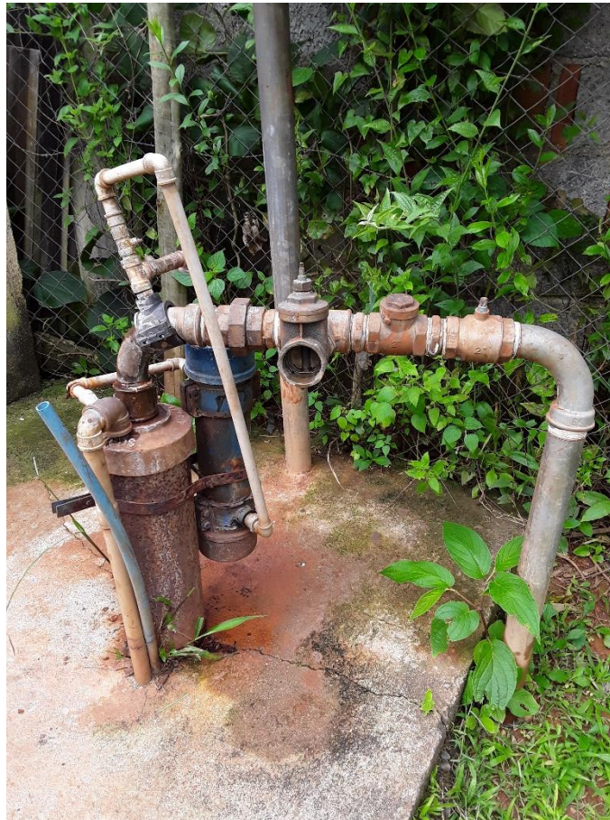
Figura 69 – Poço Tubular – Sol Nascente
