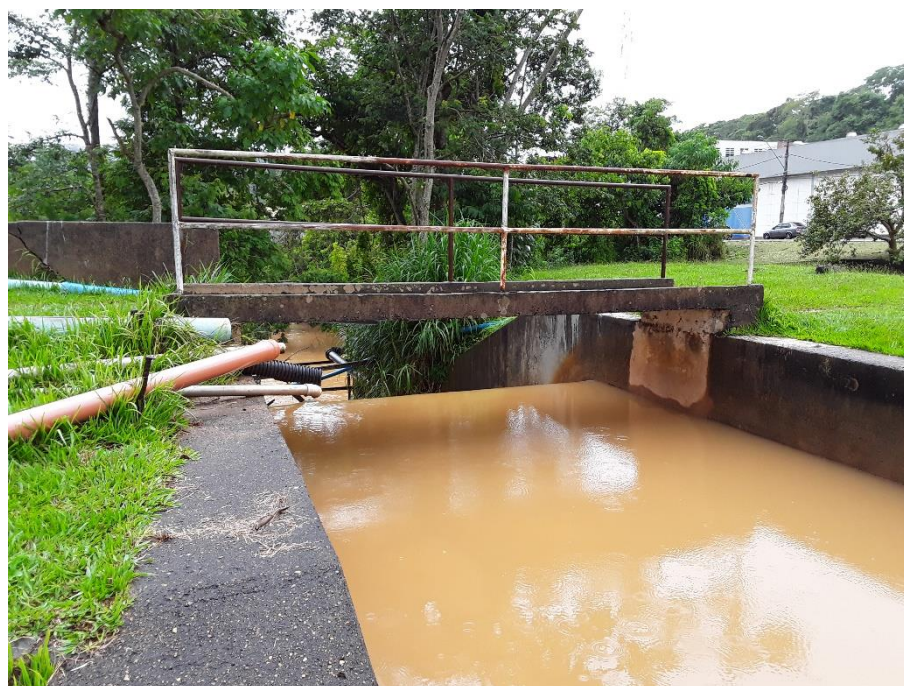
Figura 18 – Tubos próximos a captação
