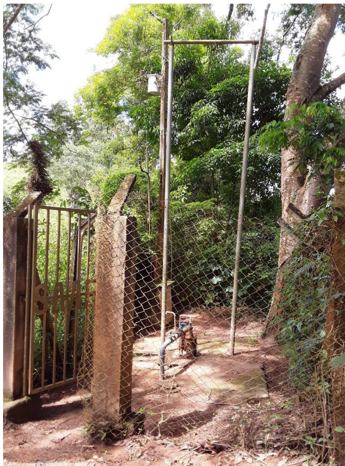
Figura 61 – Área da Captação subterrânea – Novo Paraíso
