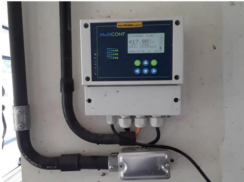
Figura 130 – Painel do medidor de vazão
