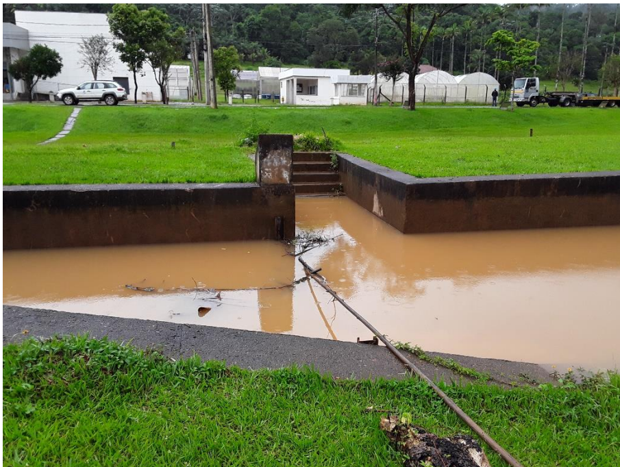
Figura 16 – área da captação – São Bartolomeu
