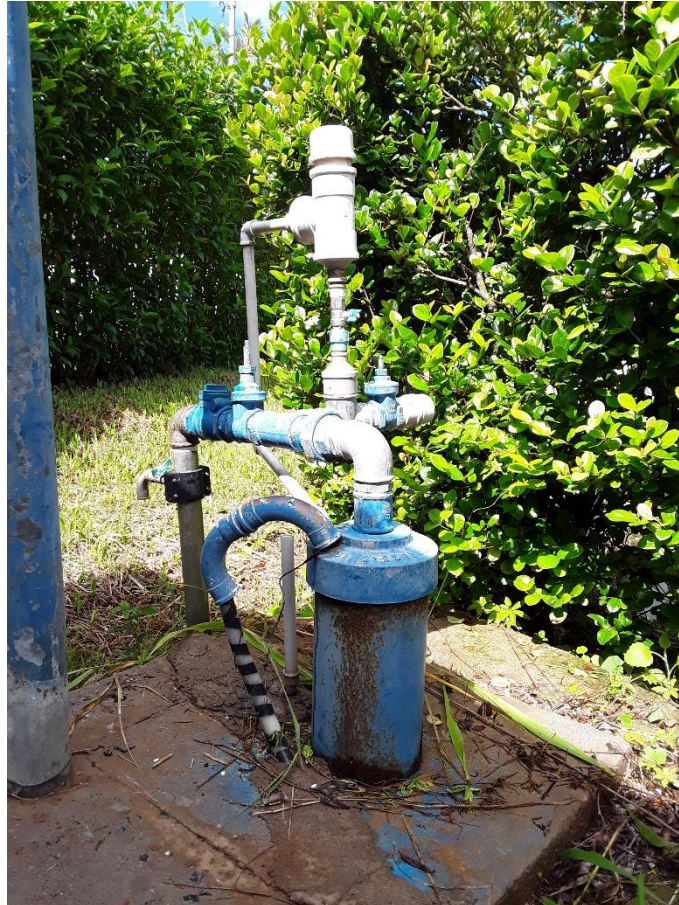
Figura 52 – Área do Poço tubular – Octávio Pacheco
