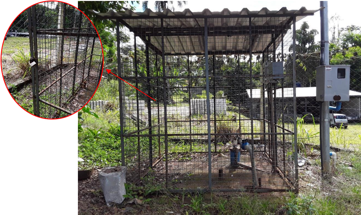
Figura 75 – Área da captação subterrânea – Rua Nova 1
