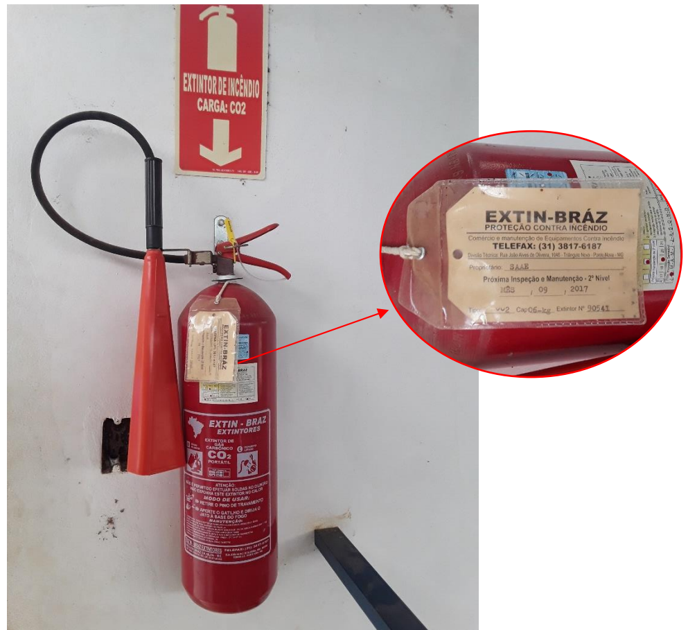
Figura 175 – Extintor de incêndio da EEAT – ETA II
