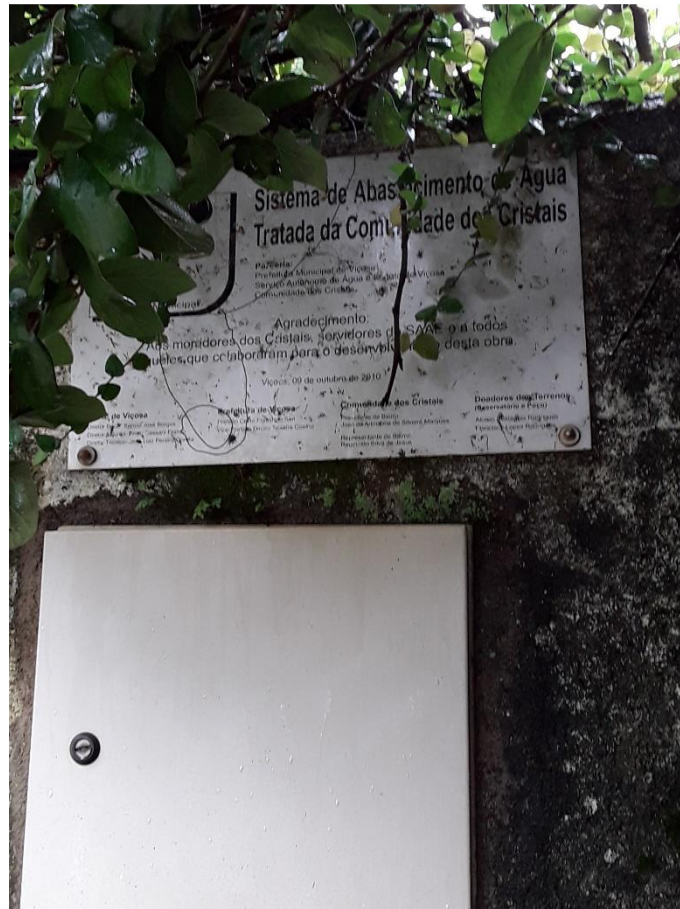
Figura 73 – Placa de Identificação e painel de controle - Cristais
