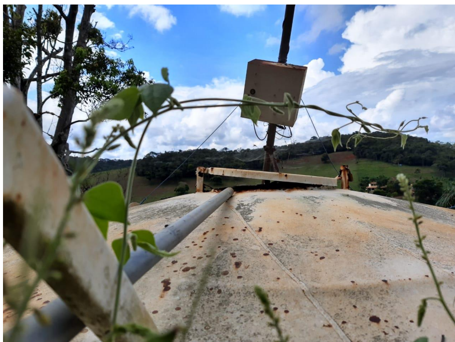
Figura 184 – Tampa de inspeção e estrutura do sistema de telemetria – Córrego São João
