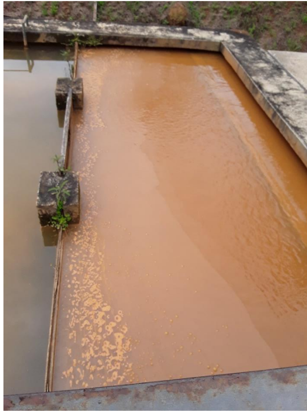
Figura 132 – Decantador – ETA II
