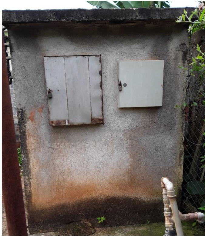
Figura 70 – Área do painel de controle – Sol Nascente
