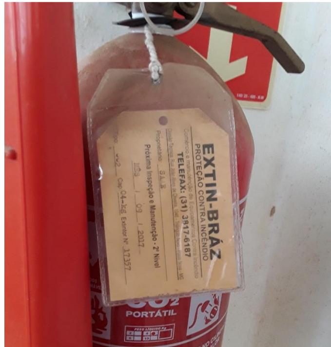
Figura 221 – Extintor de incêndio
