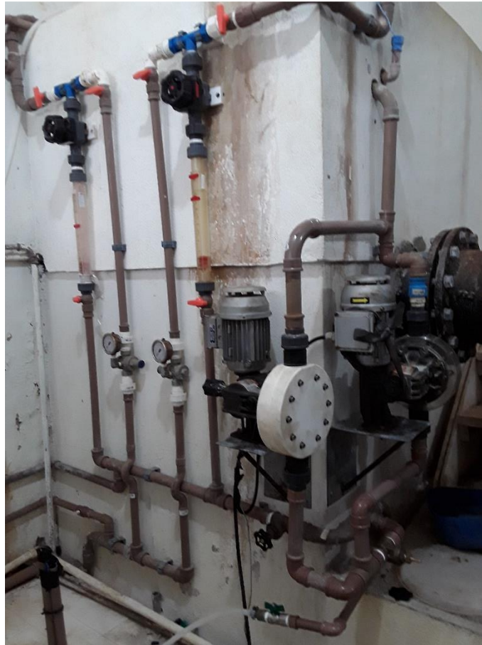
Figura 151 – Sistema de Bombeamento
