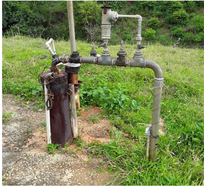
Figura 180 – Poço Tubular – Córrego São João
