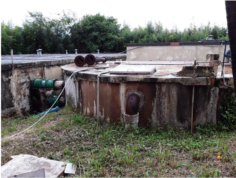
Figura 93 – Tanque de Contato
