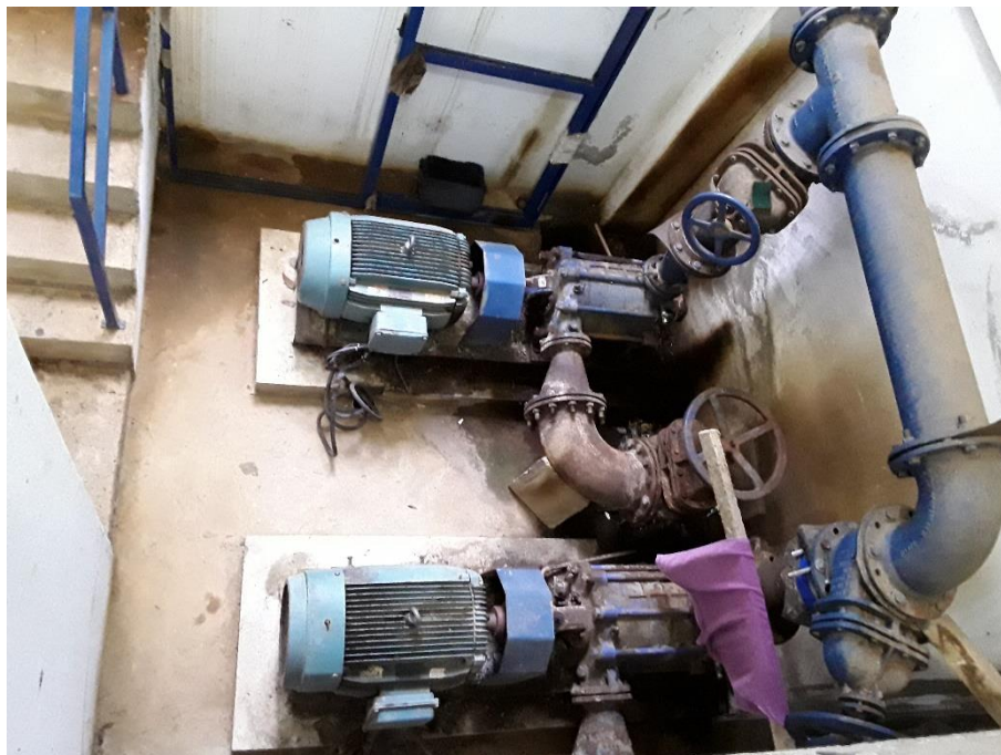
Figura 124 – Conjuntos motobomba – ETA I
