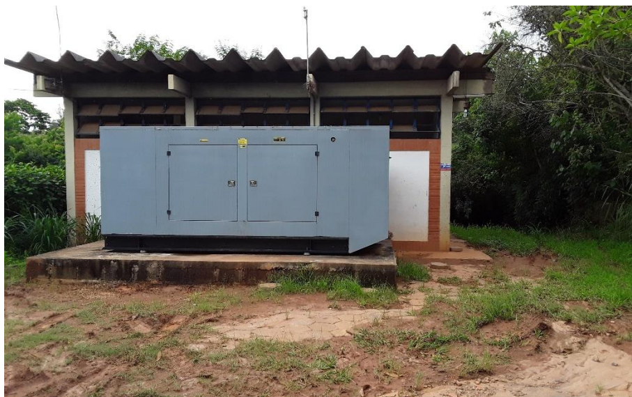
Figura 38 – Casa de bombas – Rio Turvo Sujo
