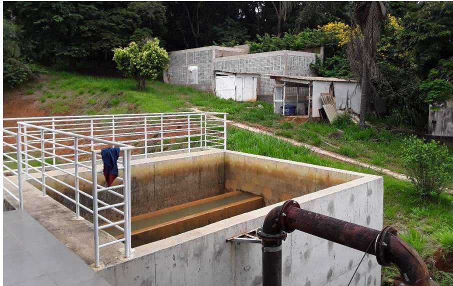
Figura 134 – Filtros novos – ETA II
