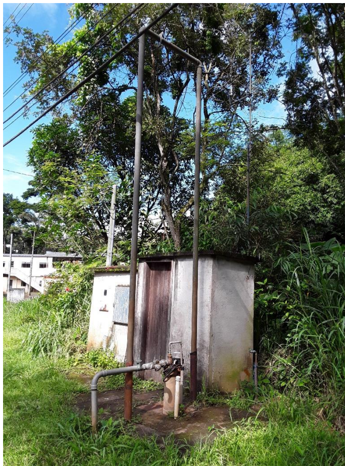
Figura 49 – área do poço Tubular – Vila Alves
