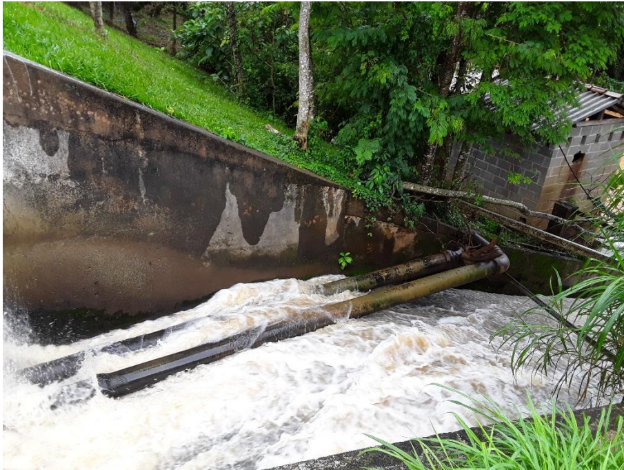
Figura 15 – Adutoras de água Bruta
