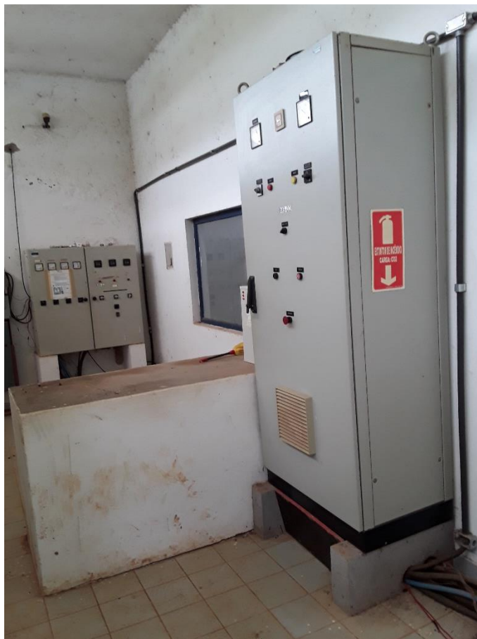
Figura 42 – Painéis de controle
