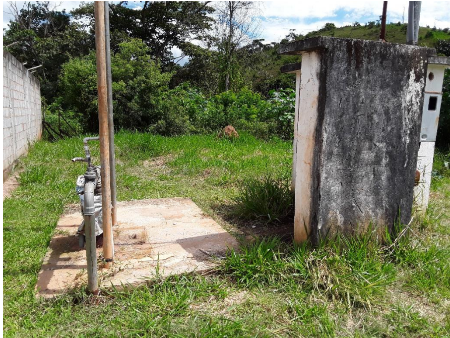
Figura 64 – Área da captação subterrânea – São Francisco de Assis
