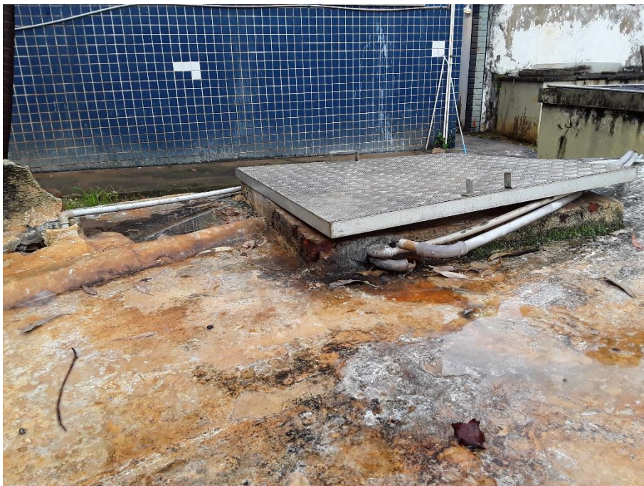
Figura 94 – Tampa de inspeção do tanque de contato
