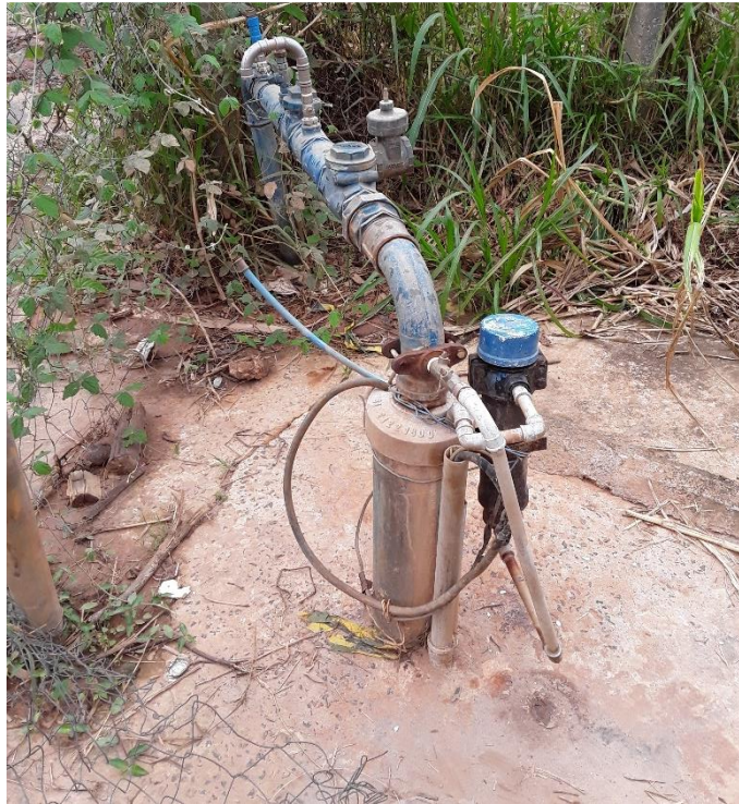
Figura 47 – Poço Tubular – Novo Silvestre
