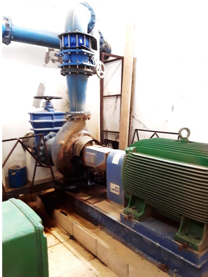
Figura 178 – Conjunto motobomba - ETA II
