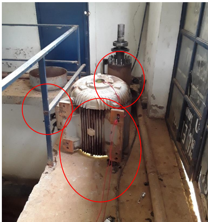
Figura 40 – Área interna da cada de bombas
