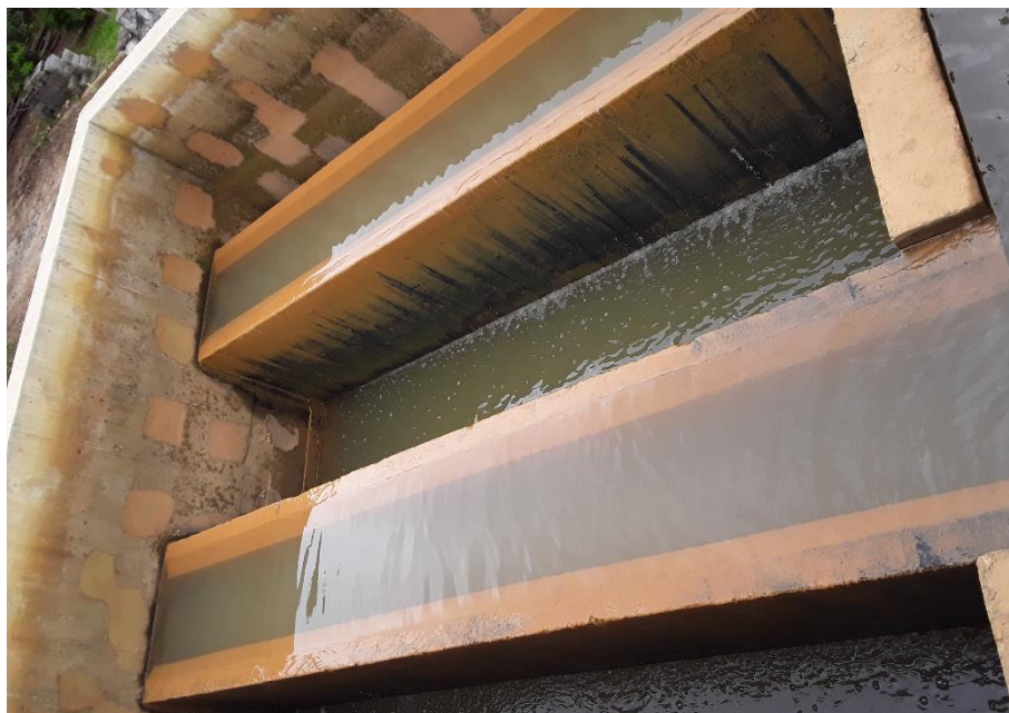
Figura 133 – Filtro – ETA II
