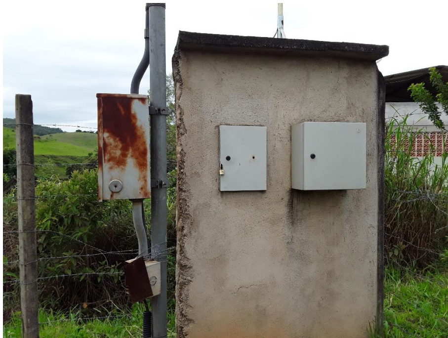
Figura 195 – Local do painel de controle - Buieié
