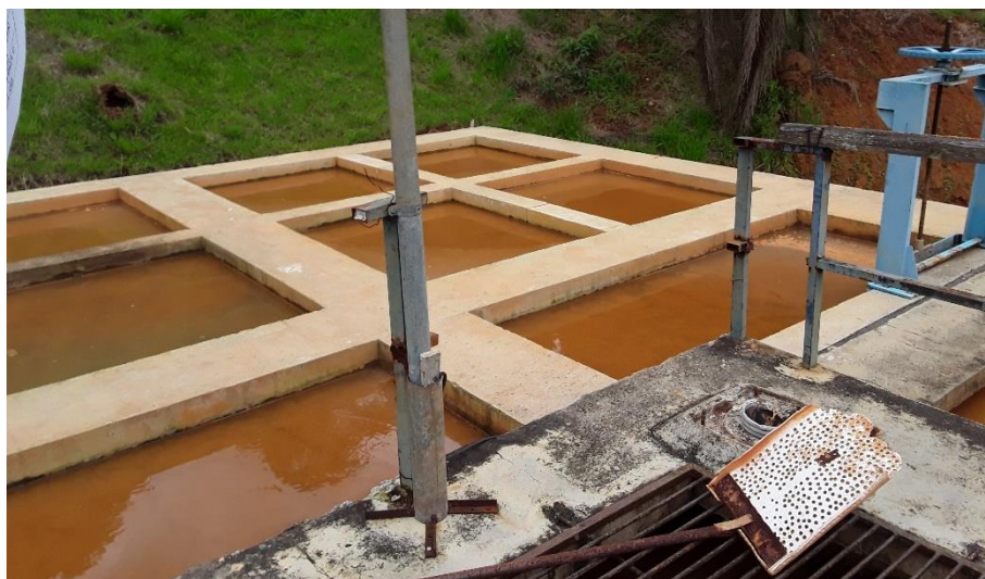
Figura 131 – Floculadores – ETA II
