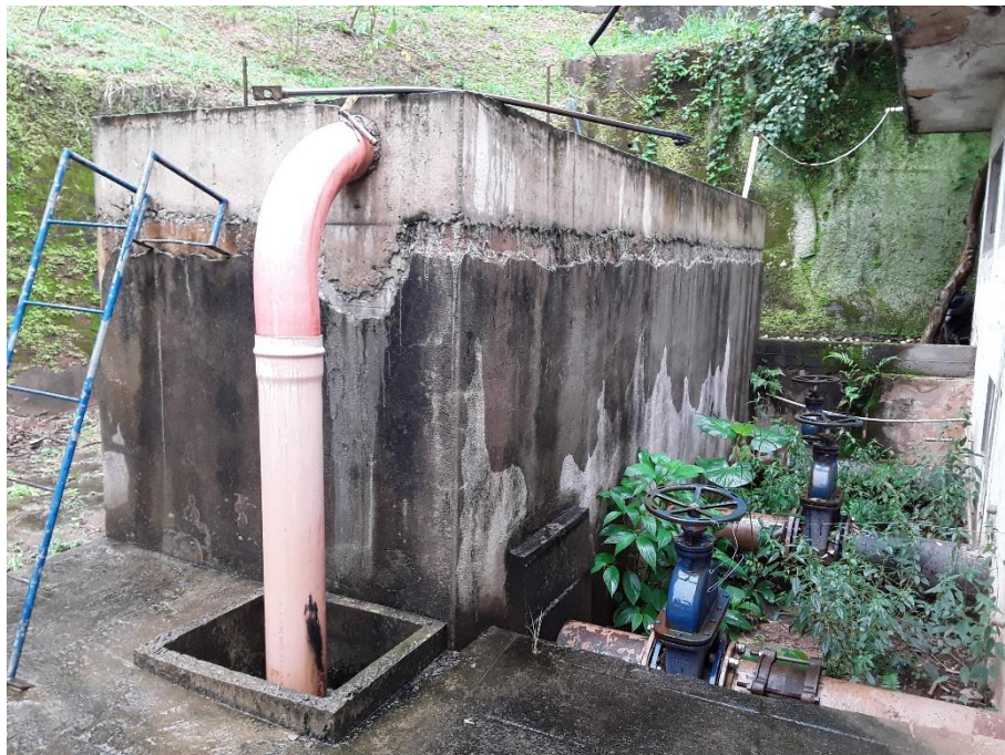
Figura 22 – Tanque de água bruta
