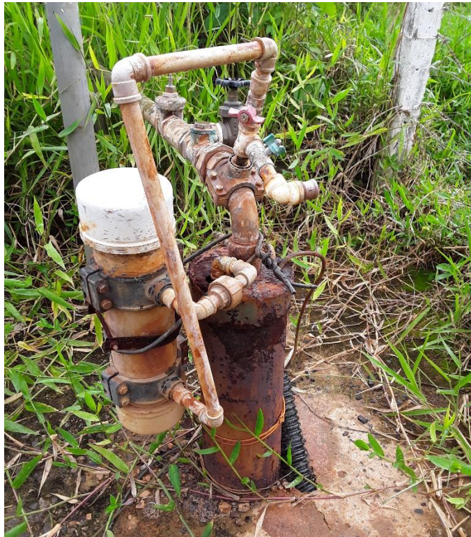
Figura 186 – Poço Tubular - Pau de Cedro
