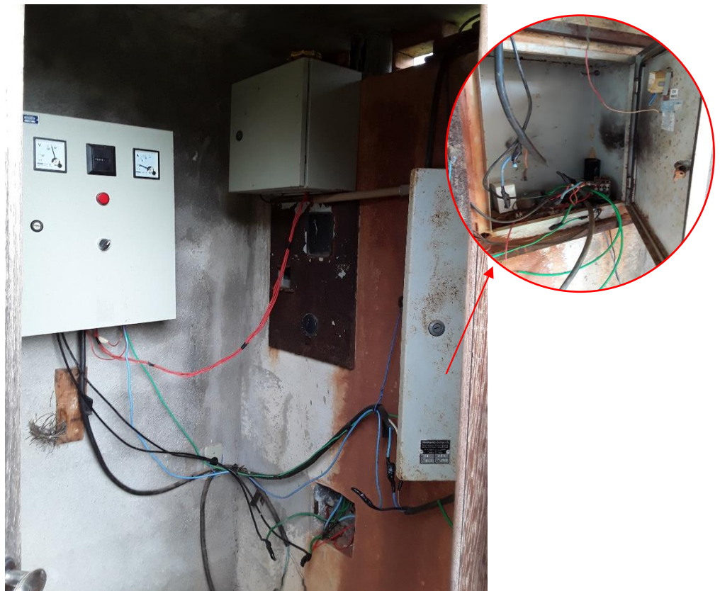
Figura 181 – Painel de controle – Córrego São João
