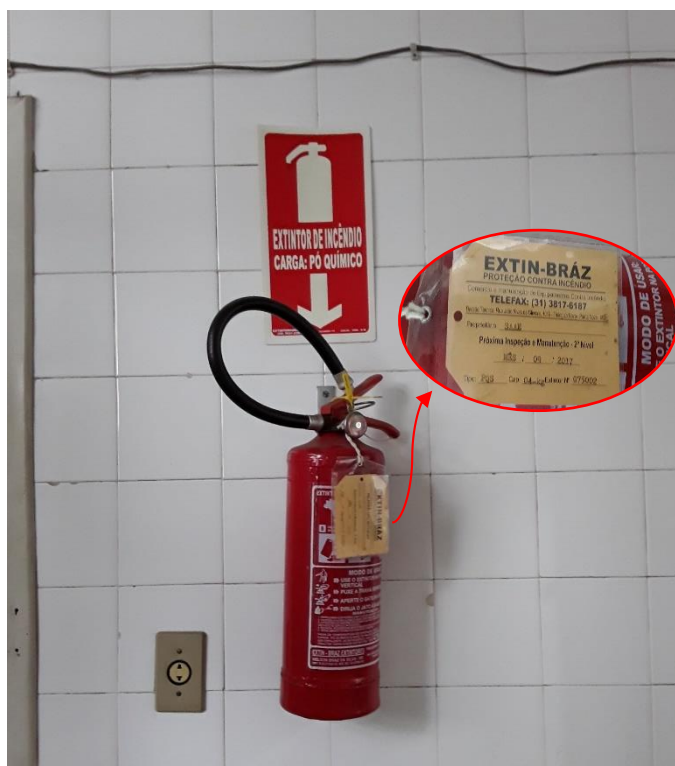
Figura 10 – Extintor de incêndio
