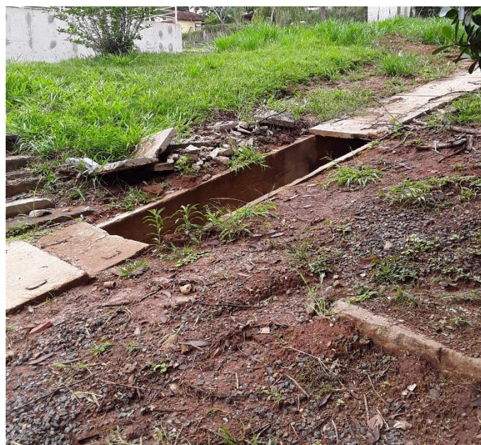
Figura 172 – Acesso a área de armazenamento de produtos químicos danificado
