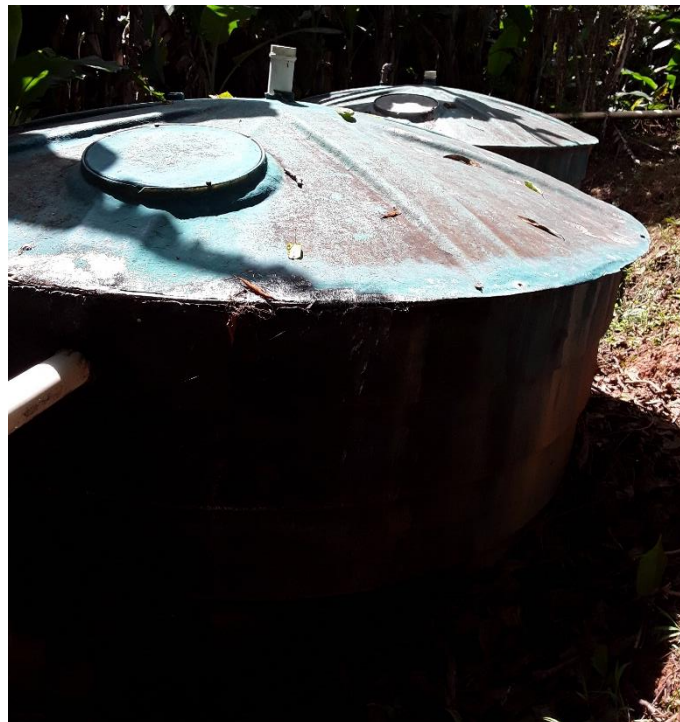
Figura 239 – Tanque séptico e filtro anaeróbio – São Francisco de Assis
