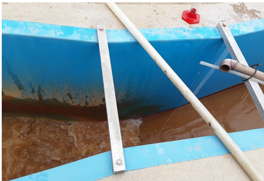
Figura 129 – Calha Parshall – ETA II
