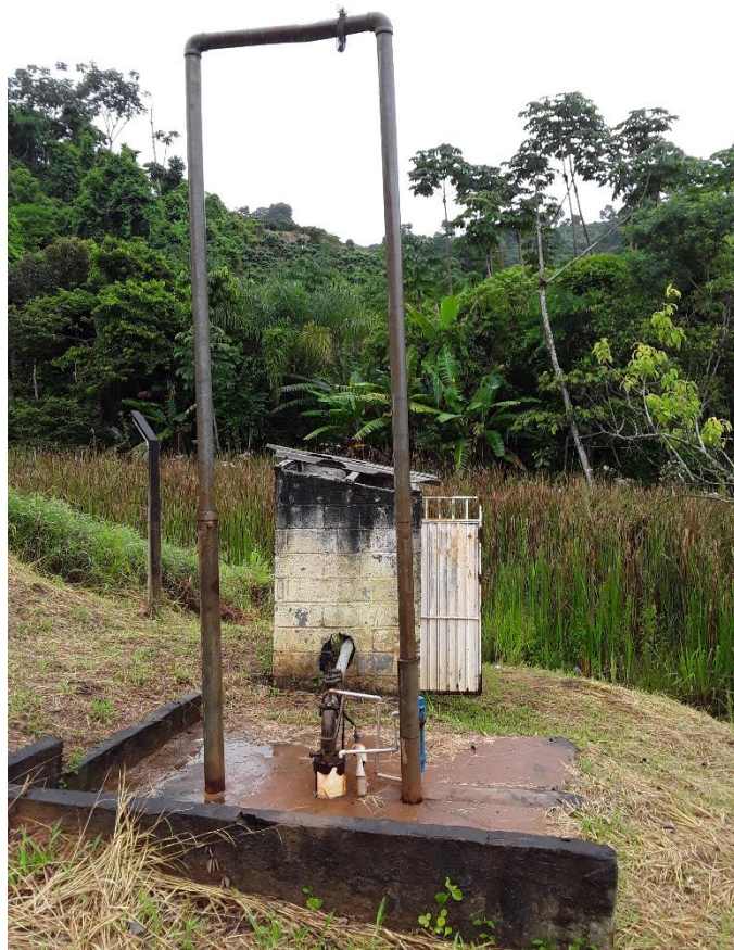
Figura 58 – Área da captação subterrânea – Nova Viçosa
