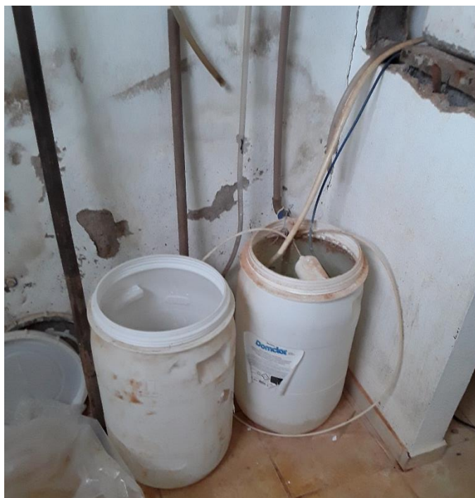
Figura 207 – Área de dosagem do hipoclorito de sódio
