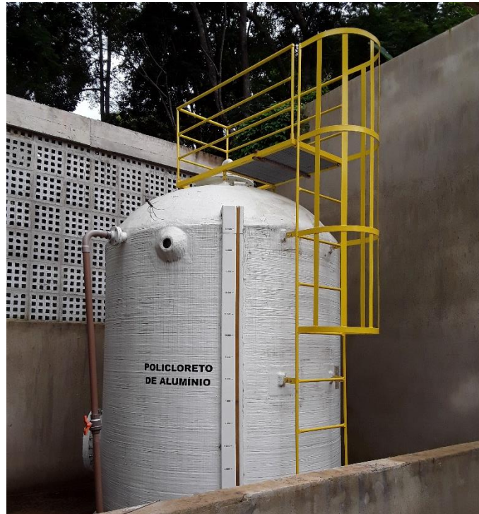
Figura 171 – Tanque de policloreto de alumínio
