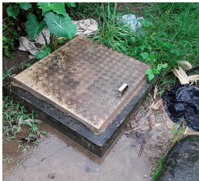
Figura 222 – Tampa de inspeção do tanque de contato
