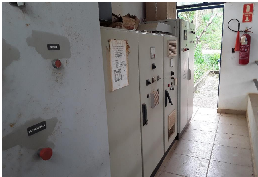
Figura 174 – Painéis de controle EEAT – ETA II
