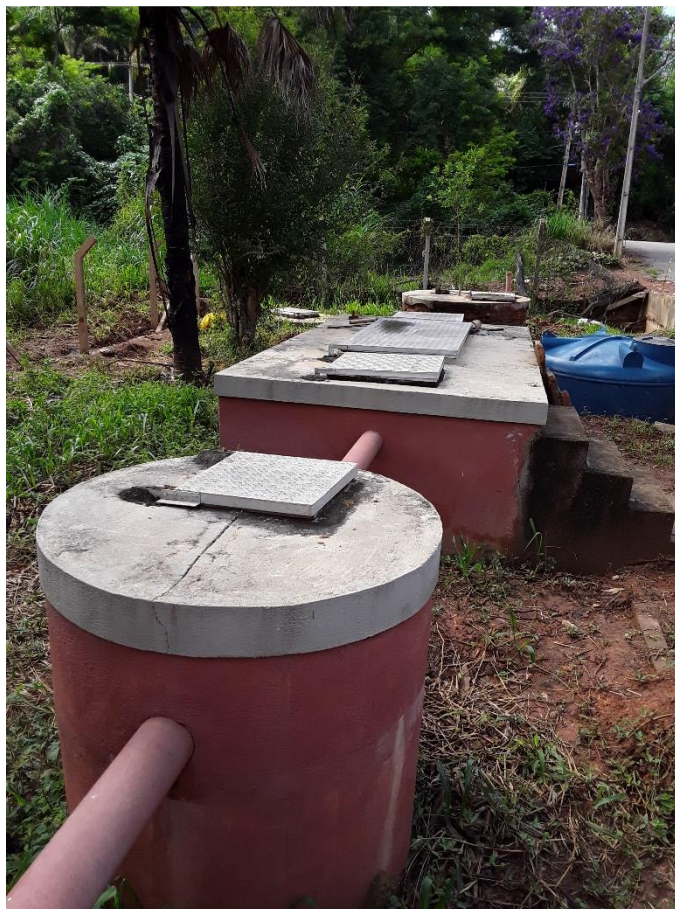
Figura 226 – Estruturas da ETE – Romão dos Reis
