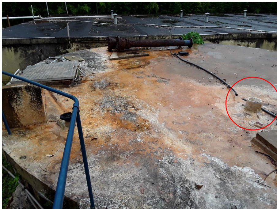
Figura 95 – Cobertura do tanque de contato
