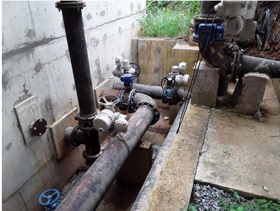
Figura 136 – Tubulações do filtros – ETA II
