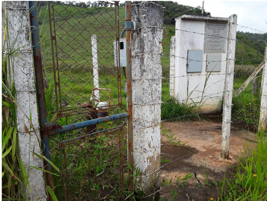
Figura 185 – Área da captação subterrânea – Pau de Cedro
