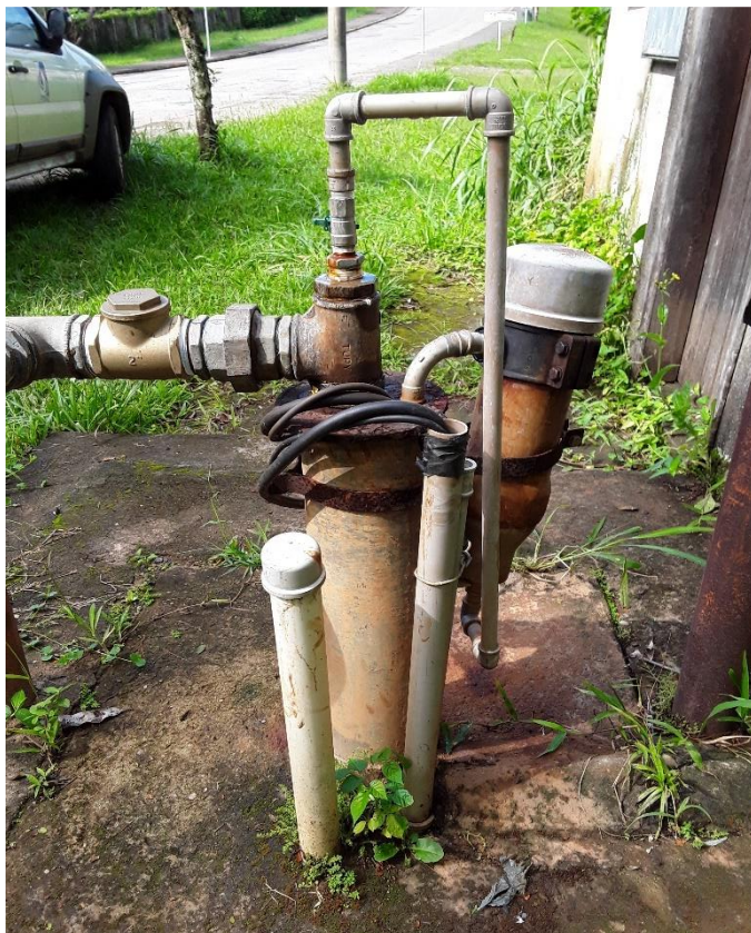
Figura 50 – Poço tubular – Vila Alves
