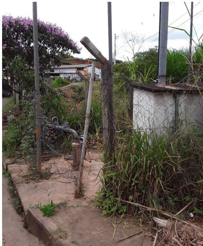
Figura 46 – Área do poço tubular Novo Silvestre
