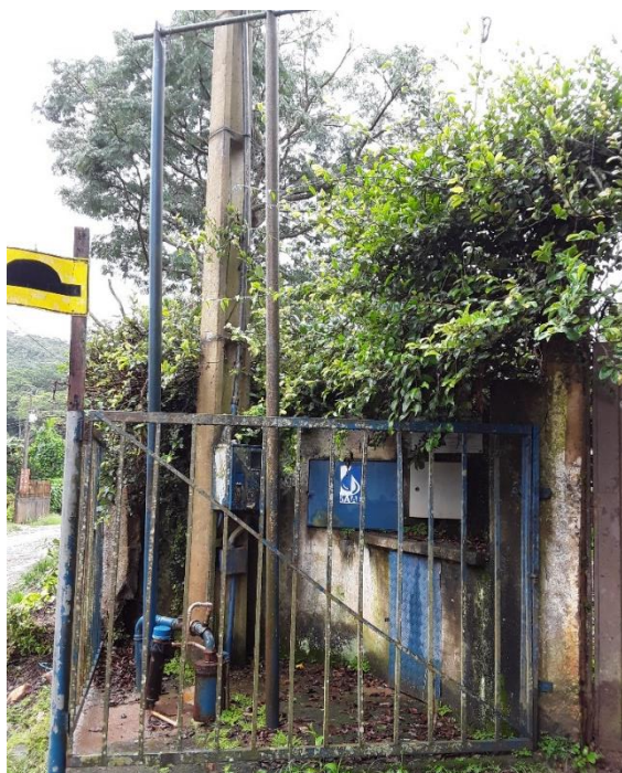
Figura 71 – área da captação subterrânea - Cristais
