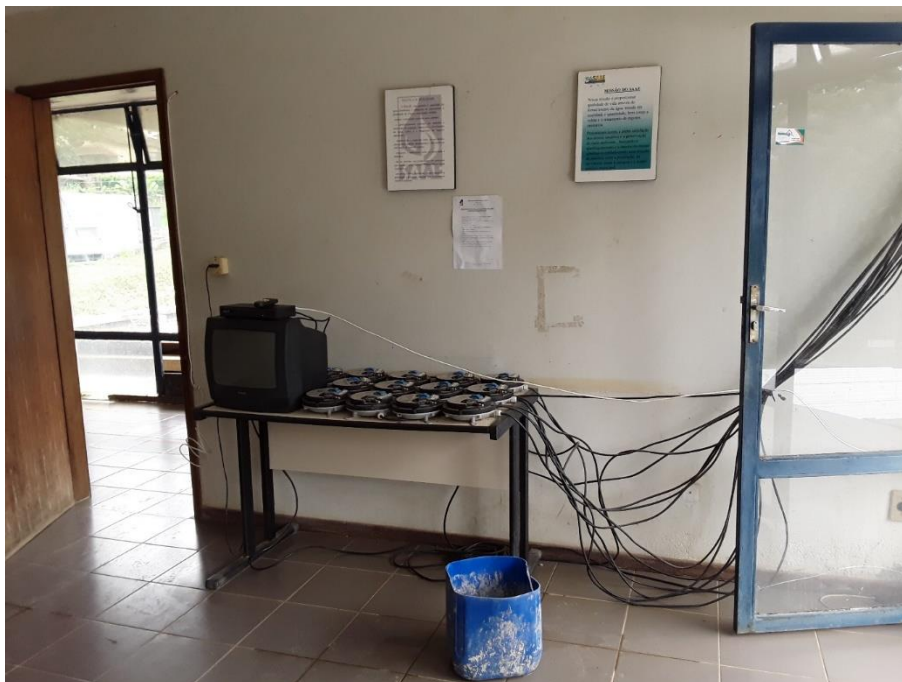
Figura 157 – Controles das comportas dos filtros
