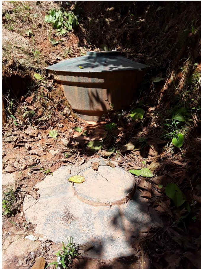
Figura 240 – Sistema de gradeamento e desarenador – São Francisco de Assis
