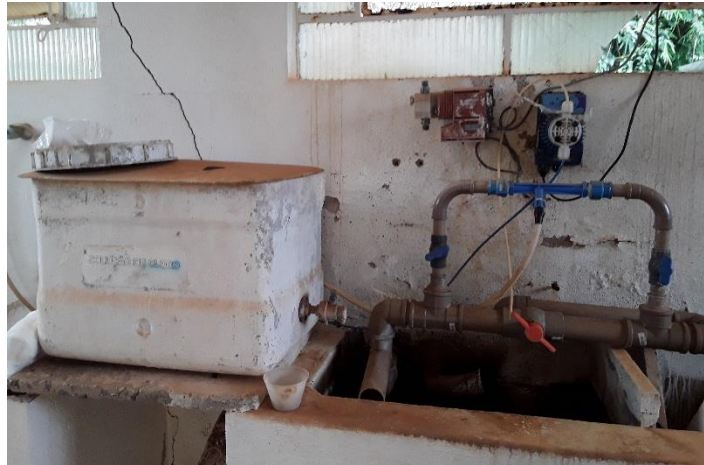
Figura 21 – Tanque de Contato – Cachoeira de Santa Cruz
