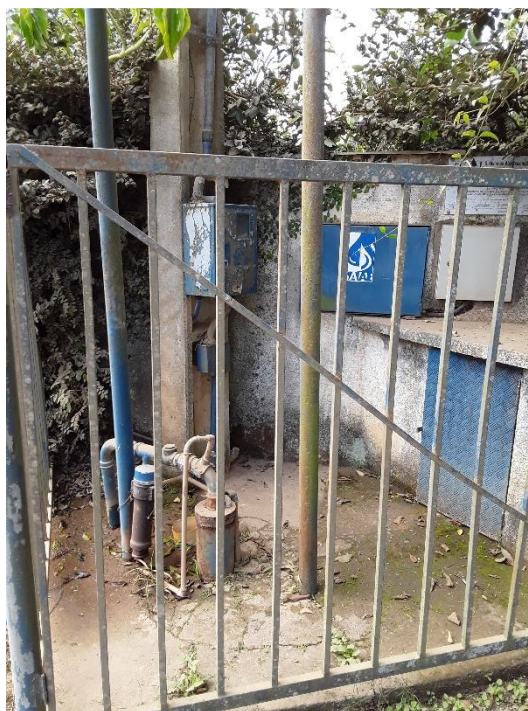
Figura 45 - Área da captação subterrânea – Cristais
