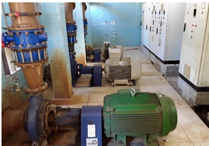
Figura 4 – Casa de bombas - Ribeirão São Bartolomeu
