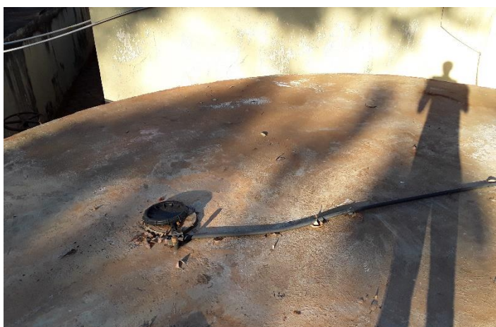
Figura 60 – Tanque de contato – ETA I
