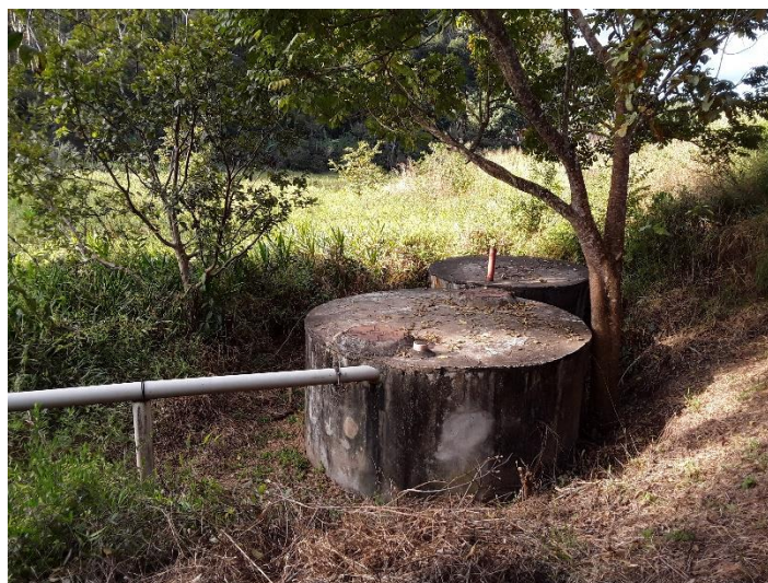
Figura 81 – ETE Zona Rural dos Nobres
