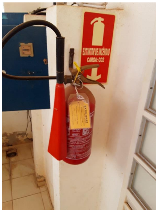
Figura 29 – Extintor de incêndio – São José do Triunfo
