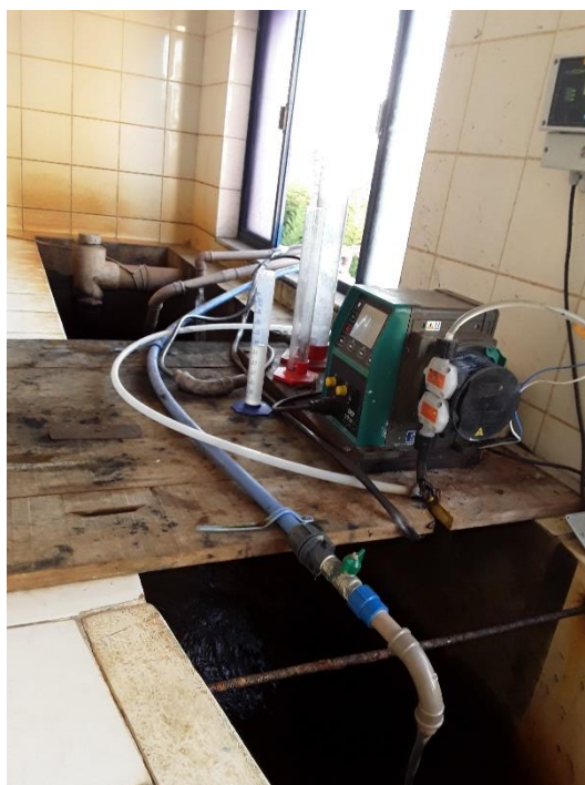
Figura 51 – Bomba dosadora – ETA I
