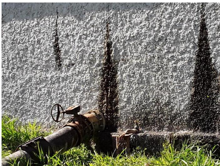
Figura 68 – Vazamento no reservatório – ETA II
