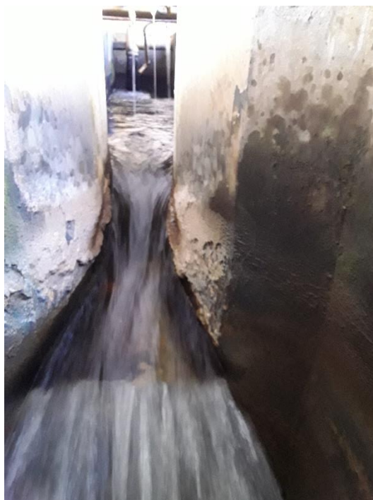
Figura 50 – Calha Parshall – ETA I
