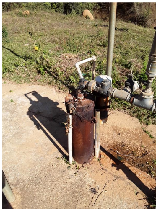
Figura 11 – Captação subterrânea – Córrego São João
