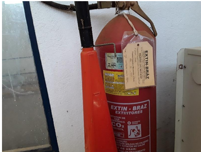
Figura 8 – Extintor de Incêndio – Rio Turvo Sujo
