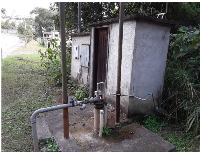
Figura 31 – Captação subterrânea – Vila Alves
