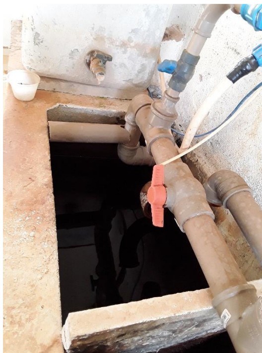
Figura 20 – Tanque de Contato – Cachoeira de Santa Cruz
