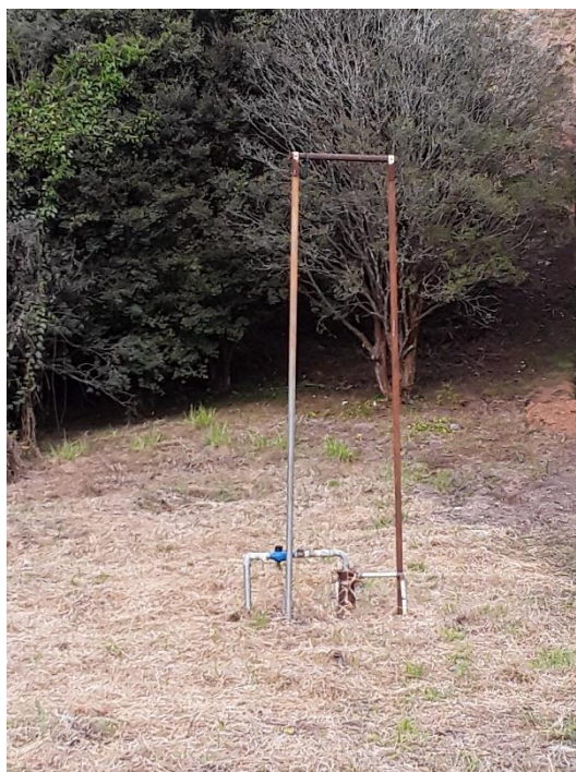
Figura 48 – Captação subterrânea – Rua Nova
