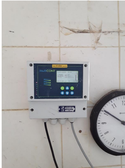
Figura 52 – Macromedidor – ETA I
