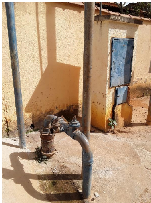
Figura 24 – Captação Subterrânea 1 – São José do Triunfo
