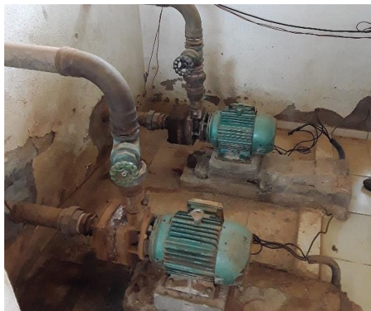
Figura 19 – Casa de Bombas – Cachoeira de Santa Cruz
