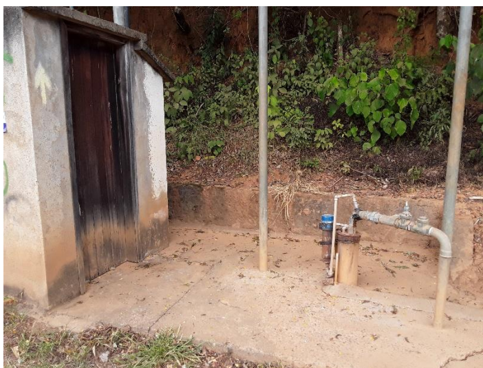
Figura 35 – Área da captação subterrânea – Romão dos Reis
