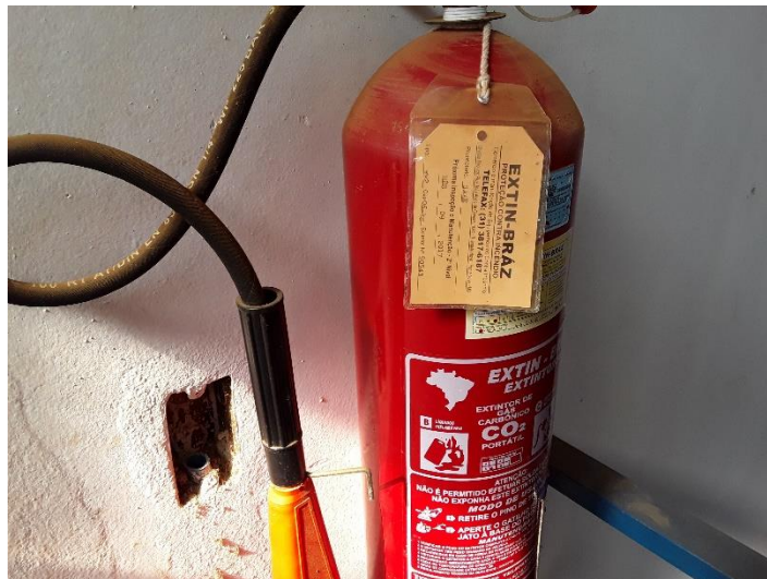
Figura 71 – Extintor de incêndio – ETA II
