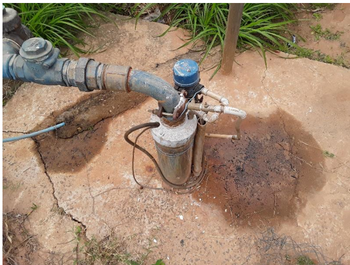
Figura 15 – Captação subterrânea – Novo Silvestre
