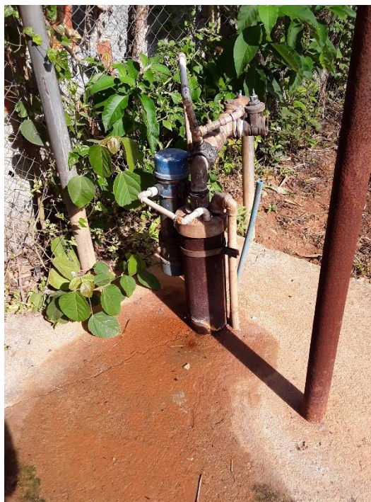
Figura 44 - Captação subterrânea – Sol Nascente
