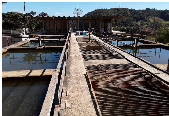
Figura 64 – Decantadores – ETA II
