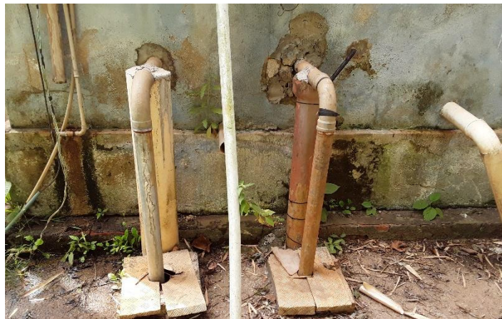
Figura 22 – Tubulações – Cachoeira de Santa Cruz
