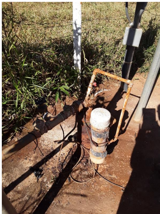
Figura 13 – Captação subterrânea – Pau de Cedro
