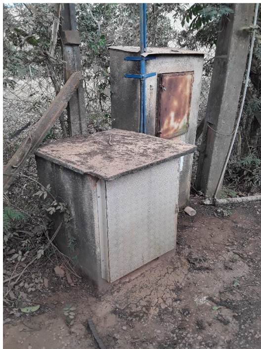
Figura 40 – Quadro de Comando – Novo Paraíso
