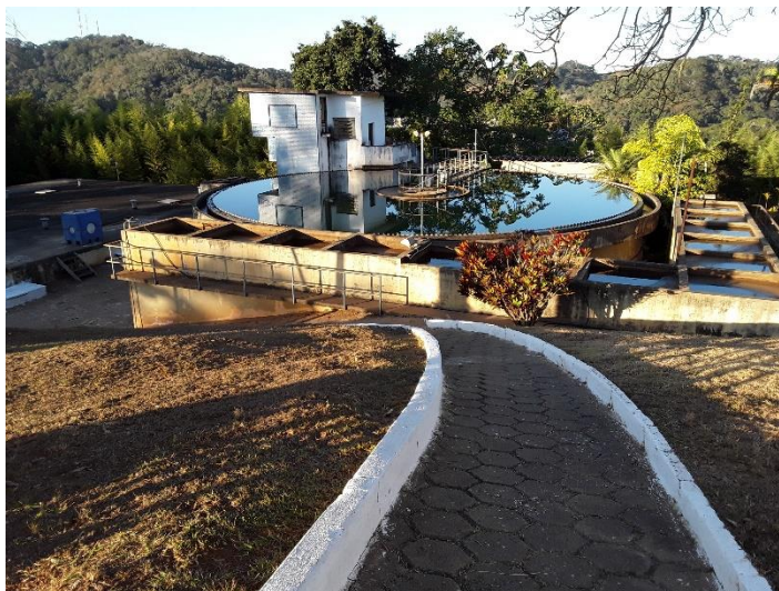
Figura 62 – Estação de Tratamento de água – ETA I
