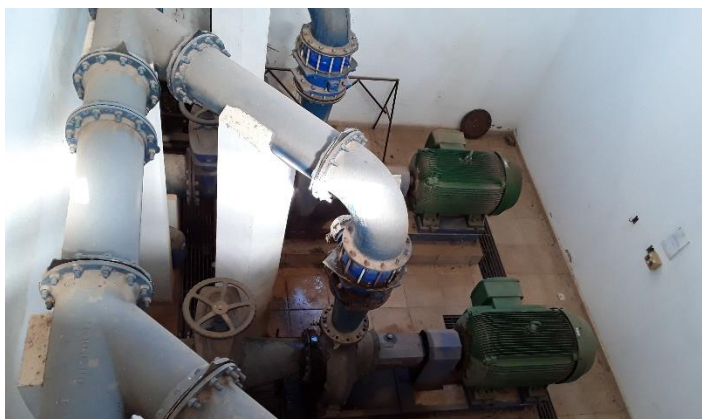
Figura 69 – Casa de Bombas – ETA II
