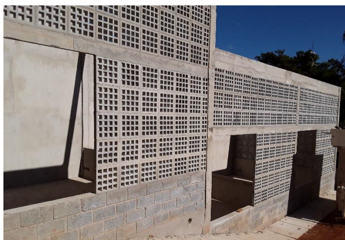
Figura 66 – Estrutura para armazenar produtos químicos – ETA II
