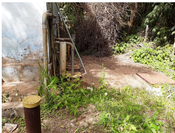
Figura 23 – Área da Casa de Bombas – Cachoeira de Santa Cruz
