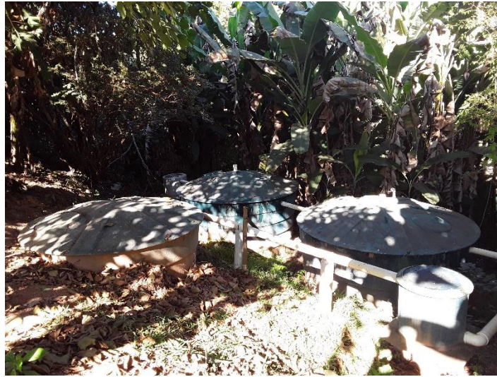
Figura 78 – Área da ETE São Francisco de Assis
