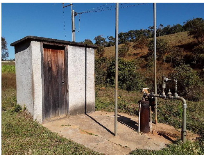
Figura 10 – Área da captação subterrânea – Córrego São João
