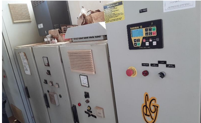
Figura 70 – Painel de Controle – ETA II
