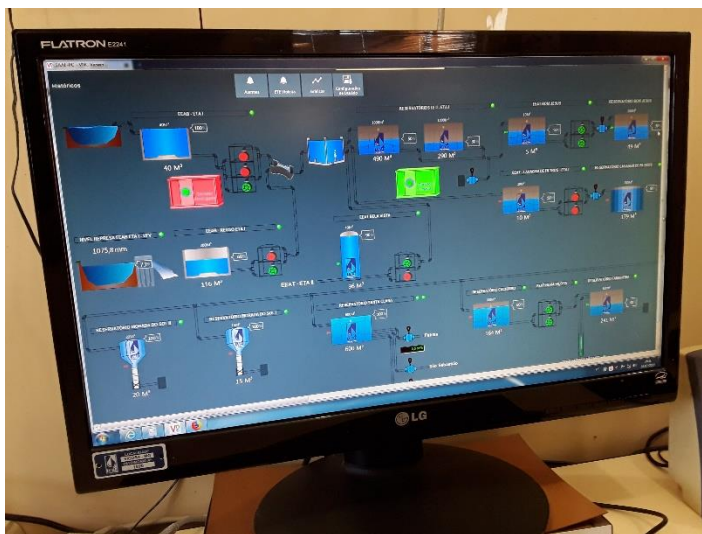
Figura 56 – Sistema de telemetria – ETA I
