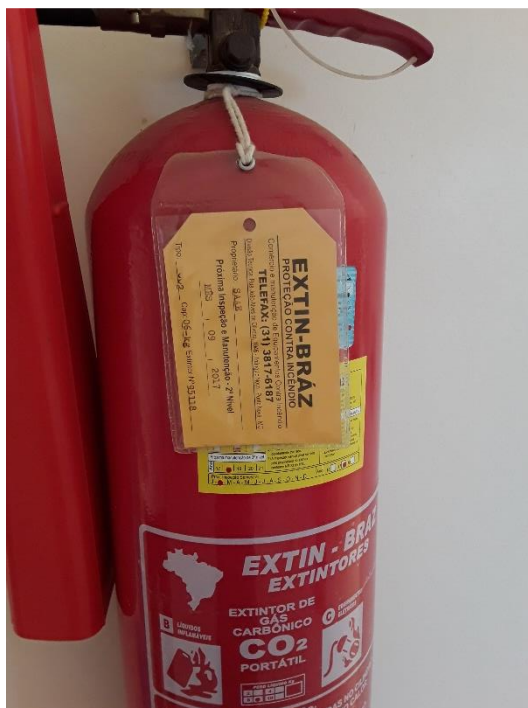
Figura 54 – Extintor de incêndio
