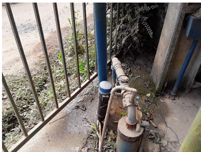
Figura 46 - Captação subterrânea – Cristais
