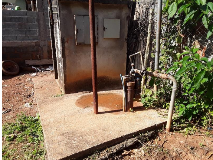
Figura 43 - Área da captação subterrânea – Sol Nascente
