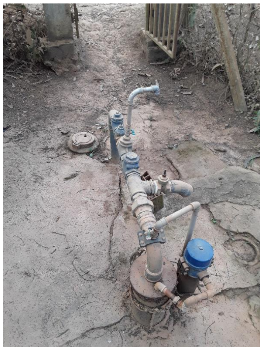
Figura 39 – Captação subterrânea – Novo Paraíso
