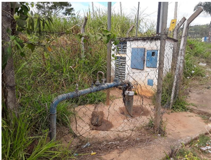
Figura 14 – Área da captação subterrânea – Novo Silvestre
