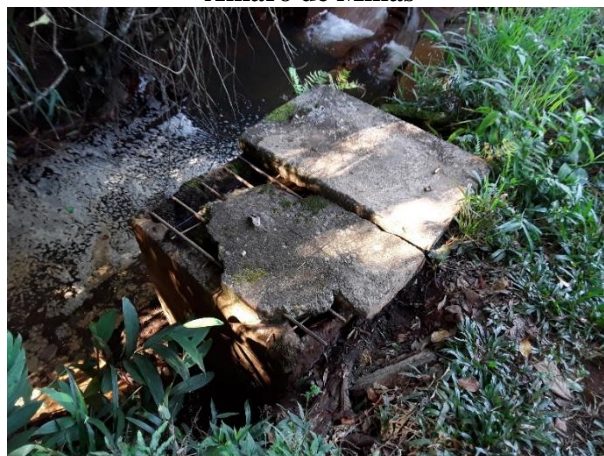
Figura 206 – Condições da caixa de passagem na adutora de água bruta do Distrito de Santo Amaro de Minas
