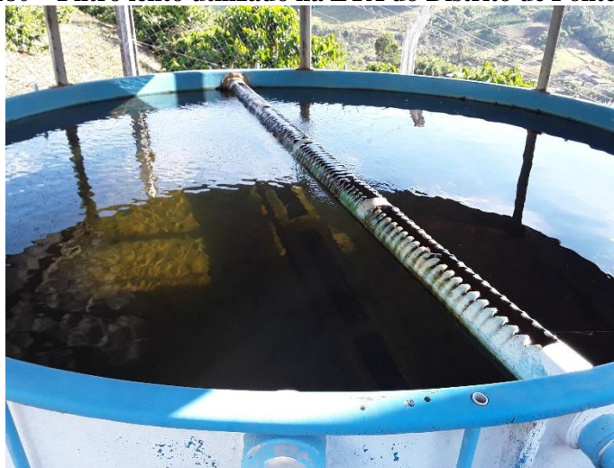
Figura 180 – Filtro lento utilizado na ETA do Distrito de Ponte do Silva.
