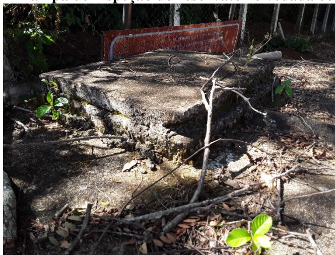
Figura 149 – Tampa de inspeção do reservatório vedada com concreto.
