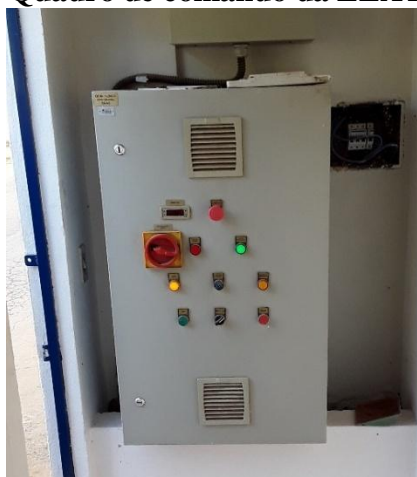
Figura 117 – Quadro de comando da EEAT Bom Jardim
