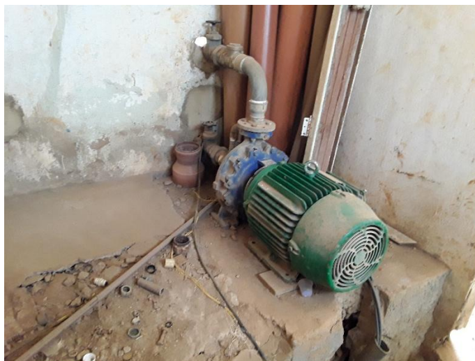
Figura 151 – Motobomba da EEAT do Distrito de Dom Corrêa.
