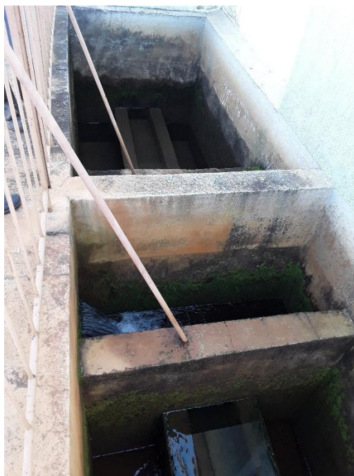
Figura 213 – Filtros da ETA do Distrito de Santo Amaro de Minas
