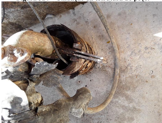
Figura 324 – Oxidação da estrutura do poço.
