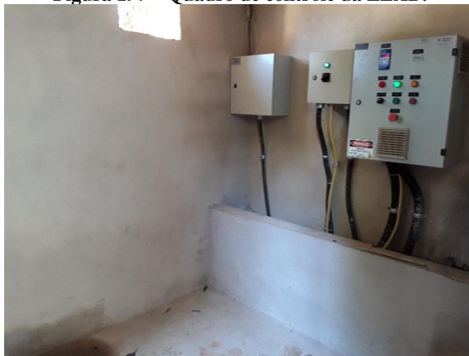
Figura 197 – Quadro de controle da EEAB.
