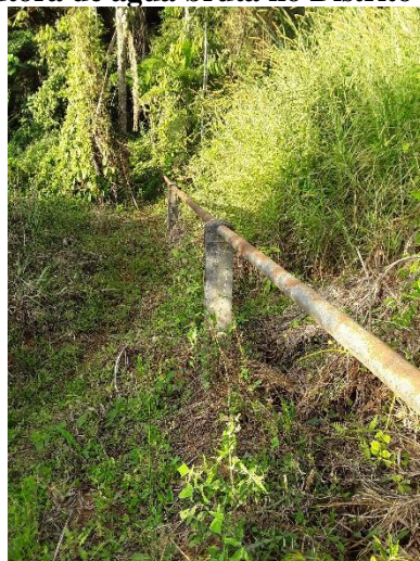
Figura 177 – Adutora de água bruta no Distrito de Ponte do Silva.
