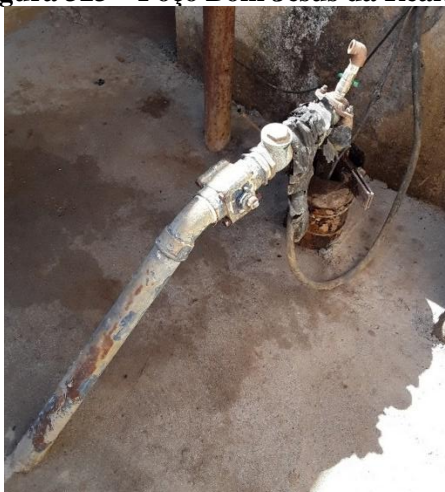
Figura 323 – Poço Bom Jesus da Realeza
