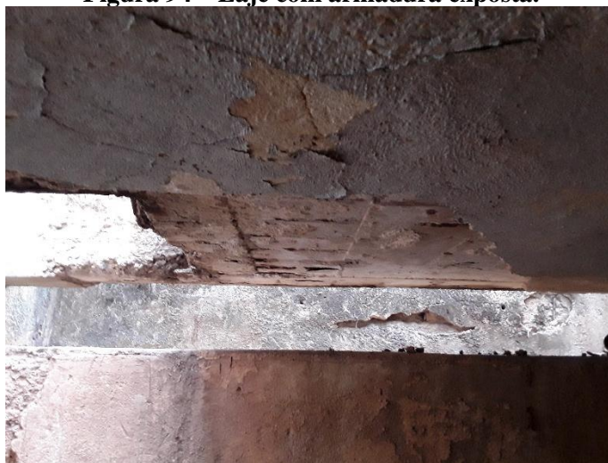
Figura 94 – Laje com armadura exposta.
