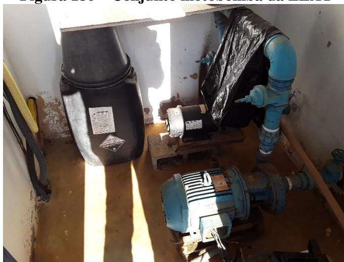
Figura 186 – Conjunto motobomba da EEAT
