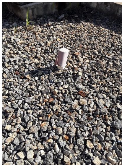
Figura 34 – Tubulação de Ventilação do tanque de contato com proteção improvisada
