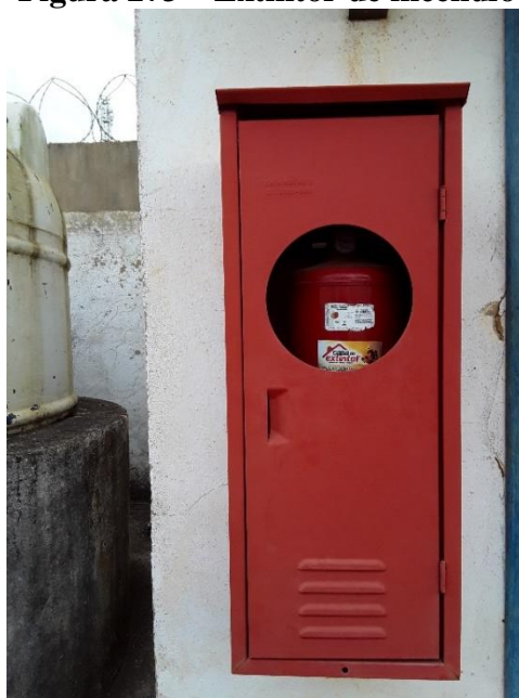
Figura 273 – Extintor de incêndio
