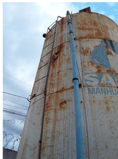
Figura 86 – Oxidação na estrutura do reservatório Santa Terezinha I
