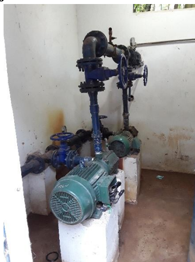
Figura 97 – conjunto motobomba da EEAT Morada do Campo
