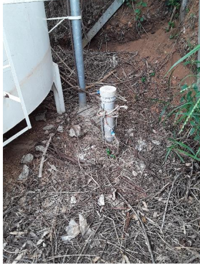
Figura 133 – Clorador do reservatório Alphaville
