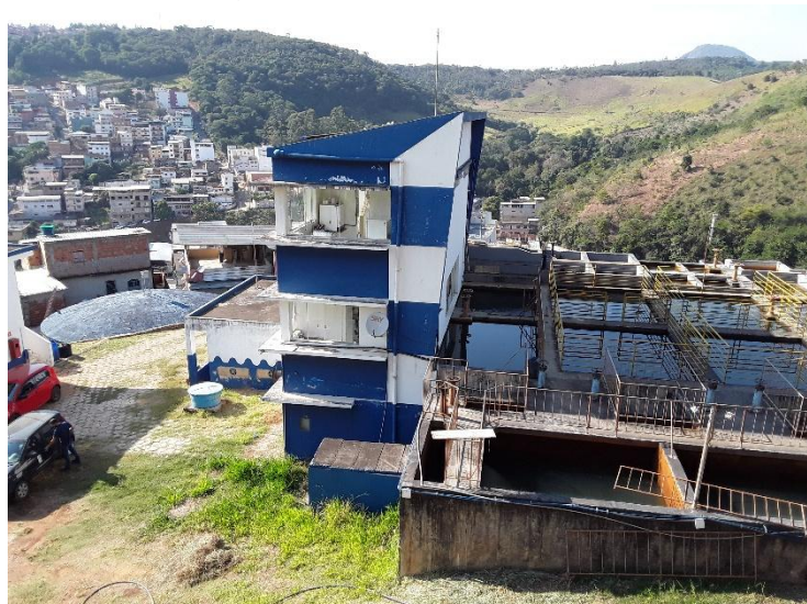
Figura 23 – ETA do SAA Sede
