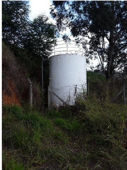
Figura 134 – Localização do reservatório com necessidade de manutenção.
