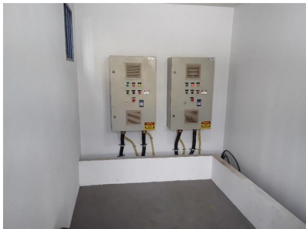
Figura 99 – Quadros e cabos elétricos do Sistema de Bombeamento Petrina
