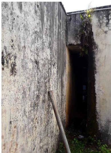
Figura 30 – Infiltração na estrutura da ETA
