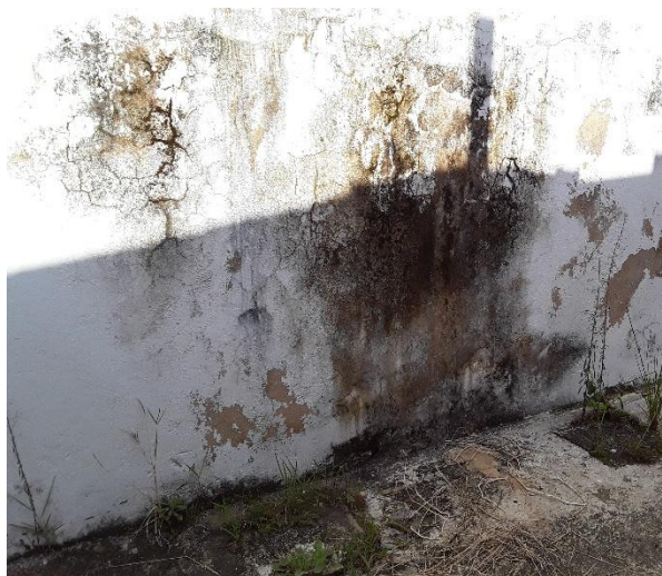
Figura 63 – Infiltração na estrutura do reservatório Matinha (Gravidade)
