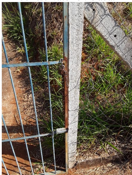
Figura 51 – Corrente do portão de acesso do reservatório violada.
