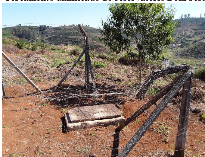
Figura 327 – Cercamento danificado do reservatório Bom Jesus da Realeza.
