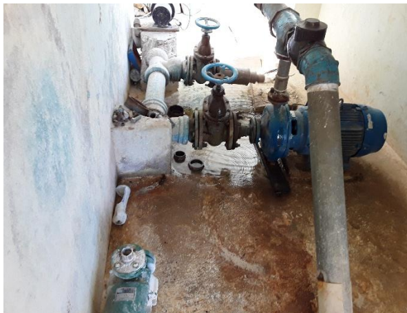
Figura 225 – Acúmulo de água na base da EEAT devido ao vazamento
