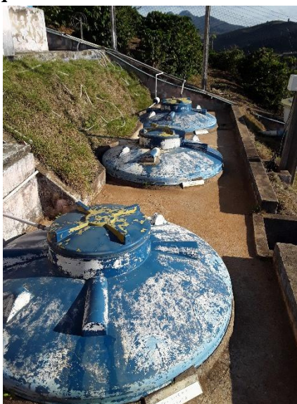
Figura 181 – Tanque de contato da ETA do Distrito de Ponte do Silva.
