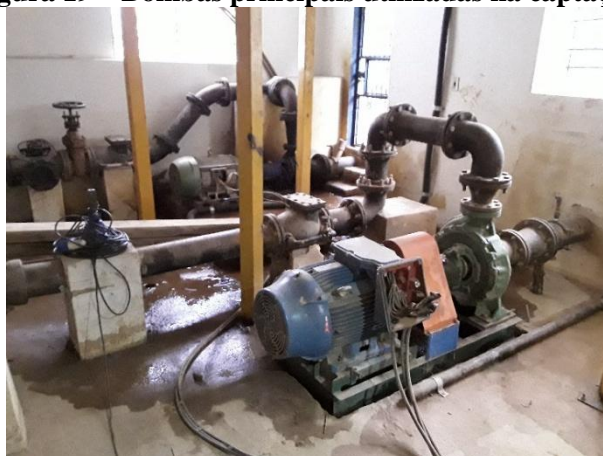
Figura 19 – Bombas principais utilizadas na captação.
