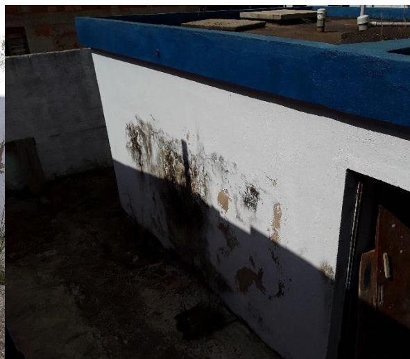
Figura 64 – Infiltração na parede do reservatório Matinha (Gravidade)
