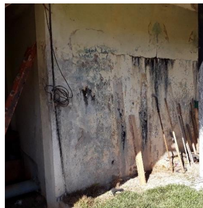
Figura 215 – Infiltração nas estruturas da ETA
