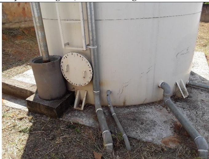
Figura 69 – Tubulações de chegada, saída e descarga de fundo do reservatório Colina II
