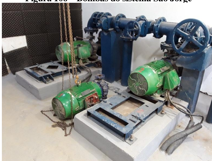
Figura 106 – Bombas do sistema São Jorge
