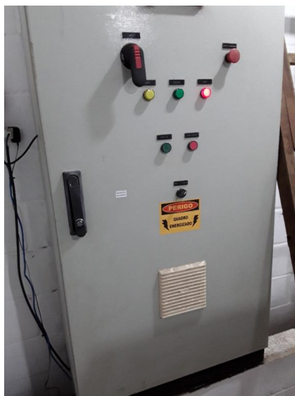
Figura 288 –Quadro de Comando
