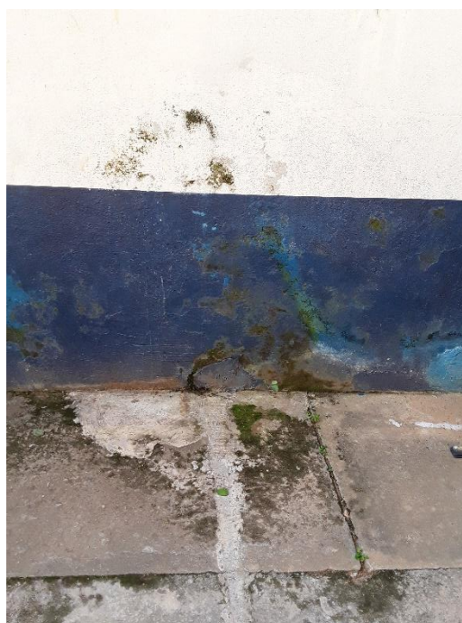
Figura 252 – Pequena área de infiltração
