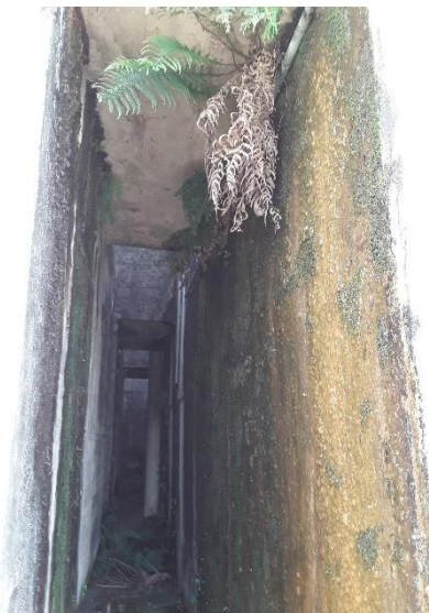
Figura 31 – Vazamento na estrutura da ETA
