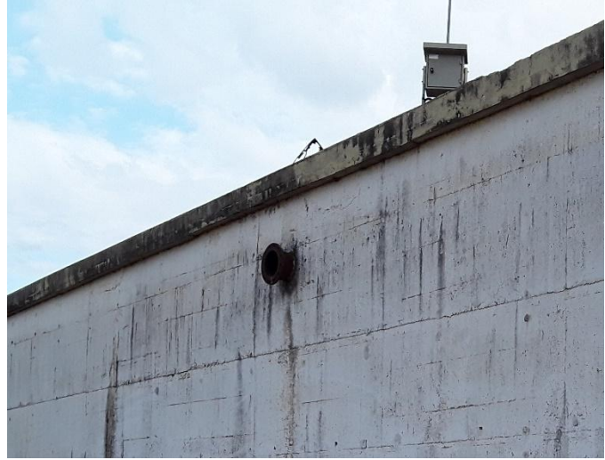
Figura 90 – Tubo extravasor desprotegido no Reservatório São Francisco de Assis
