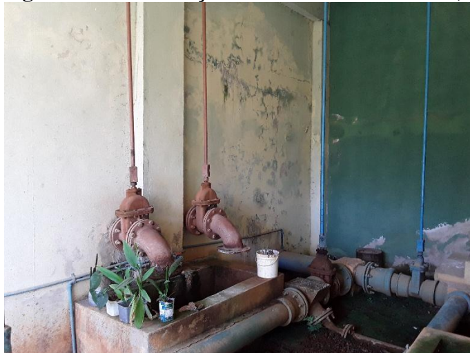
Figura 216 – Infiltração nas estruturas da ETA (2)
