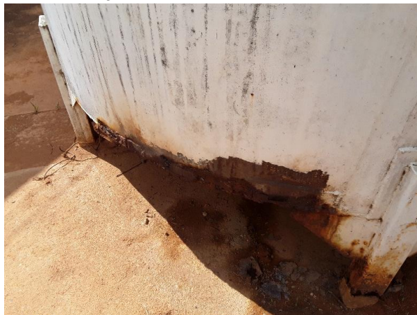
Figura 57 – Oxidação e vazamento no Reservatório Matinha I
