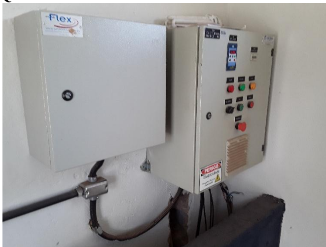
Figura 108 – Quadro de comando do sistema de bombeamento Cidade Nova
