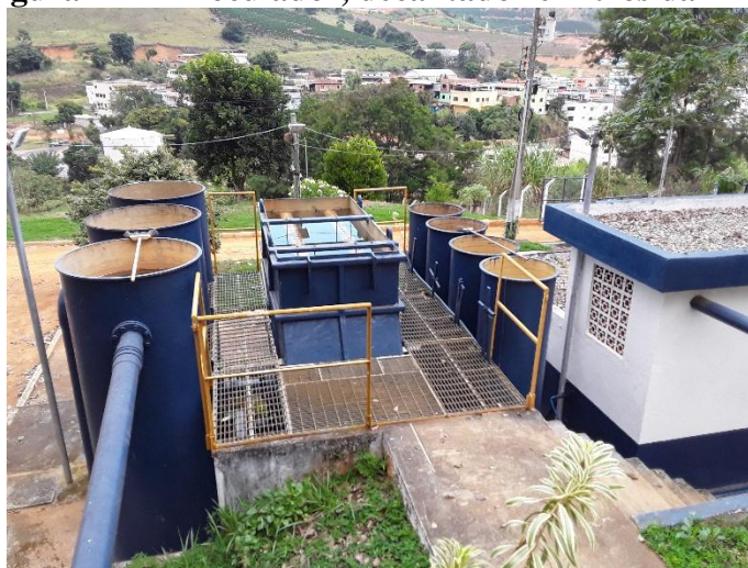
Figura 142 – Floculador, decantador e filtros da ETA.
