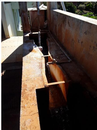
Figura 210 – Calha Parshall da ETA do Distrito de Santo Amaro de Minas
