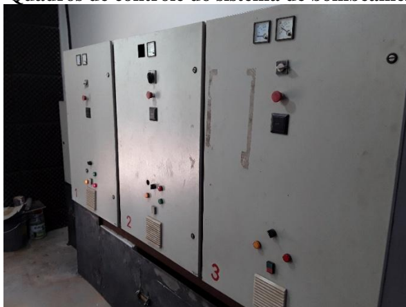
Figura 105 – Quadros de controle do sistema de bombeamento São Jorge
