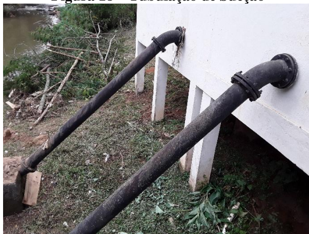
Figura 18 – Tubulação de Sucção
