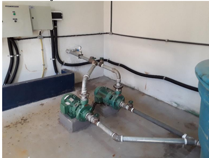
Figura 115 – Conjunto motobomba na EEAT Recanto da Aldeia
