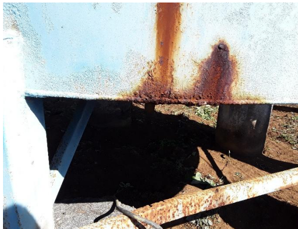
Figura 229 – Pontos de oxidação no reservatório
