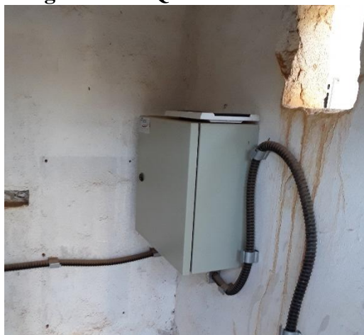
Figura 294 – Quadro de comando
