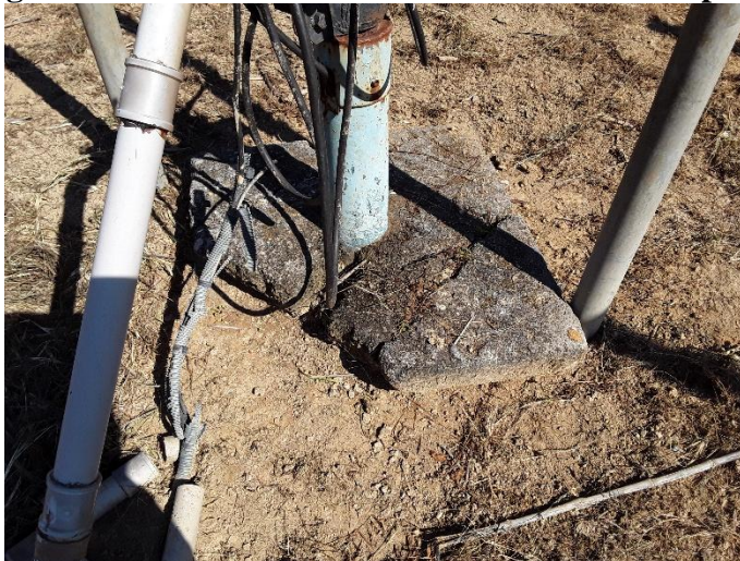
Figura 208 – Base de concreto necessitando de reparo.
