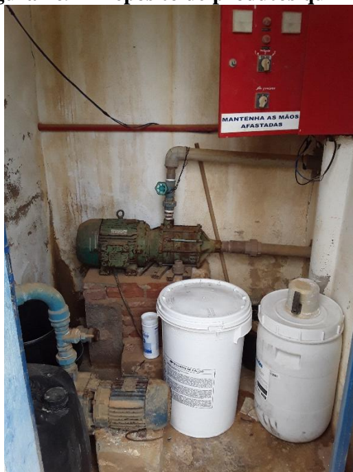
Figura 269 – Depósito de produtos químicos
