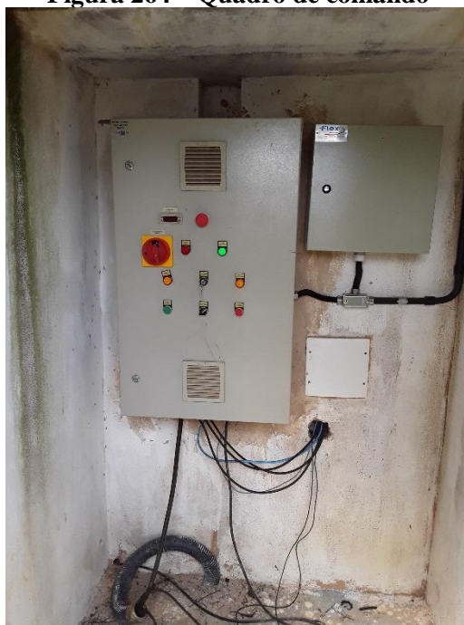
Figura 264 – Quadro de comando
