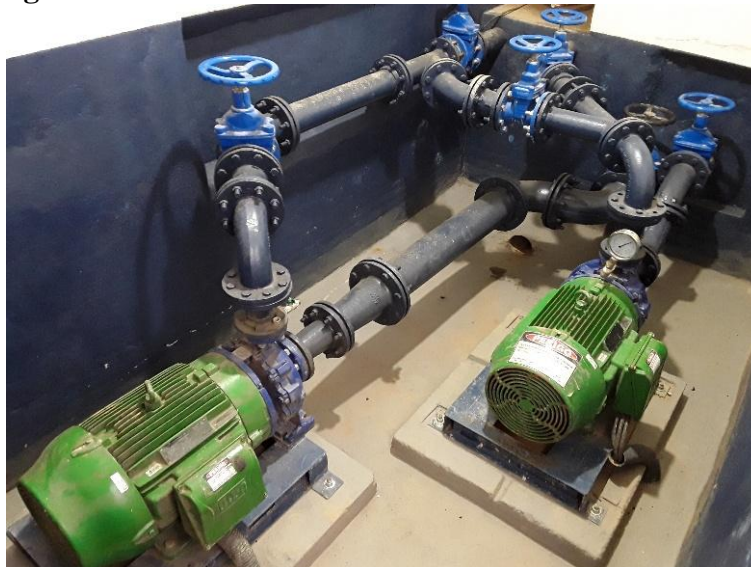
Figura 100- Bombas do sistema de bombeamento Petrina
