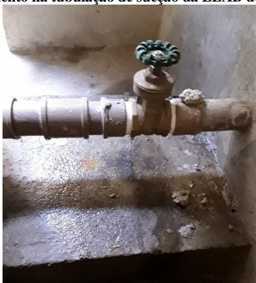
Figura 198 – Vazamento na tubulação de sucção da EEAB do Distrito de Realeza.
