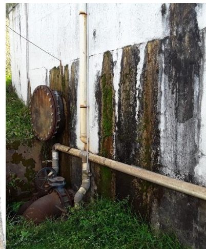
Figura 32 – Infiltração na estrutura da ETA (2)
