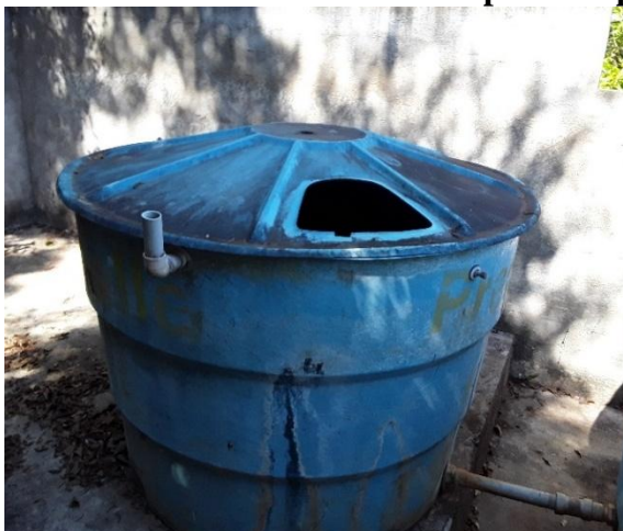
Figura 201 – Reservatório I sem tampa de inspeção
