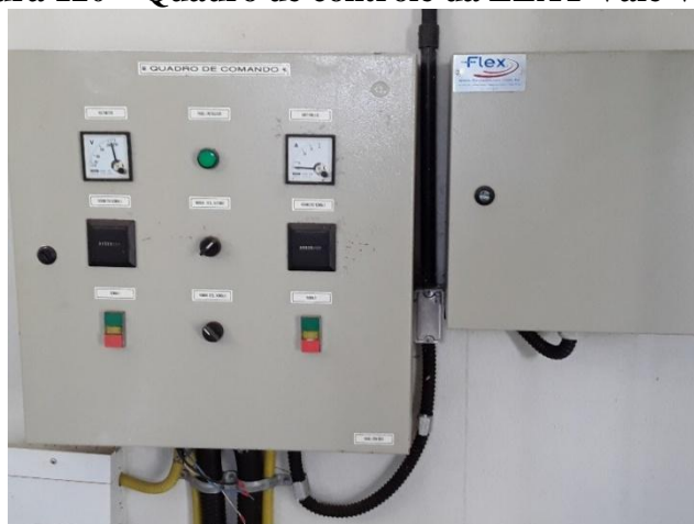
Figura 120 – Quadro de controle da EEAT Vale Verde.
