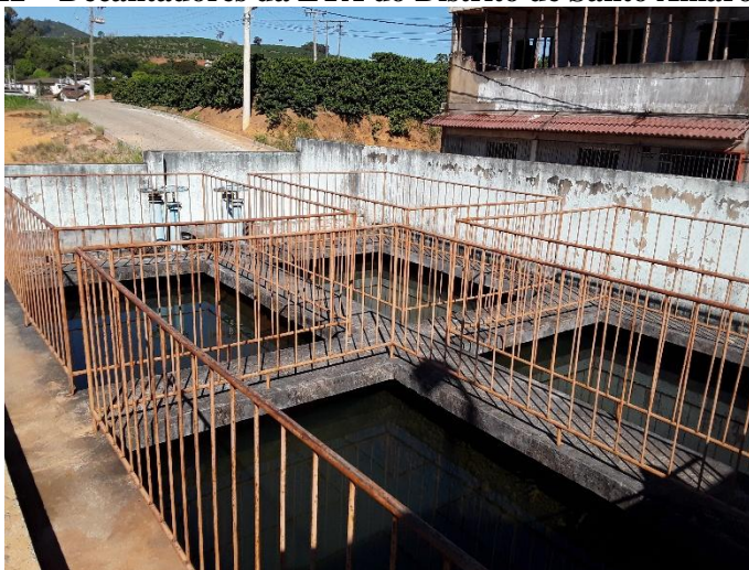
Figura 212 – Decantadores da ETA do Distrito de Santo Amaro de Minas
