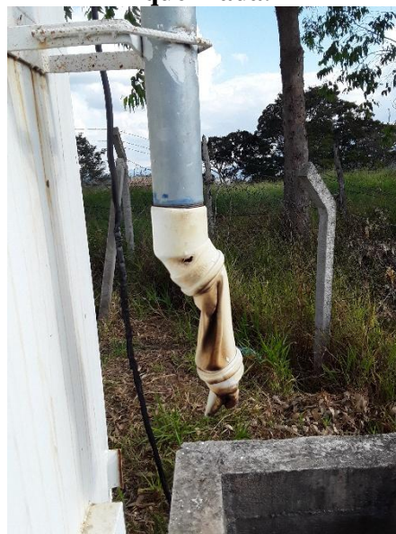
Figura 52 – Ponta do tubo extravasor queimada.
