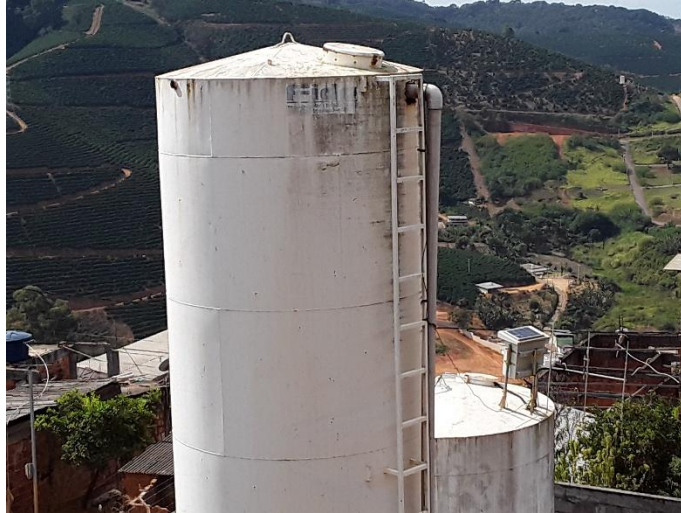
Figura 60 – Abertura e abertura no reservatório no local da tubulação de entrada.
