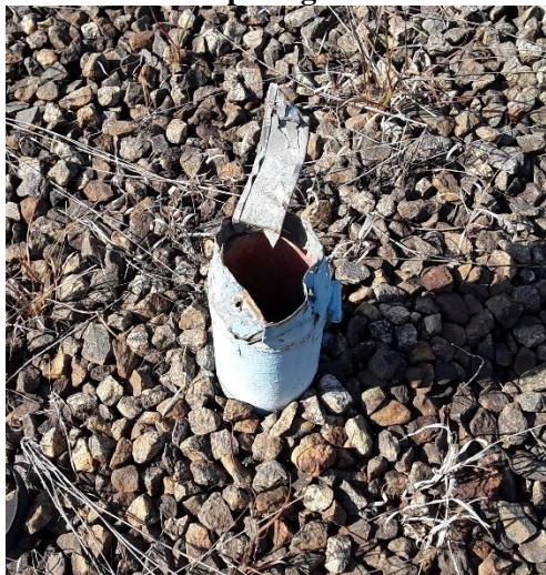
Figura 47 – Tubo de ventilação desprotegido.
