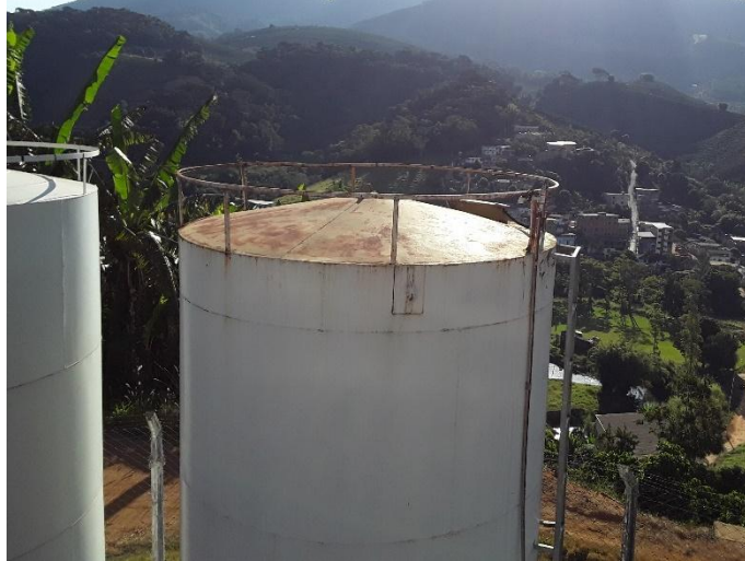
Figura 188 – Oxidação no Reservatório I do Distrito de Ponte do Silva.
