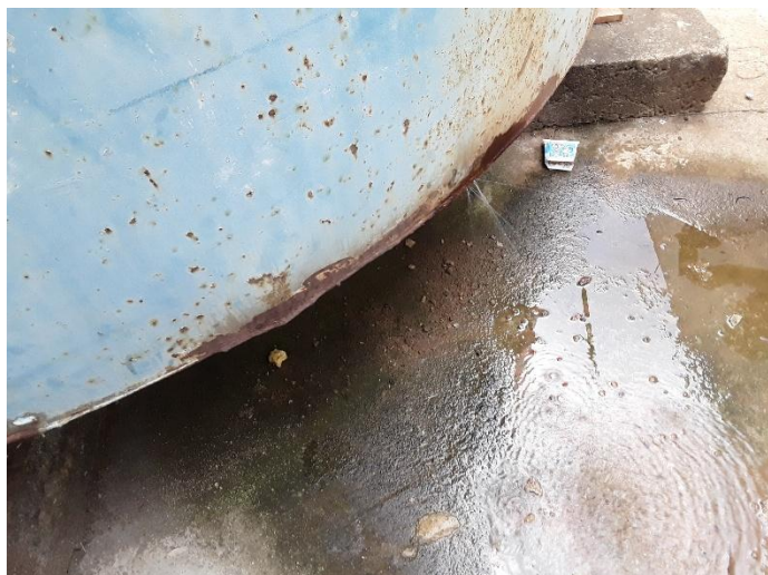
Figura 85 – Vazamento na base do reservatório Santa Terezinha II
