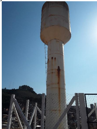
Figura 80 – Reservatório Bela Vista I
