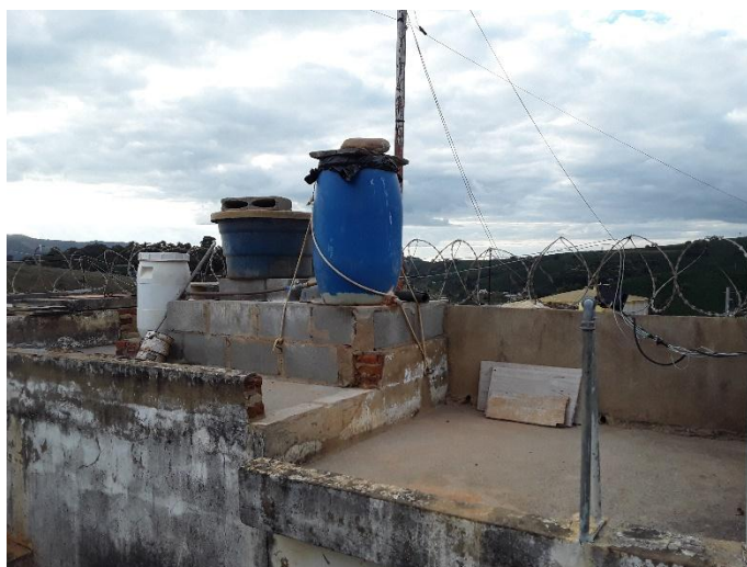
Figura 267 – Tanque de contato
