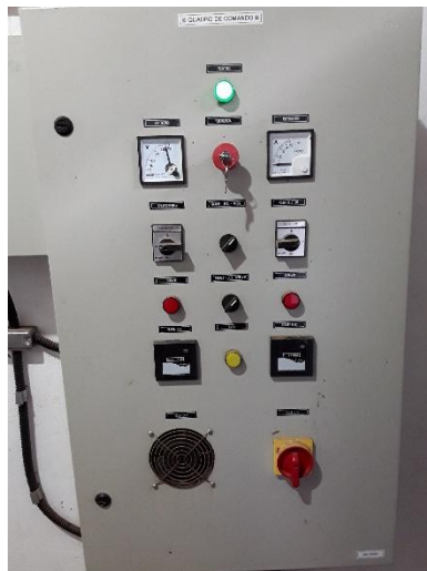
Figura 96 – Quadro de comando da EEAT Morada do Campo
