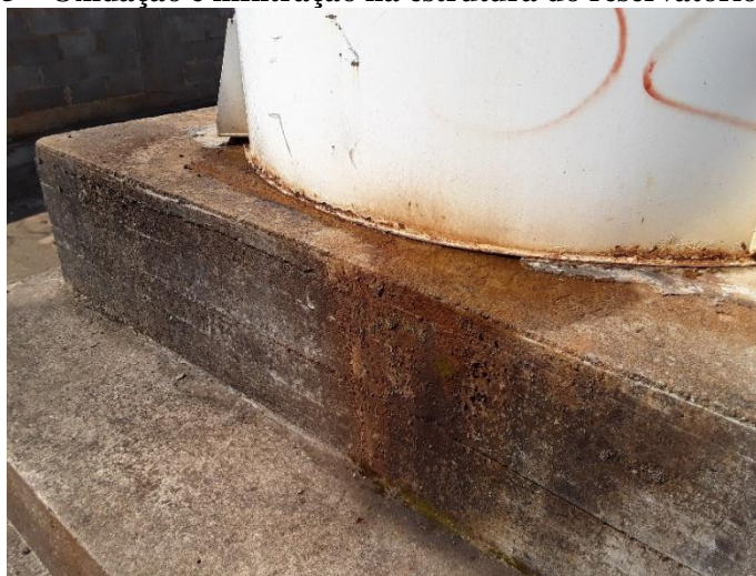
Figura 75 – Oxidação e infiltração na estrutura do reservatório Petrina I
