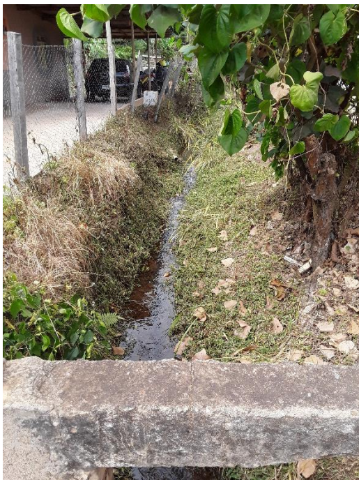
Figura 328 - Lançamento de esgoto no Distrito de São Sebastião do Sacramento
