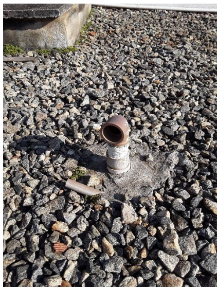
Figura 33 – Tubulação de ventilação do tanque de contato sem proteção
