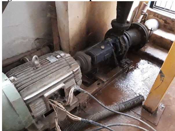
Figura 22 – Bomba com problemas de vazamento
