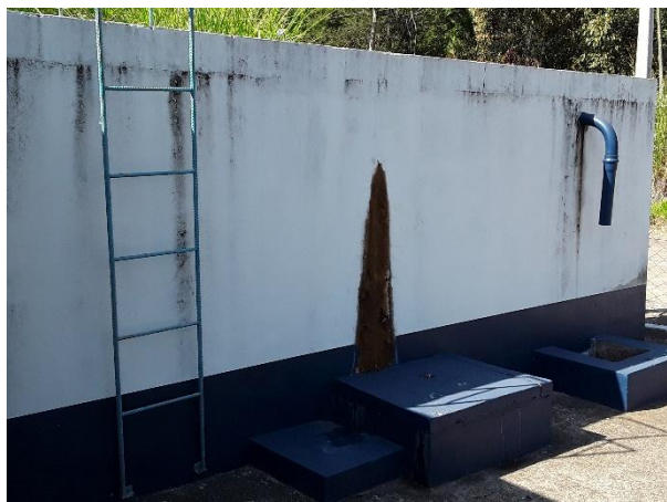
Figura 122 – Reservatório de sucção Vale Verde
