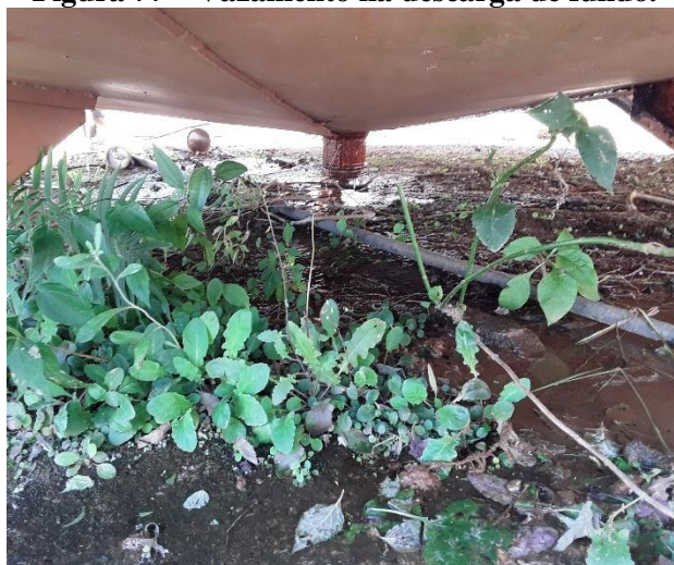
Figura 77 – Vazamento na descarga de fundo.
