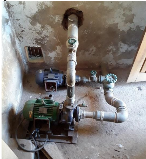
Figura 199 – conjunto motobomba da EEAT do distrito de Realeza
