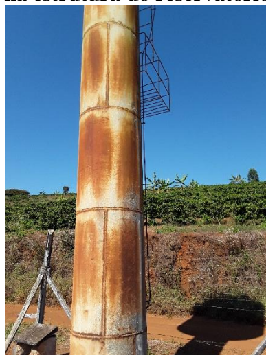
Figura 326 – Oxidação na estrutura do reservatório Bom Jesus da Realeza.
