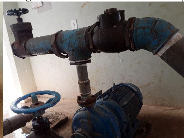
Figura 226 – Vazamento na EEAT
