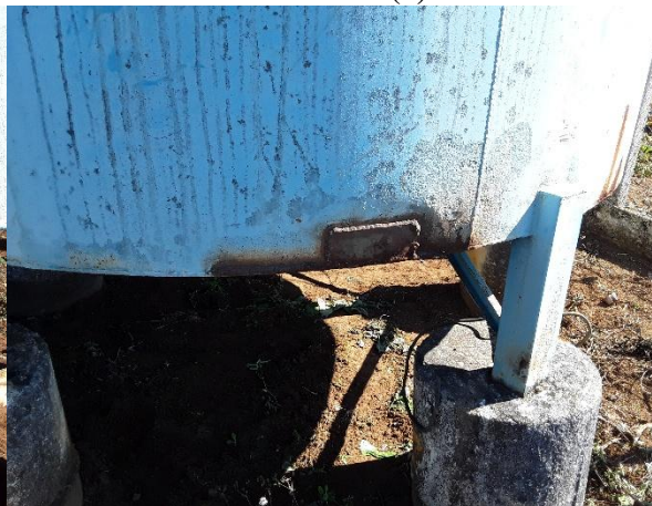
Figura 230 – Pontos de oxidação no reservatório (2)
