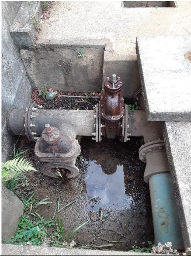
Figura 89 – Vazamento no registro do reservatório São Francisco de Assis
