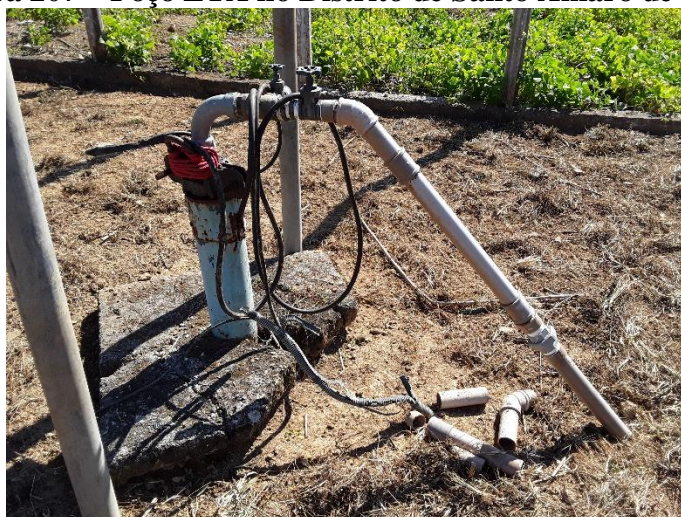
Figura 207 – Poço ETA no Distrito de Santo Amaro de Minas
