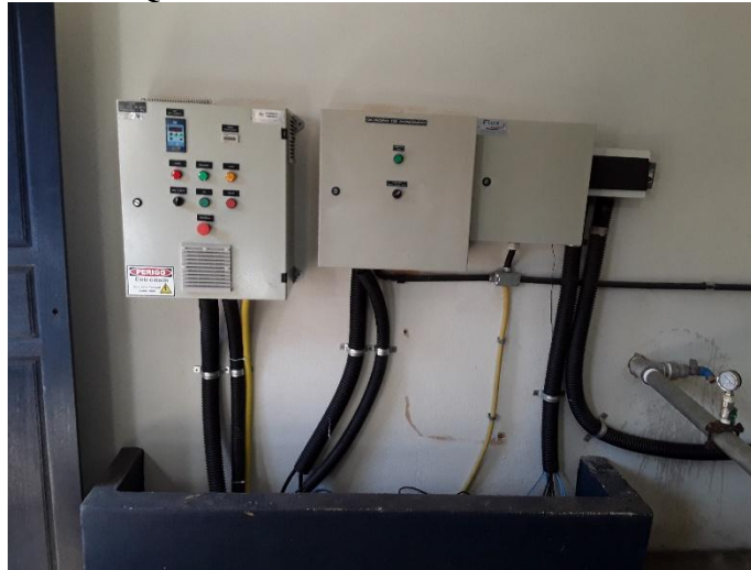
Figura 114 – Quadro de comando da EEAT Recanto da Aldeia
