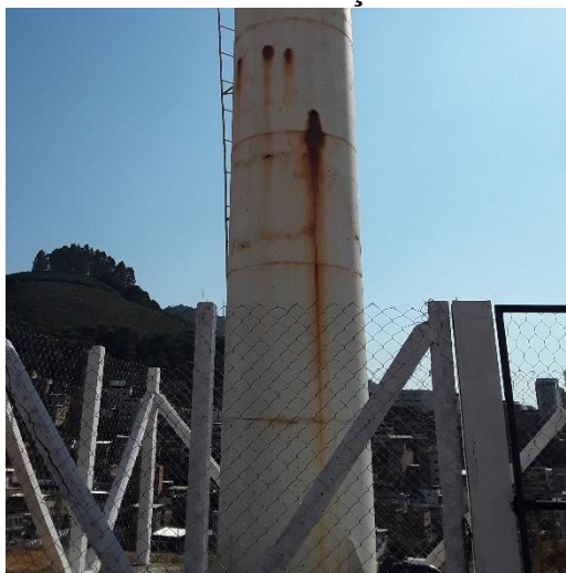
Figura 81 – Pontos de oxidação no reservatório.
