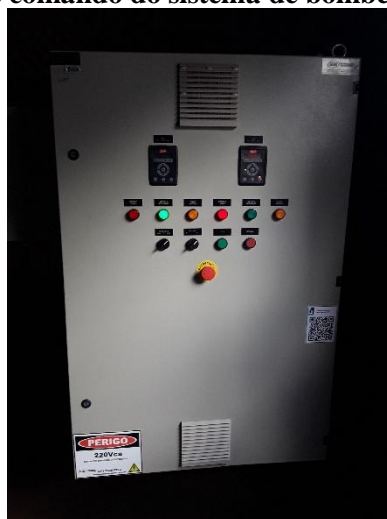
Figura 102 – Quadro de comando do sistema de bombeamento Sagrada Família
