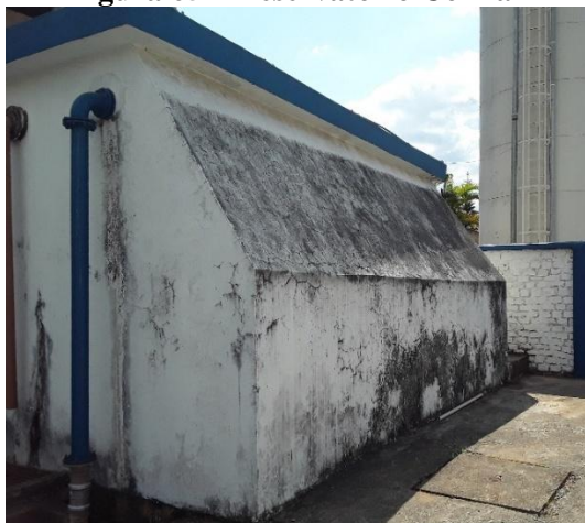
Figura 65 – Reservatório Colina I
