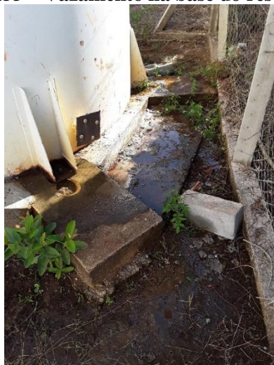
Figura 255 – Vazamento na base do reservatório
