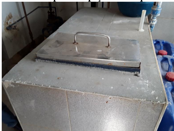
Figura 241 – Tampo de inspeção do tanque de contato
