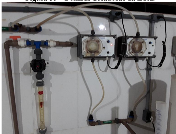
Figura 35 – Bombas dosadoras da ETA.
