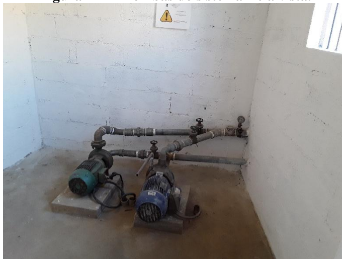
Figura 112 – Bombas do sistema Bela vista.
