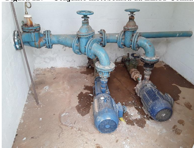
Figura 127 – Conjunto motobomba da EEAT Colina
