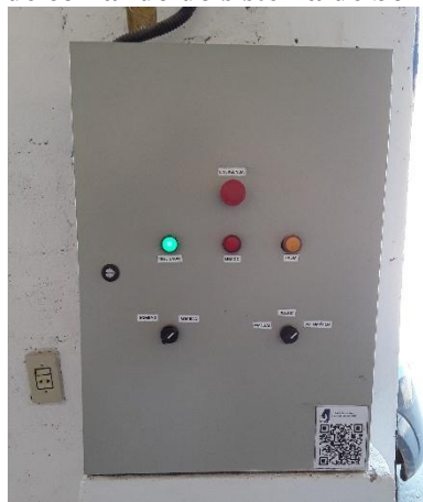
Figura 111 –Quadro de comando do sistema de bombeamento Bela Vista.
