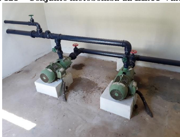
Figura 121 – Conjunto motobomba da EEAT Vale Verde.
