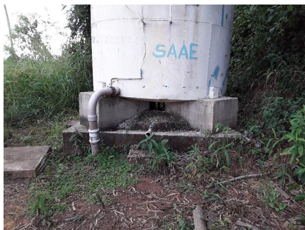
Figura 54 – Tubulação de saída e descarga de fundo do Reservatório Catuaí
