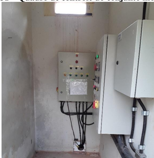
Figura 131 – Quadro de controle do conjunto motobomba.
