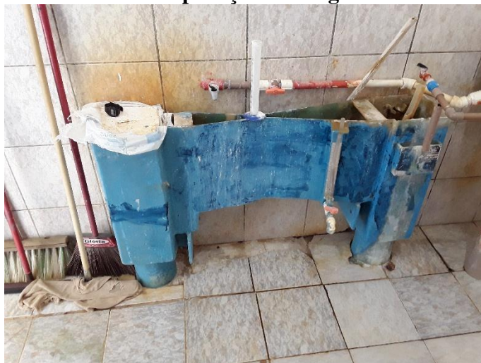
Figura 141 – Calha Parshall e aplicação do coagulante na ETA Dom Corrêa.
