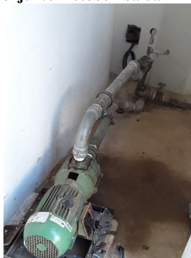
Figura 118 – Conjunto motobomba da EEAT Bom Jardim
