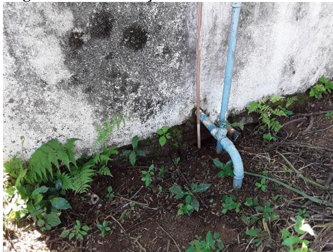
Figura 150 – Infiltração na base do reservatório.
