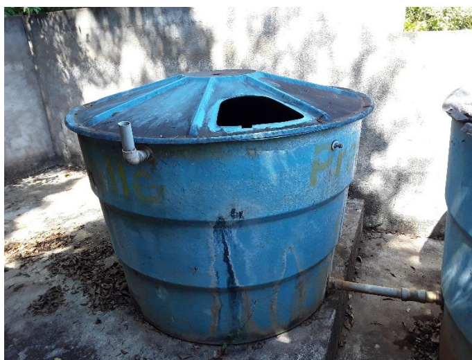
Figura 200 – Reservatório I do Distrito de Realeza
