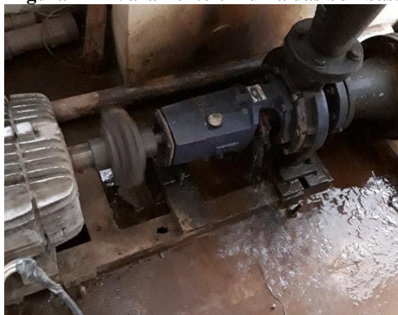
Figura 21 – Vazamento em uma das bombas.
