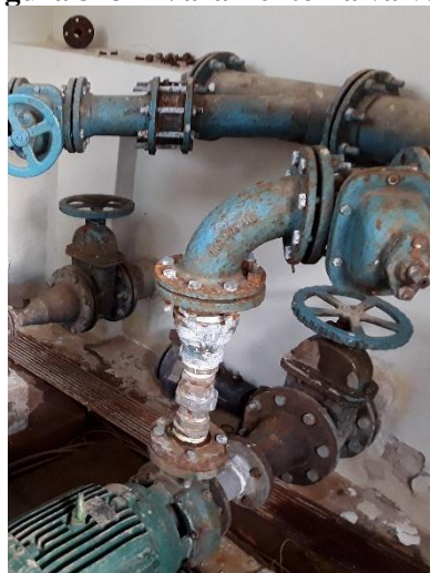
Figura 313 – Vazamento na válvula
