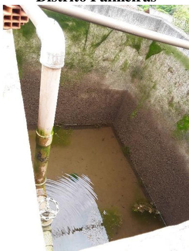
Figura 166 – Filtro lento da ETA do Distrito Palmeiras
