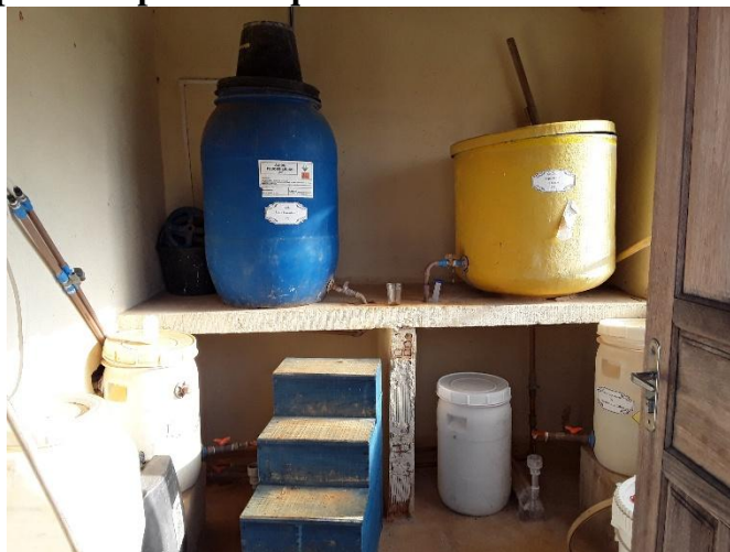
Figura 183 – Depósito de produtos químicos da ETA do Distrito de Ponte do Silva.
