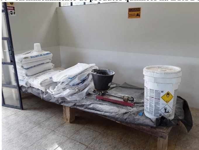
Figura 144 – Armazenamento de produtos químicos na ETA Dom Corrêa
