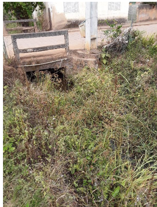
Figura 329 - Lançamento de esgoto – Distrito de São Sebastião do Sacramento (2)
