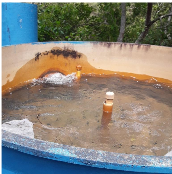
Figura 196 – Floculador 1 – ETA Matadouro
