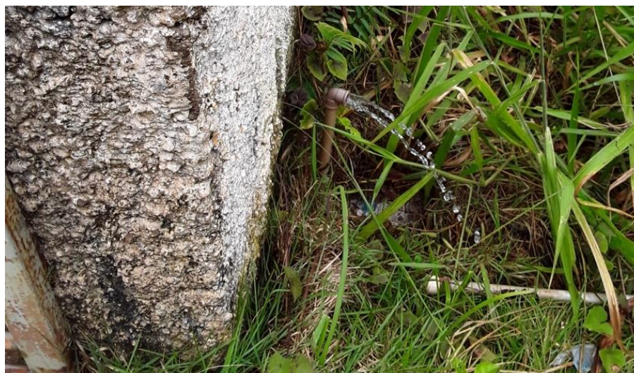
Figura 264 – Perda de água do extravassor
