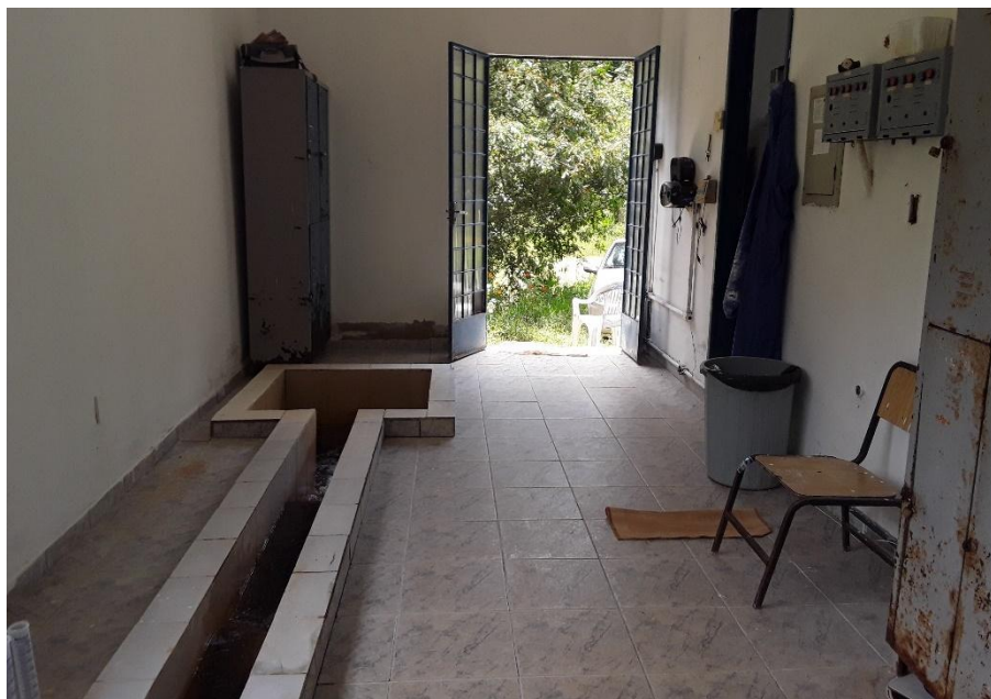
Figura 193 – Calha de Água bruta – ETA Matadouro
