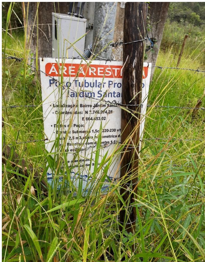
Figura 81 - Placa de identificação do Poço tubular profundo Jardim Santana
