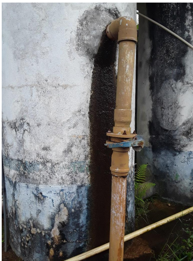
Figura 162 – Vazamento nos filtros – ETA Santa Rita de Cássia
