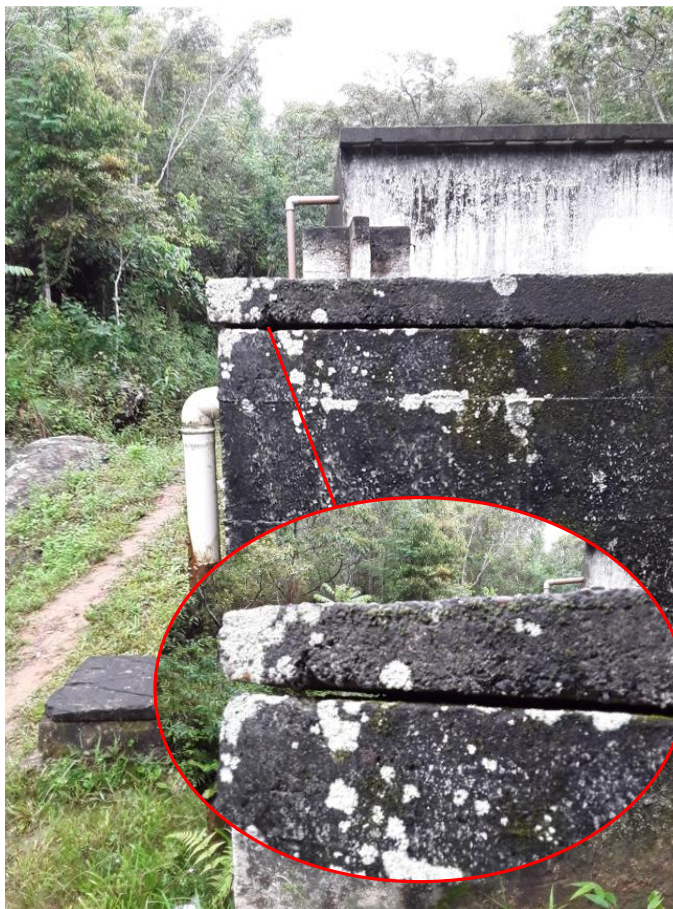
Figura 243 – Abertura entre paredes e cobertura
