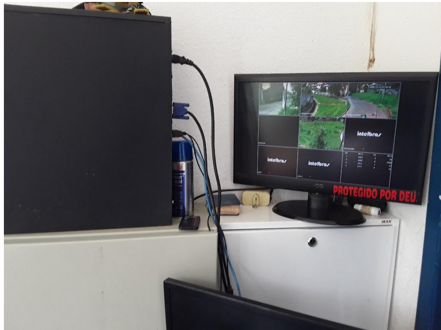
Figura 184 – Monitor de câmeras - ETA Santa Rita de Cássia
