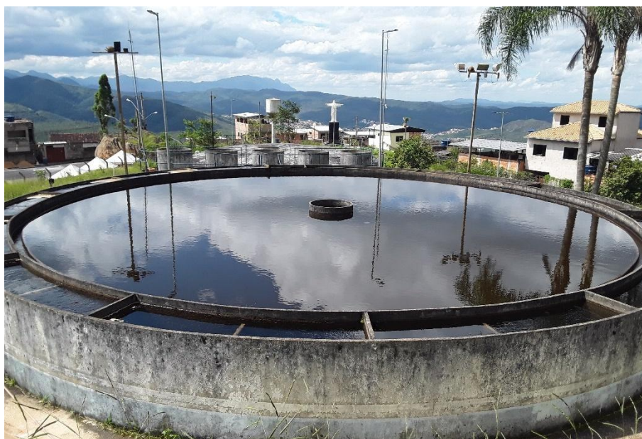
Figura 157 – Floculadores e decantador – ETA Santa Rita de Cássia
