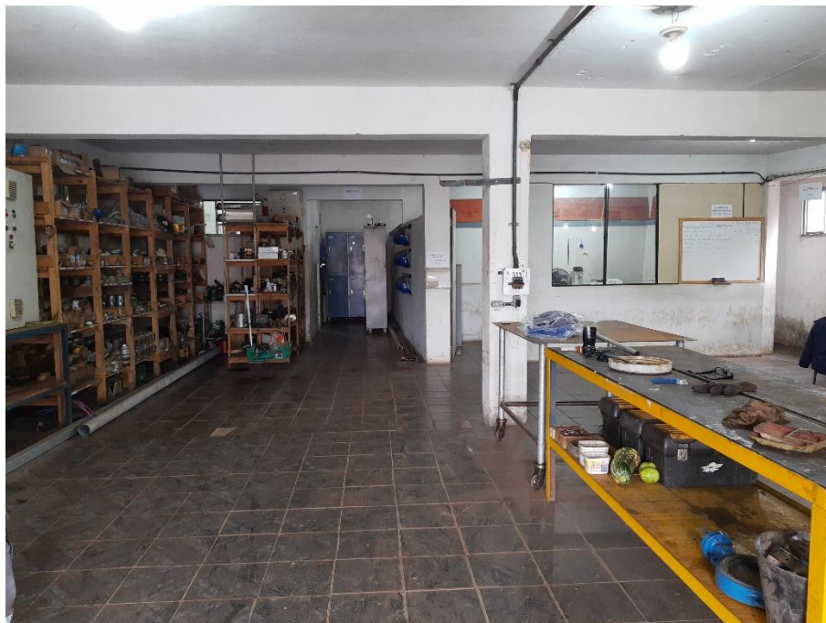
Figura 215 – Área do setor de eletromecânica
