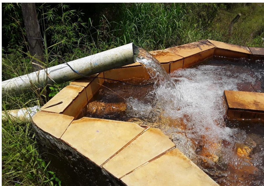
Figura 191 – Adutoras de água bruta – ETA Matadouro
