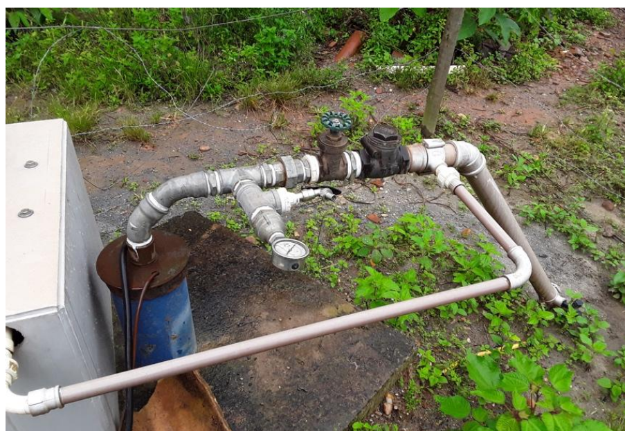
Figura 275 – Captação subterrânea de Barroca
