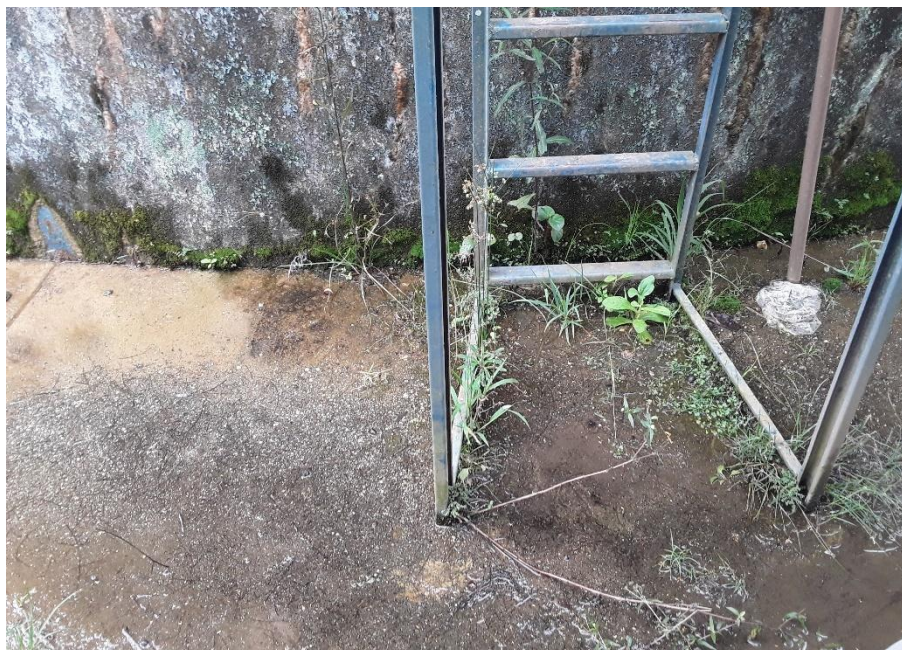
Figura 165 – Infiltrações – Reservatório ETA Santa Rita de Cássia
