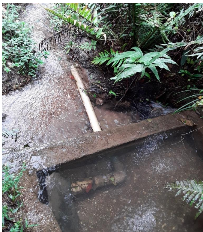
Figura 54 – Captação Cartuxa – sistema de gradeamento
