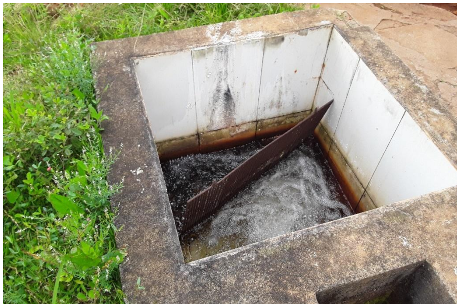
Figura 156 – Caixa de passagem – ETA Santa Rita de Cássia
