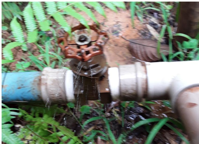
Figura 249 – Vazamento no registro de entrada
