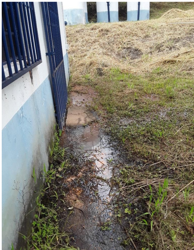
Figura 135 – Entrada da casa de bomba – ETA Seminário
