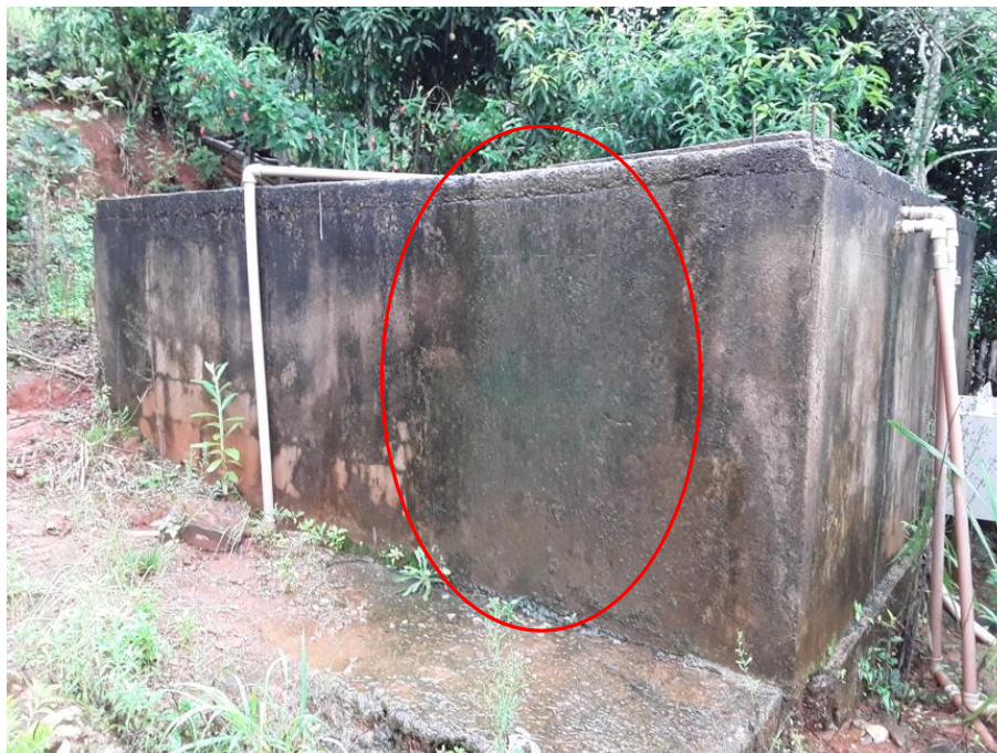
Figura 278 – Extravasamento no reservatório
