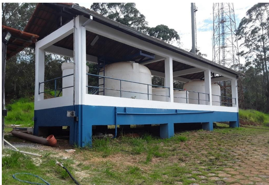
Figura 106 – Depósito de produtos químicos - Líquidos
