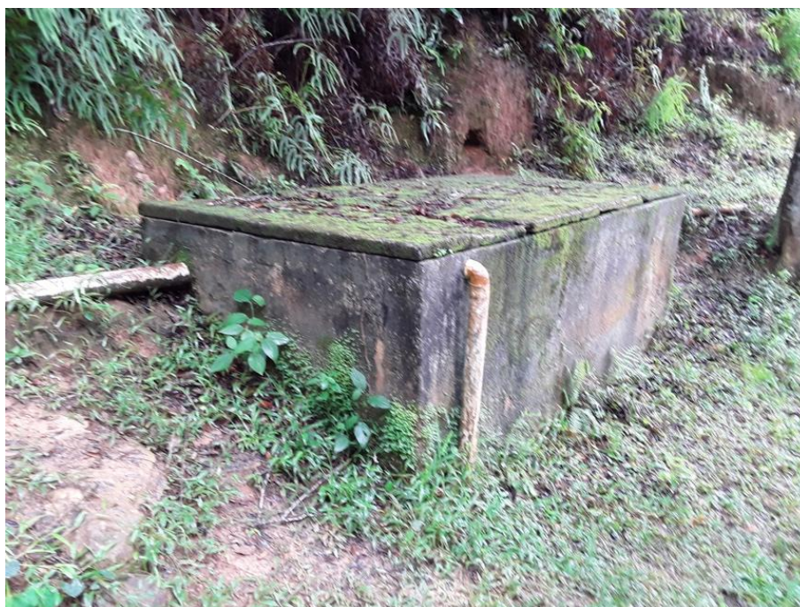
Figura 239 – Caixa de água bruta
