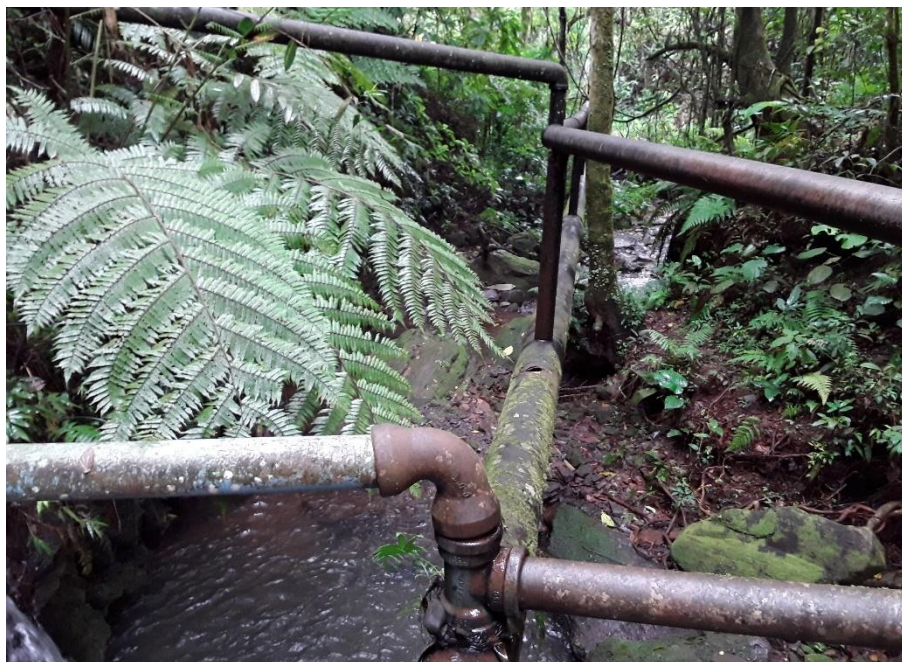
Figura 59 – Canalizações das adutoras
