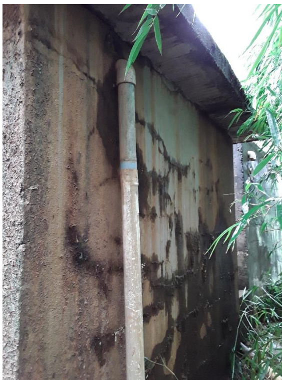
Figura 250 – Macas de infiltrações
