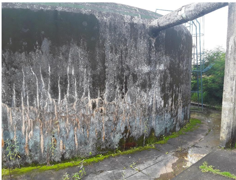
Figura 163 – Reservatório – ETA Santa Rita de Cássia
