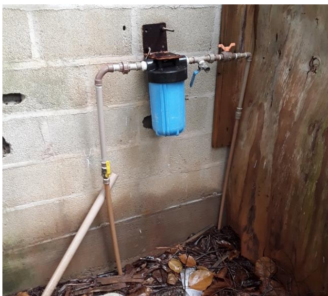
Figura 259 – Clorador da ETA em construção de Padre Viegas
