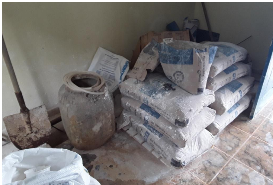
Figura 176 – Armazenamento da CAL - ETA Santa Rita de Cássia
