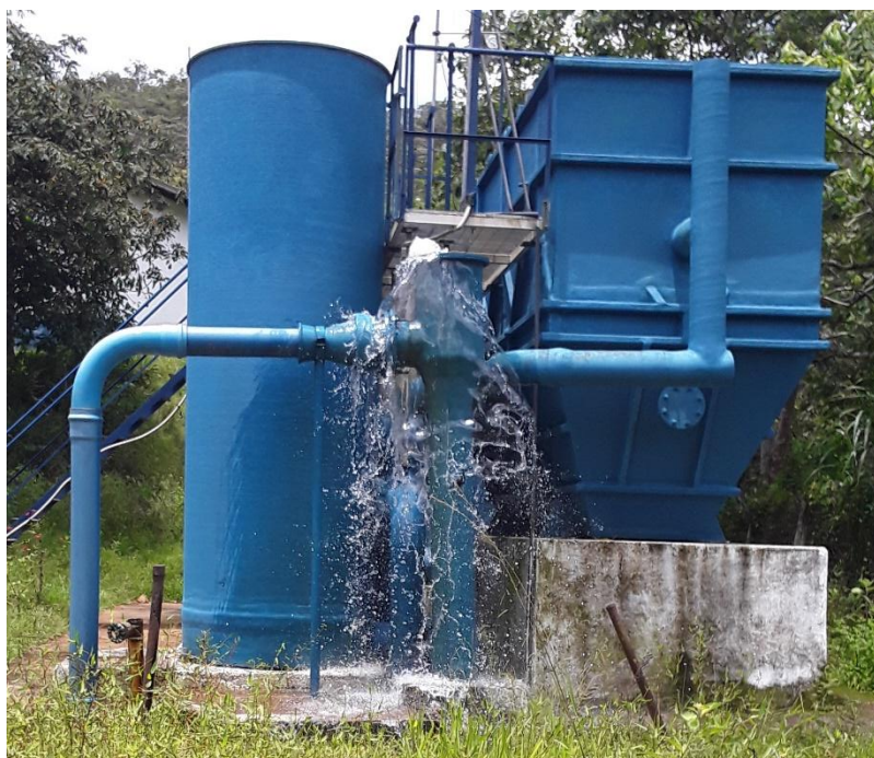
Figura 199 – Extravasamento de água – ETA Matadouro
