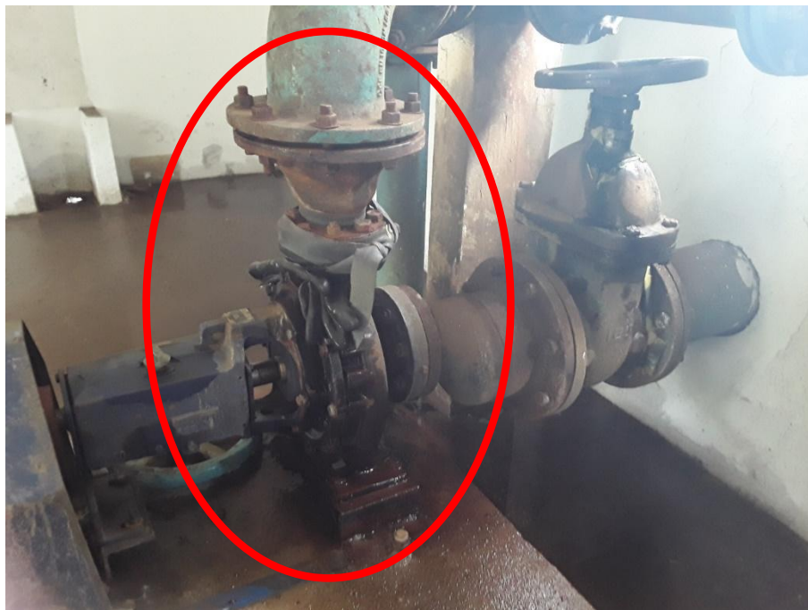
Figura 137 – Vazamento – Casa de bomba ETA Seminário
