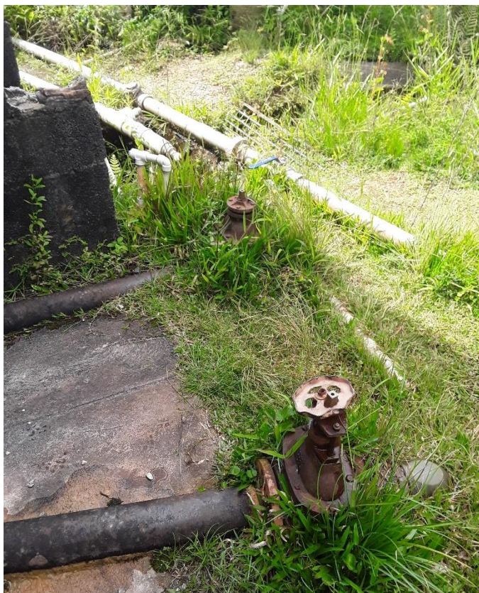
Figura 167 – Tubulações – ETA Santa Rita de Cássia
