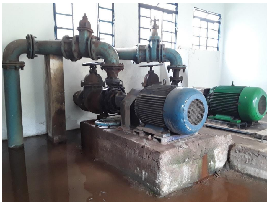
Figura 136 – Conjunto motobomba – ETA Seminário
