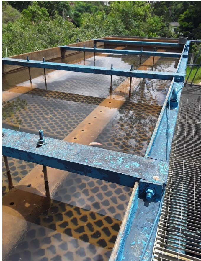
Figura 197 – Decantador – ETA Matadouro
