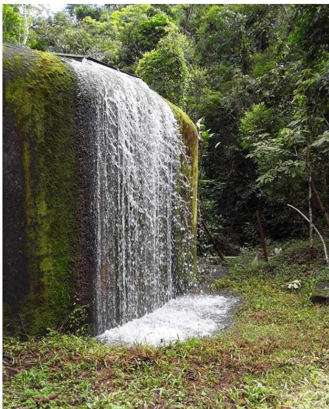
Figura 228 – Extravasamento pela tampa de inspeção
