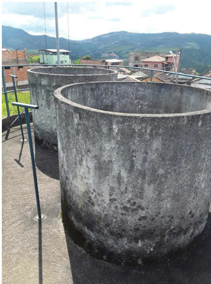
Figura 160- Filtros – ETA Santa Rita de Cássia
