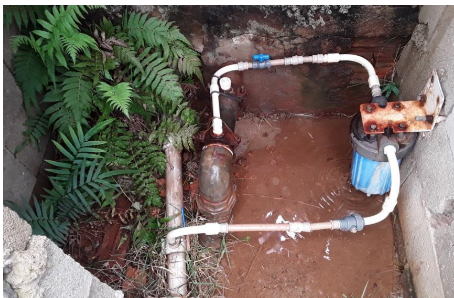
Figura 263 – Clorador do reservatório de Passagem de Mariana
