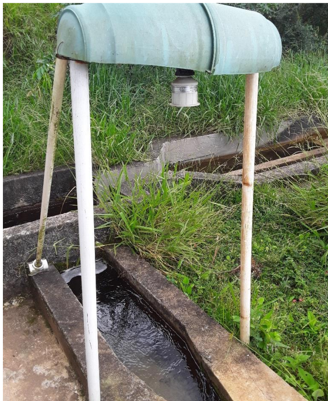
Figura 154 – Medidor de vazão – ETA Santa Rita de Cássia
