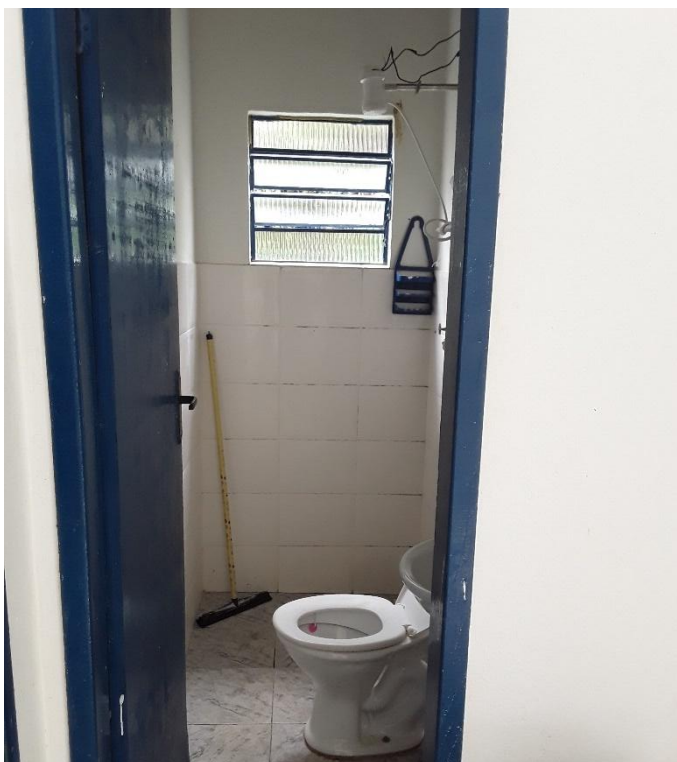
Figura 205- Instalação sanitária com chuveiro – ETA Matadouro
