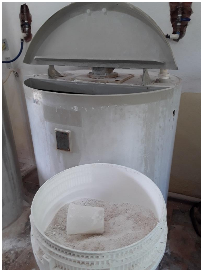
Figura 143 – Preparo do hipoclorito de cálcio – ETA Seminário
