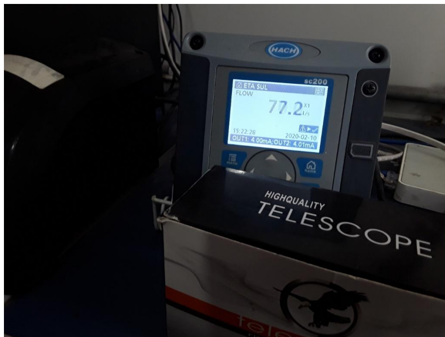
Figura 88 – Medidor de vazão
