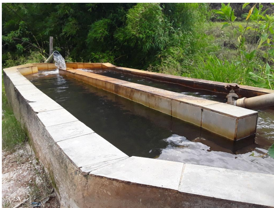
Figura 192 – Desarenador – ETA Matadouro
