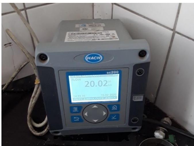
Figura 128 – Painel do transmissor e controlador de nível ultrassônico – ETA Seminário
