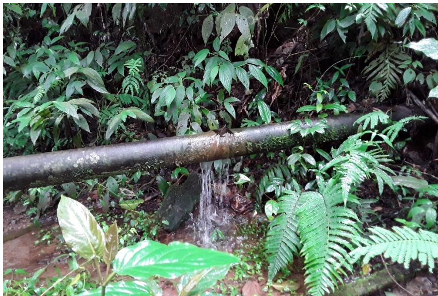
Figura 60 – Vazamento na adutora da Captação Cristal
