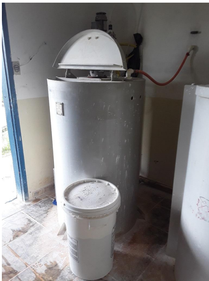
Figura 177- Preparo dos produtos químicos - ETA Santa Rita de Cássia
