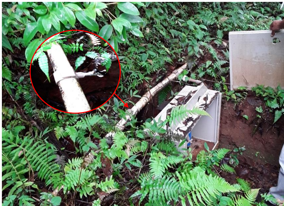
Figura 279 – Clorador de Mainart
