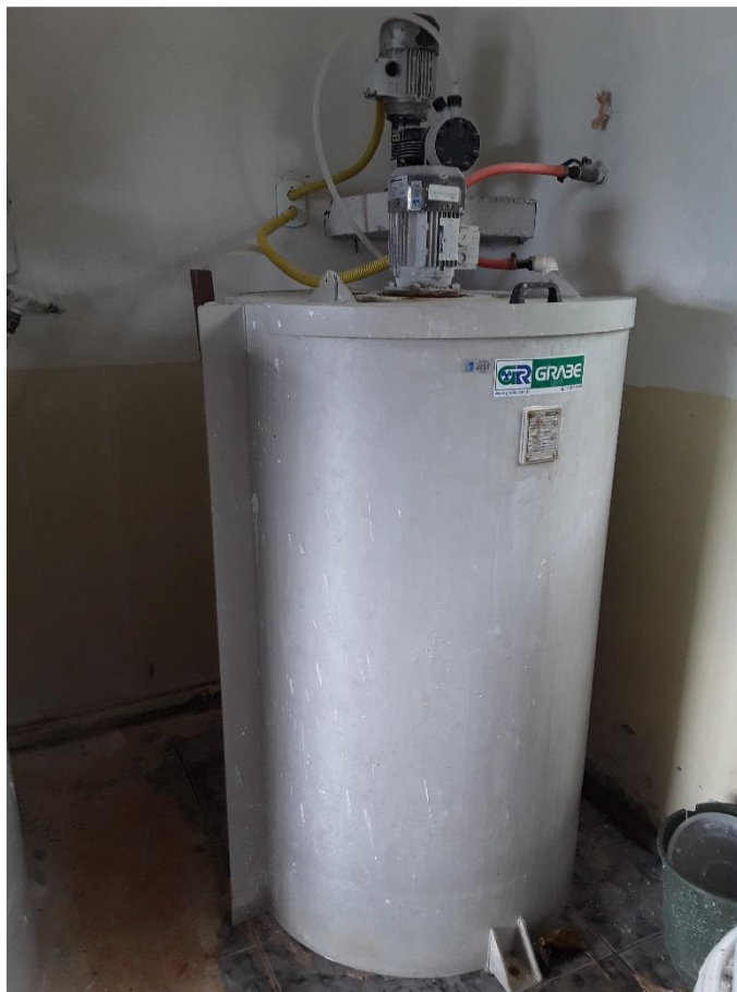
Figura 178 – Tanque - ETA Santa Rita de Cássia
