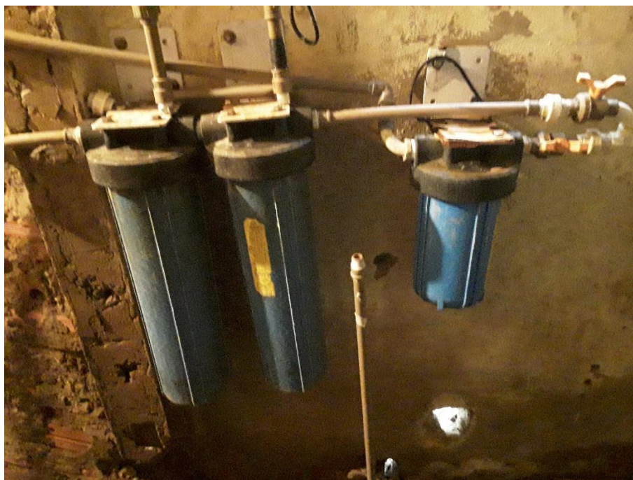
Figura 73 – Dosadores de cloro pastilhas – Captação Maquiné
