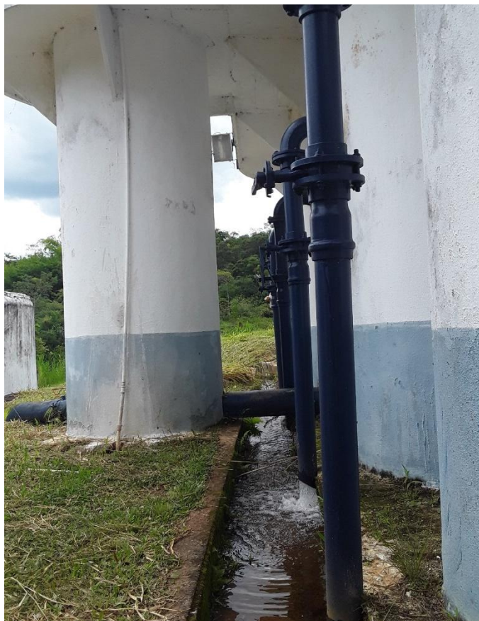
Figura 132 – Descarga dos filtros – ETA Seminário
