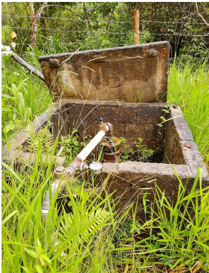
Figura 82 - Captação subterrânea Jardim Santana
