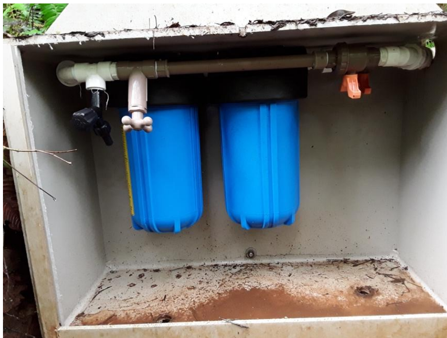
Figura 280 - Interior da caixa do clorador
