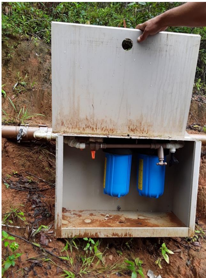
Figura 240 – Clorador de Zeca Barbosa
