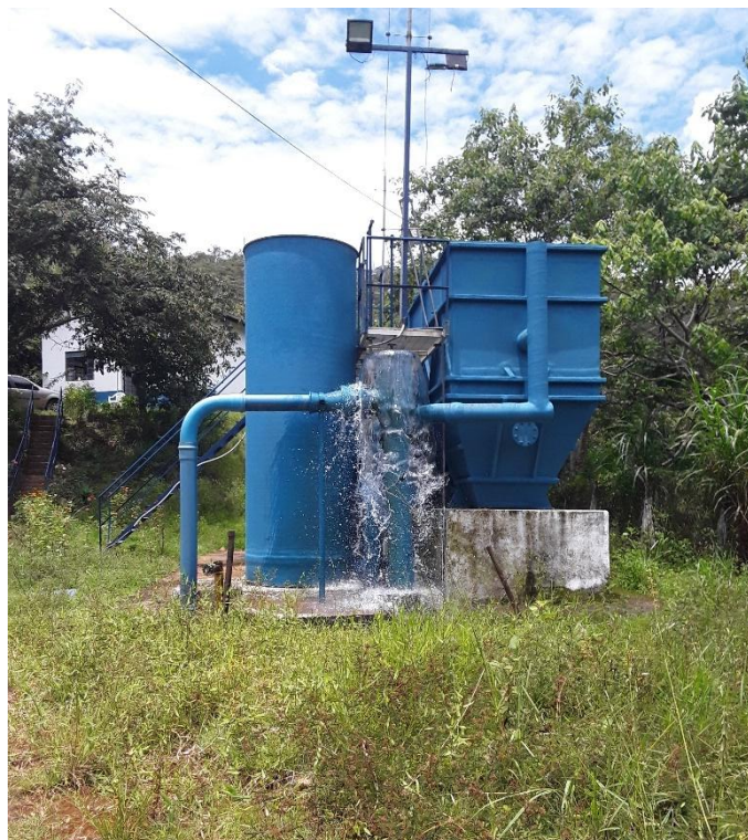
Figura 194 – ETA Compacta Matadouro
