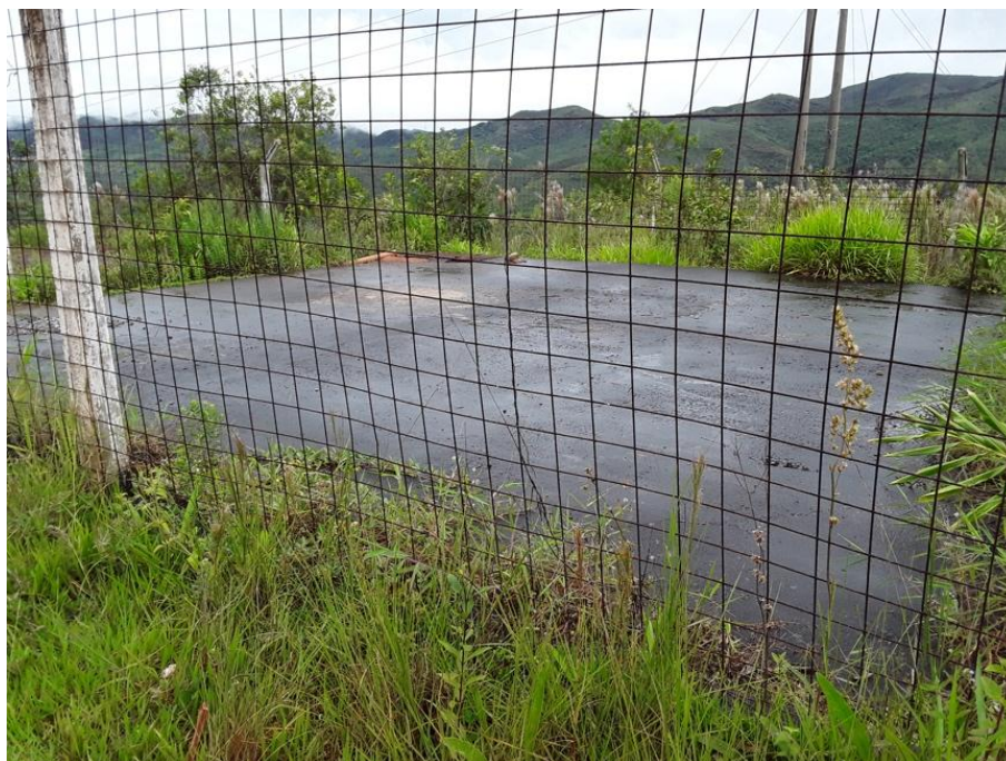
Figura 262 – Reservatório de Passagem de Mariana
