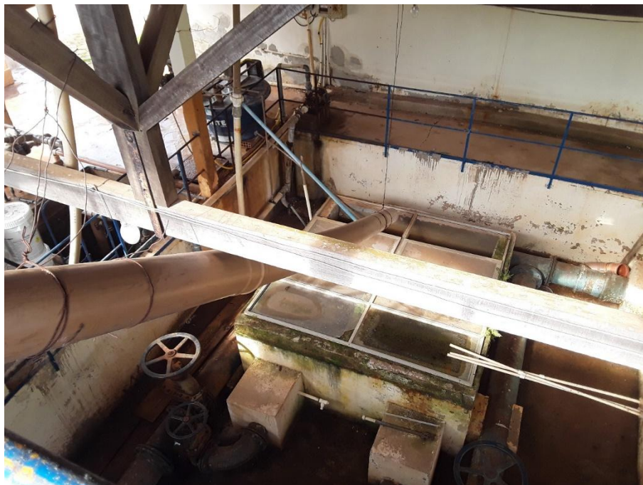
Figura 95 – Tampa de inspeção do tanque de contato
