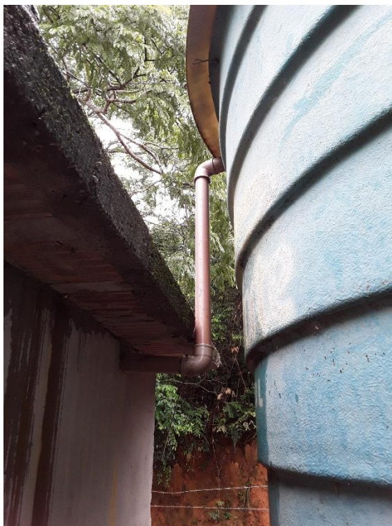
Figura 248 – Extravasor ligado ao reservatório de concreto
