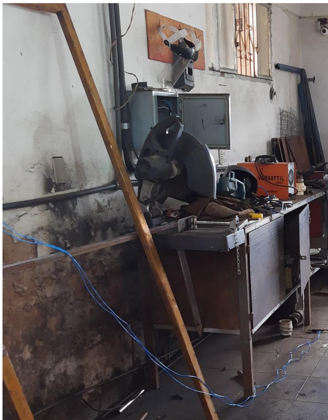
Figura 222 – área de bancada de solda e corte
