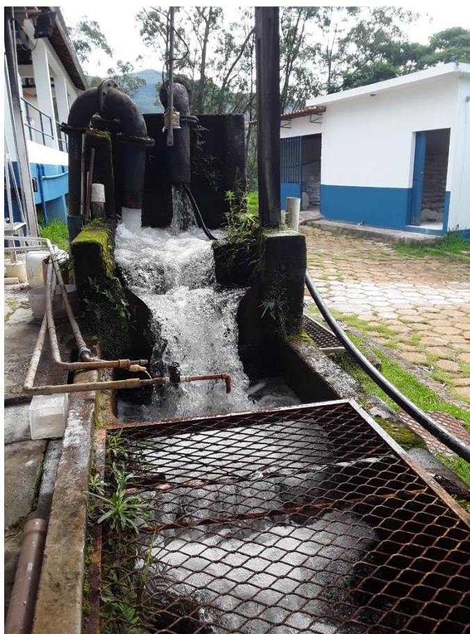
Figura 87 – Chegada da água bruta
