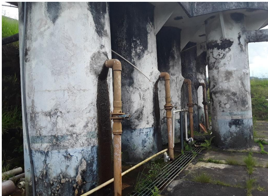
Figura 161 – Área de descarga dos filtros – ETA Santa Rita de Cássia
