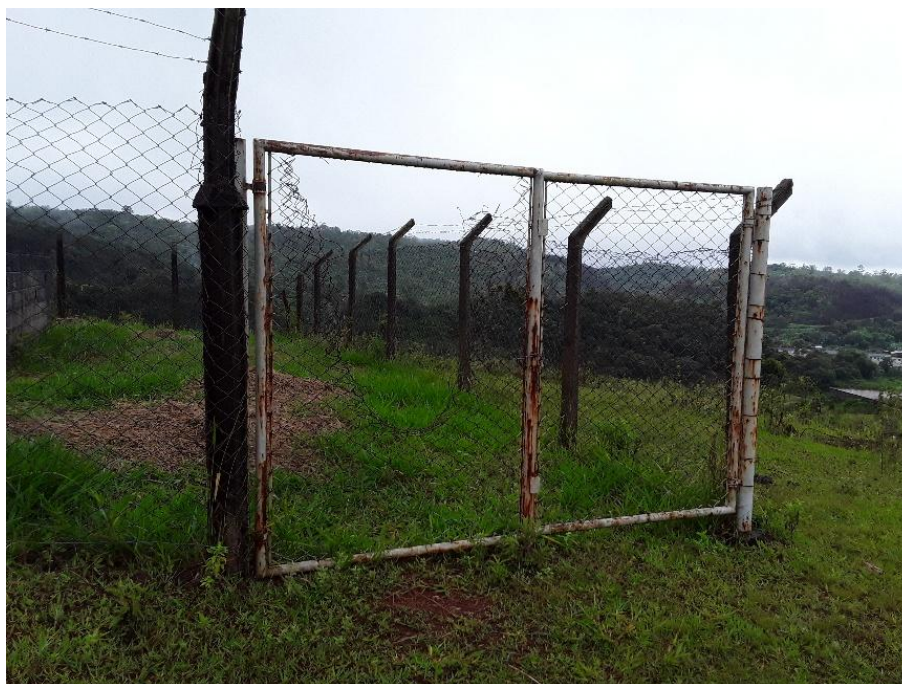
Figura 265 – Abertura na tela de arame do portão de acesso
