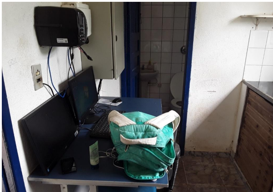
Figura 148 – Mesa para serviços administrativos – ETA Seminário
