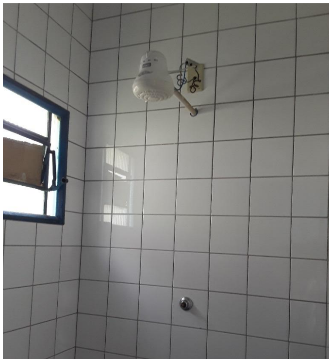
Figura 186 – Chuveiro - ETA Santa Rita de Cássia
