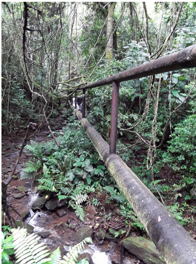
Figura 58 – Adutoras – Captação Cristal
