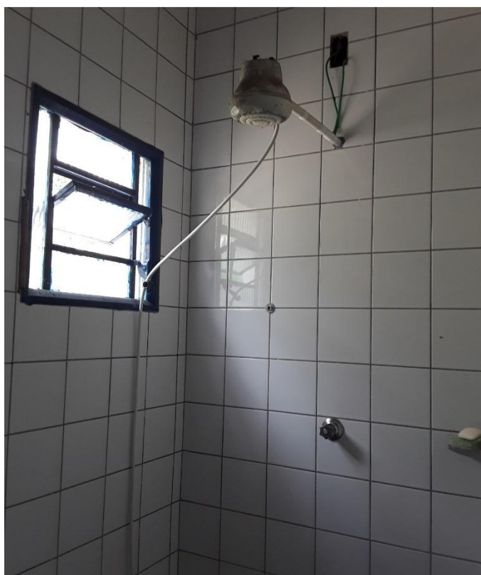
Figura 149 – Chuveiro – ETA Seminário
