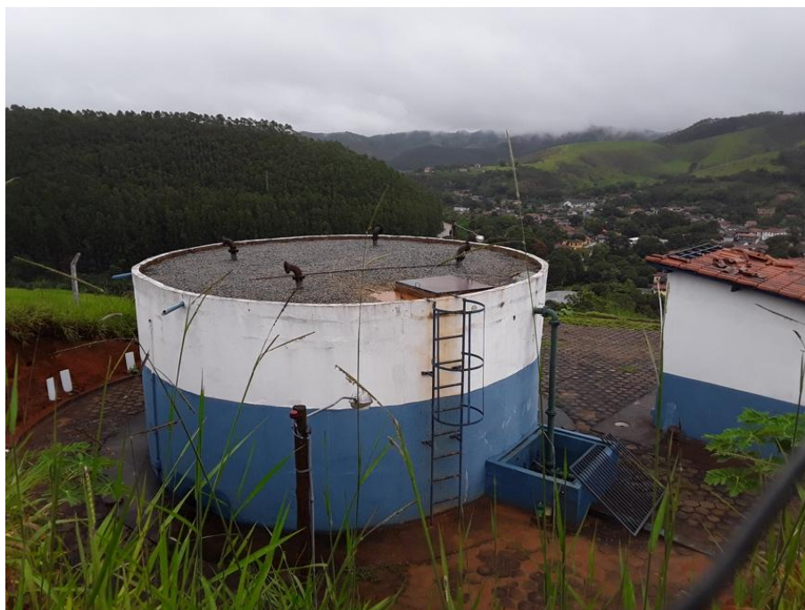
Figura 253 – Reservatório do poço de Monsenhor Horta
