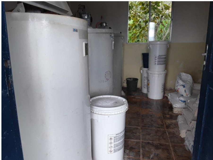
Figura 174 – Sala de armazenamento, preparo e dosagem dos produtos químicos – ETA Santa Rita de Cássia
