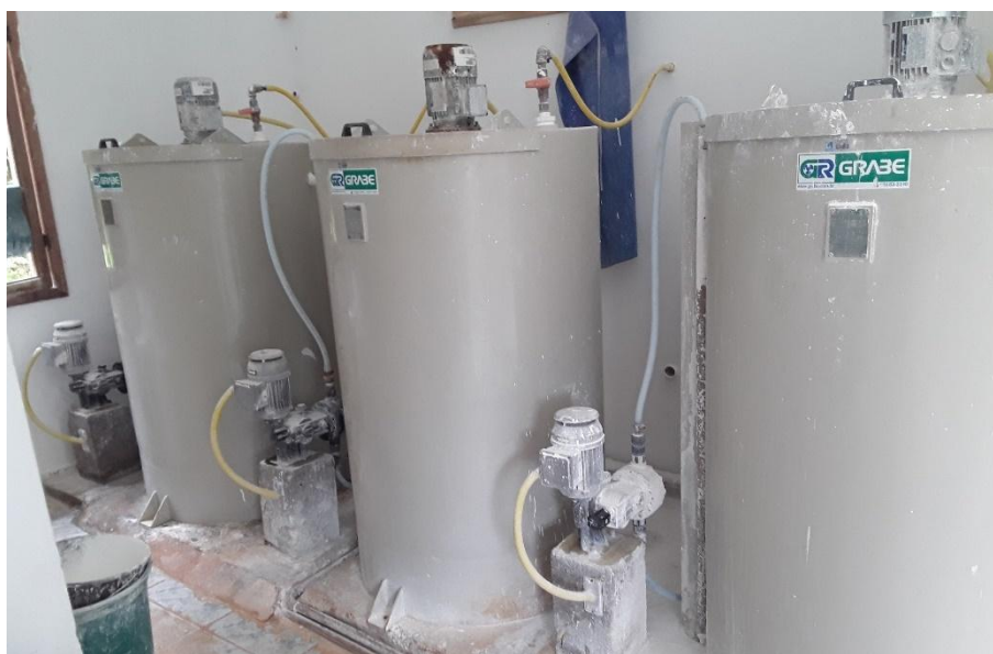
Figura 203 – Área de preparo dos produtos químicos- ETA Matadouro
