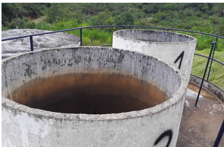
Figura 130 – Filtros rápidos 1 e 2 – ETA Seminário
