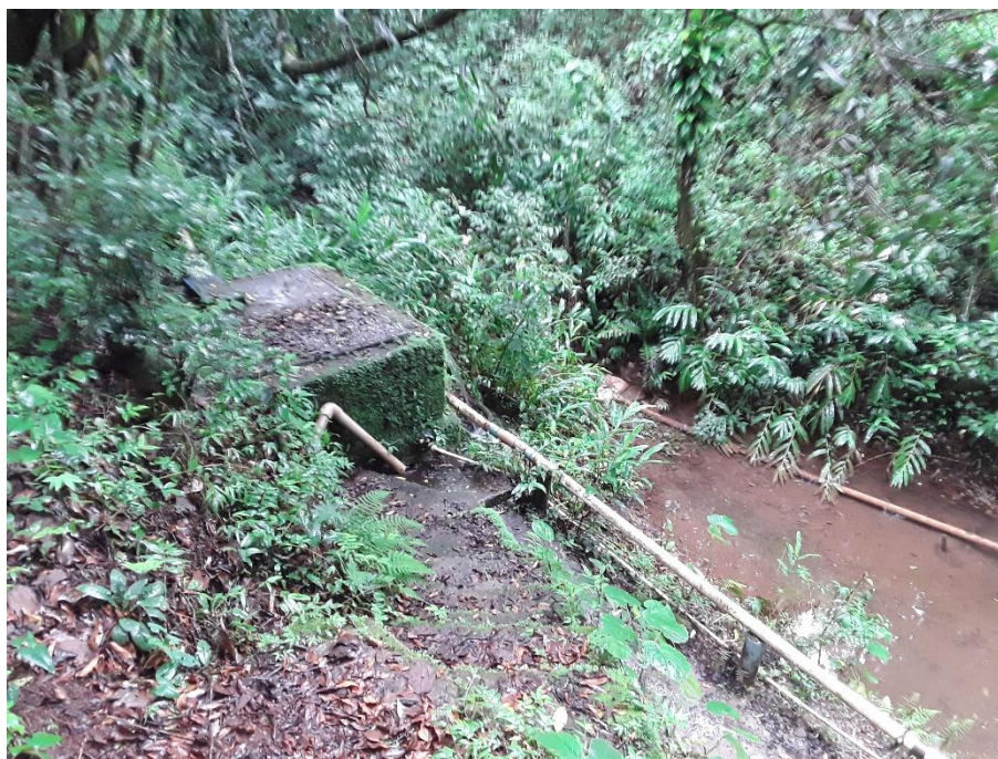
Figura 71 – Caixa de passagem
