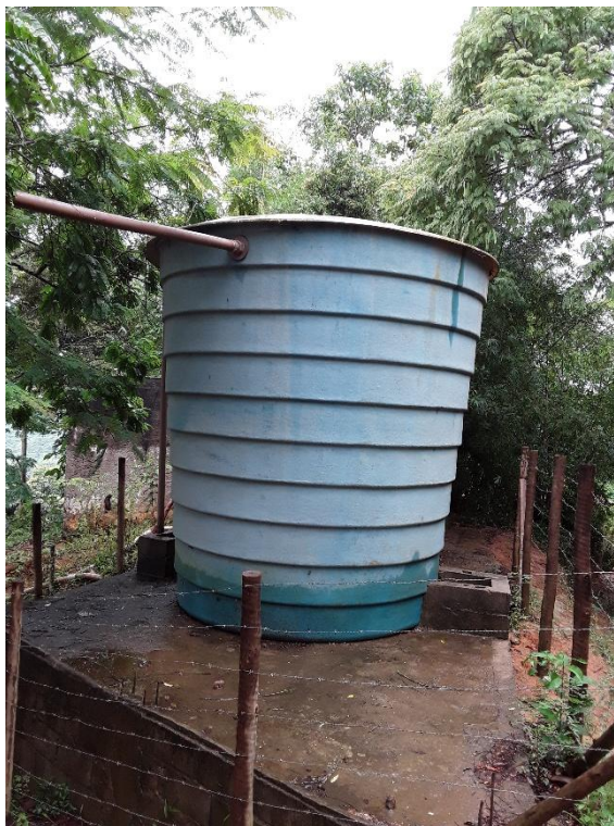
Figura 247 – Reservatório de fibra de vidro de Coelhos
