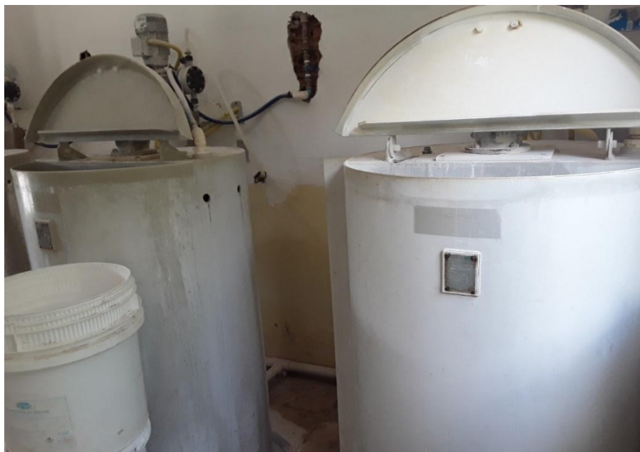
Figura 142 – Local de preparo dos produtos químicos – ETA Seminário
