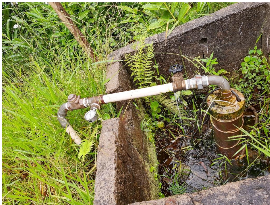
Figura 83 – Captação subterrânea Jardim Santana
