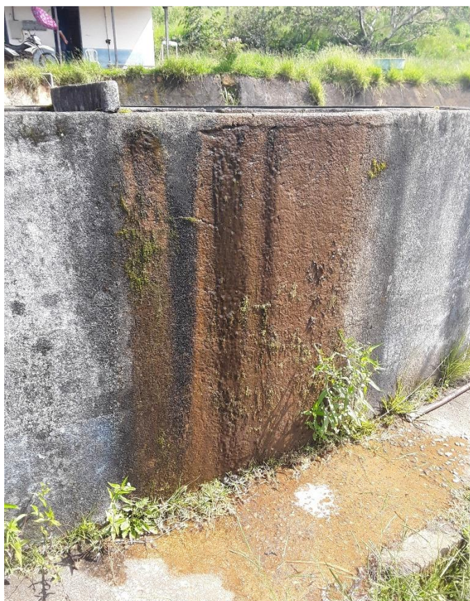
Figura 159 – Vazamento na lateral do floculador – ETA Santa Rita de Cássia
