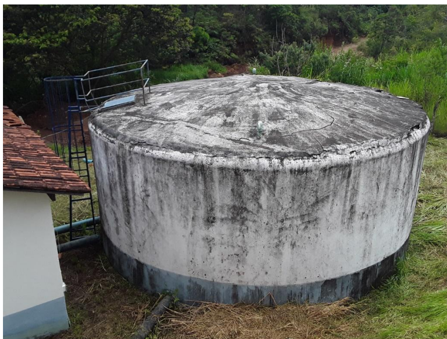
Figura 133 – Reservatório – ETA Seminário
