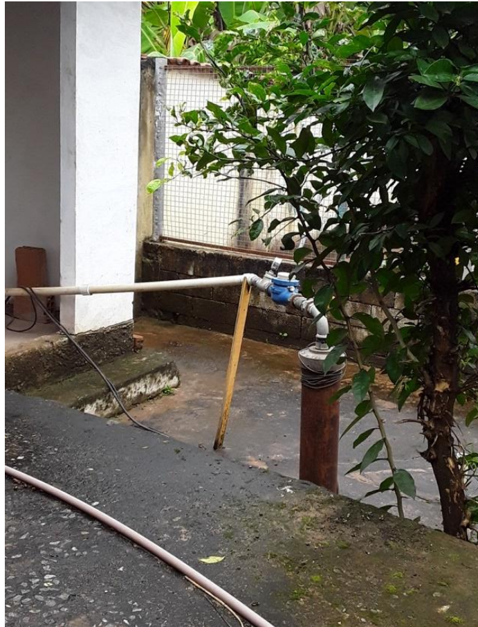
Figura 272 – Captação subterrânea de Barro Branco
