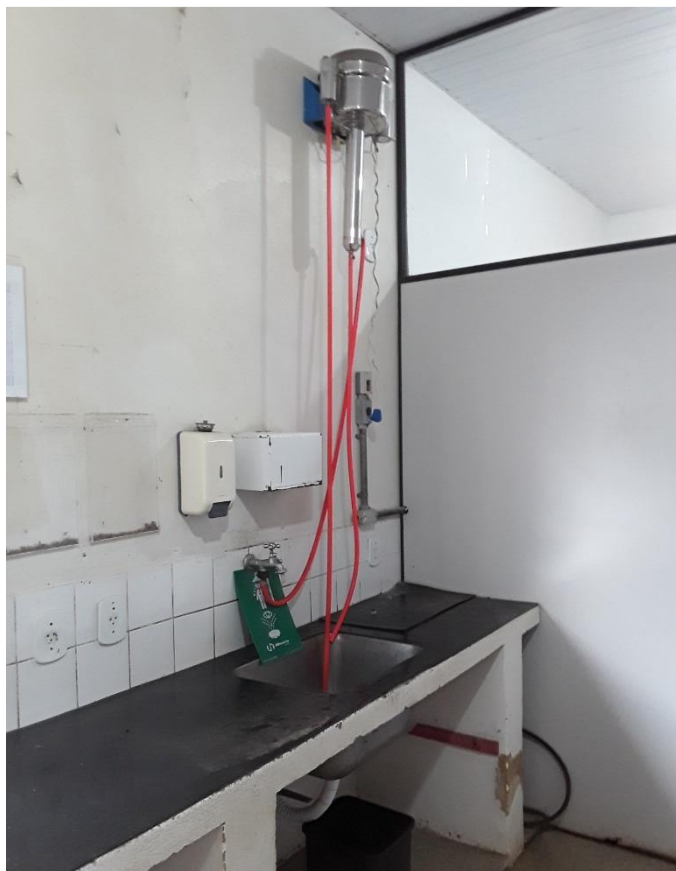
Figura 116 – Bancada do laboratório – ETA Sul
