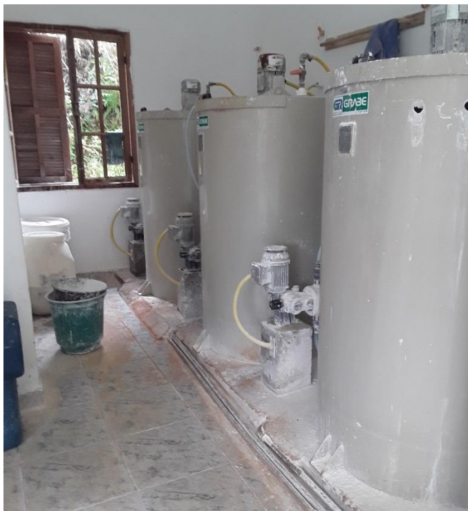
Figura 204 - Área de preparo dos produtos químicos- ETA Matadouro
