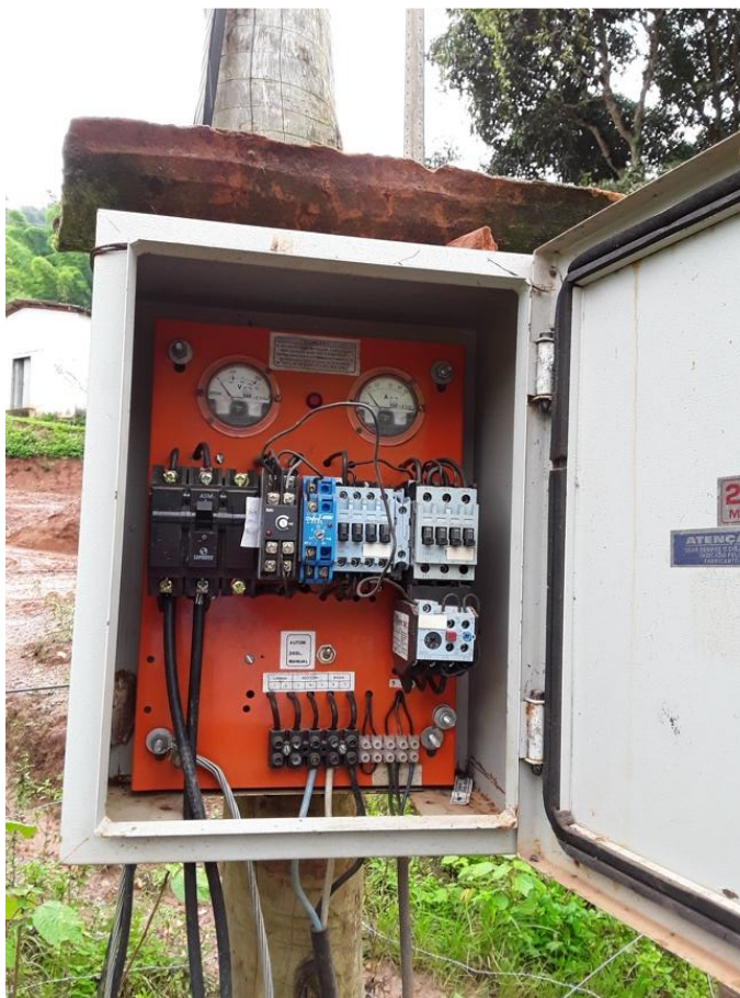
Figura 276 – Quadro de comando
