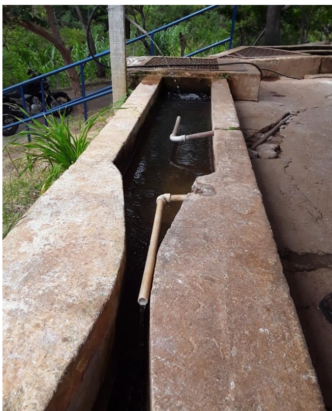
Figura 127 – Calha Parshall – ETA Seminário
