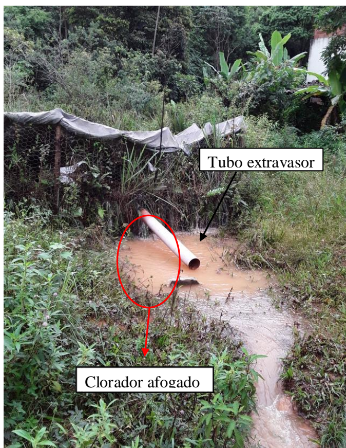
Figura 229 – Captação de Cachoeira do Brumado
