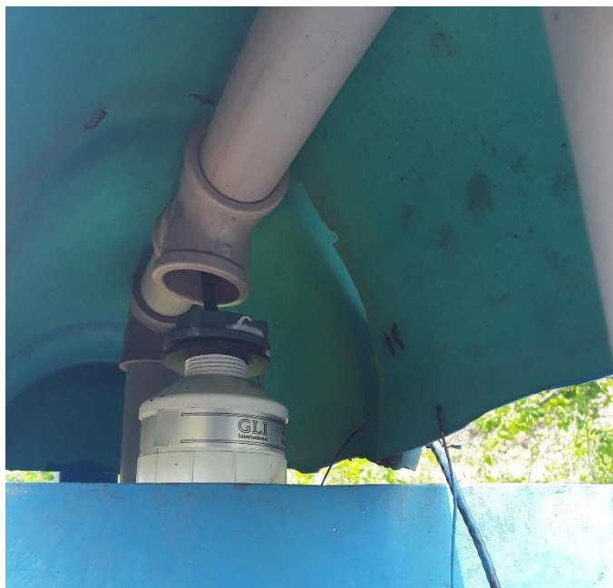
Figura 195 – Medidor de vazão – ETA Matadouro
