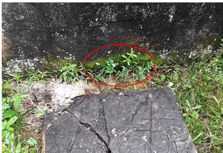
Figura 244 – Local do vazamento
