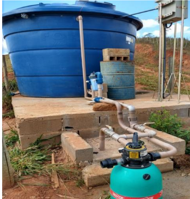
Figura 59 – Poço Tubular no Distrito de Santa Helena
