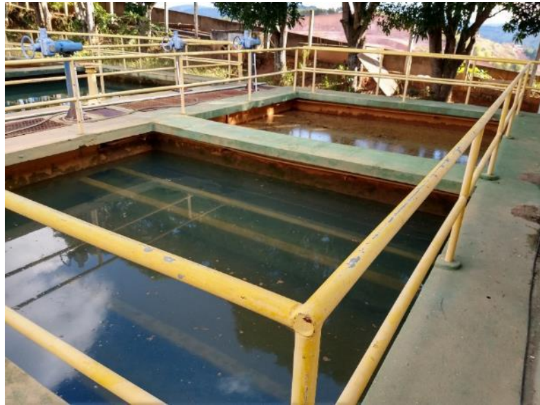
Figura 21 – Filtros da ETA de Ponte Nova
