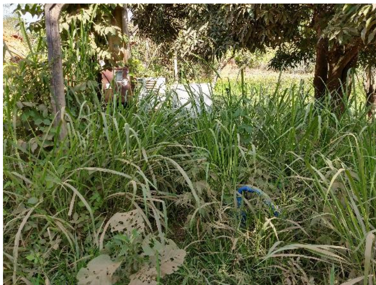
Figura 55 – Poço Tubular no Distrito de Massangano
