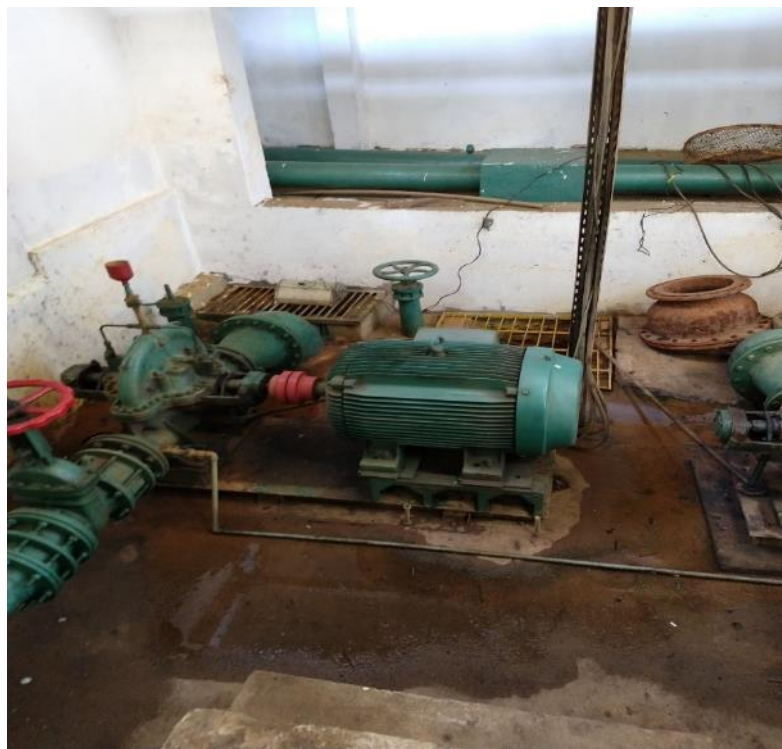
Figura 10 – Vazamento em um dos conjuntos moto bomba
