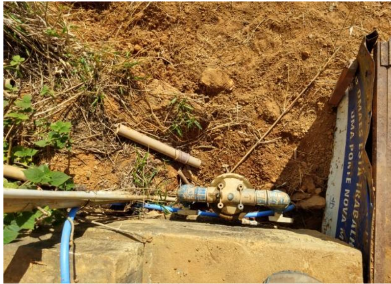
Figura 56 – Dosador de cloro no SAA do Distrito de Massangano
