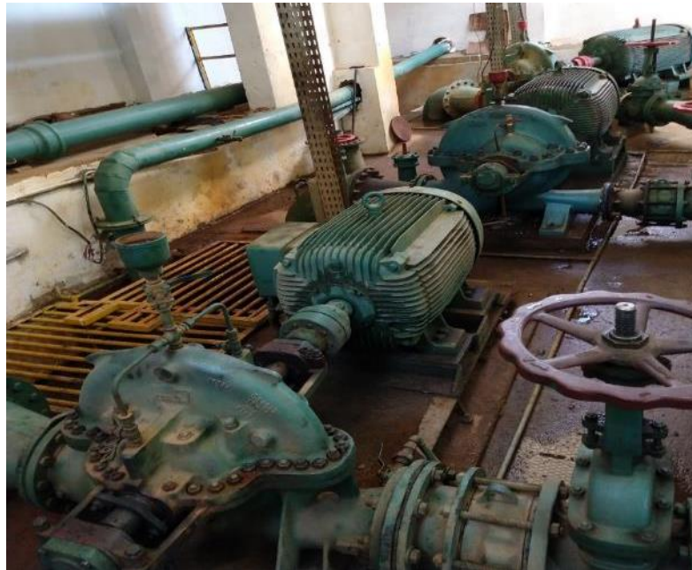
Figura 7 - Elevatória de Água Bruta (Alto Recalque)
