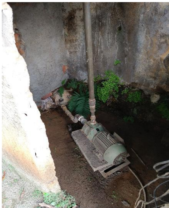
Figura 44 - Conjunto moto - bomba
