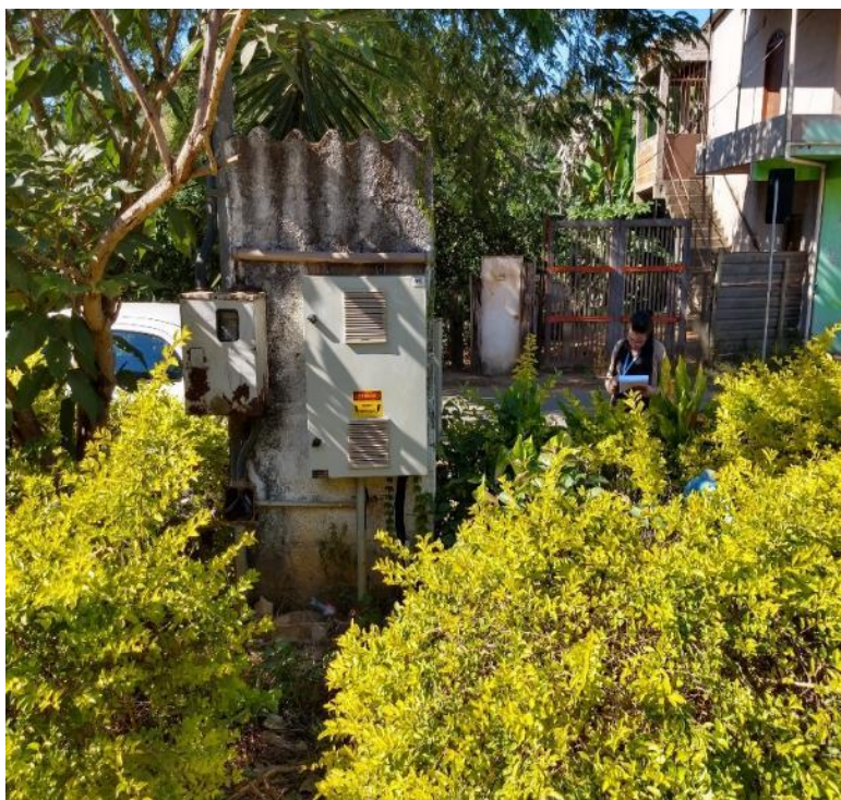
Figura 34 - Poço 2 do Distrito do Pontal localiza-se numa praça pública.
