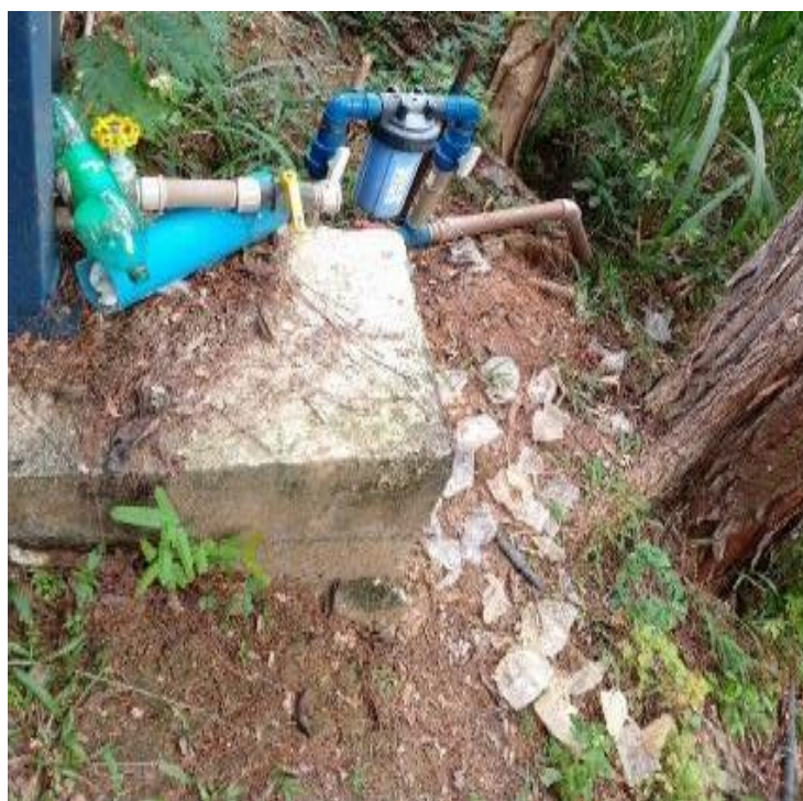
Figura 51 – Unidade de desinfecção
