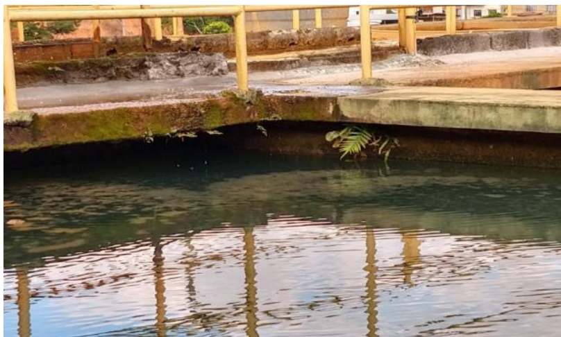
Figura 24 – Presença de vegetação no interior da unidade de decantação
