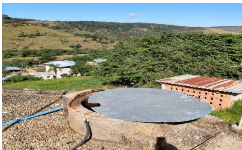
Figura 38 – Tampa de inspeção sem cadeado
