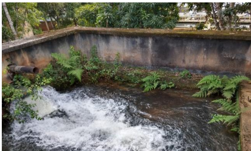
Figura 26 – Local de chegada da água bruta sem limpeza adequada
