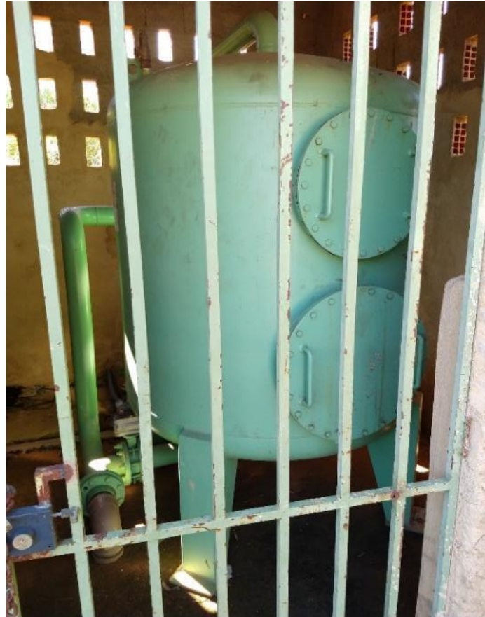
Figura 39 – Unidade de filtração para diminuição de Ferro e Manganês
