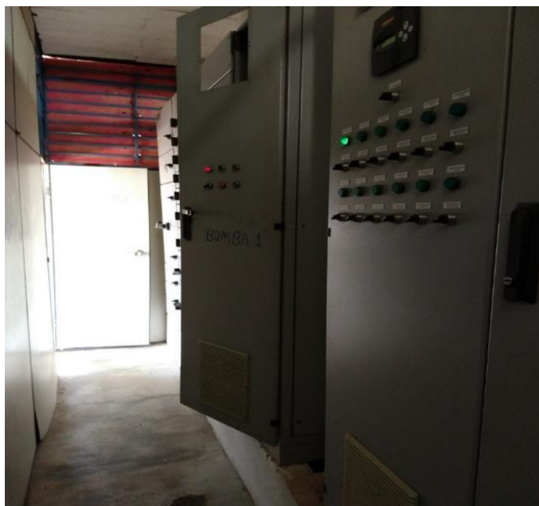
Figura 11 – Local energizado sem o devido isolamento
