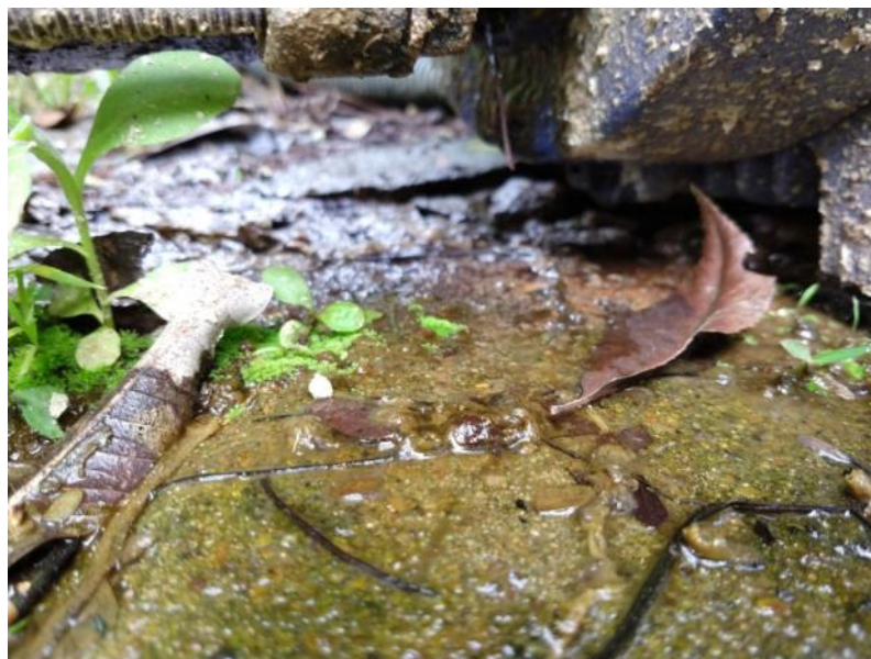
Figura 54 – Vazamento na estrutura do reservatório
