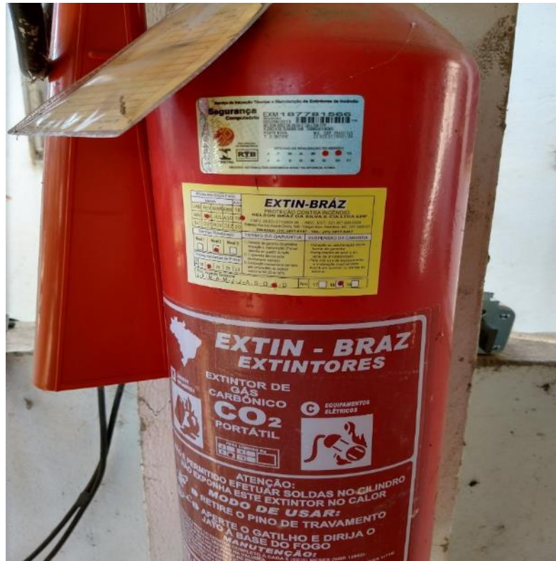
Figura 13 – Extintor de incêndio
