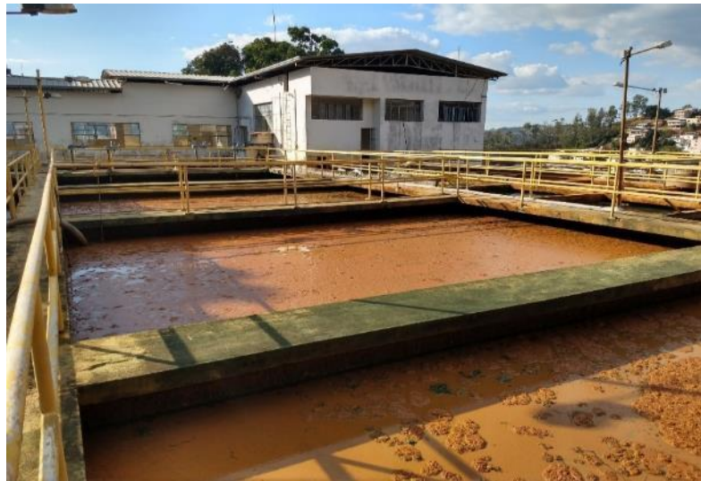
Figura 20 – Decantadores da ETA de Ponte Nova
