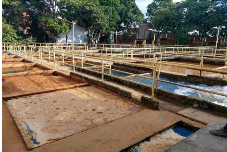
Figura 19 – Flocculadores na ETA de Ponte Nova
