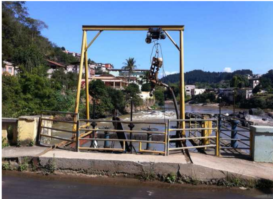
Figura 4 - Elevatória de Baixo Recalque no Rio Piranga
