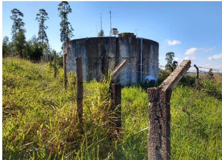
Figura 36 – Reservatório local necessita de manutenção.
