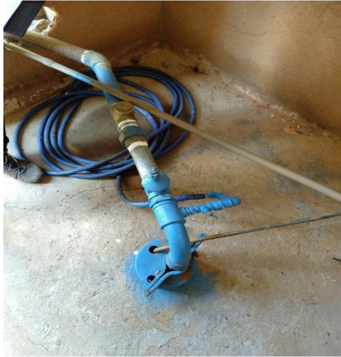
Figura 46 – Poço 3 do Distrito de Vau-Açu
