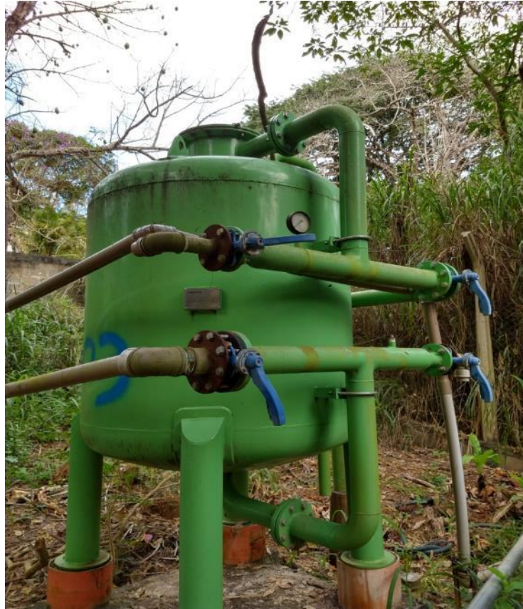
Figura 52 – Unidade de filtração no SAA de Passa Tempo
