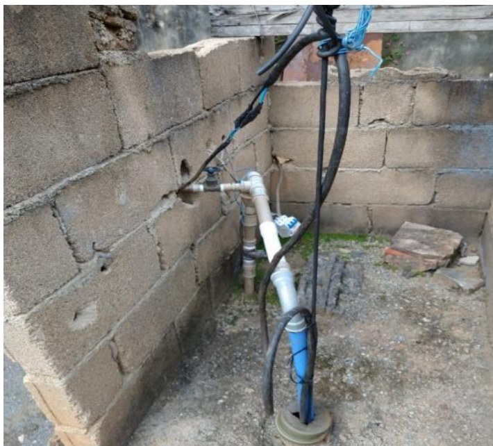
Figura 42 - Poços 1 e 2 são interligados
