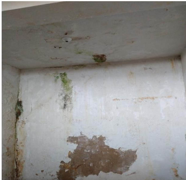
Figura 28 – Infiltração na estrutura da ETA de Ponte Nova
