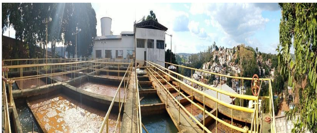
Figura 16 – ETA do DMAES de Ponte Nova
