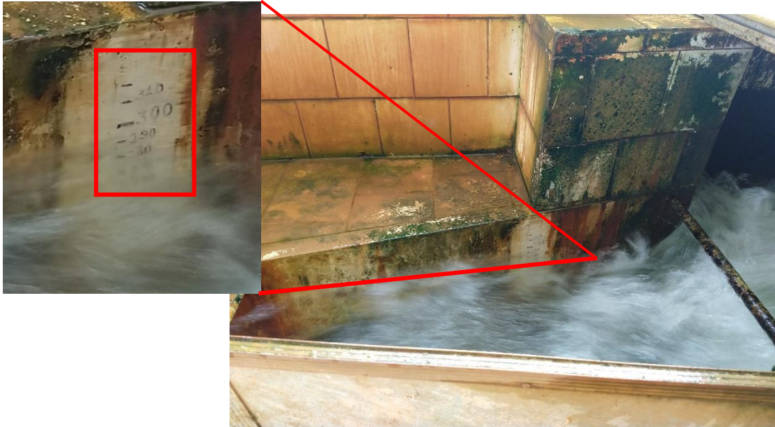
Figura 18 – Estrutura da Calha Parshall na ETA do DMAES
