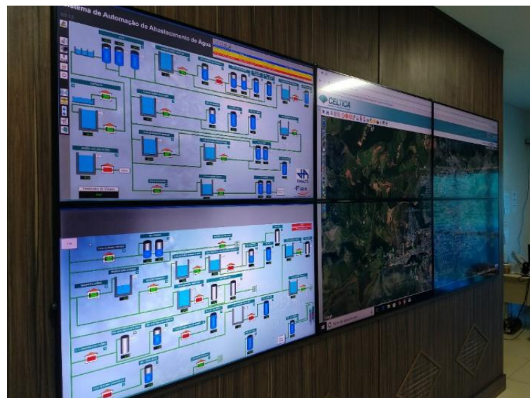
Figura 30 - Sistema de Telemetria no DMAES de Ponte Nova
