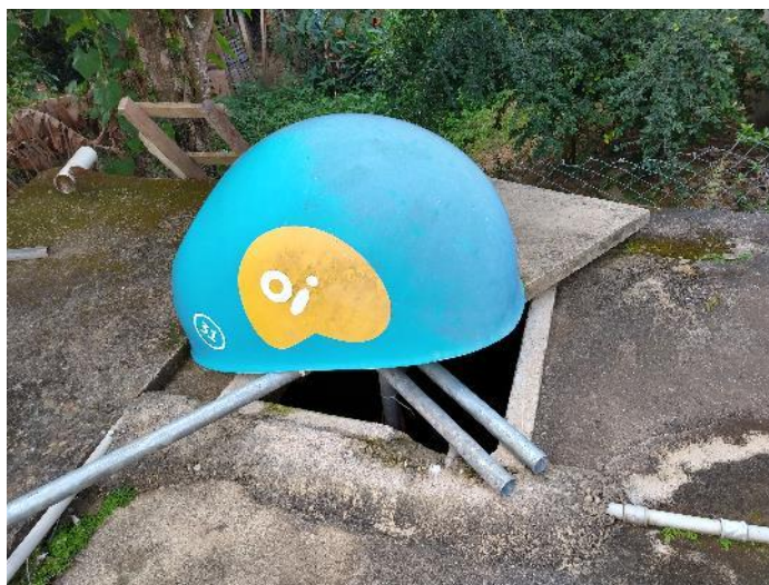
Figura 43 - Reservatório dos poços 1 e 2
