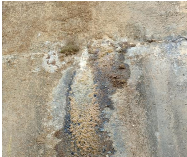
Figura 27 – Vazamento na estrutura da ETA de Ponte Nova
