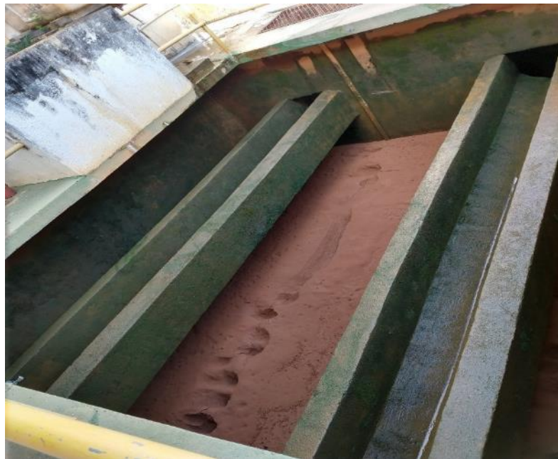
Figura 22 – Filtro passando por retrolavagem na ETA de Ponte Nova
