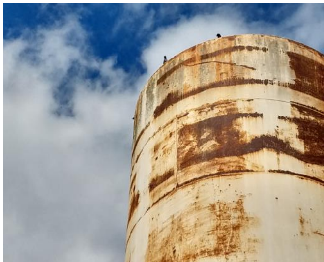
Figura 49 – Reservatório (branco) apresenta oxidação em alguns pontos
