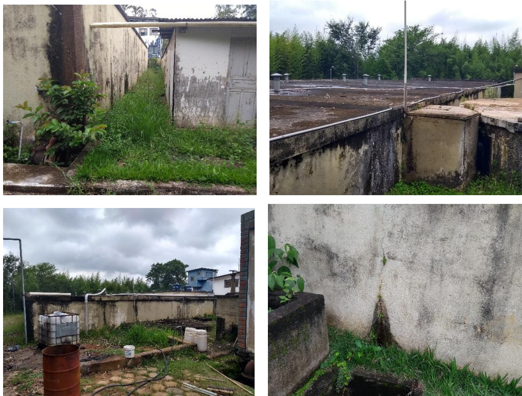
Figuras 104 a 107 – Reservatórios.
