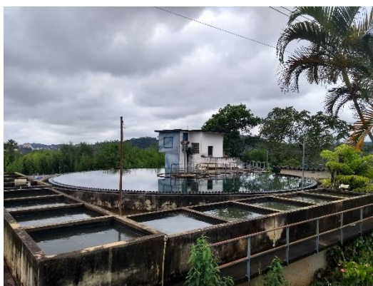
Figura 91 – Decantador e floculadores.
