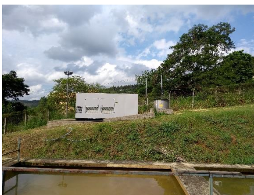
Figura 198 – Gerador de energia.
