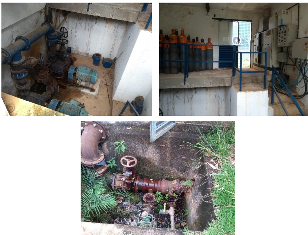
Figuras 130 a 132 – Casa de bombas.
