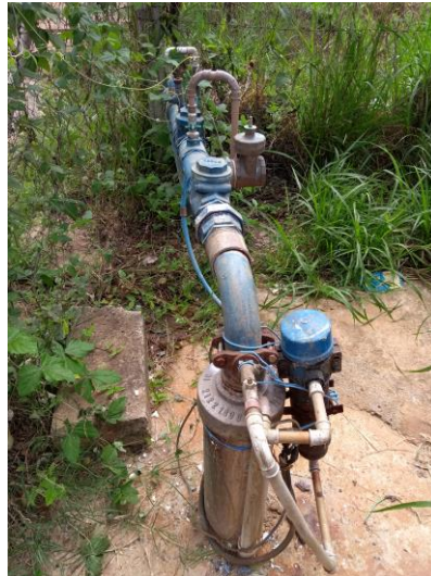
Figura 65 - Captação subterrânea no bairro Novo Silvestre.
