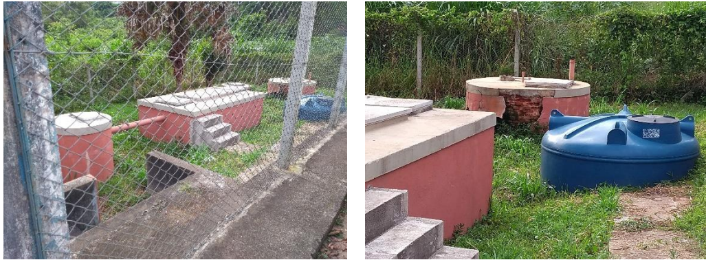
Figuras 229 a 232 – ETE localizada no bairro Romão dos Reis.
