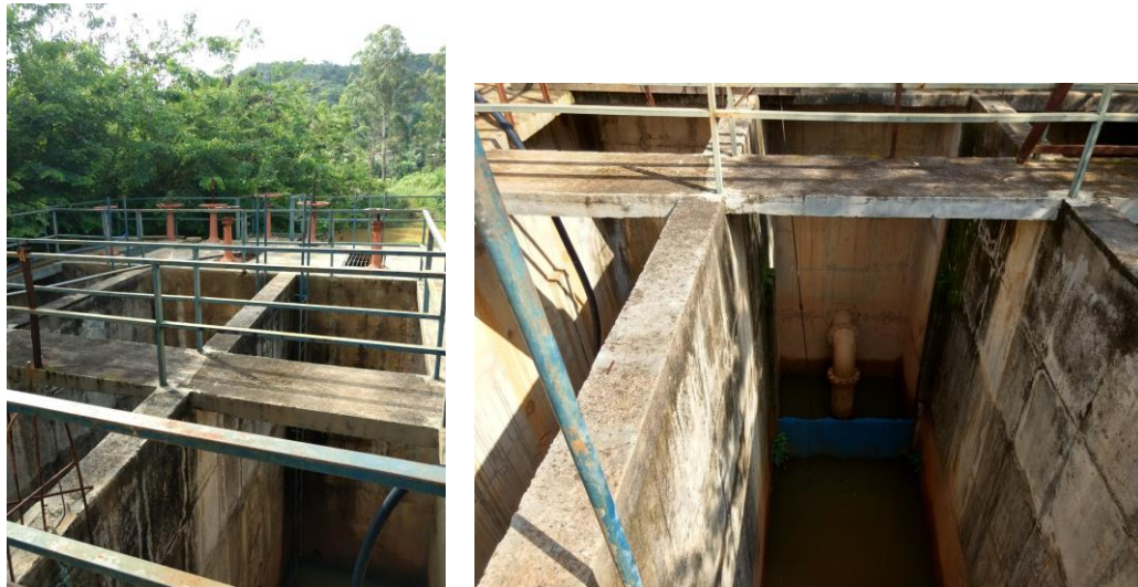
Figuras 55 e 56 – Ponto de sucção da água (Rio Turvo Sujo ao fundo) e detalhe da tela utilizada para retenção de sólidos.
