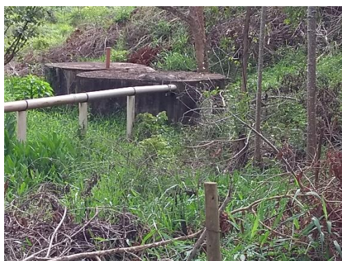
Figuras 247 a 249 – ETE localizada na zona rural Nobres.
