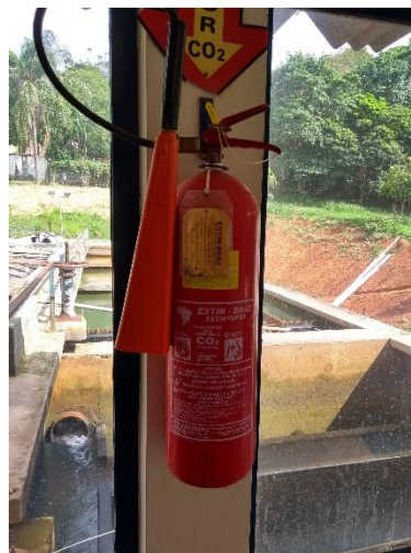
Figura 189 – Extintor de incêndio.
