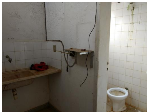
Figura 61 – Dependência da casa de bombas com banheiro e pia para uso do operador.
