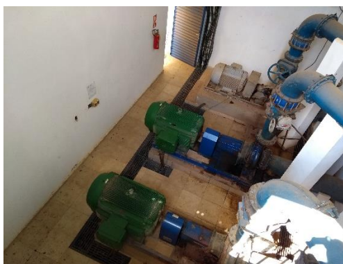
Figuras 194 a 196 – Casa de bombas.
