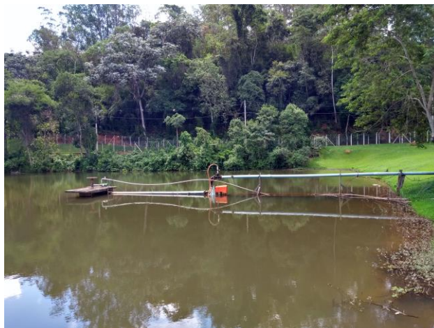
Figura 50 – Bomba para captação localizada no meio da represa.
