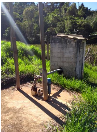
Figura 76 – Visão geral da captação subterrânea no bairro Nova Viçosa.
