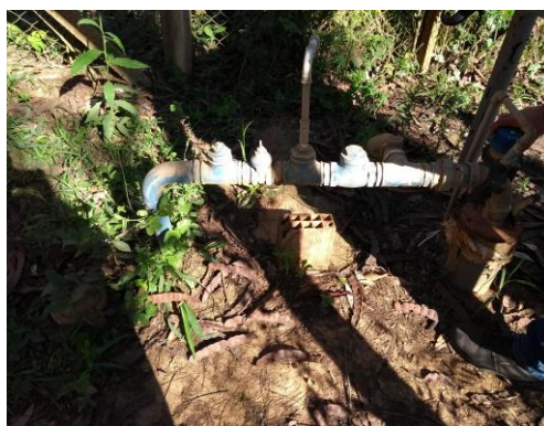
Figura 77 – Captação subterrânea na comunidade Novo Paraíso.
