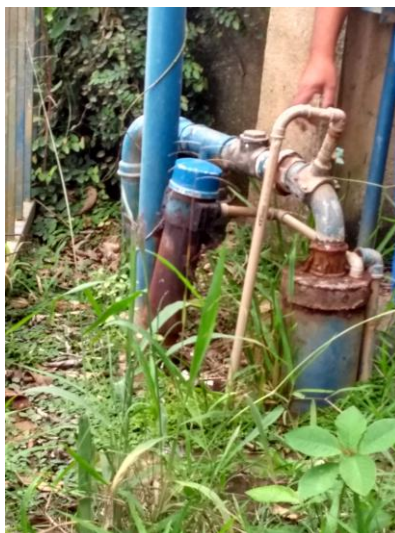
Figura 82 – Captação subterrânea na comunidade Cristais.
