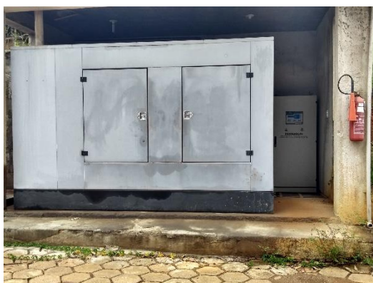
Figura 133 – Gerador de energia.
