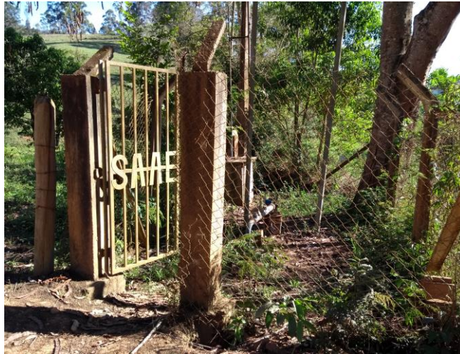
Figura 33 – Captação subterrânea na comunidade Novo Paraíso.
