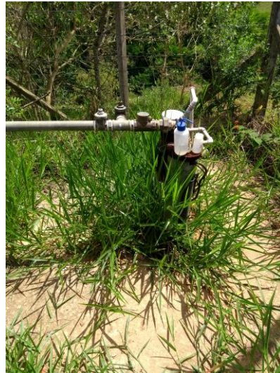
Figura 66 – Captação subterrânea na comunidade Buieíé.
