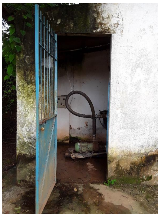
Figura 84 – Casa de bomba de Conceição da Boa Vista
