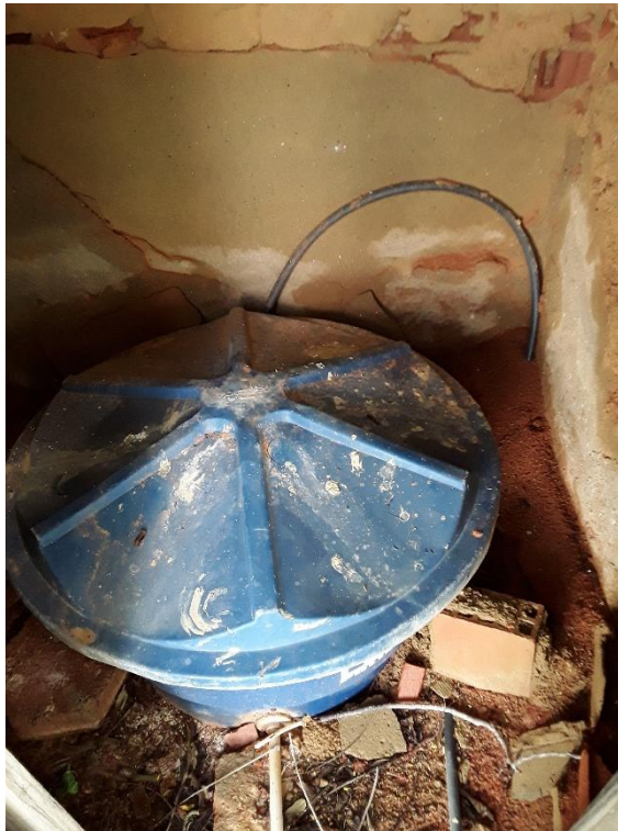
Figura 82 – Armazenamento da solução de cloro
