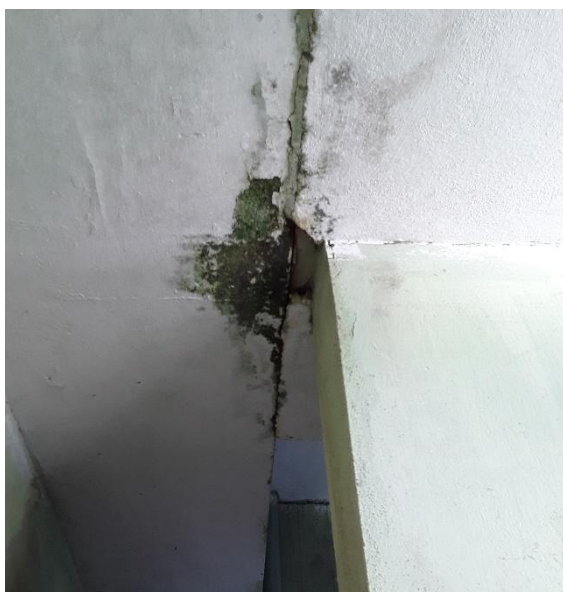
Figura 42 – Infiltrações no banheiro
