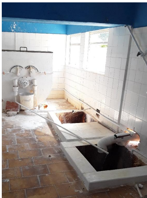
Figura 40 – Tanque de contato
