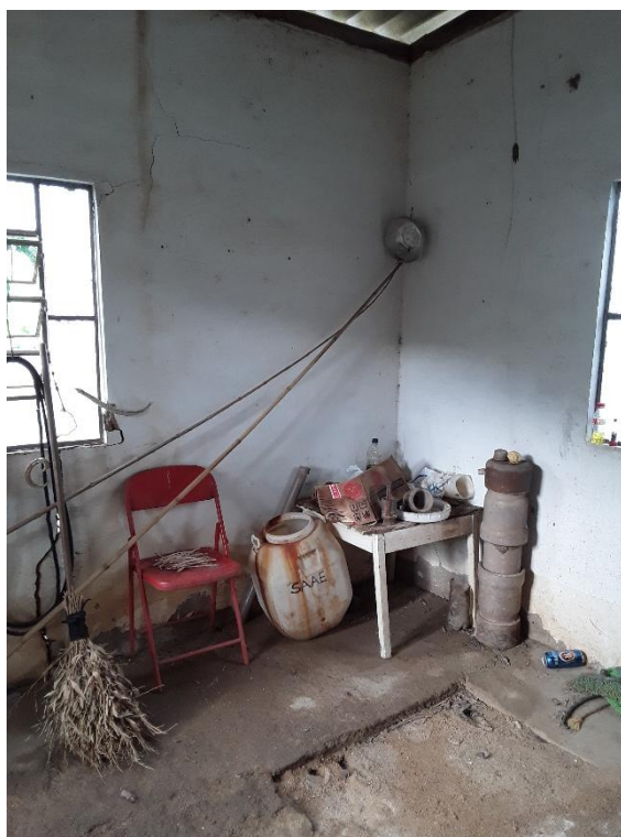
Figura 69 – Materiais no interior da casa de bombeamento
