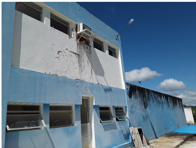
Figura 46 – Parte posterior da ETA com pintura desgastada e excesso de umidade
