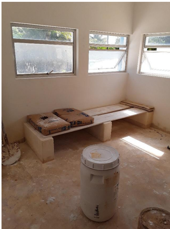
Figura 47 – Armazenamento dos produtos químicos
