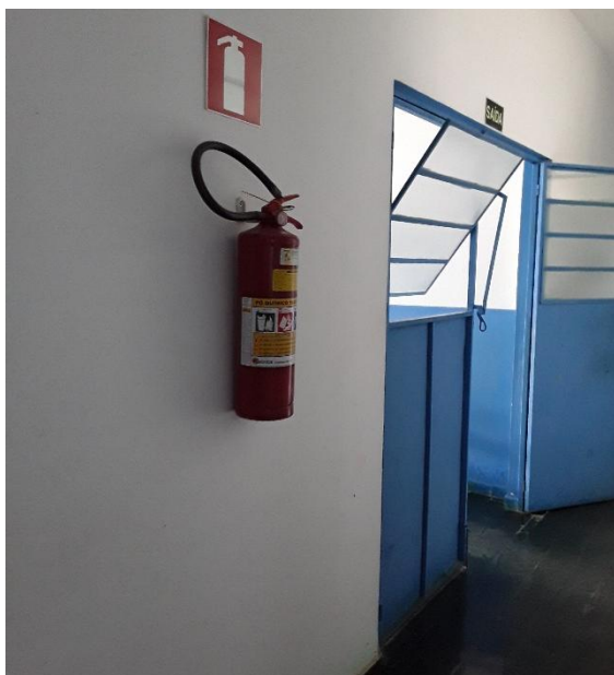
Figura 3 – Extintor de incêndio em área central
