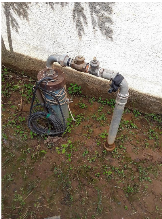
Figura 77 – Poço sem laje sanitária de proteção
