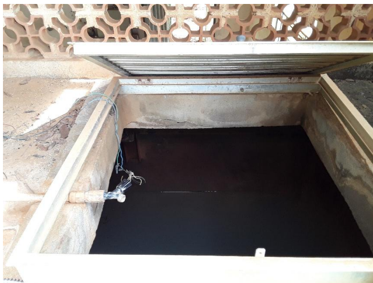
Figura 91 – Tampa de inspeção do tanque de contato
