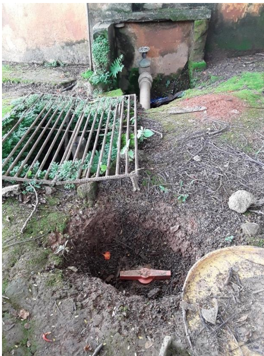
Figura 79 – Registros e descarga de fundo do reservatório
