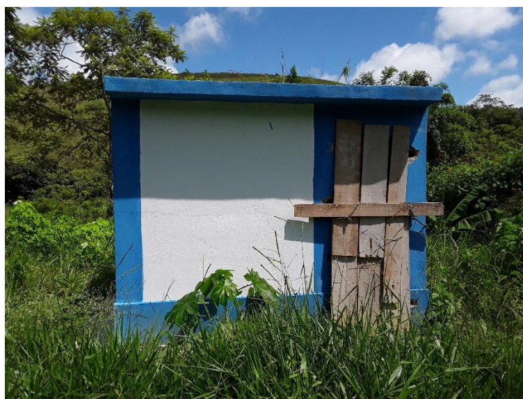
Figura 30 – Captação subterrânea da sede
