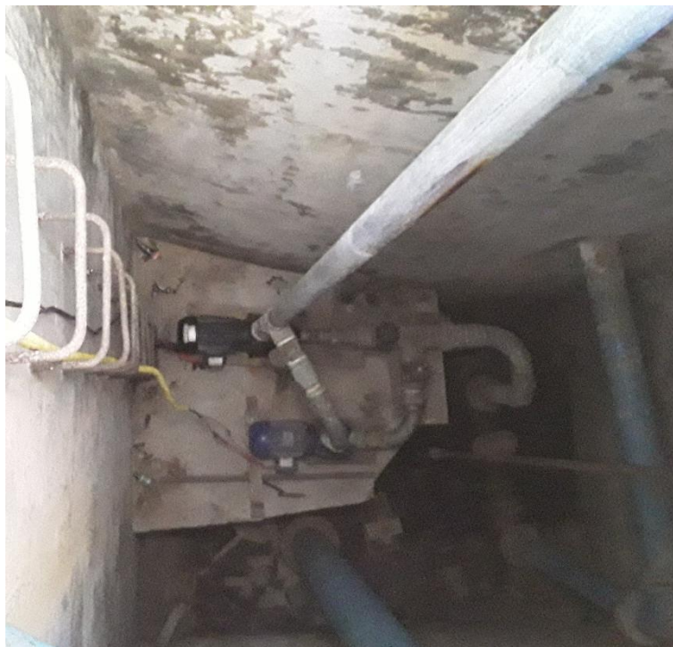
Figura 64 – Bombeamento na ETA
