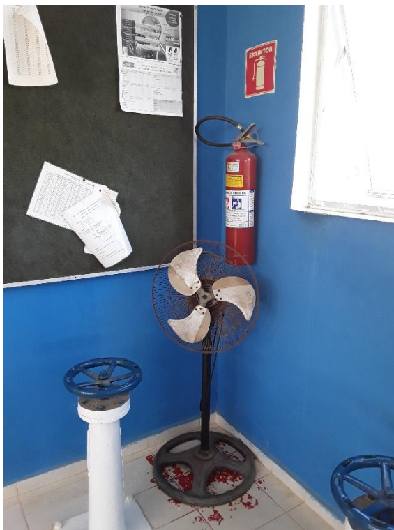
Figura 58 – Extintor de incêndio obstruído
