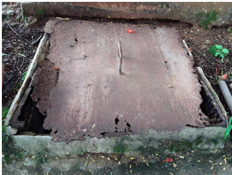
Figura 81 – Tampa de inspeção corroída
