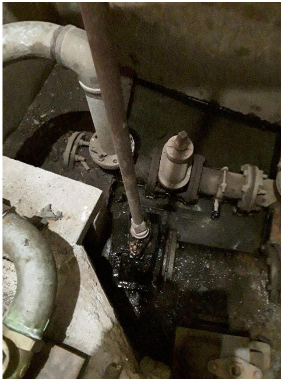
Figura 63 – Vazamento no registro do reservatório
