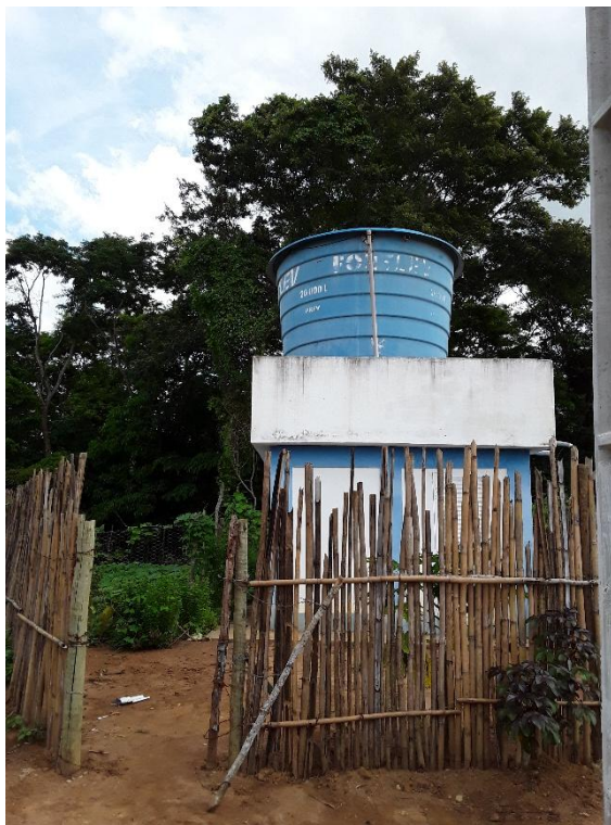
Figura 86 – Reservatório do Cohab de Conceição
