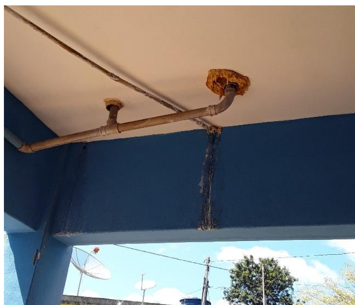
Figura 45 – Vazamento de coagulante
