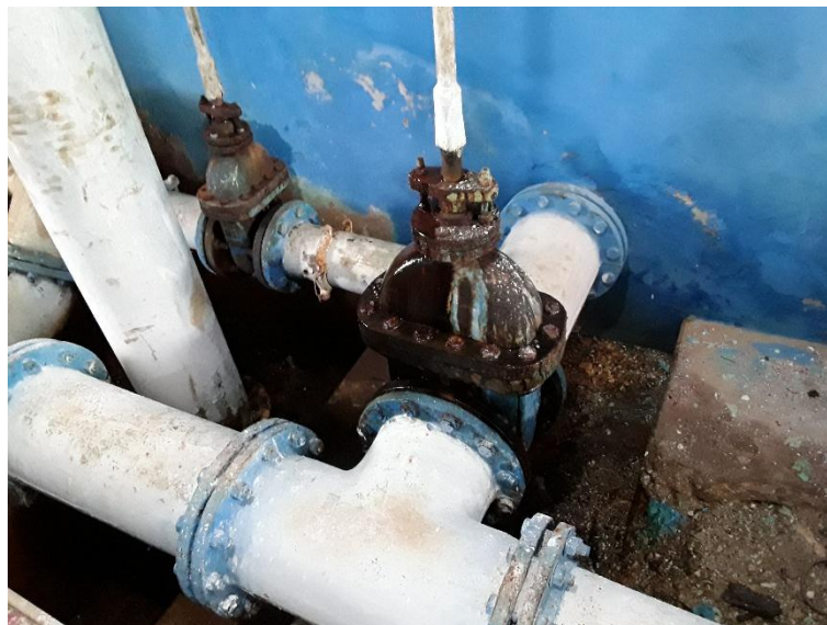
Figura 39 – Vazamento no registro dos filtros
