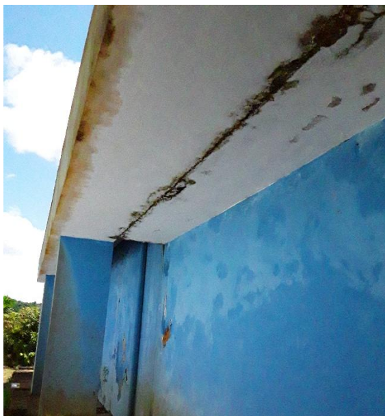
Figura 43 – Linha de infiltração ao longo da estrutura da ETA
