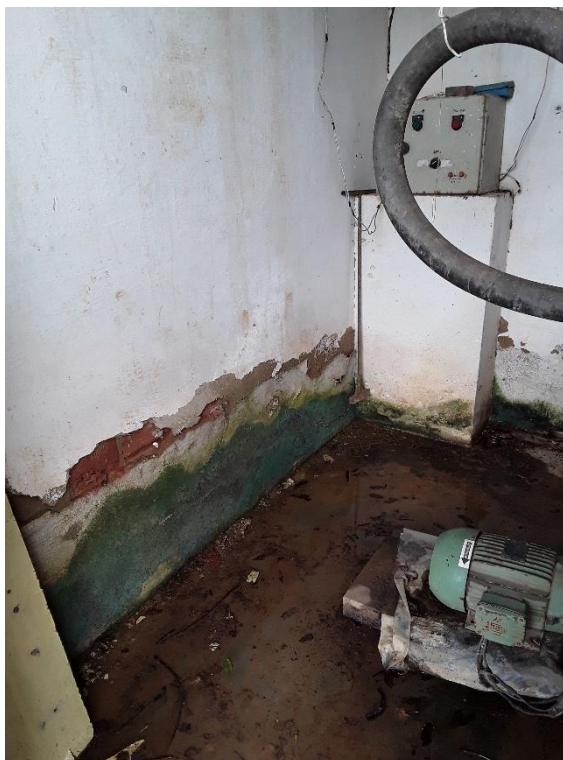
Figura 85 – Água empoçada na casa de bomba
