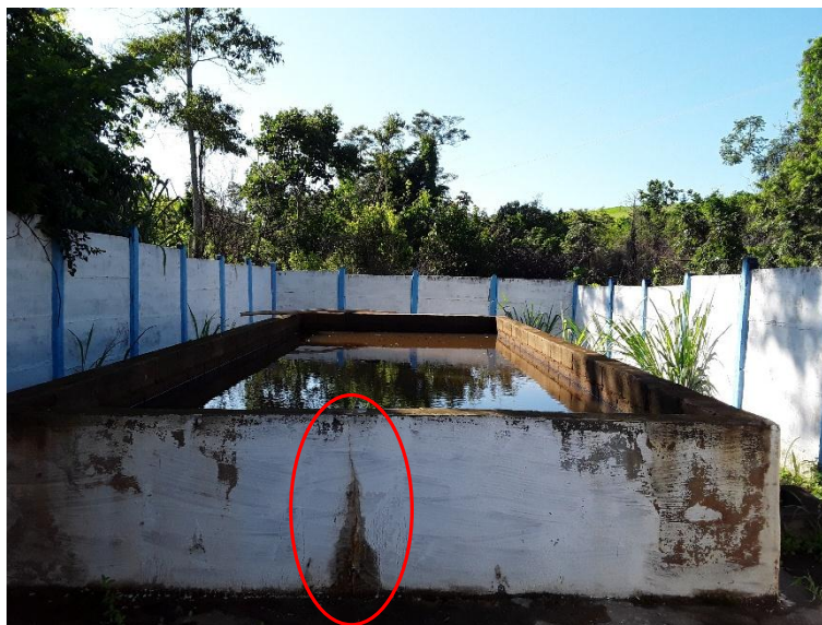
Figura 28 – Fissura verificada na caixa de areia a partir do portão
