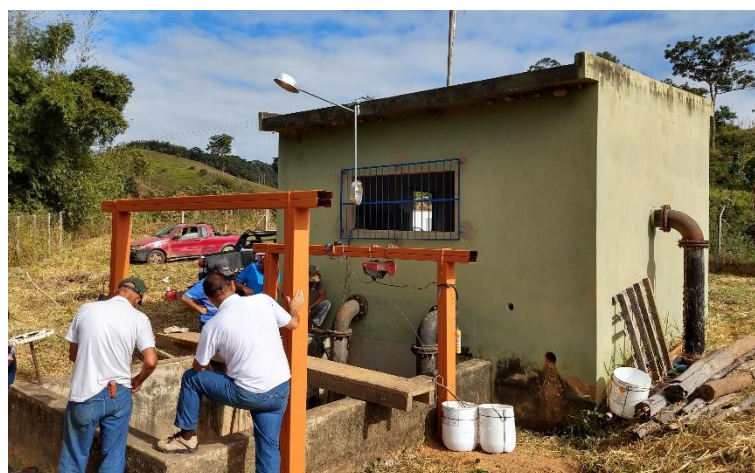
Figura 21 – Casa de Bombas - Captação Cobrador
