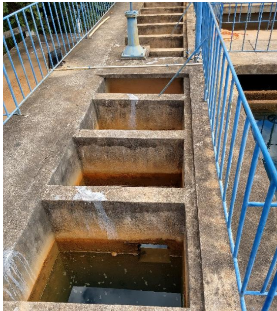
Figura 36 –Floculadores - ETA Córrego Cobrador
