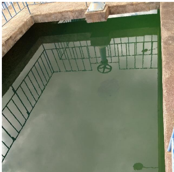
Figura 37 –Decantador - ETA Córrego Cobrador
