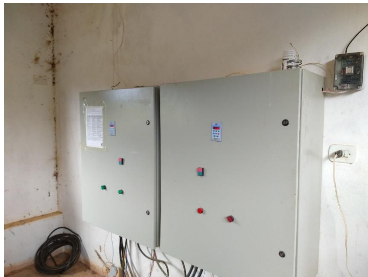
Figura 23 – Painel de Controle - Captação Cobrador
