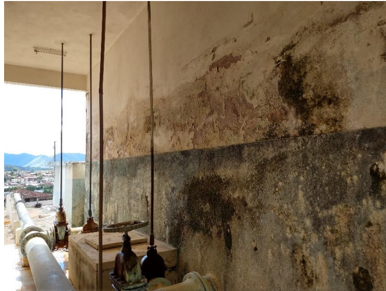
Figura 42 – Umidade na ETA Córrego Cobrador
