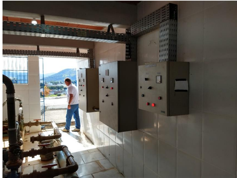
Figura 69 – Painel de controle da Casa de Bombas - ETA
