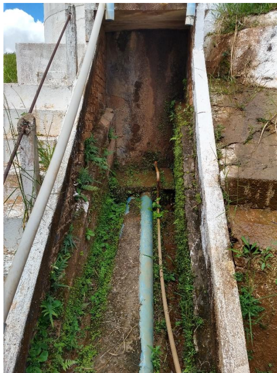
Figura 33 –Vazamento na Chegada da água Captada no Córrego Cobrador
