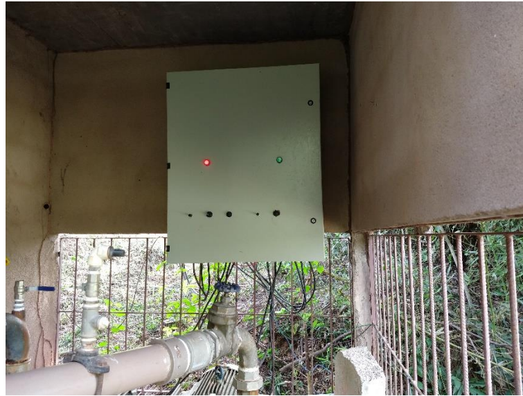
Figura 28 – Painel de Controle – Captação Rio José Pedro
