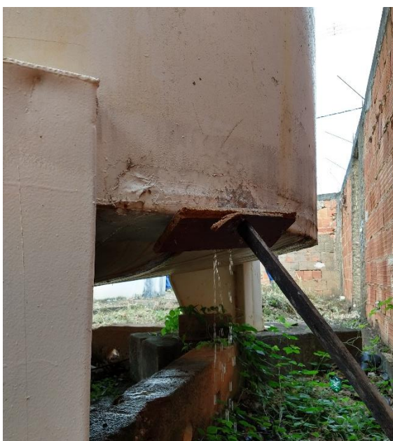
Figura 81 – Vazamento Reservatório Nova Cidade
