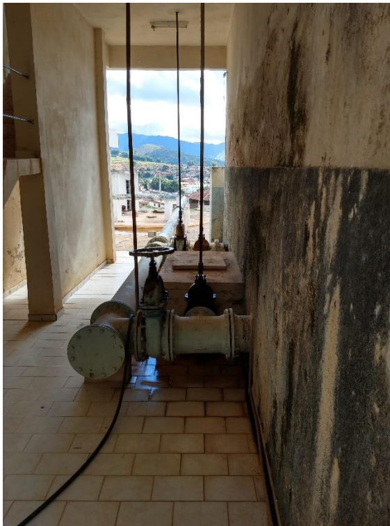
Figura 40 –Umidade na ETA Córrego Cobrador
