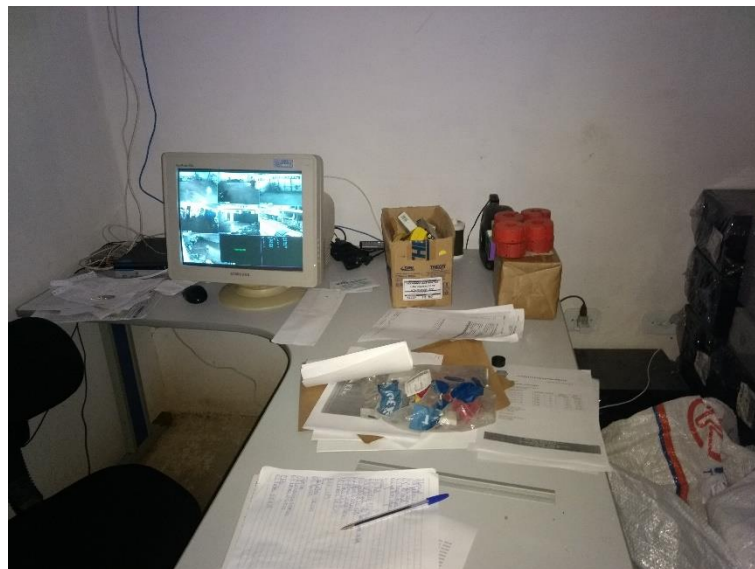
Figura 72 – Sala de Controle do Almoxarifado
