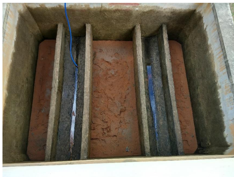
Figura 47 – Lavagem do Filtro - ETA Tabuleiro
