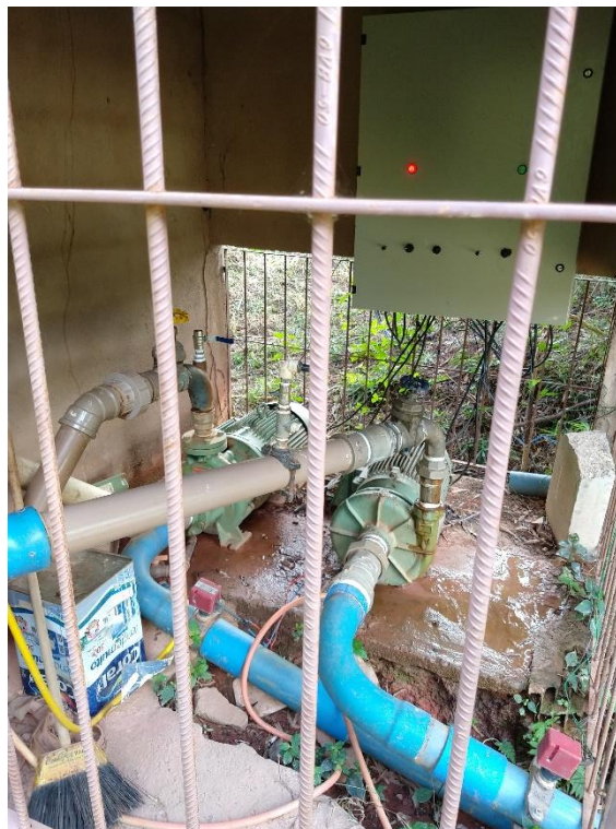
Figura 29 – Casa de Bombas - Captação Rio José Pedro
