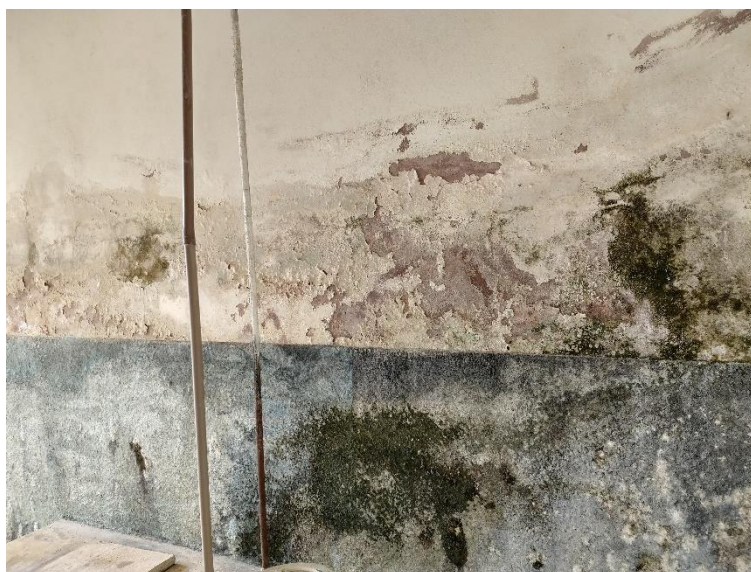
Figura 41 –Umidade na ETA Córrego Cobrador
