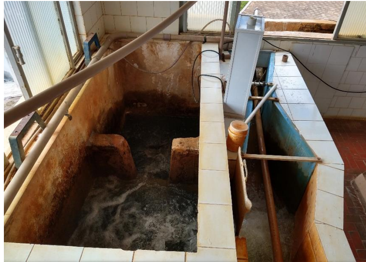
Figura 44 – Calha Parshall – ETA Tabuleiro
