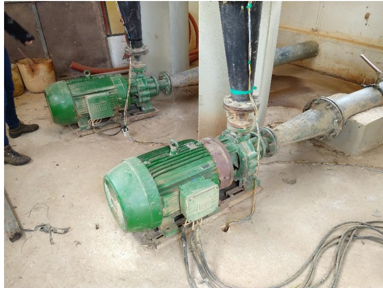
Figura 22 – Bombas - Captação Cobrador
