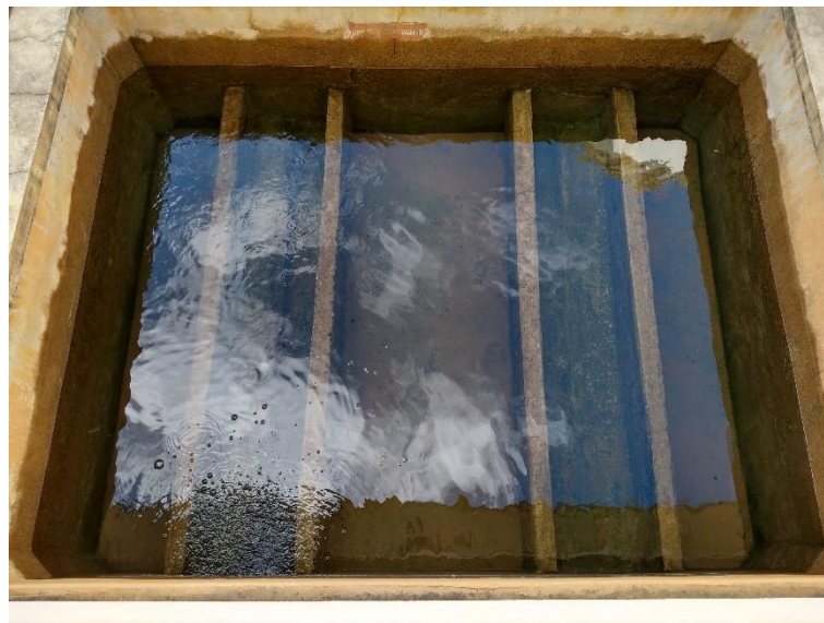
Figura 46 – Filtro - ETA Tabuleiro
