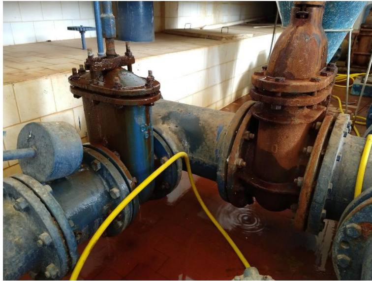
Figura 51 – Vazamento nos Registros - ETA Tabuleiro
