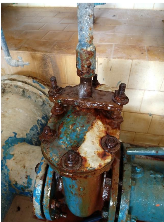
Figura 50 – Vazamento no Registro - ETA Tabuleiro
