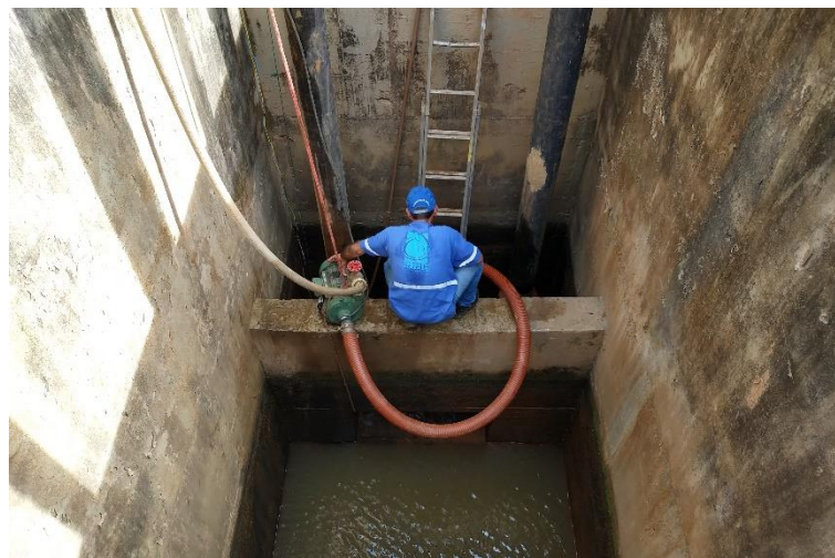
Figura 20 – Tanque de Sucção - Captação Cobrador
