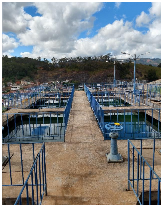
Figura 35 –ETA que trata a água Captada no Córrego Cobrador
