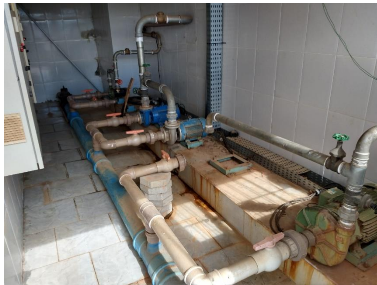
Figura 68 – Casa de Bombas - ETA
