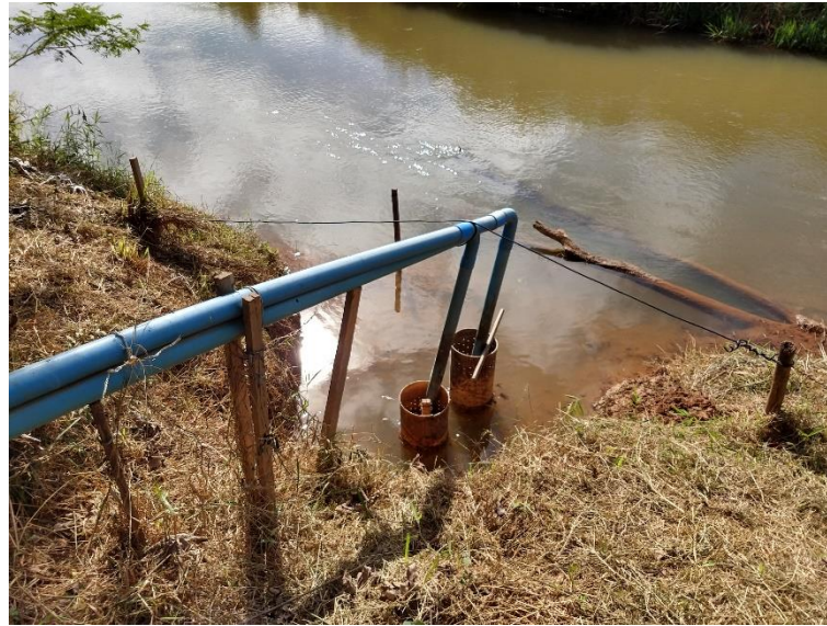
Figura 26 – Tubulação de Sucção – Captação Rio José Pedro
