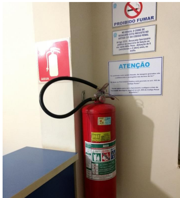
Figura 11 – Extintor de incêndio no Atendimento Comercial
