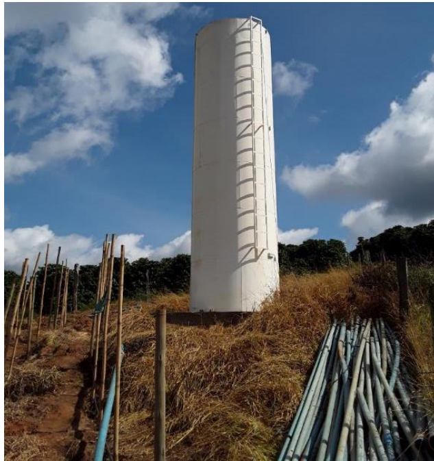
Figura 73 - Reservatório R-2 Área sem cercamento.
