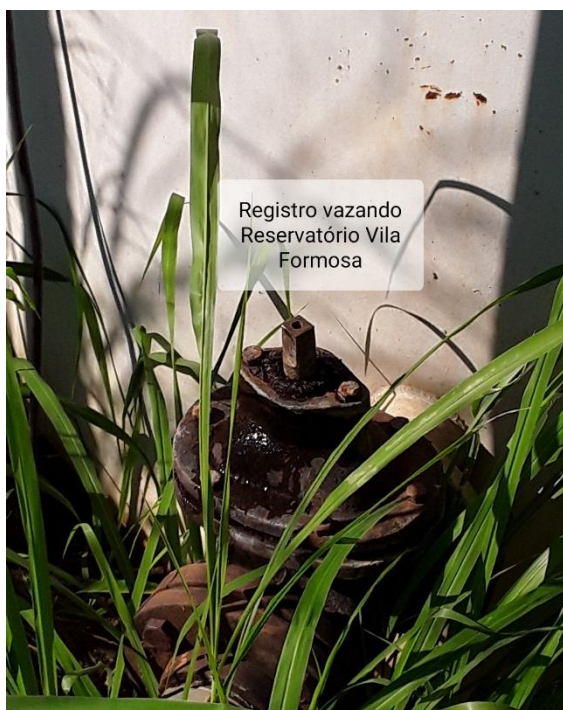
Figura 157 – Vazamento no registro do Reservatório – Vila Formosa
