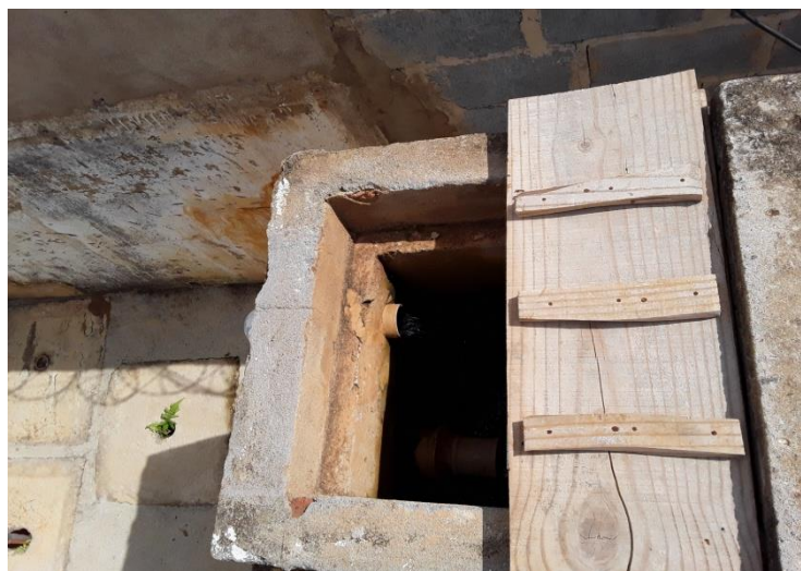
Figura 130 – Tampo improvisada no tanque de contato na ETA
