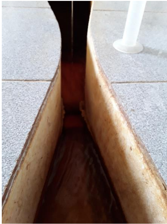
Figura 107 – Calha Parshall – SAA São Pedro do Avai
