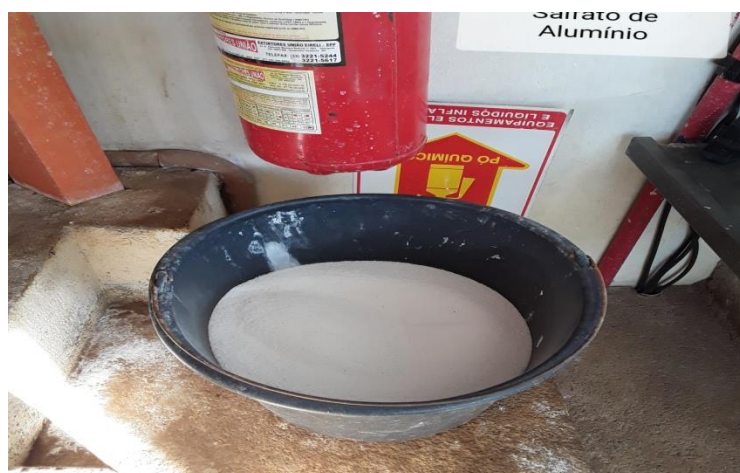
Figura 146 – Produtos químicos são dosados próximo ao local de refeições na ETA.
