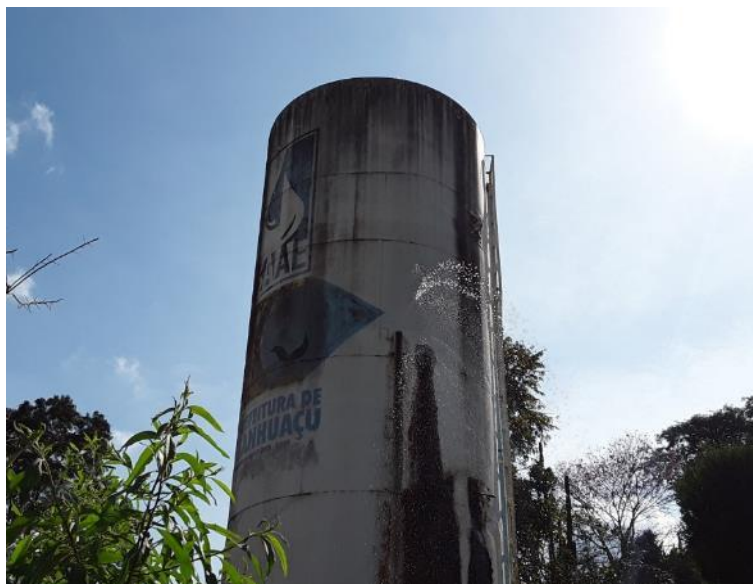
Figura 71 - Reservatório R-1 - Vazamento no terço superior
