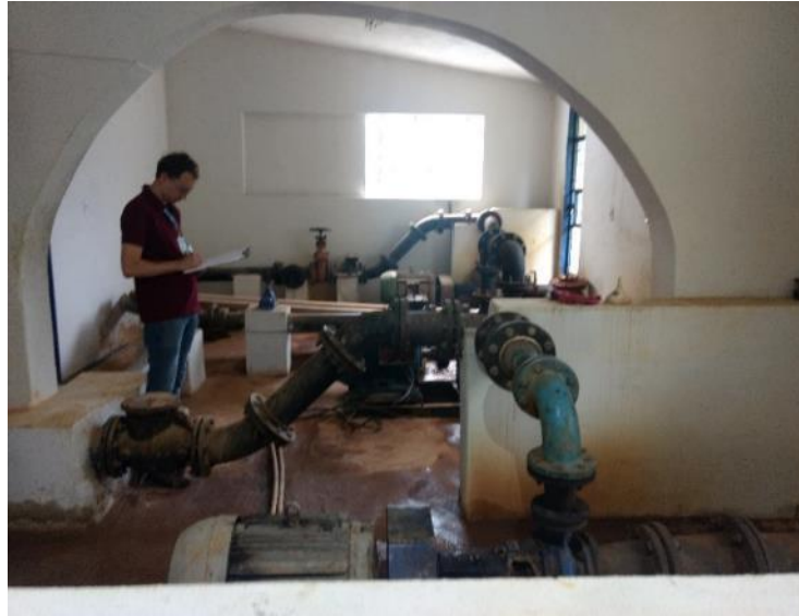
Figura 9 – Conjunto de Bombas – Captação Manhuaçu
