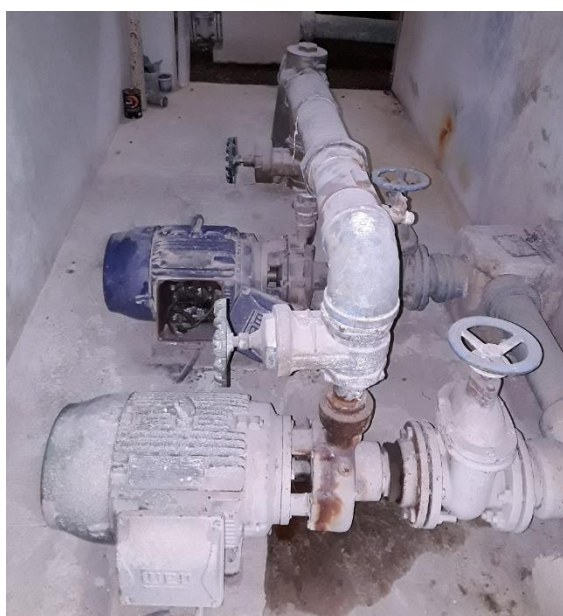
Figura 103 - Casa de Bombas na ETA
