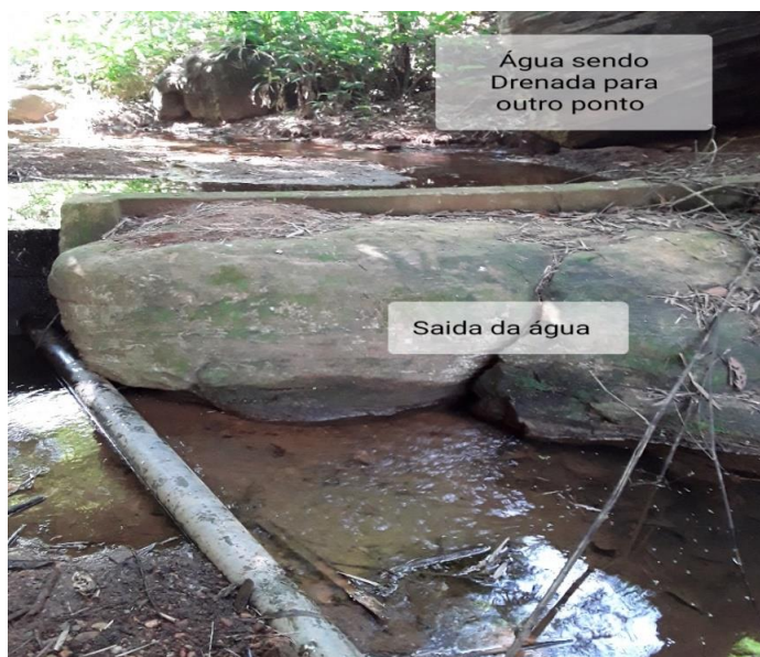
Figura 74 - Manancial de captação - Distrito de Palmeiras do Manhuaçu
