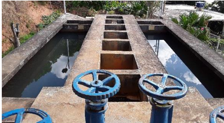
Figura 109 – Floculadores – SAA São Pedro do Avai
