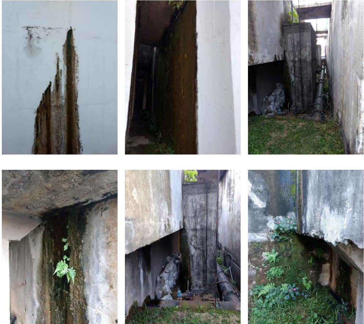
Figura 32 – Vazamentos na ETA Sede
