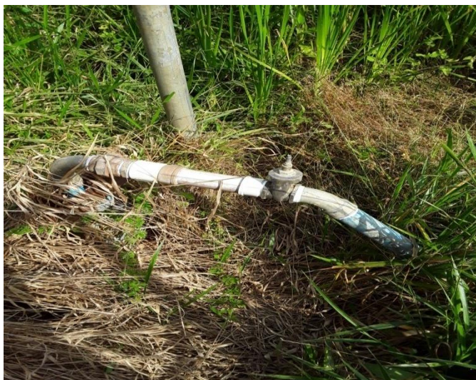
Figura 125 – Poço 1 em São Sebastião do Sacramento
