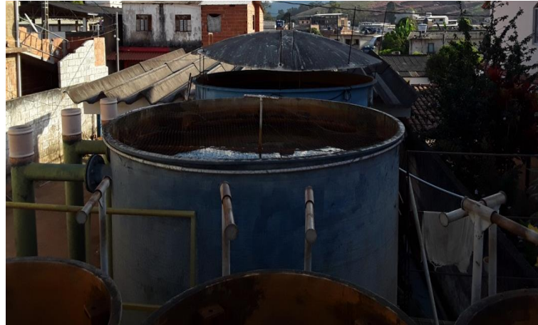
Figura 143 - ETA do Distrito de Vila Nova
