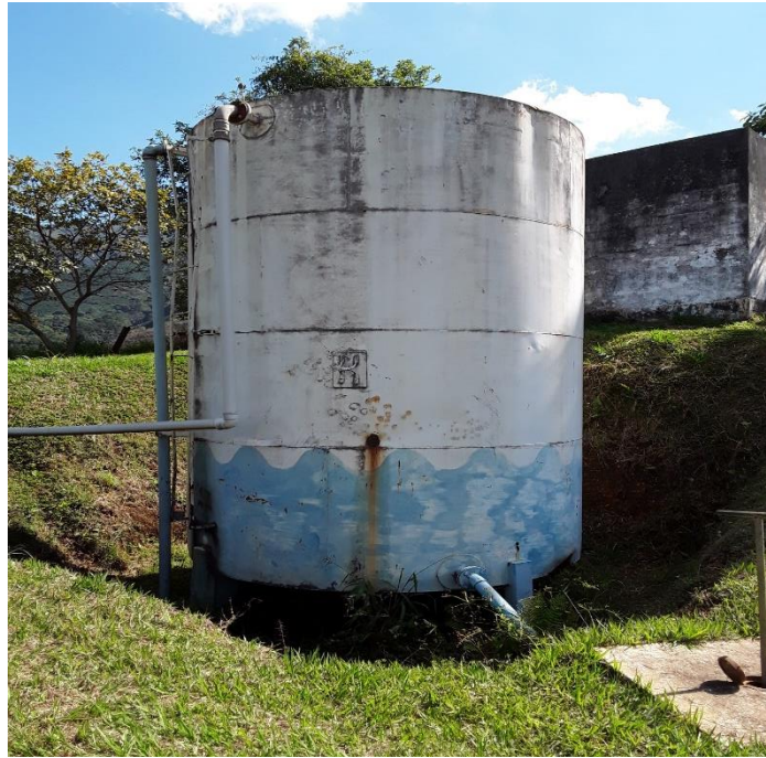
Figura 80 - Reservatório do distrito de Palmeiras do Manhuaçu
