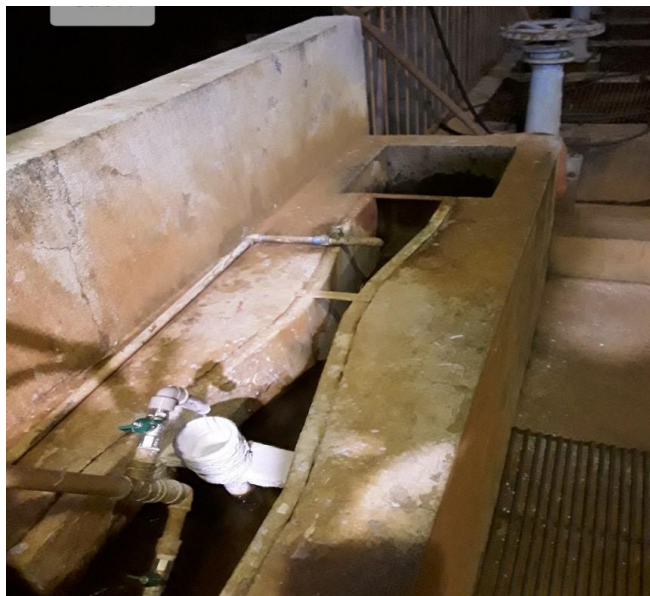
Figura 102 - Dosagem dos produtos acontece na calha Parshall.
