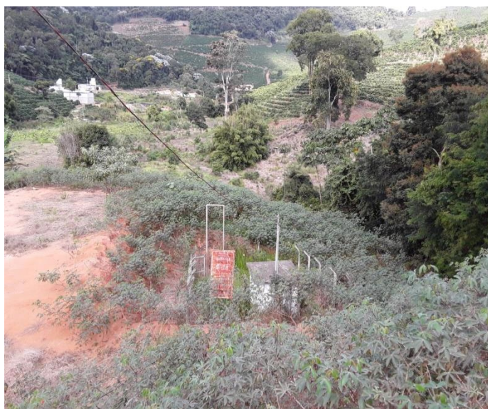
Figura 126 – Condições precárias do Poço 1 no SAA da Localidade mencionada
