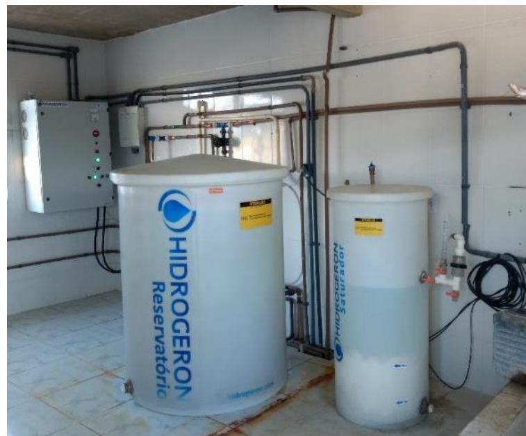
Figura 46 – Local de preparação do Cloro e Flúor – ETA SEDE
