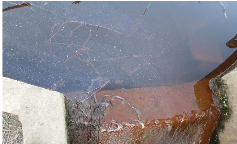
Figura 139 – Qualidade duvidosa da água bruta na captação do SAA local
