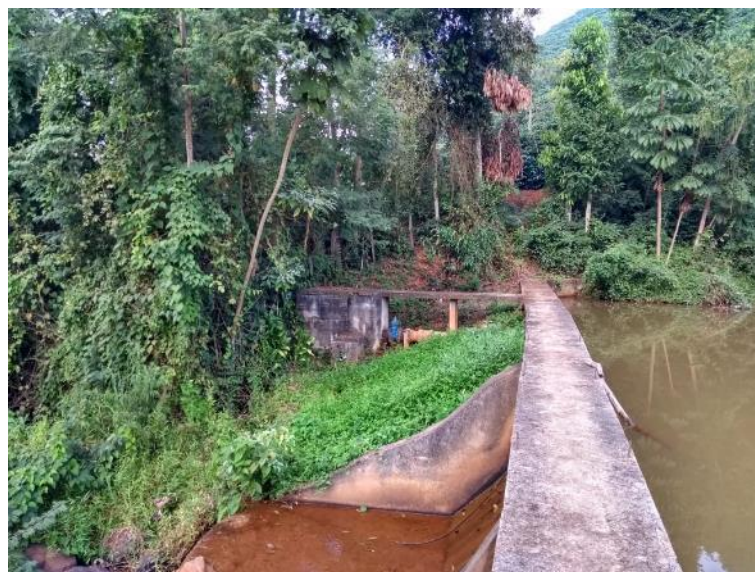
Figura 18 - Captação no Córrego São Sebastião
