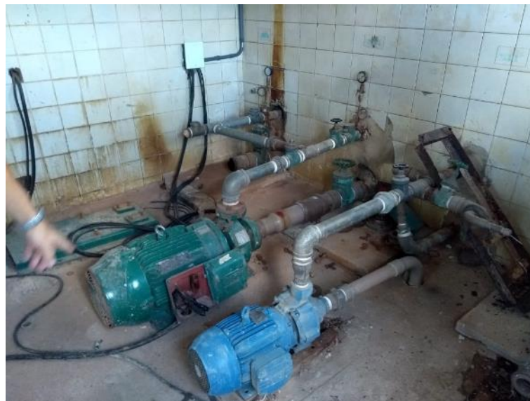
Figura 61 – Bombas – ETA Sede
