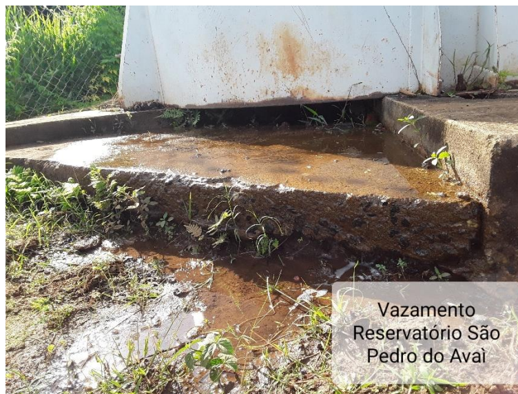
Figura 123 – Vazamento do reservatório – SAA São Pedro do Avaí
