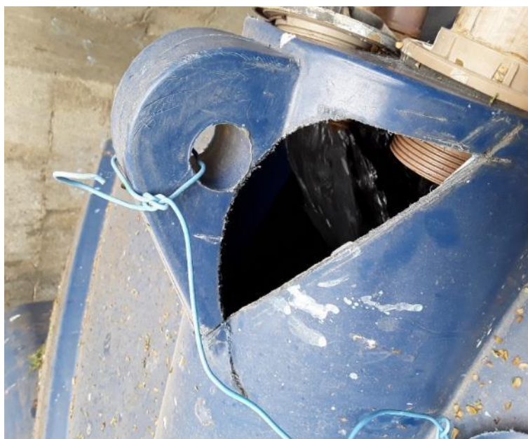
Figura 95 - Fenda no tanque de contato na elevatória 1
