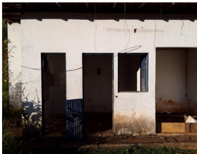
Figura 165 - Estrutura sucateada na ETA Engenho da Serra
