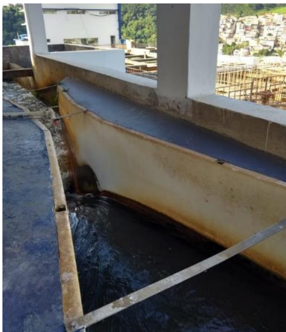
Figura 27 - Calha Parshall – ETA Sede
