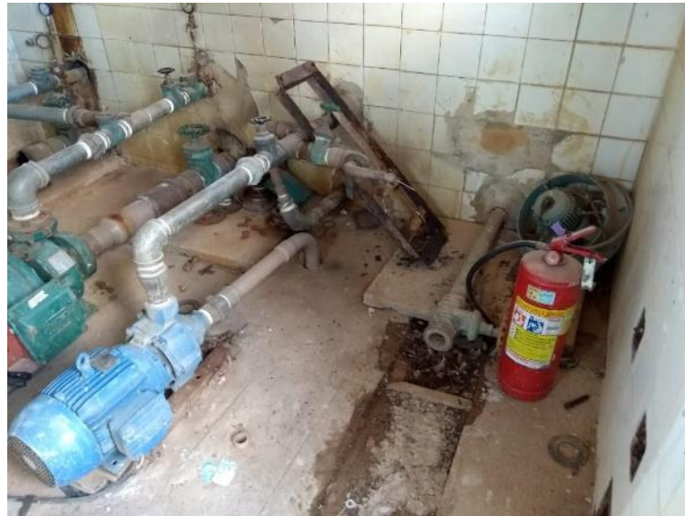
Figura 60 – Local das bombas – ETA Sede
