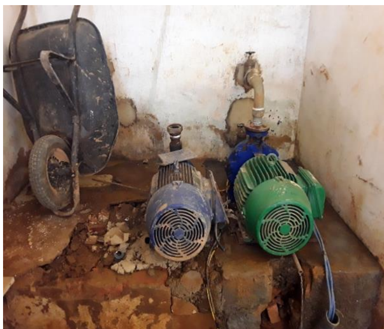
Figura 69 - de Bombas na ETA
