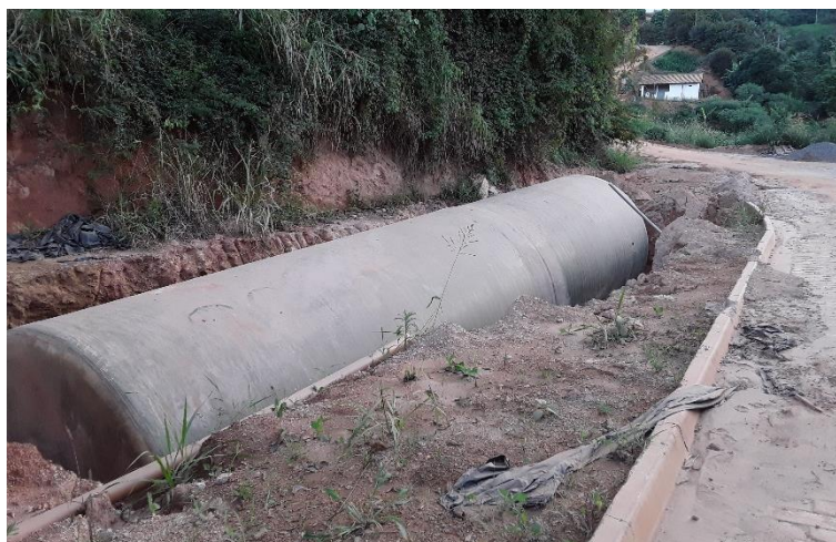
Figura 163 – Sistema de tratamento de esgoto– Alphaville
