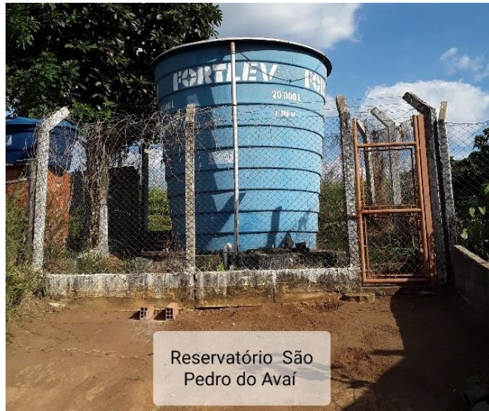
Figura 121 – Reservatório de Fibra– SAA São Pedro do Avai
