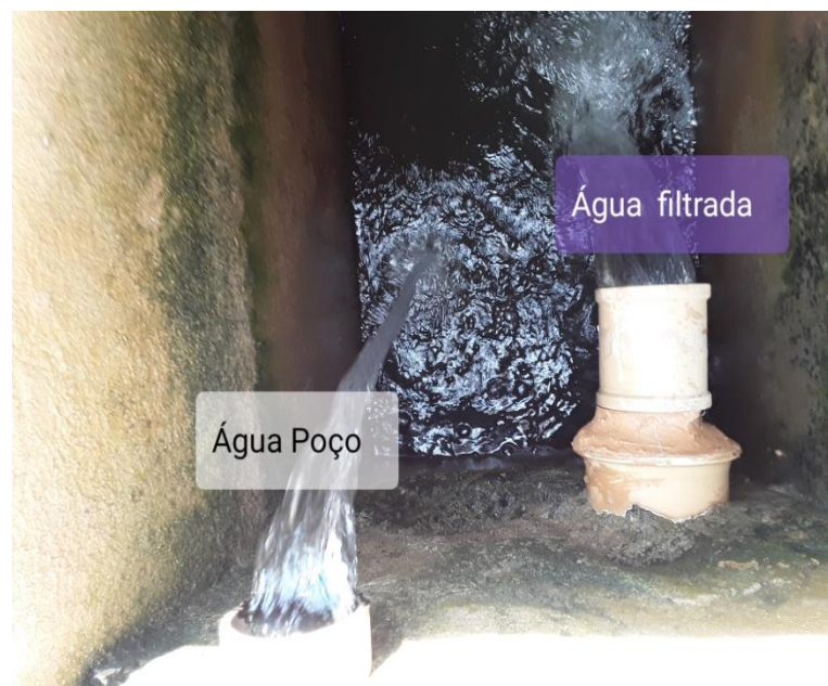
Figura 129. Chegada de água no tanque de contato na ETA
