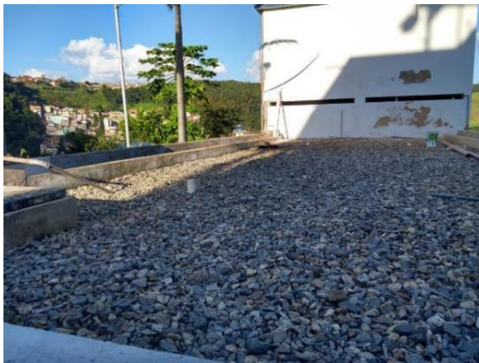
Figura 49 – Tanque de Contato – ETA Sede
