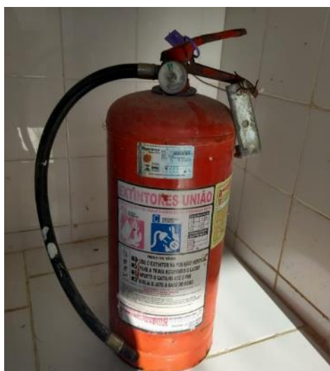
Figura 40 – Extintor embaixo da bancada - ETA Sede
