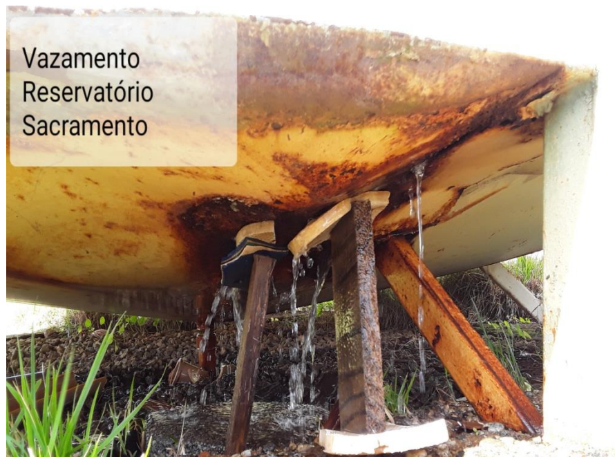
Figura 134 – Vazamento de água no reservatório de água
