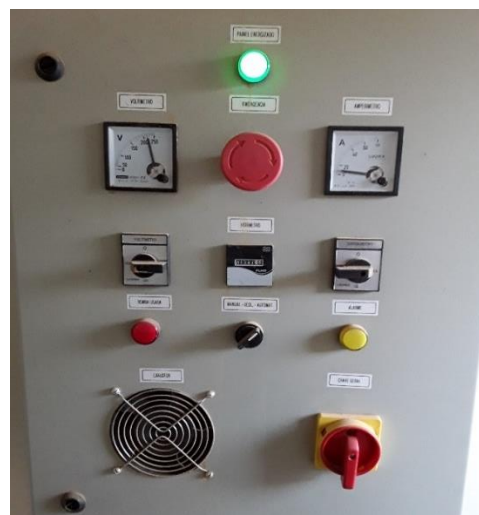
Figura 22 - Painel de Controle – Captação Alphaville
