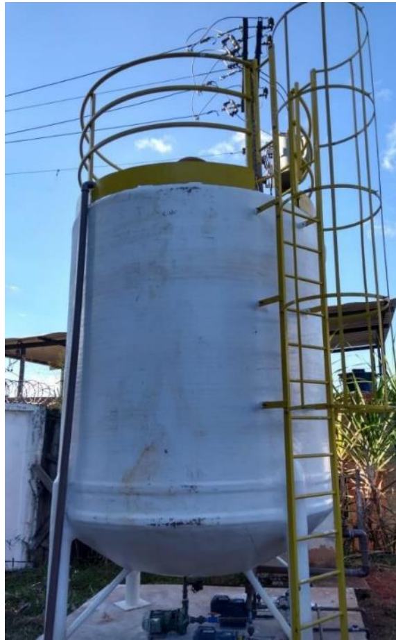
Figura 58 – Reservatório de Geocálcio – ETA Sede
