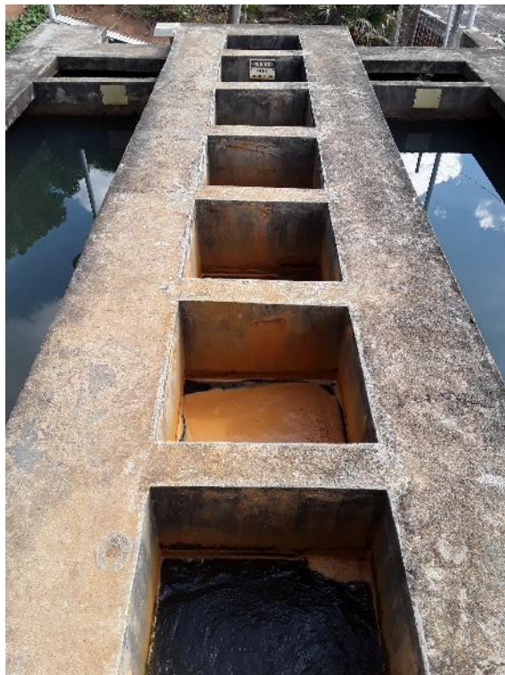
Figura 108 – Floculadores – SAA São Pedro do Avai
