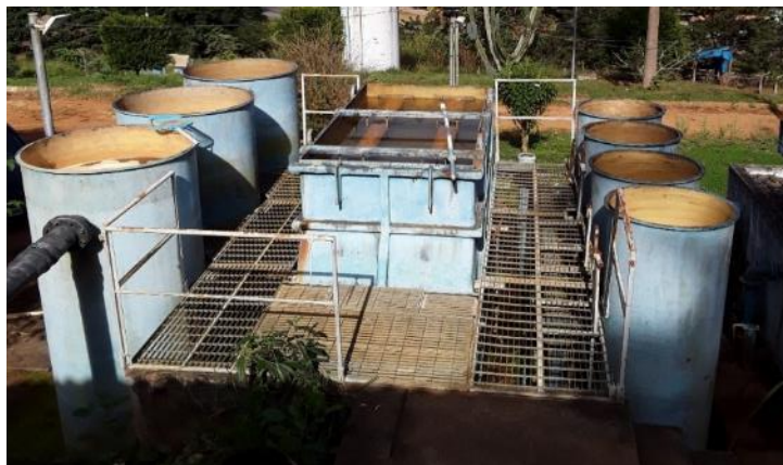
Figura 64 - ETA de Dom Corrêa do tipo compacta
