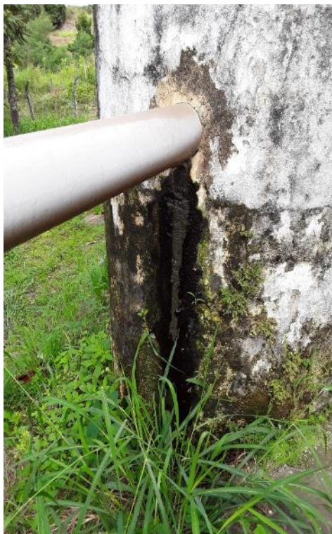
Figura 169 - Vazamento em estrutura da ETE de Realeza
