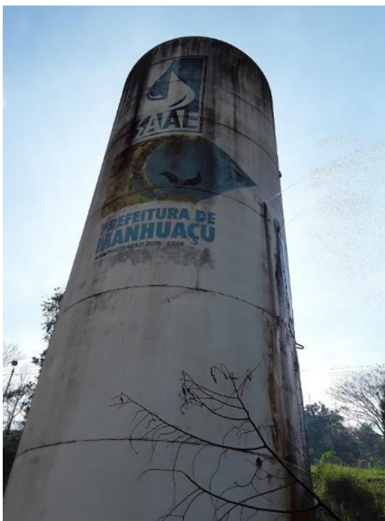
Figura 70 - Reservatório R-1 do distrito de Dom Corrêa
