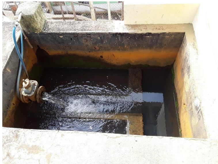
Figura 110 – Filtros – SAA São Pedro do Avai
