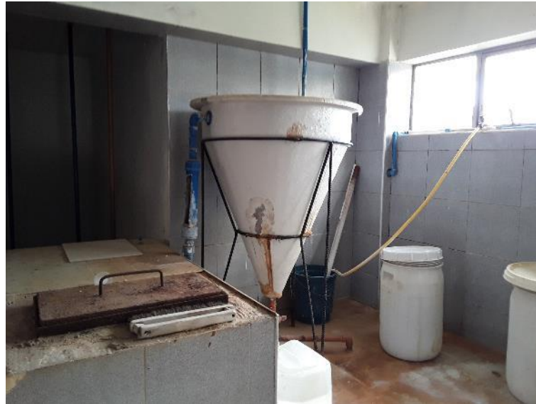
Figura 115 – Dosagem de Hidróxido de cálcio – SAA São Pedro do Avaí
