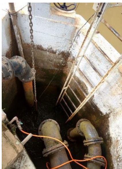
Figura 8 – Tubos de Sucção - Captação no Rio Manhuaçu
