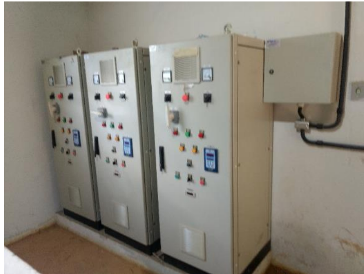
Figura 11 – Quadro de comando – Captação Manhuaçu
