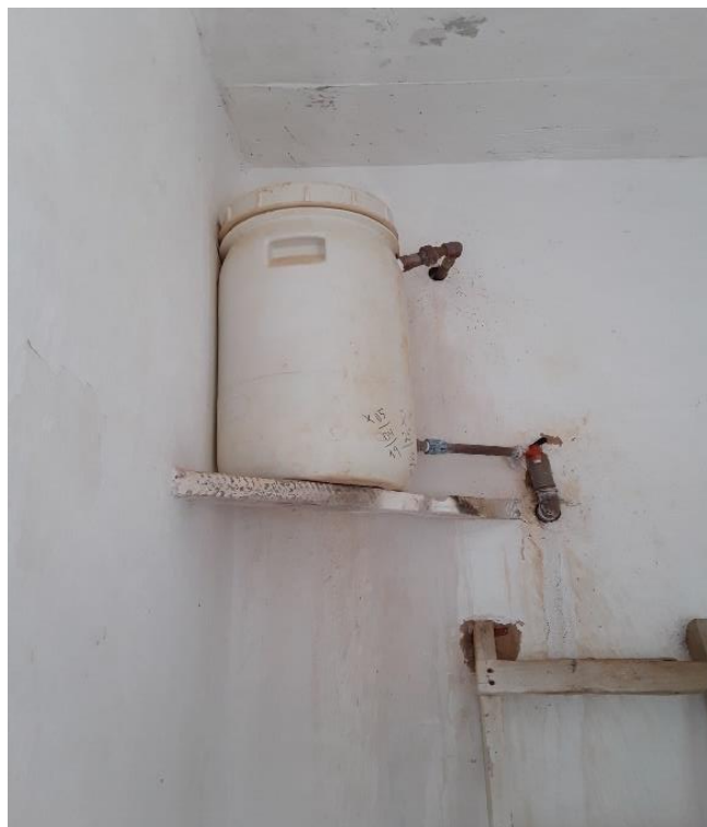
Figura 79 - Desinfecção na ETA de Palmeiras Do Manhuaçu
