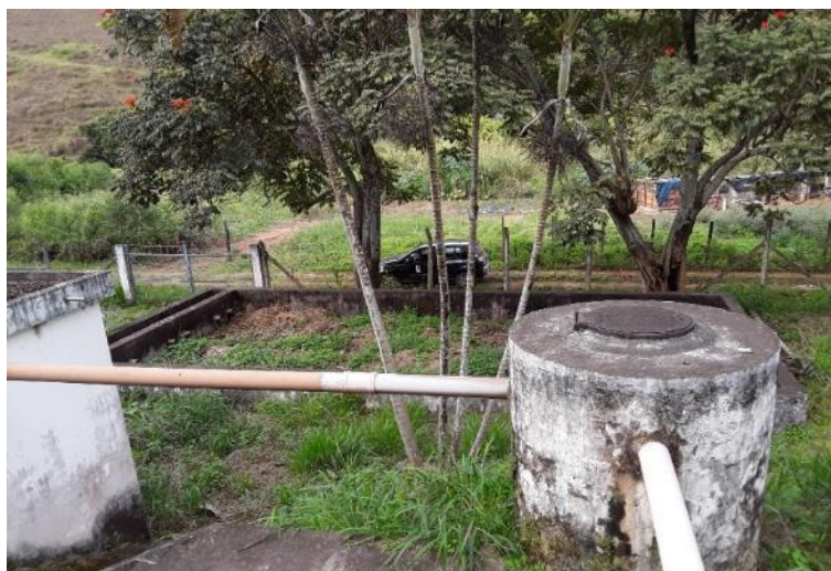
Figura 168 - Unidade de tratamento biológico na ETE do Distrito de Realeza
