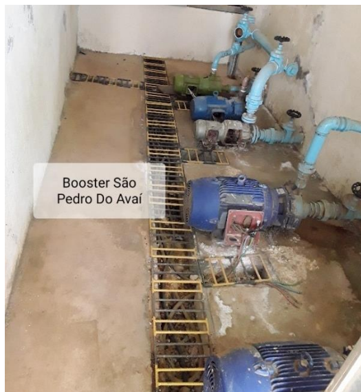
Figura 118 – Conjuntos motobomba – SAA São Pedro do Avaí
