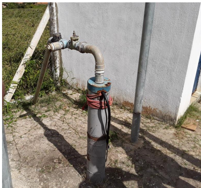
Figura 127 – Poço 2 no Distrito de São Sebastião do Sacramento
