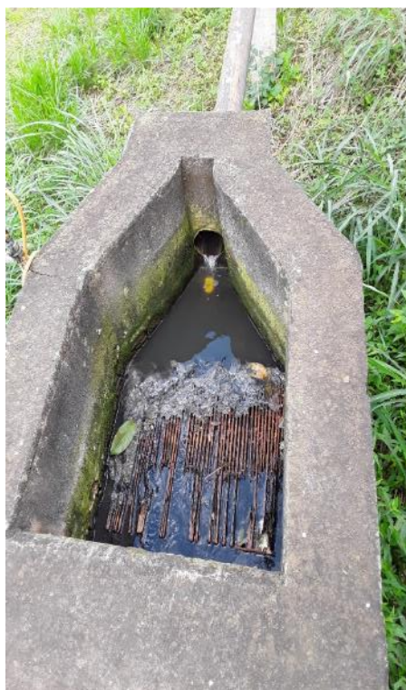
Figura 170 - Tratamento preliminar (gradeamento) na ETE de Realeza
