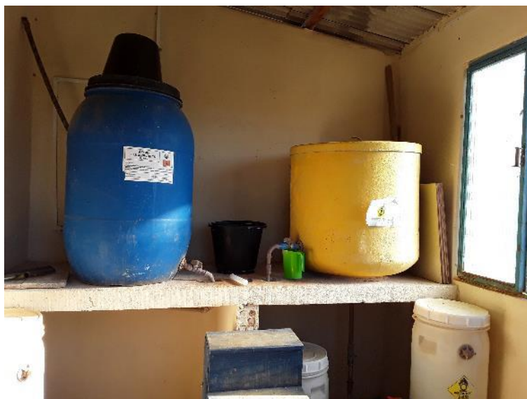
Figura 85 - Dosadores de Cloro e Flúor
