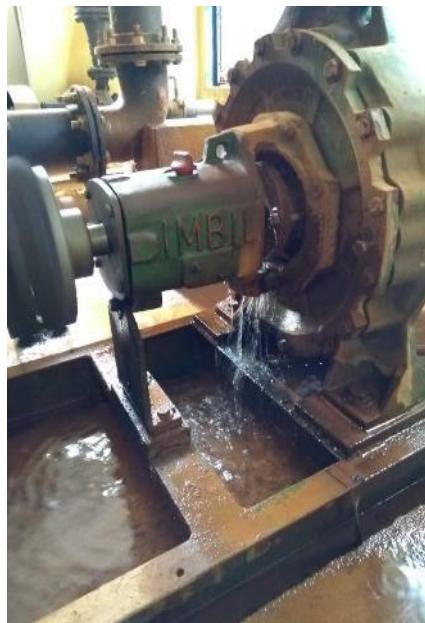
Figura 10 – Vazamento – Captação Manhuaçu
