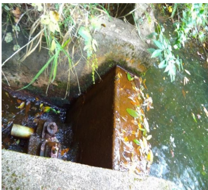
Figura 124 - Captação no Córrego São Sebastião
