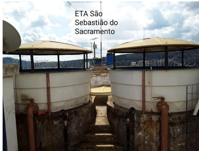
Figura 128 - ETA de São Sebastião do Sacramento
