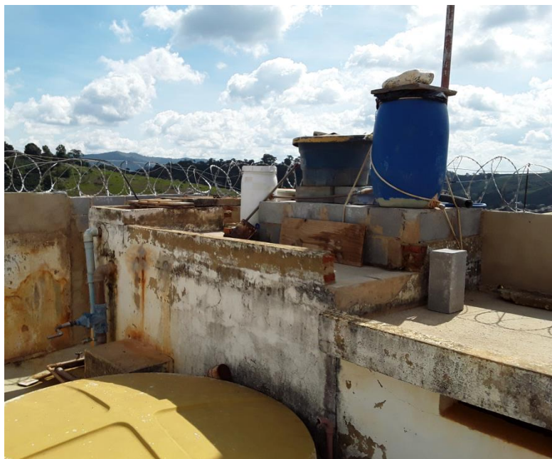
Figura 132 – Desinfecção e Fluoretação na ETA de São Sebastião Do Sacramento
