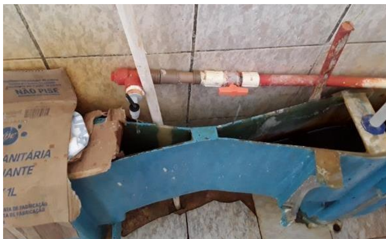
Figura 68 - Dosagem dos produtos acontece na calha Parshall
