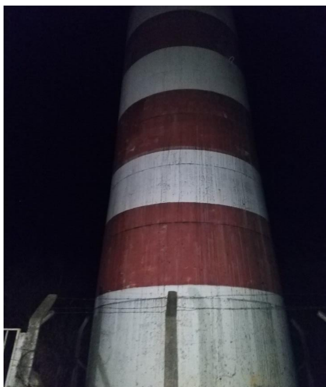
Figura 104 - Reservatório do distrito de Santo Amaro de Minas
