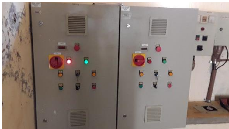
Figura 119 – Painel de Controle – SAA São Pedro do Avaí
