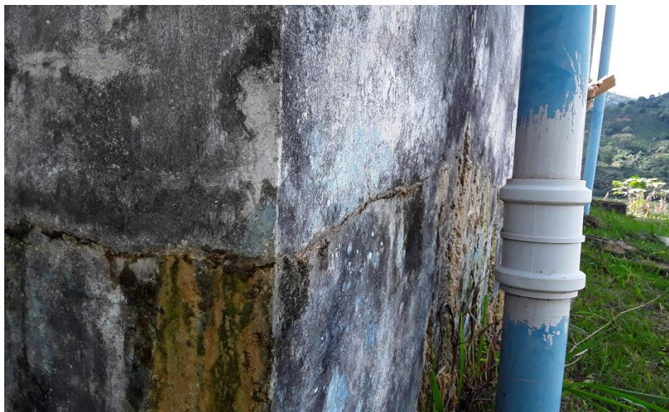
Figura 81 –Infiltração de água no tanque de contato da ETA de Palmeiras do Manhuaçu
