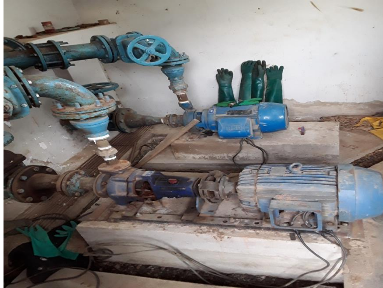
Figura 149 – Conjunto Moto bomba na ETA
