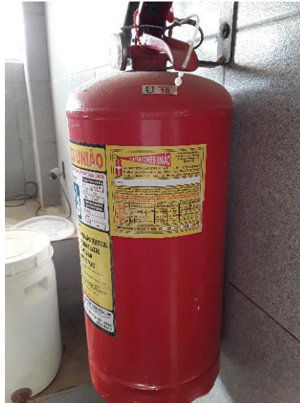
Figura 117 – Extintor de incêndio – SAA São Pedro do Avaí
