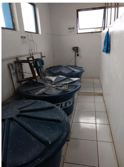
Figura 11 – Sala de preparo de produtos químicos.
