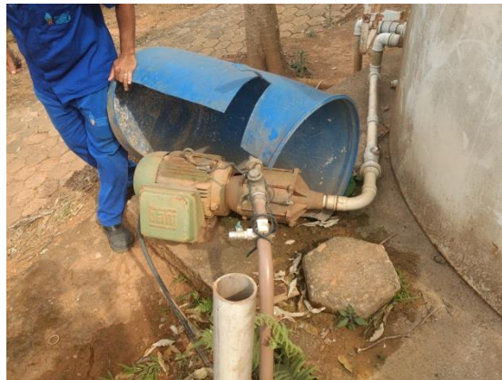
Figura 18 – Bomba que auxilia na distribuição da água.
