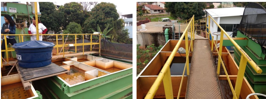
Figura 7 – ETA na sede do município.
