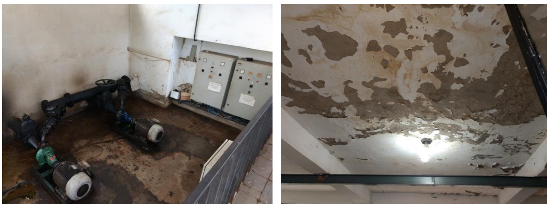
Figura 12 – Casa de bombas.
