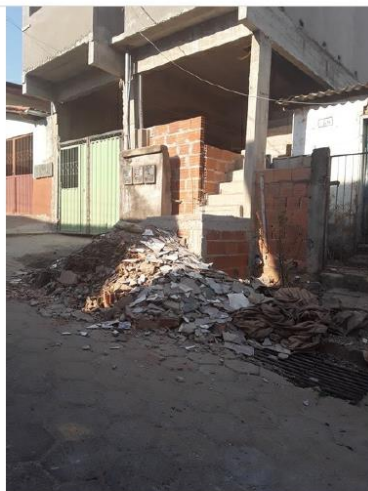
Disposição irregular de resíduos de construção civil
