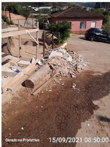
Disposição inadequada dos resíduos de construção civil
