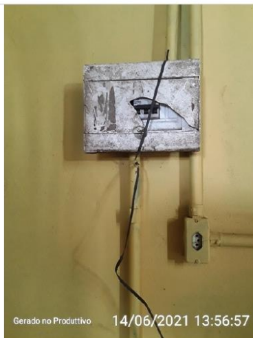
Quadro de energia elétrica das prensas hidráulicas.
