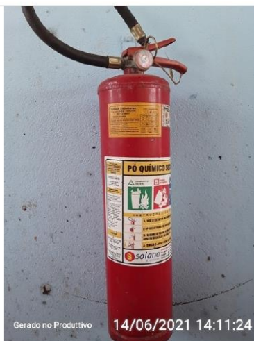
Extintor de incêndio Tipo ABC.
