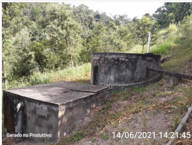
Fossa séptica mais filtro anaeróbico da UTC.
