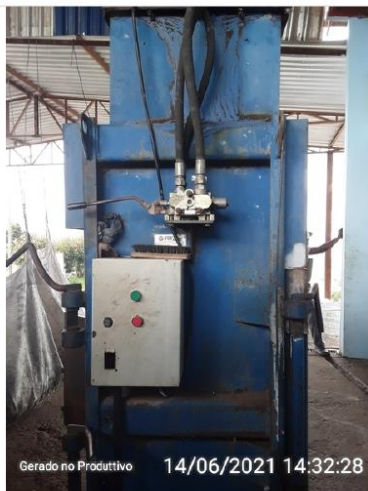
Parte elétrica da prensa hidráulica 2.
