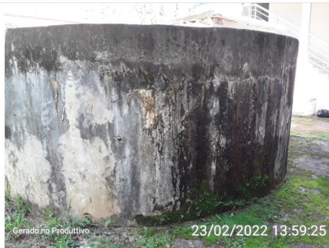
Infiltrações na estrutura do reservatório
