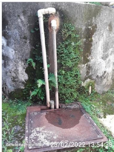
Caixa de descarga do tubo extravassor
