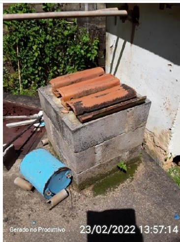
Abertura no reservatório
