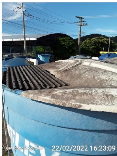
Tampa dos filtros
