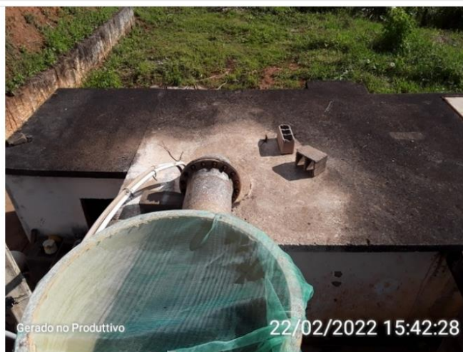
Tanque de Contato
