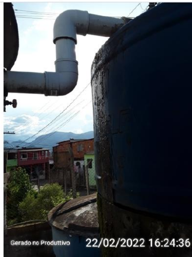
Vazamento em um dos filtros de brita
