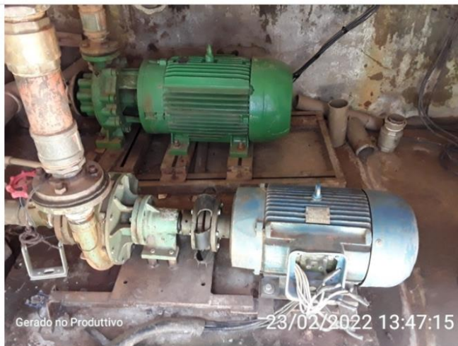
Conjunto moto-bomba reserva
