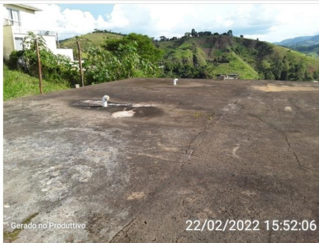
Tubulações de ventilação
