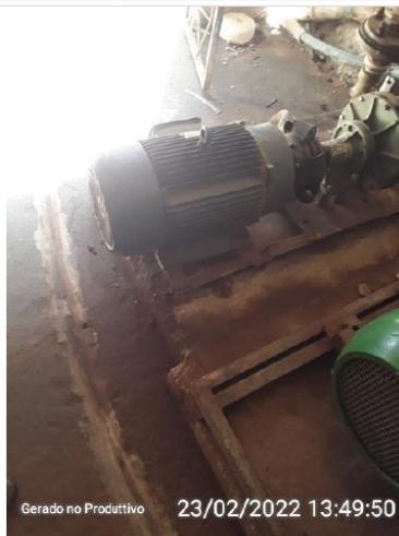
Local para drenagem de vazamentos inexistente
