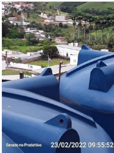
Tubulação de ventilação
