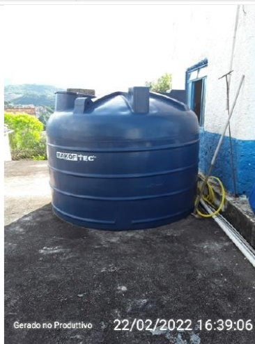
Reservatório de polietileno
