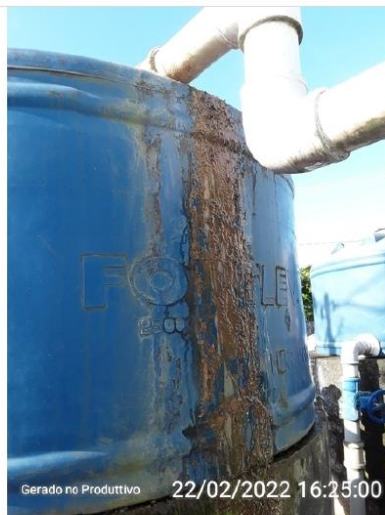
Vazamento em um dos filtros de brita
