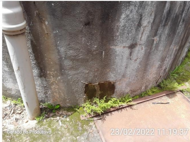
Infiltração na estrutura
