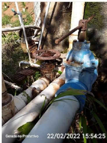
Registro das tubulações do reservatório
