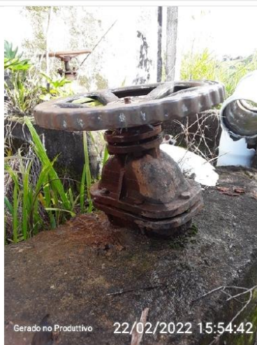
Registro das tubulações do reservatório
