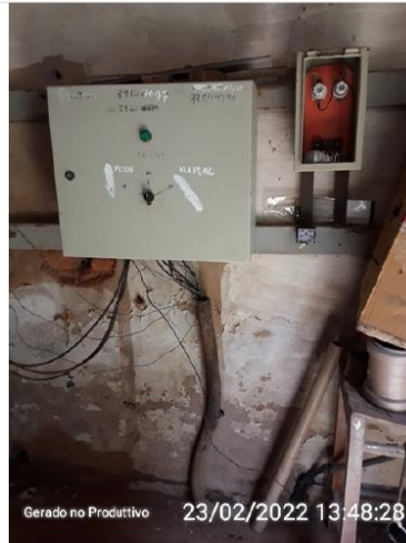
Instalações elétricas expostas
