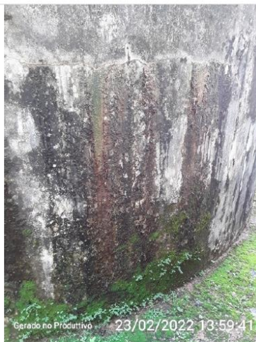
Infiltrações na estrutura do reservatório
