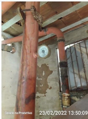
Manômetro com defeito
