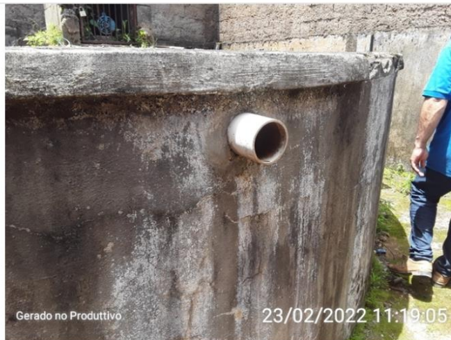
Tubulação de ventilação
