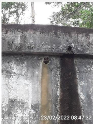
Tela na tubulação de ventilação
