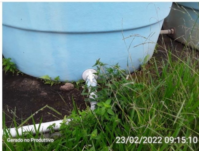
Registro de saída de água
