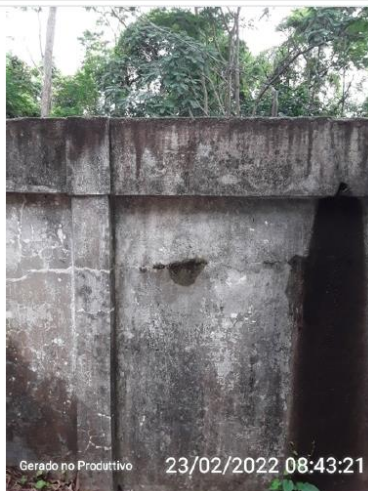
Pequena rachadura no reservatório
