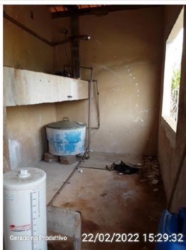
Área de dosagem
