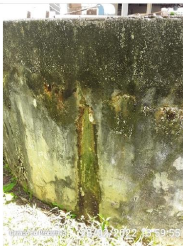
Infiltrações na estrutura do reservatório
