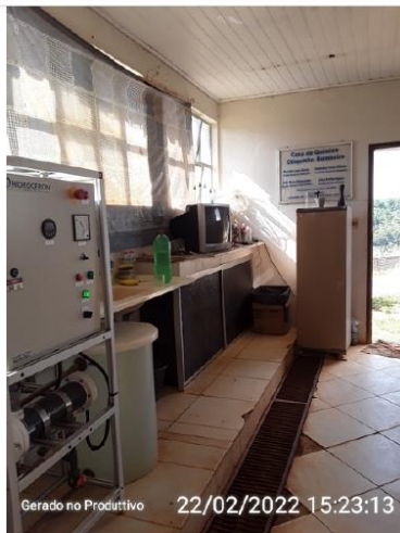
Gerador de hipoclorito de sódio
