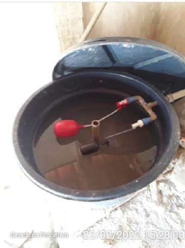
Reservatório de água para preparo de produtos químicos
