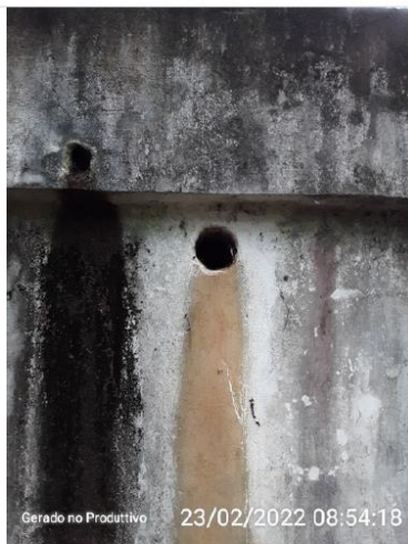
Tela na tubulação de ventilação
