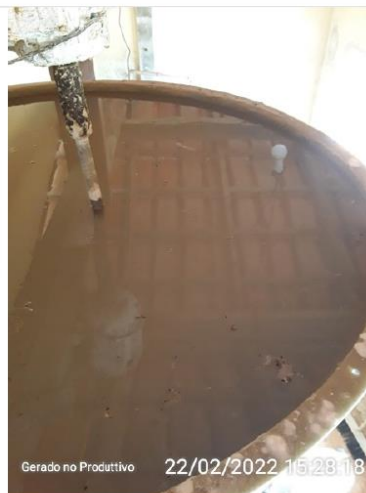
Tanque de preparo de produtos químicos
