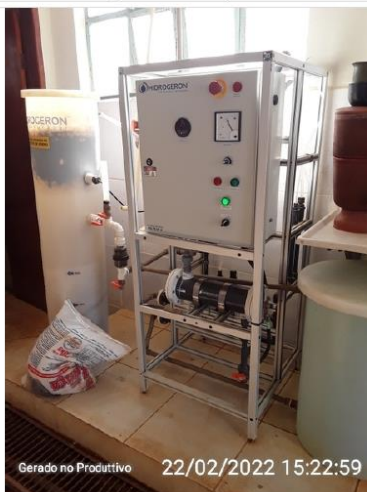
Gerador de hipoclorito de sódio
