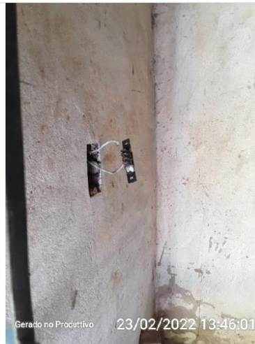
Instalações elétricas expostas
