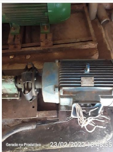
Conjunto motobomba sem proteção
