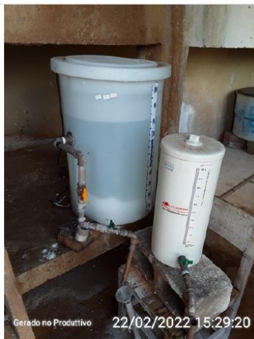
Reservatório (Gerador de hipoclorito de sódio)
