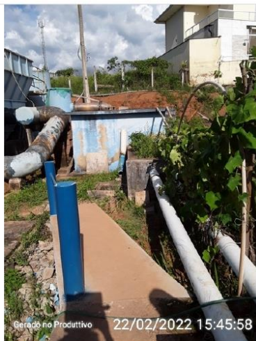
Tanque de contato
