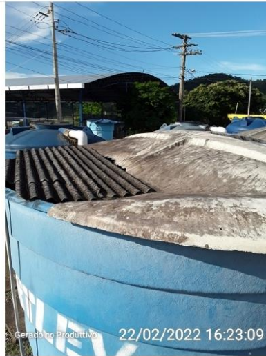
Cobertura dos filtros
