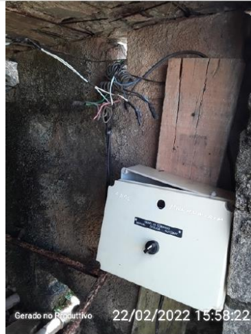
Fios e painel elétrico
