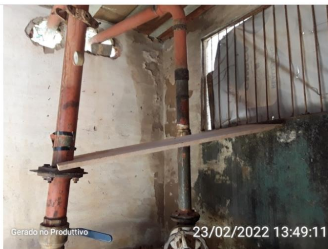
Estruturas de manutenção inadequadas
