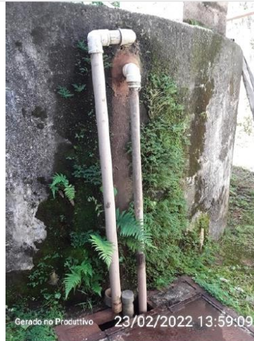
Infiltrações na estrutura do reservatório
